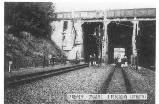
写真-Ⅲ.1.7 JR横断橋梁の被害
