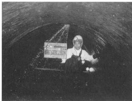
写真-Ⅲ.2.1 管渠内への漏水 (猪名川流域下水道)
