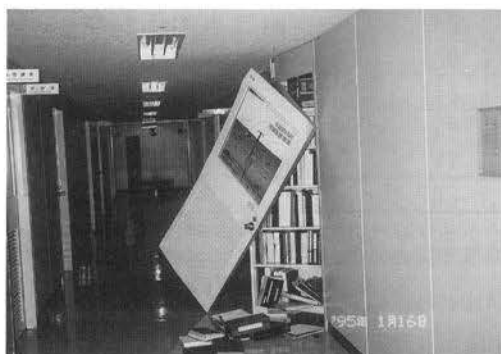
写真-Ⅲ.1.1 県庁舎内の被災状況
