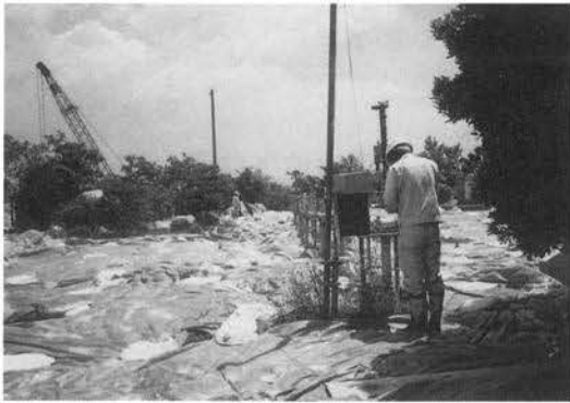
写真-Ⅲ.1.5 伸縮計設置状況 (仁川百合野町地区)
