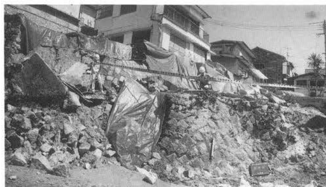
写真-IV.4.1 石積擁壁の崩壊(神戸市須磨区)
