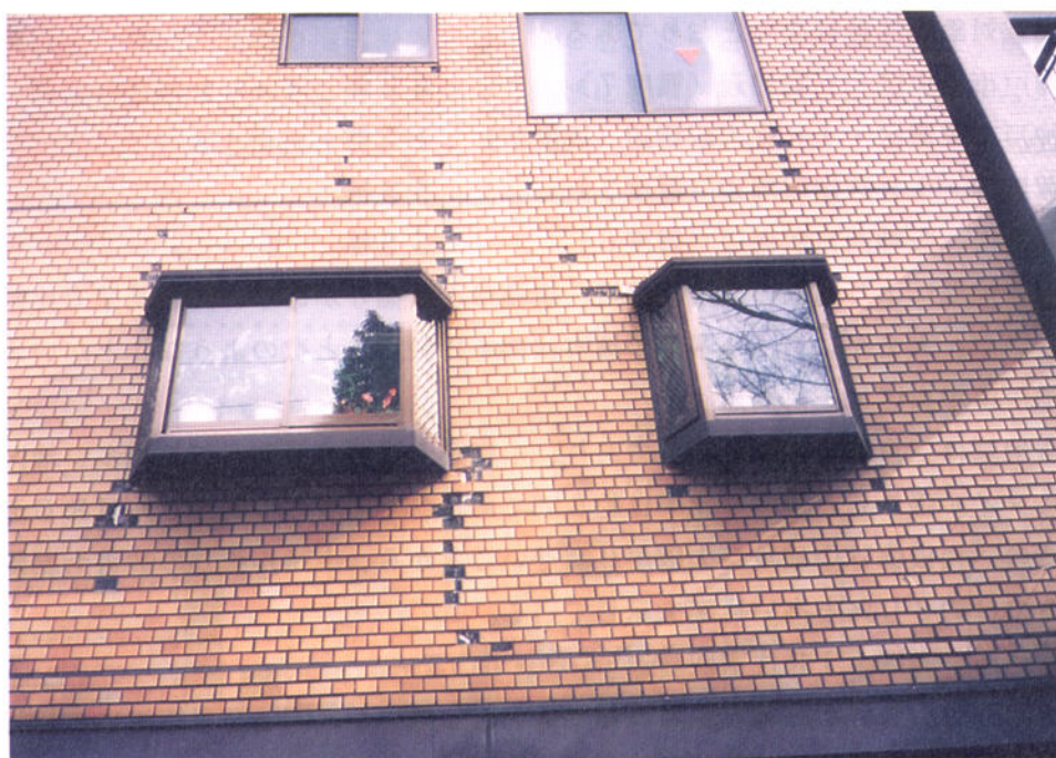
写真. 4-18 ALCジョイントのひび割れと剥離
