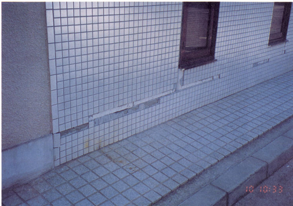
写真. 4-6 ALC下地 基礎との取り合い部及び板間ジョイント部の剥離
