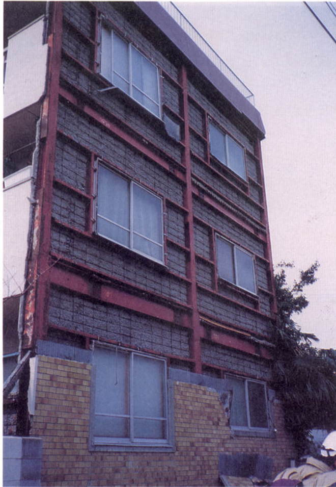
写真. 4-5 ラスモルタル下地 ラス留め付け部からの剥離
