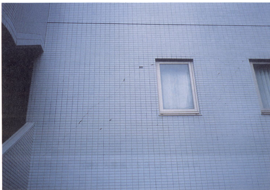
写真 3 - 6. B 2 : ひび割れ大 (例)
