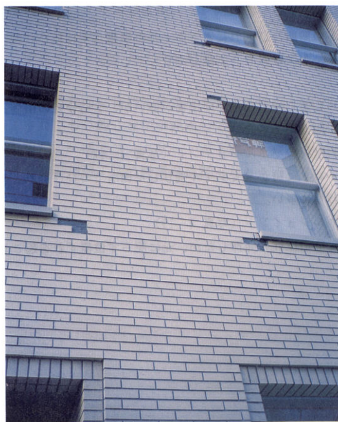
写真. 4-13 開口隅部のひび割れと剥離
