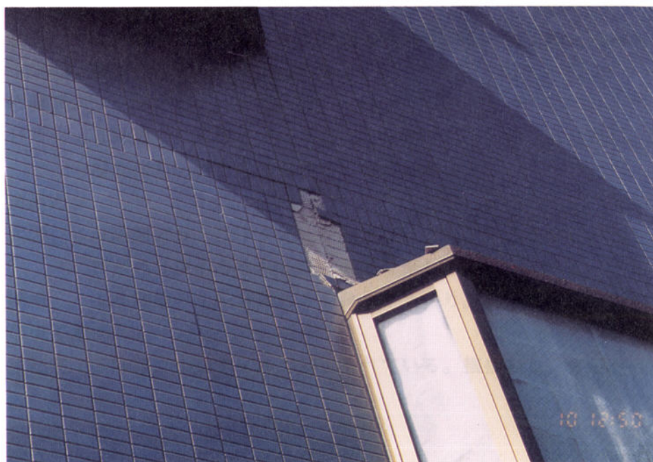
写真. 4-10 タイルと張付けモルタル間の界面剥離 くし目ごてによるタイル張り
