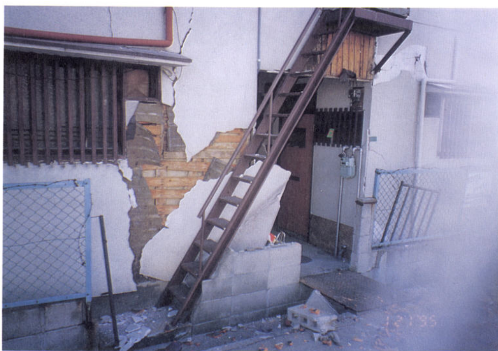
写真-4-24 阪神・西宮北口付近 ラス下地に吹付け。このような例は至る所にあり。
