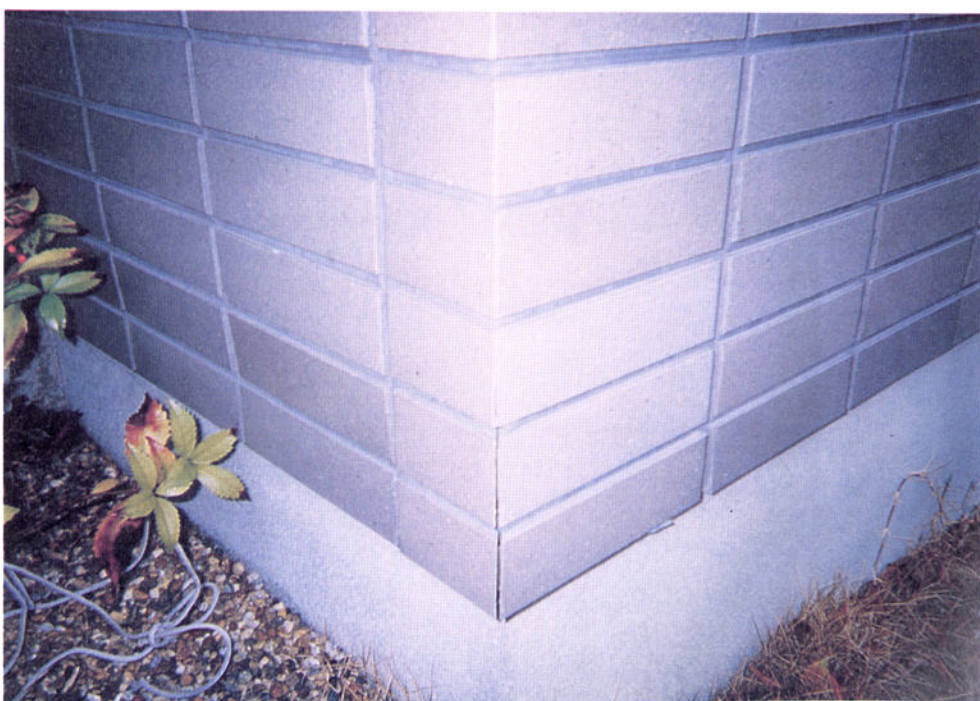
写真-4-29 同上 一部コーナーにクラックがある。
