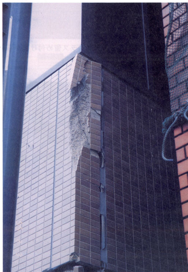
写真. 4-8 PC板先付け工法 コーナー部のタイルがコ ンクリートと共に剥離
