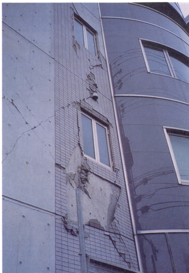
写真. 4-9 コンクリートと下地間の界面剥離
