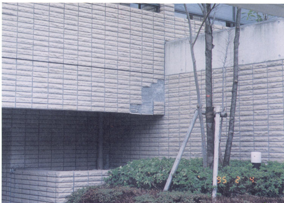
写真. 4-14 入隅部の剥離
