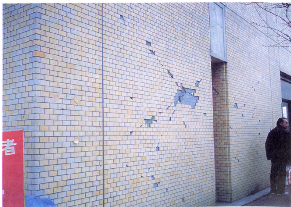
写真. 4-17 平壁のひび割れと剥離
