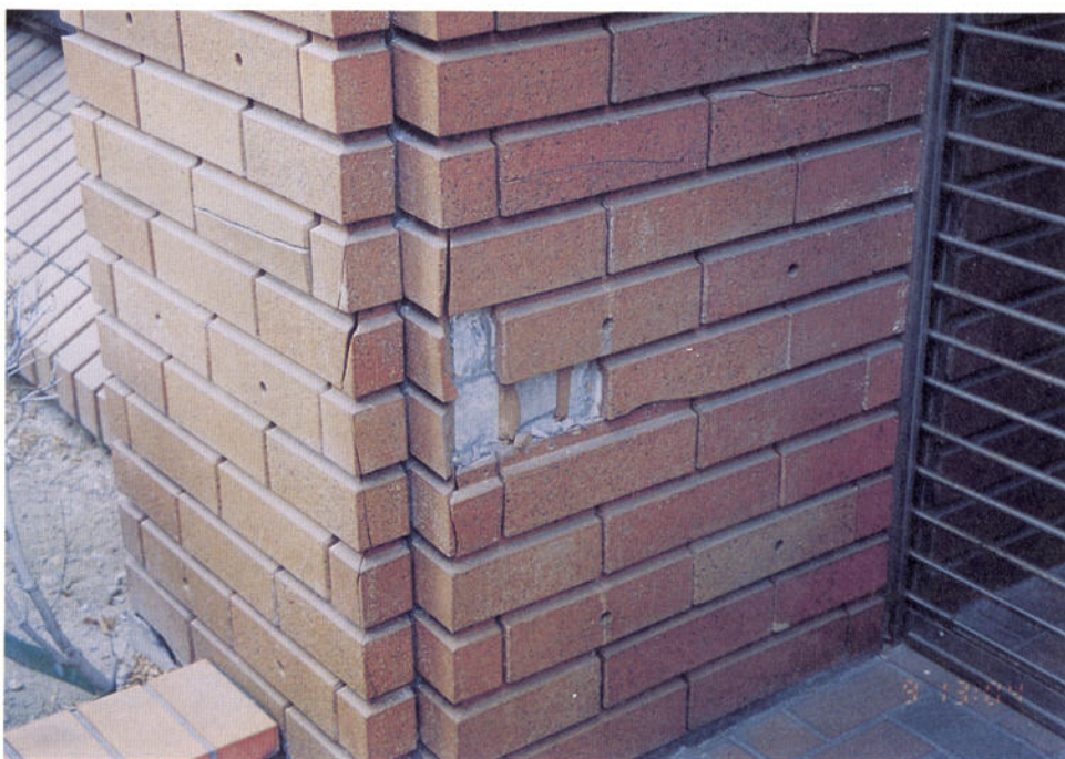
写真. 4-15 出隅部のひび割れと剥離
