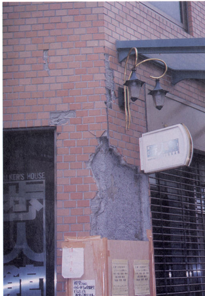
写真. 4-11 こすりの軽量モルタルの凝集破壊
