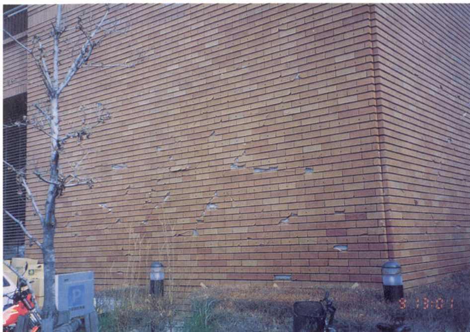
写真. 4-7 型枠先付け工法 ひび割れは多くみられるが タイル1枚以上の剥離は発生していない。
