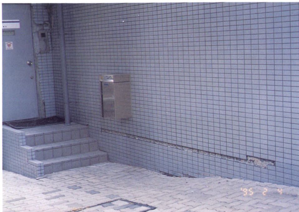
写真. 4-16 打ち継ぎ目地部の剥離
