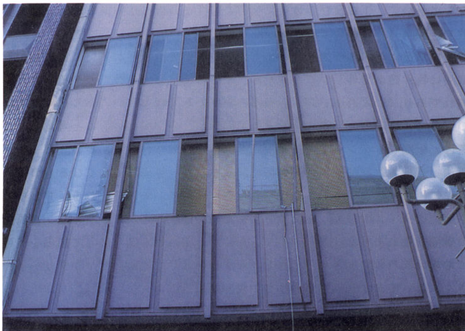
写真. 4-3 金属パネル サッシの変形はみられるが、金属パネルの変形はみられない。
