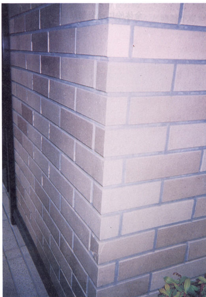
写真-4-27 同上 詳細にみると一部のコーナー部にクラックがある。
