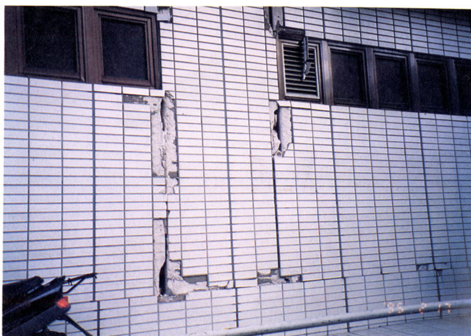
写真-4-25 阪神・深江駅付近 鉄骨に50mmALC取付け、板間ジョイント部が母材破断
