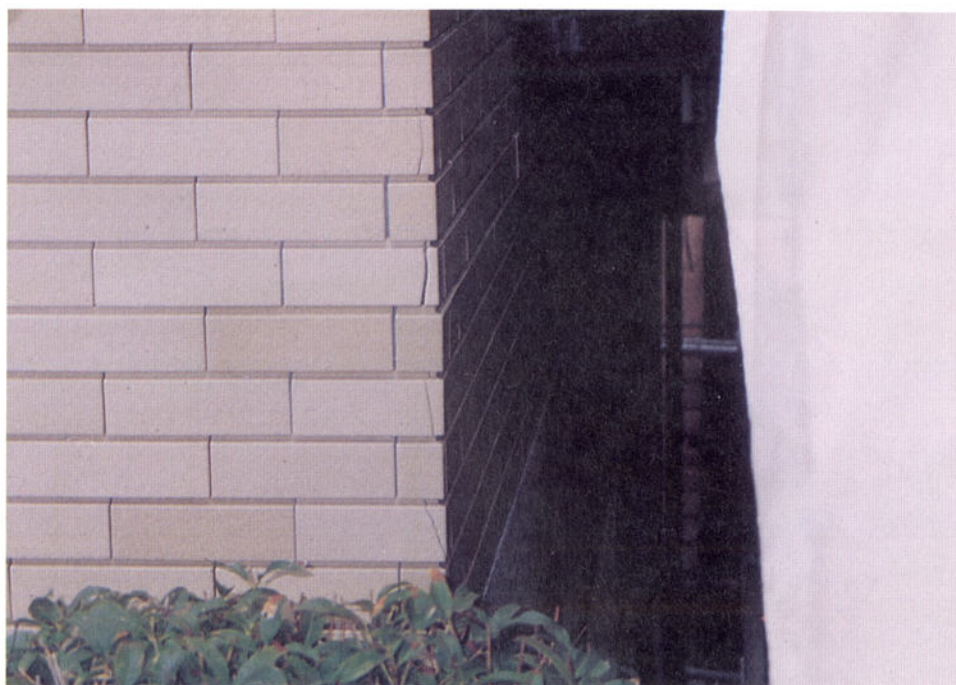
写真-4-31 同上 出隅部にわずかにクラックが有る。隣家が傾き倒 れかっているためか。（隣家は倒壊した4Fマンション）
