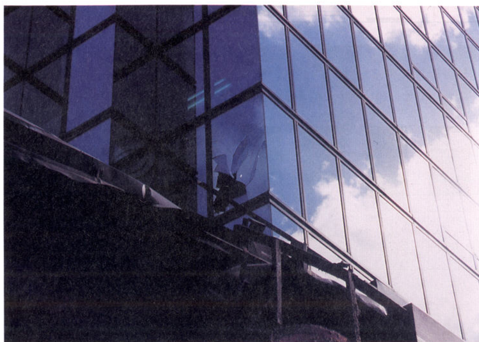
写真. 4-4 ガラスのカーテンウォール 調査Ⅰの範囲で剥離が確認された建物はこの1件のみ
