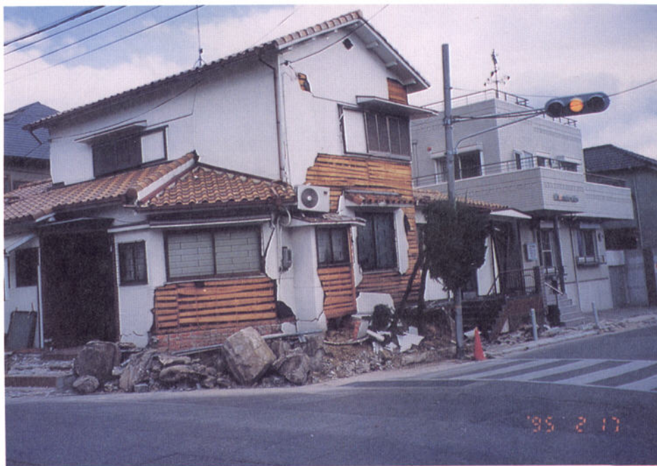
写真-4-22 芦屋市打出町付近 ラス下地吹付け、木ズリ部から剥落。建物は新しい。
