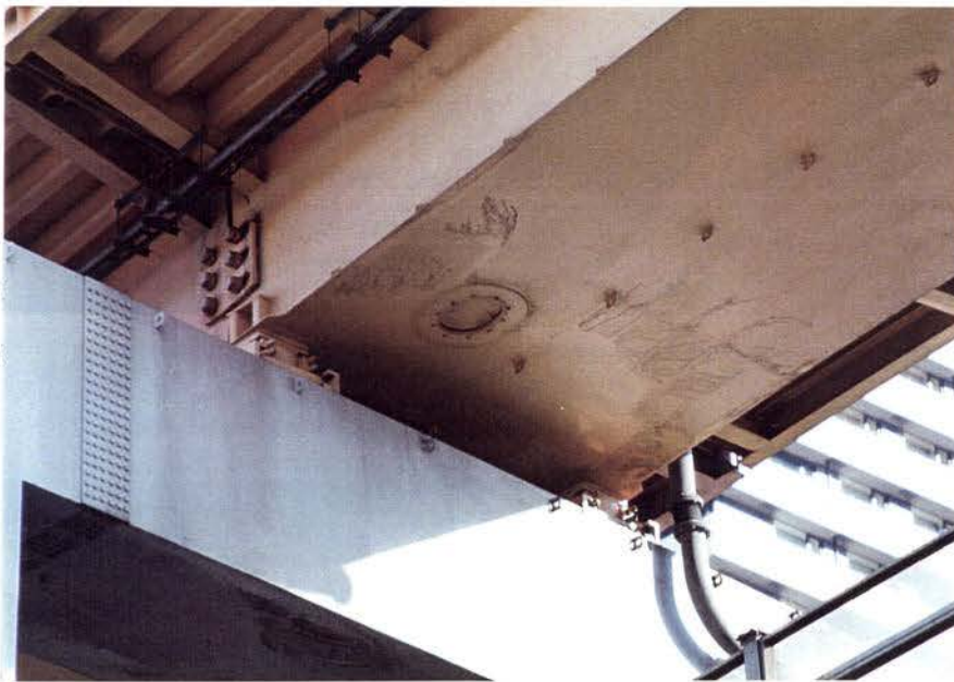
1. 12 b : P 4 2 (上層桁) 左右の桁が突き当たって、遊間 がなくなっている。山側から見 上げたとき。
