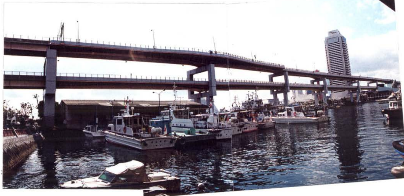
1. 2 a : 京橋付近から 左から、P34、35、36…… P36上で上層桁が橋軸直角方 向に大きくずれている。
