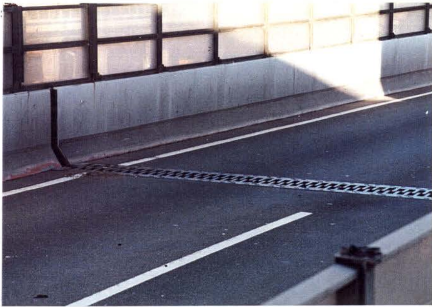
1. 12 f : P 4 2 (下層桁) 舗装およびExpは、何も損傷 はなさそう。
