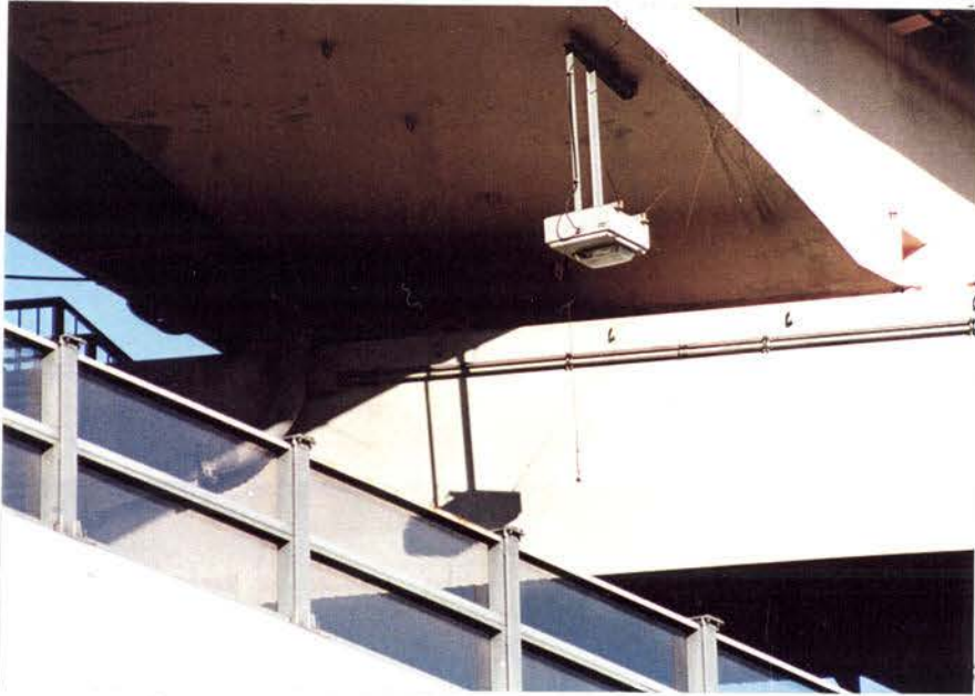
1. 10 b : P40 (海側から) 上層桁から吊り下がった照明を 固定するワイヤーが切れている。
