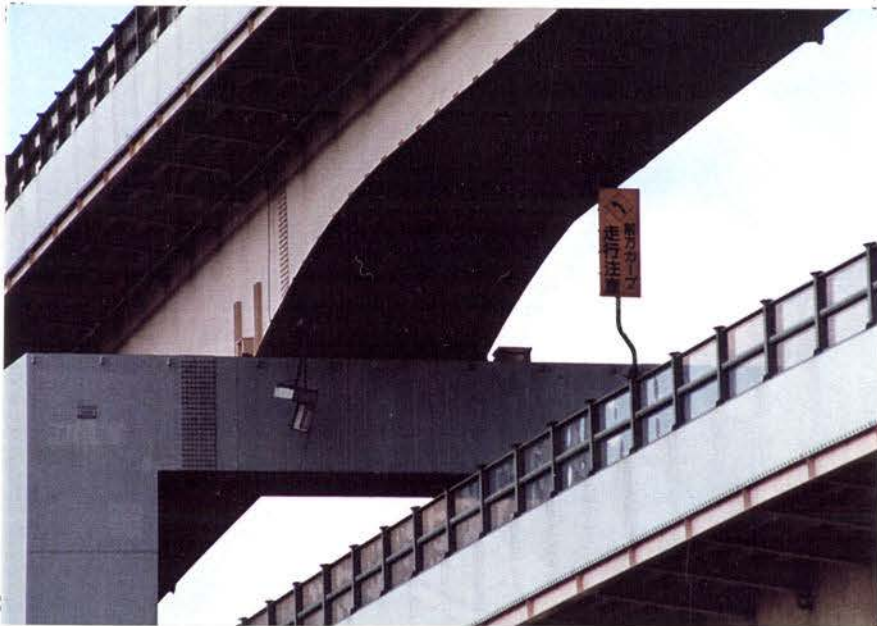
1. 7 b : P 3 7 (海側から) 上層桁が海側へ移動し、山側沓 が脱落。
