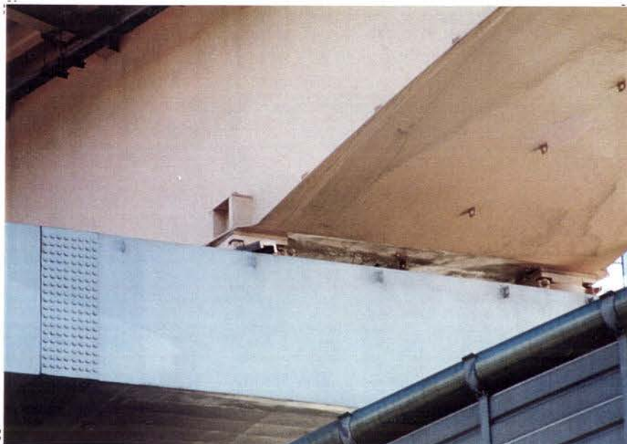
1.15g:P44 (上層桁) 左側(山側)の脊のサイドブロッックが破損している。
