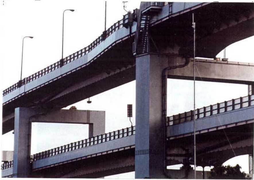
1. 10 a : P40 (山側から) 上層桁が山側へ移動。非常階段 がねじれている。
