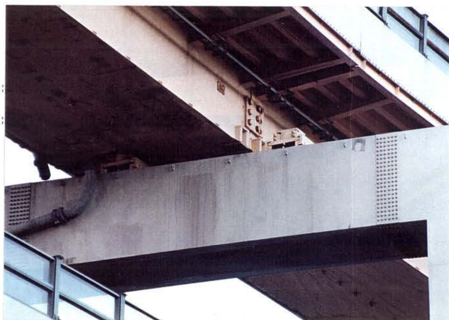
1.9b : P39 (海側から) 排水管の位置から、約1m弱も 移動した模様。
