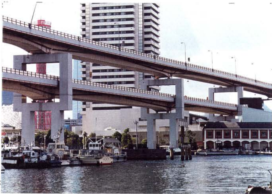
1. 2c : 京橋付近から 左から、P37、38・・・ P37上で照明柱が大きく傾いている。
