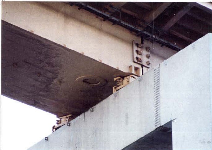
1. 16b : P45 (上層桁) 右（山側）の上沓が破損。桁の遊間がほとんどなくなっている。
