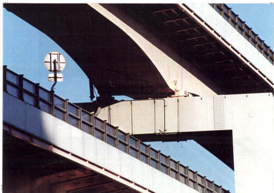
1. 8 b : P 3 8 (海側から) 海側沓が脱落。桁は山側に移動。
