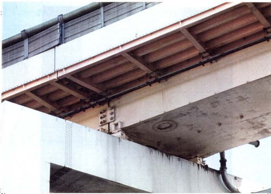
1.16c: P45 (上層桁) 両桁が近づいたため、防音壁が座屈。
