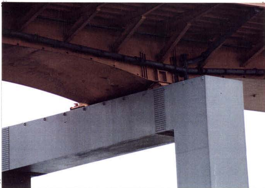
1.5c : P35 (山側から) 上層桁が海側の支承から脱落。
