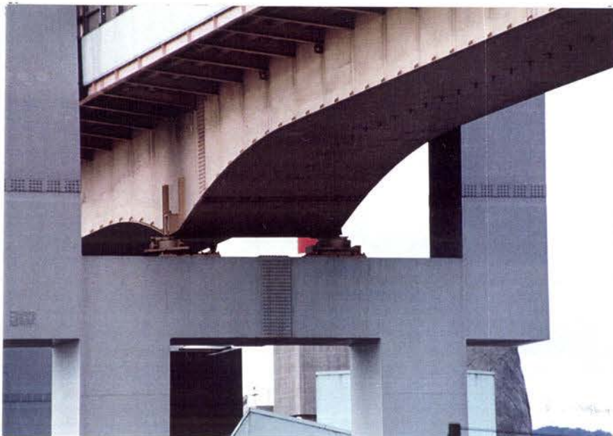
1. 7 c : P 3 7 (海側から) 下層桁も海側へ移動し、海側沓 が破損。壁高欄が柱にあたって いる。
