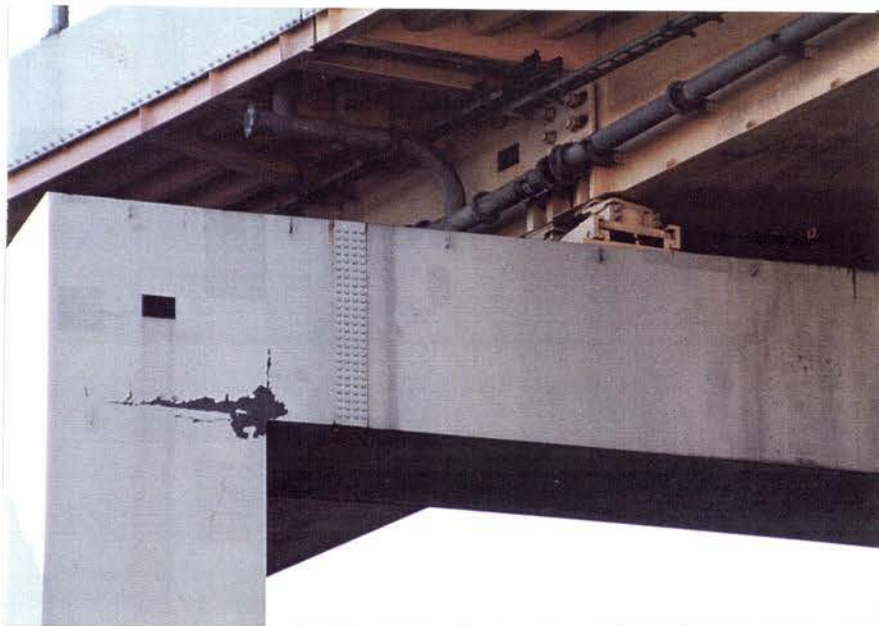
1. 16a : P45 上層の水平梁の隅角部（海側）に大きな塗装の剥離が見られ、大きな応力集中があったと思われる。
