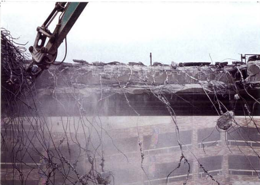
1. 24 c : 同上 緊張したままのPC鋼線が見え ている。
