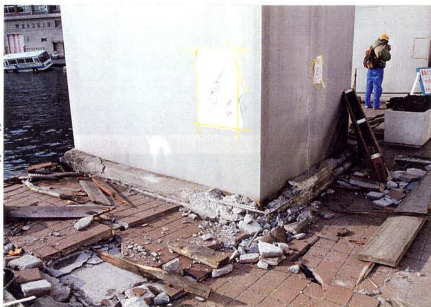
1. 15 d : P 4 4 (海側) 脚基部。周辺の護岸が沈下。 根巻きコンクリートが破損し、 脚が揺さぶられたことがわかる。
