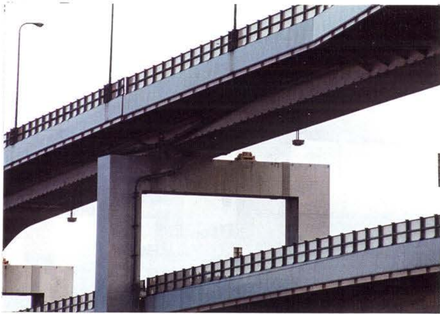
1.9c : P39 (山側から) 下層桁の防音壁も破損。
