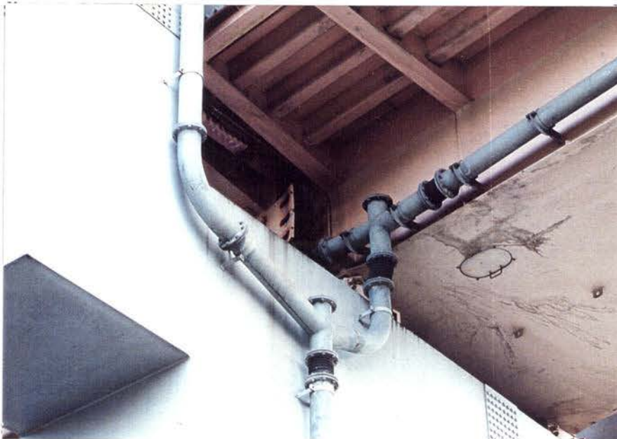
1.9e : P39下層桁 (山側から) 相手側 (向かって左) の下層桁 が、多少山側へ移動して、連結 板が破損している。
