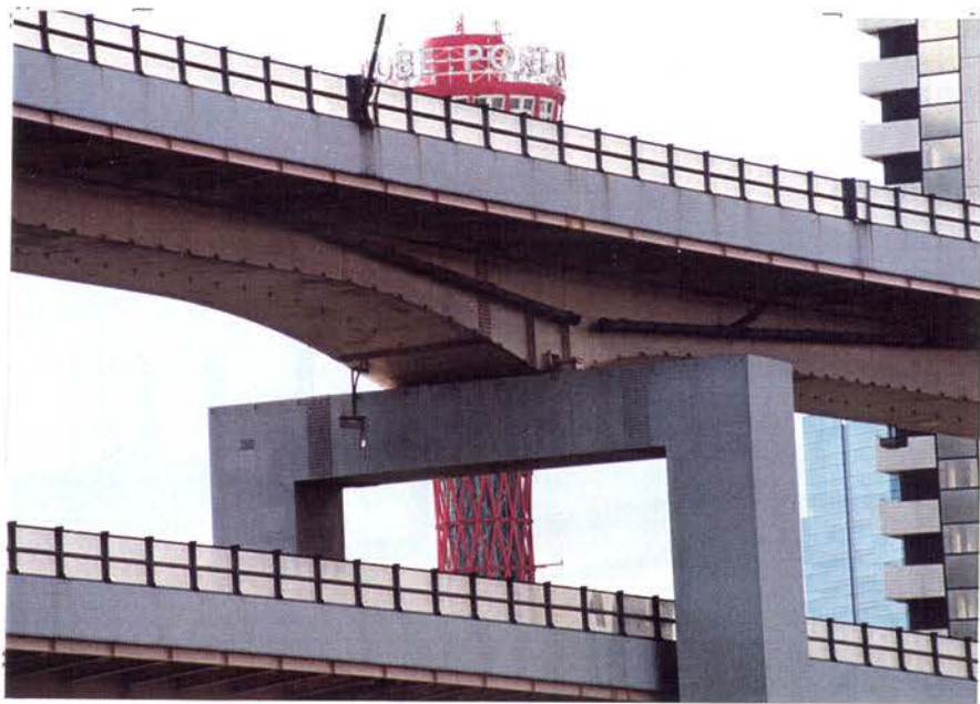
1. 7 a : P 3 7 (山側から) 上層桁が海側へ移動し、山側沓 が脱落。 また照明柱が大きく山側に倒れ ている。
