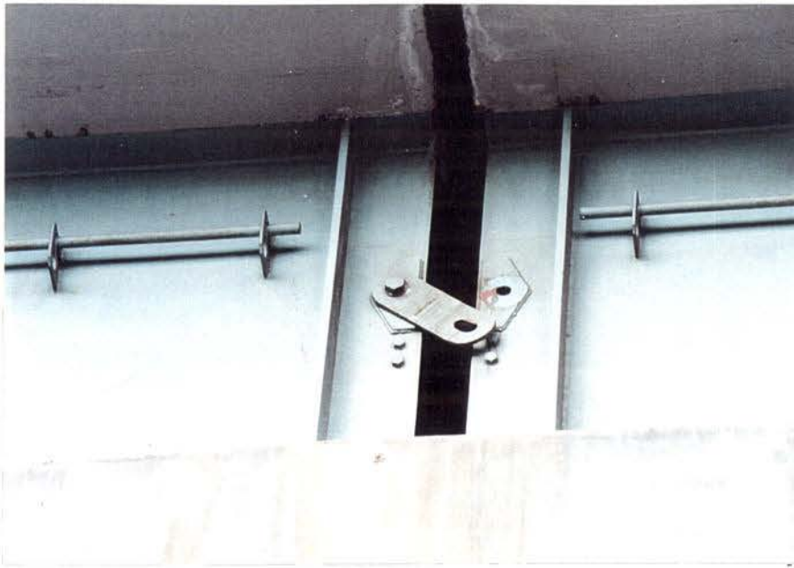
2-5.7:神167 深江ランプ手前。連結のボルト が脱落。
