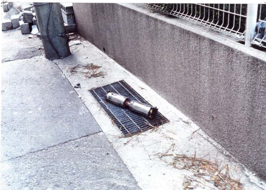
2-5.13: 支承のローラ 脱落し歩道上に転がっていた。
