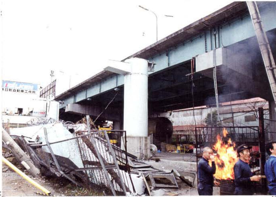
2-4.19a:神332 路側帯として拡幅していた桁が 左下に転落。
