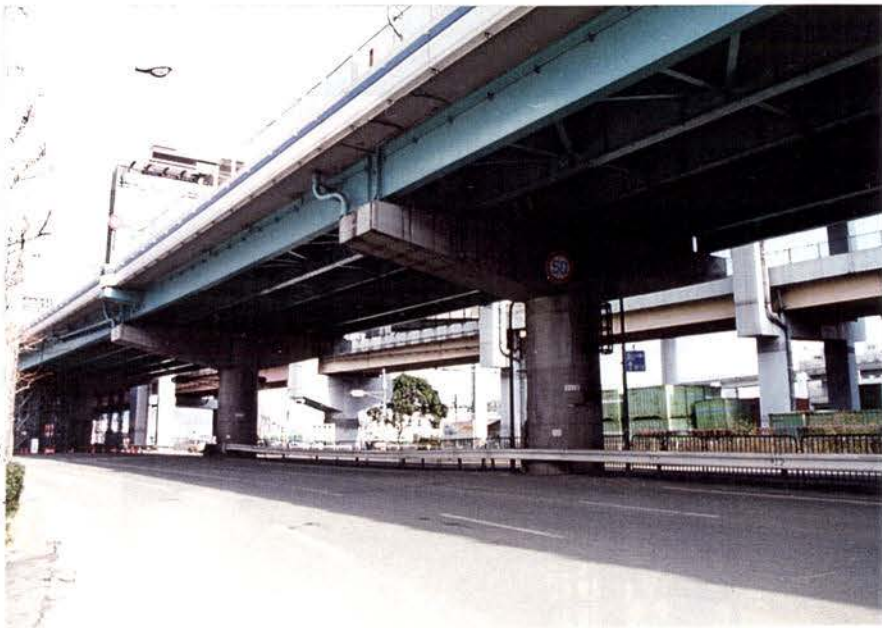
2-4. 2 : 神418 殆ど損傷無し。
