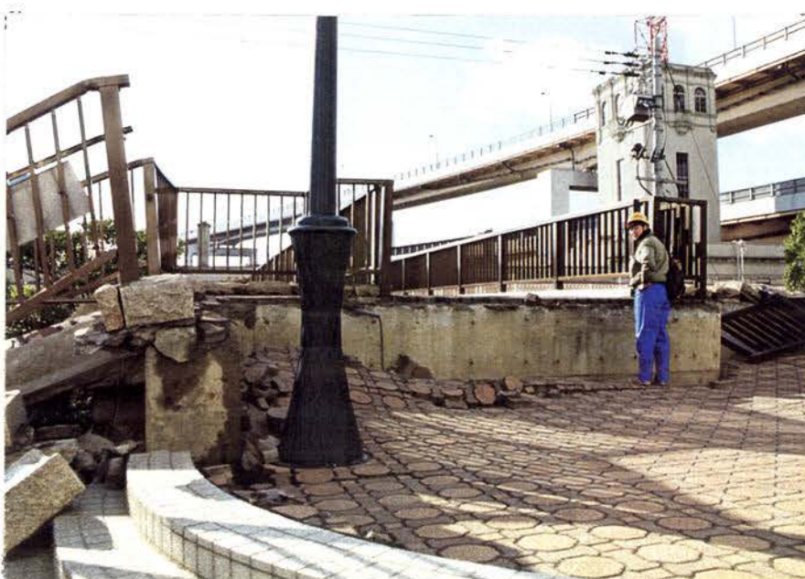
5. 25 : メリケンパーク近くの 歩道橋 取り付け部の盛り土が約1m沈 下。
