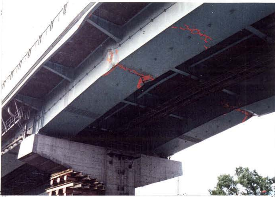
2-4.25m:座屈箇所③ 下フランジで座屈。
