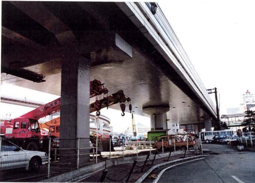
2-3.5:隣接のスラブ桁と ピルツ柱 殆ど問題ないようであるが、右 奥のバスの後ろの角柱に損傷あり (次の写真)。
