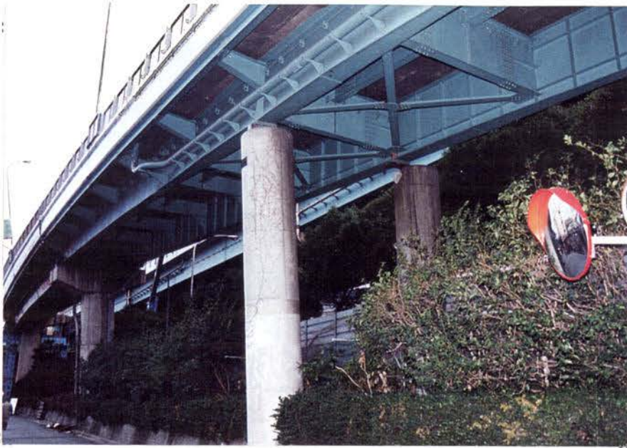
2-4.27a:魚崎入3 オンランプ桁全体が左(山側) に移動し、右側ロウソク柱の脊 が脱落。
