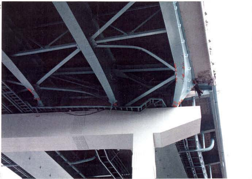
2-4.13b: 同上 I桁は面外座屈。下横構も大きく変形。
