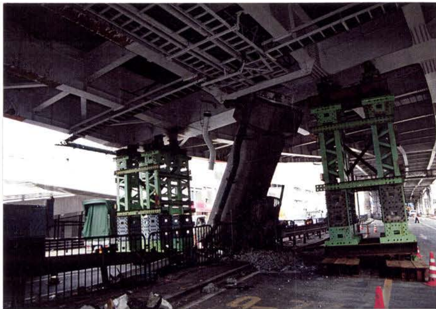
2-1.3a: 神477 (山側) 強力な鉛直力で斜めせん断破壊したRC脚。
