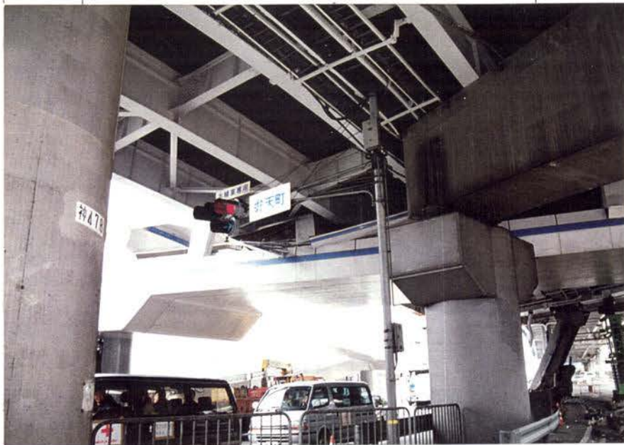
2-1. 1 a : 弁天町交差点付近 歩道橋を押しつぶした、鋼I桁。
