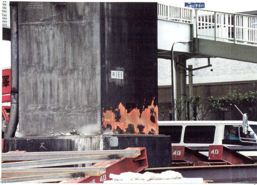
2-5.9: 神169 鋼製脚基部の曲げ座屈。
