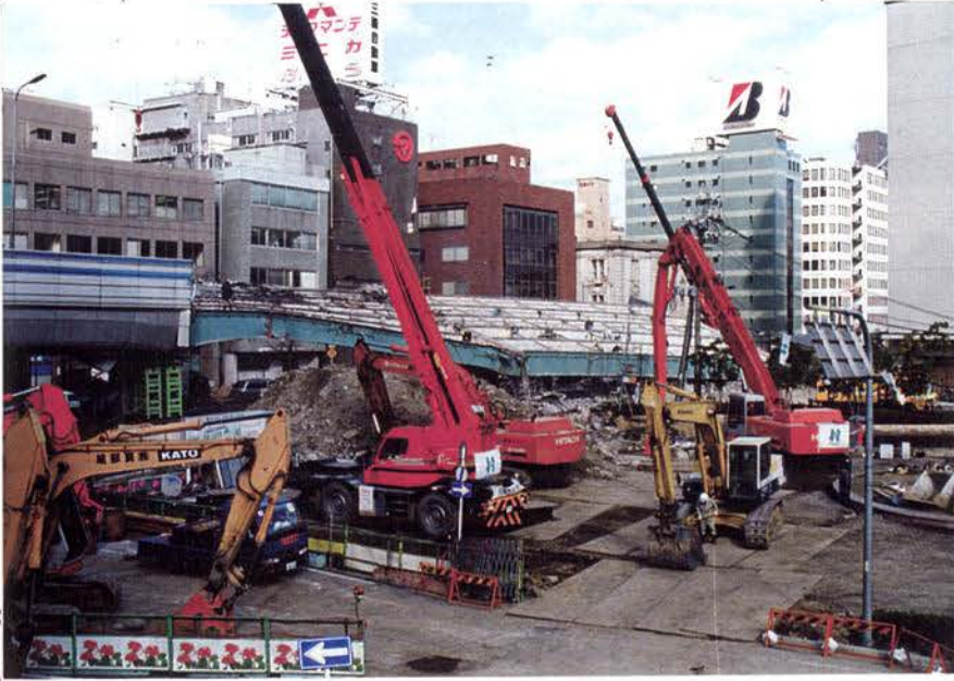
2-2.1: 海岸通り3丁目付近 RC脚の崩壊にともない、鋼桁 が崩落。床版の撤去作業が進む。
