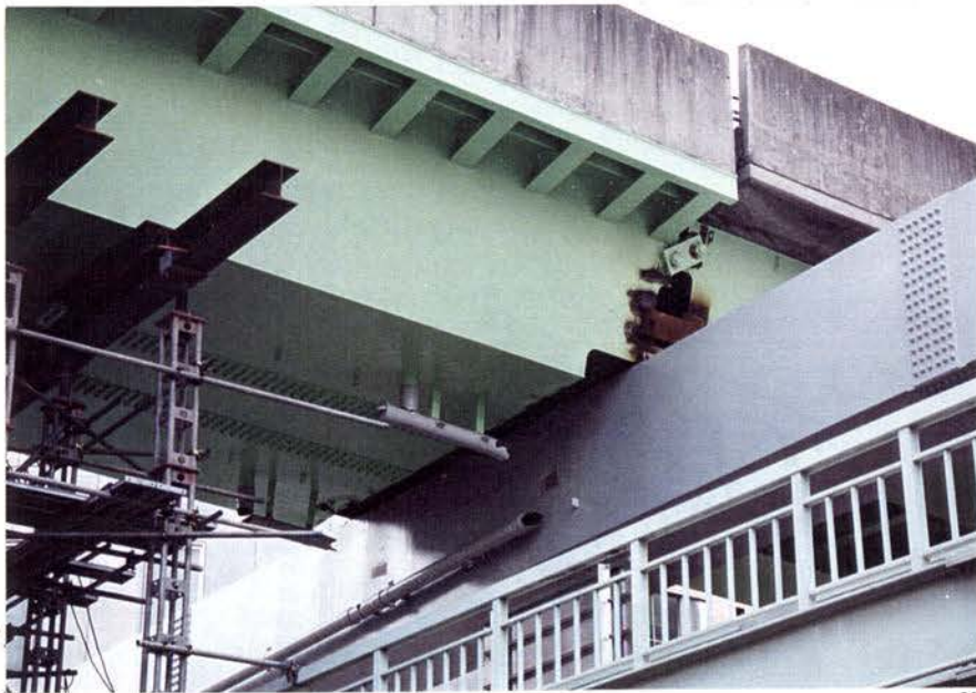
3.2: ポートライナー鋼箱桁 同上 応急的に桁を連結している。
