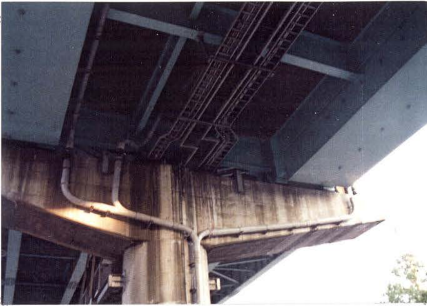
2-4.25g: 神238 軽微な損傷。
