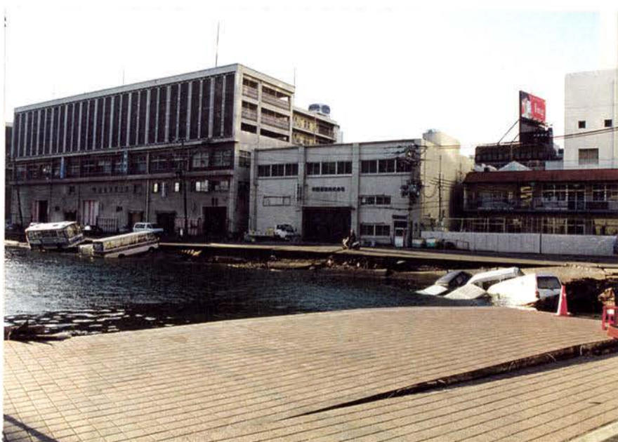
5. 24 : 崩壊した岸壁 フェリー乗場近くの岸壁が崩壊 し、バスや乗用車が海中に転落。 海底にも数台あった。
