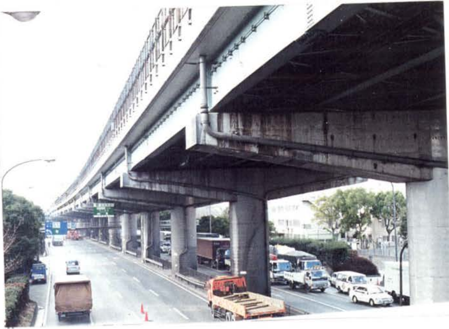
2-5.4: 東灘第4工区(当社) 商船大学前付近から神戸方面。 目立った損傷は見られない。
