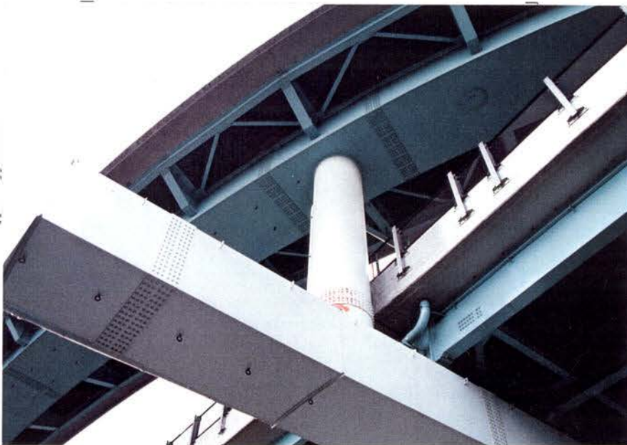
2-4.8: 生田川付近 オンランプの鋼製ラーメン脚。 円柱の基部に曲げが作用した痕 が見られる。
