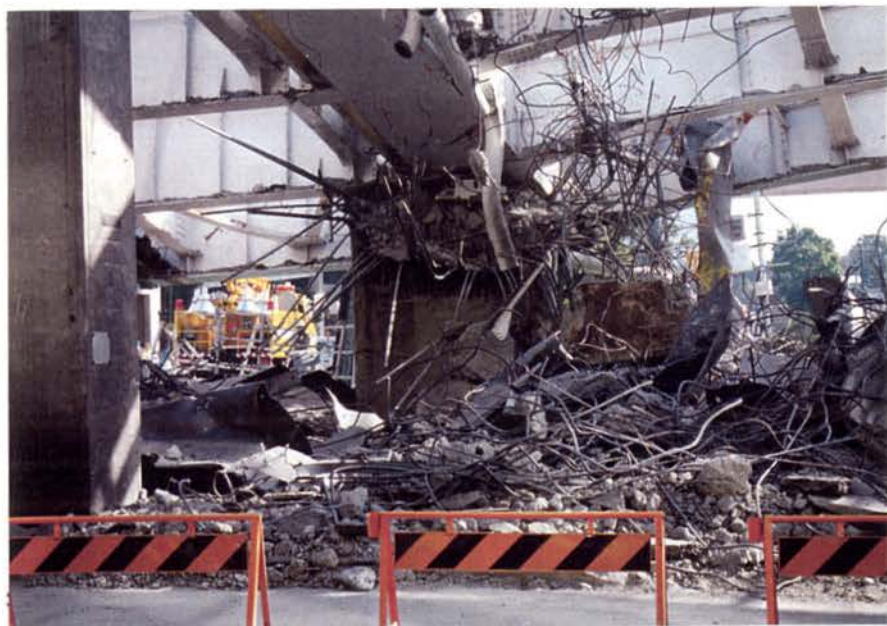
2-2.4: 神458 (海側) 爆破されたような破壊状況。
