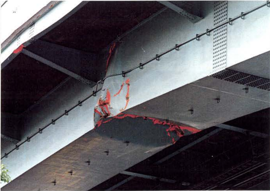
2-4.25n:同上 ほぼ面内の曲げのみにより局部 座屈。山側桁。
