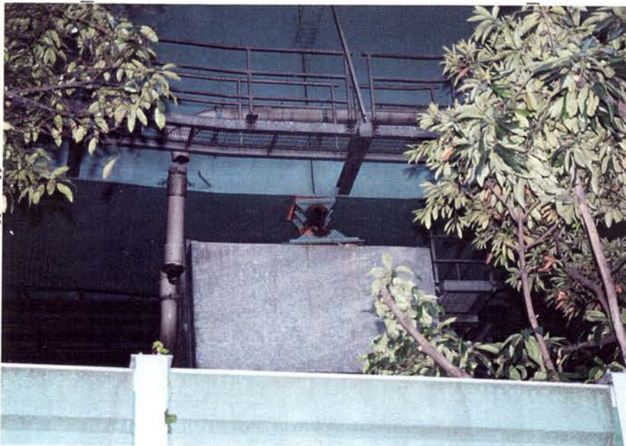
2-4.26 : 神216 桁が直角方向にずれ、脊のピン が脱落。
