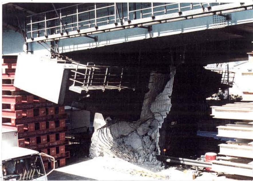
2-5.1 : 東灘工区 斜めせん断破壊した神150。 上部は鋼BOX桁。
