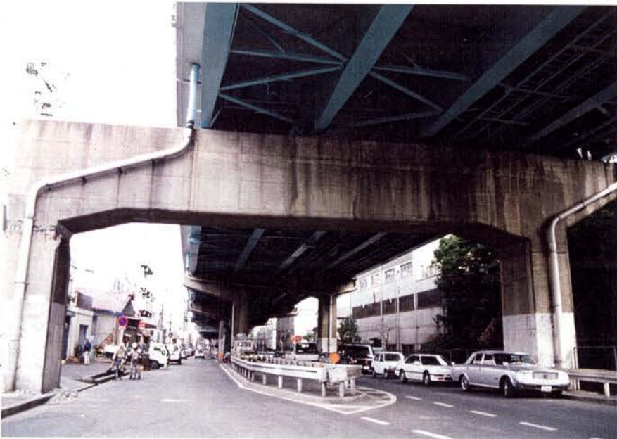
2-4.14:神364 中央区脇浜3丁目付近。RCラ ーメン脚水平梁のハンチ根元に 損傷。
