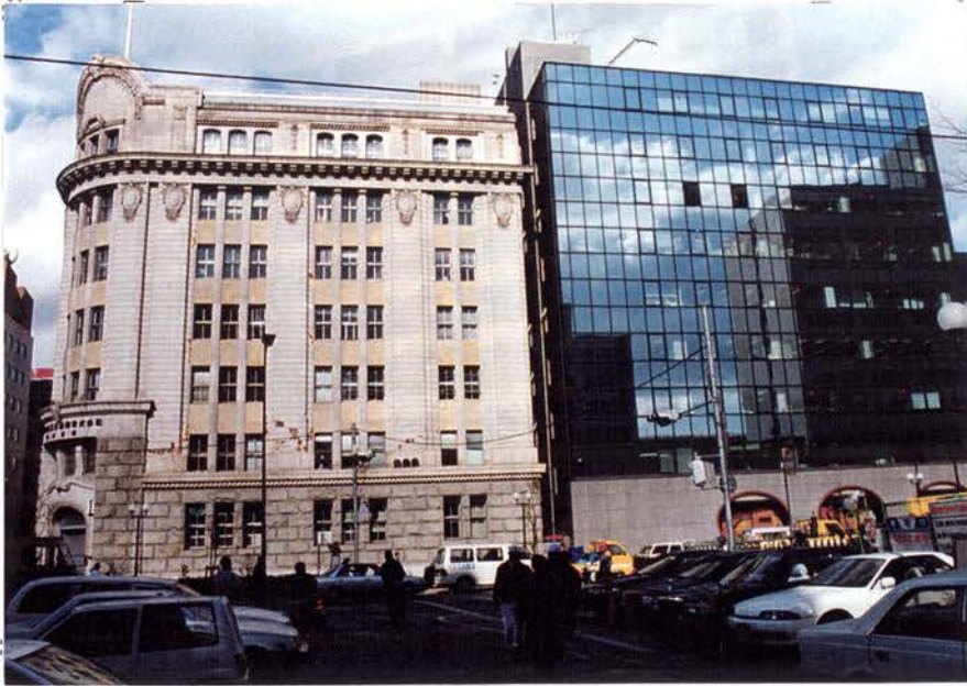
5.12: 三井商船ビル 古い石造ビルの2階部分に水平 にクラック。 隣のビルは殆ど無傷。
