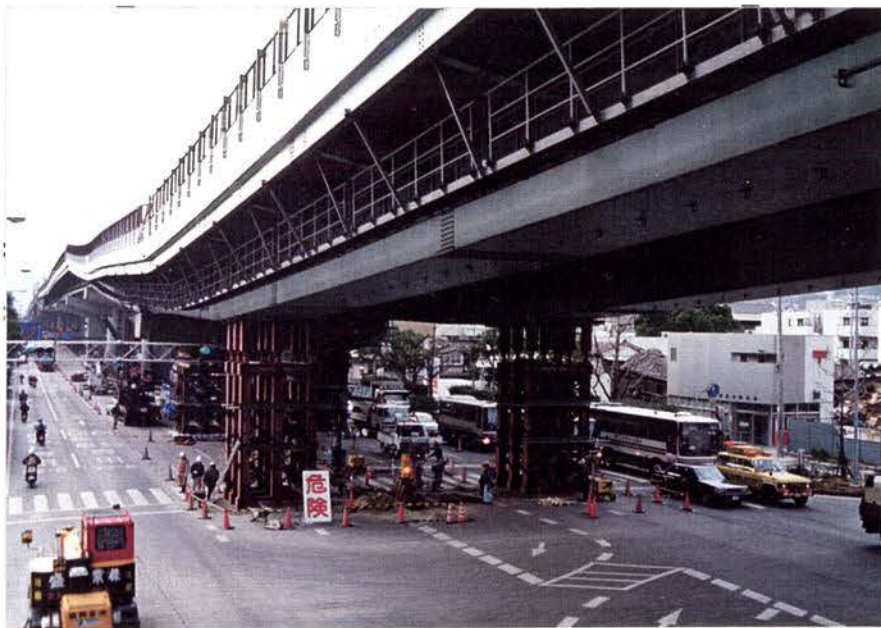
2-4. 25 b : 神239付近 大阪側から神戸方面を見る。 中央径間のほぼ中央で上フラン ジが座屈。
