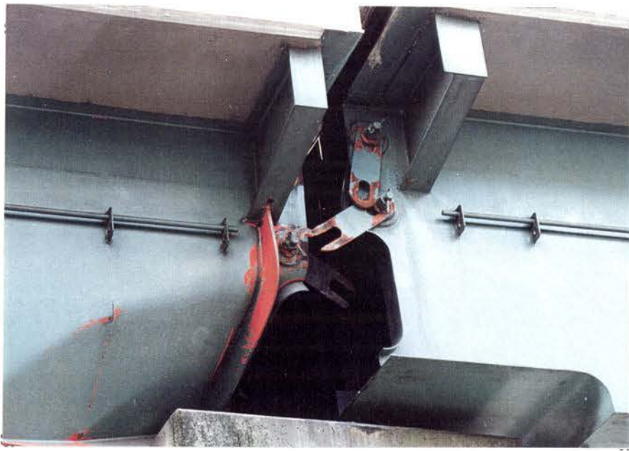
2-5.12a: 落橋防止の破損 連結板の破損とピンの脱落。
