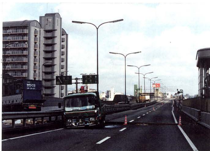
2-5.11:深江ランプ上 沓の脱落などのために、路面が 大きく波打っている。
