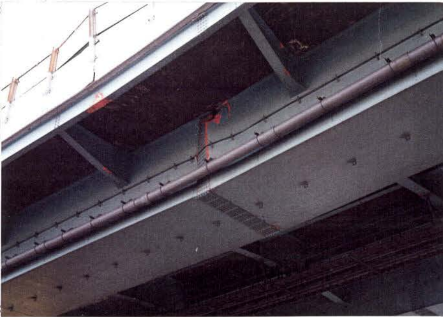
2-4.25h: 座屈箇所① 上フランジで座屈。ブラケット が軸方向に曲がり、床版がずれ ている。山側桁。
