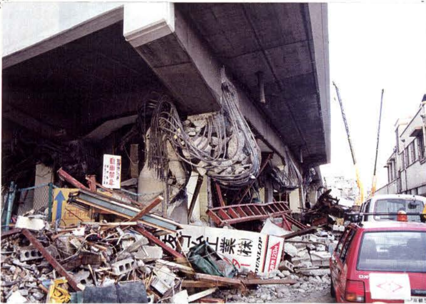
3. 8 b : 同上 強力な鉛直力により、斜めせん断破壊したRC柱。
