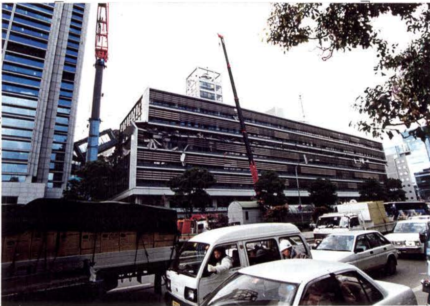
5. 1 1 b : 旧神戸市庁舎 6階(?)部分が崩落。
