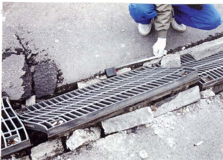
5. 23 : 側溝のグレーチング 水平方向に地面が移動し約20 cmせん断変形している。 ハーバーランドで。
