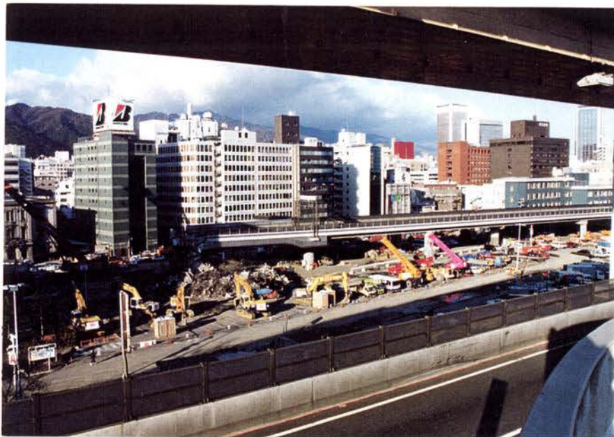
2-3.9: 海岸通り～京橋方面 左手の鋼桁部分が崩落し、右手のコンクリート部分はほぼ無傷で残った。中央から右手に向かって残った桁が、写真 2-3.7 ～ 2-3.3。
