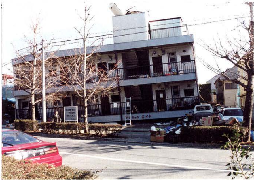
5.20：1階が崩壊した3階建てアパート
