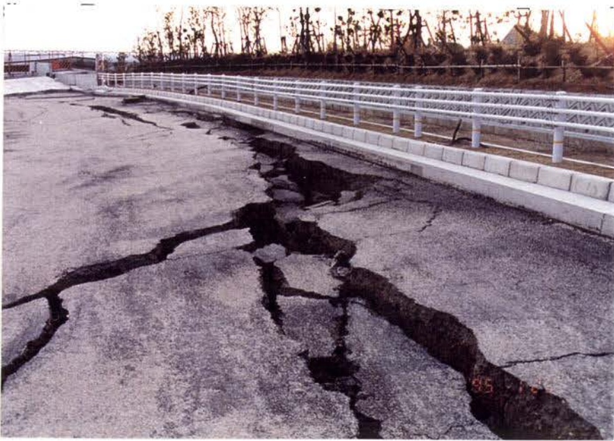
5. 26 : 芦屋浜近辺の 道路の地割れ 埋め立て地で流動化の砂が吹き 出し、4～50cmの地割れが。
