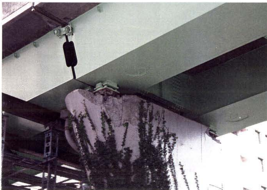
3.3: ポートライナーRC脚 沓座のコンクリート欠落。
