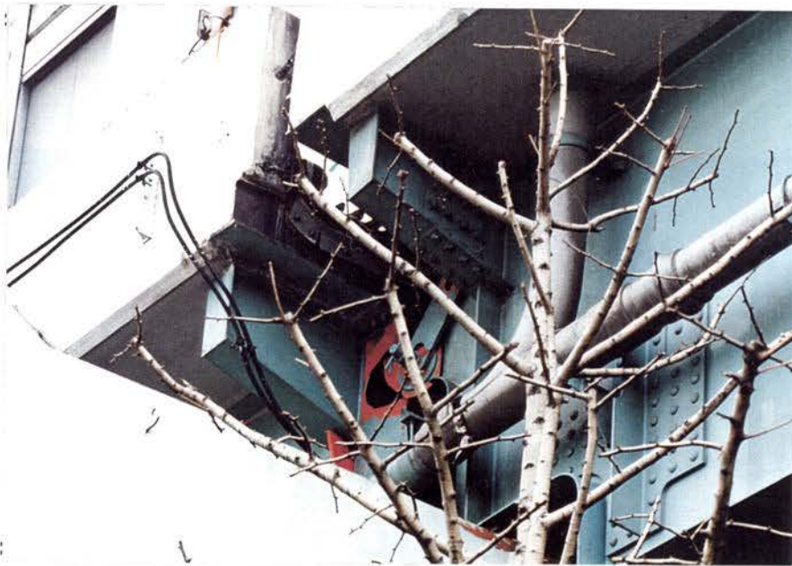
2-5.12b: 同上 腹板がちぎれている。
