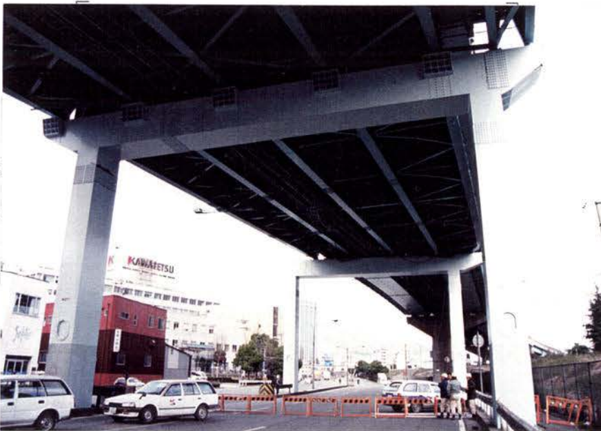
2-4.12a:神371 鋼製ラーメン脚。左上のスプ ライスに応力集中による塗装の剥 離(次の写真)。
