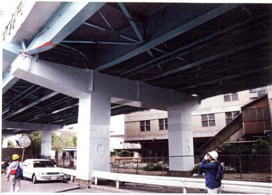
2-4.17a: 神351 鋼I桁の横倒れ。
