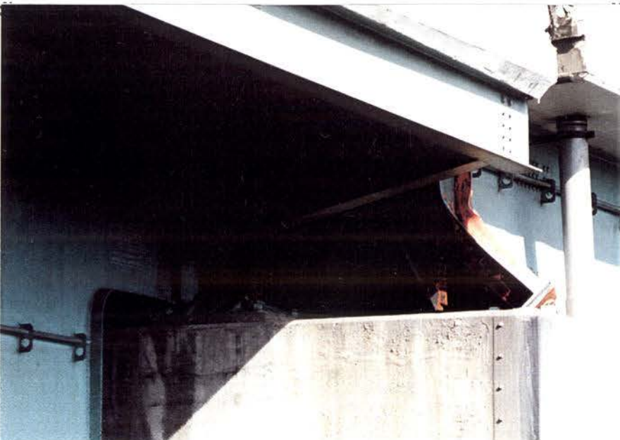
2-5.8b:同上 BOX桁(左側)は沓からはずれ、I桁(右側)は端対傾構の ボルト穴が破断。
