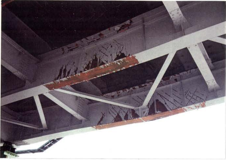
2-1.7: 同上 応力場に従って塗装が剥離し、 見事な模様が現れている。
