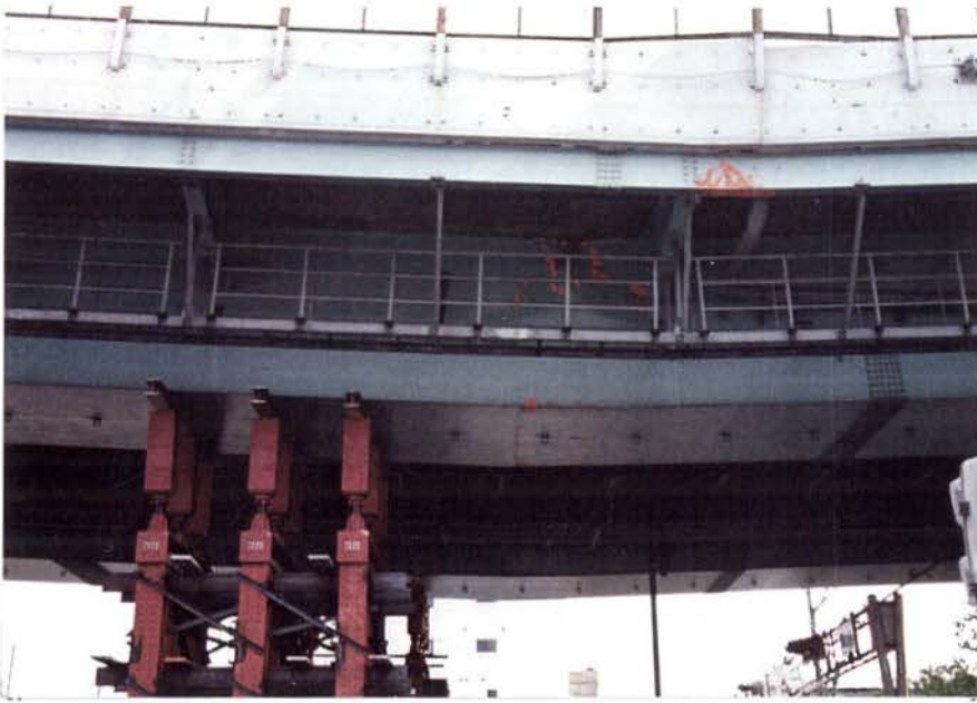
2-4.25j:座屈箇所② 上フランジで座屈。
