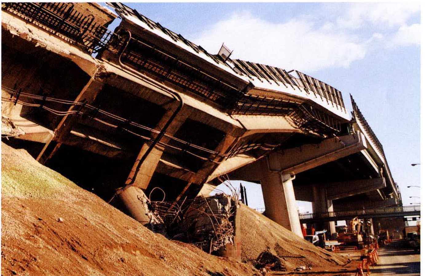
阪神高速神戸線高架橋の横転倒壊（神戸市東灘区）
