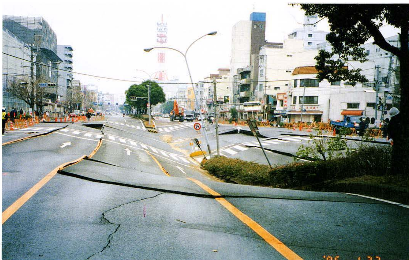
道路の陥没—地下鉄高速神戸線大開駅付近—（神戸市兵庫区）
