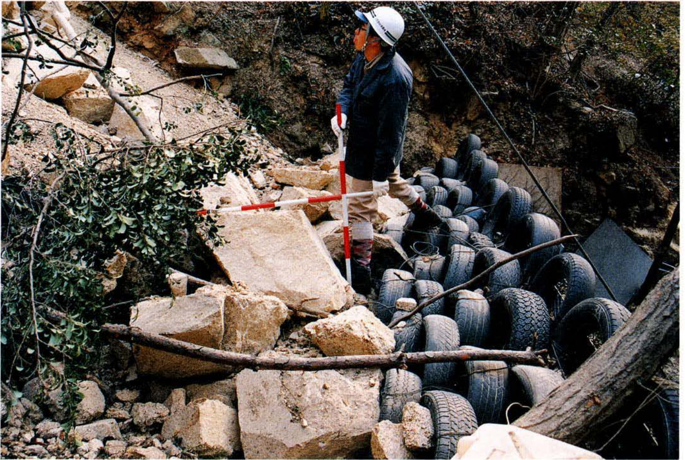
落石被害を食い止めた治山工事施行による落石防止柵（芦屋市奥山）
