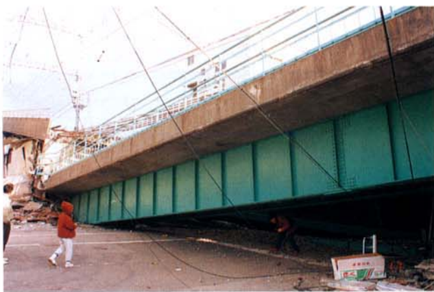
落下した阪神新在家近辺の高架橋
