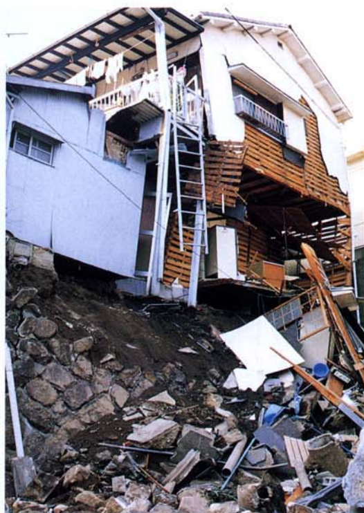
ガケくずれとともに家も崩壊した（灘区）
