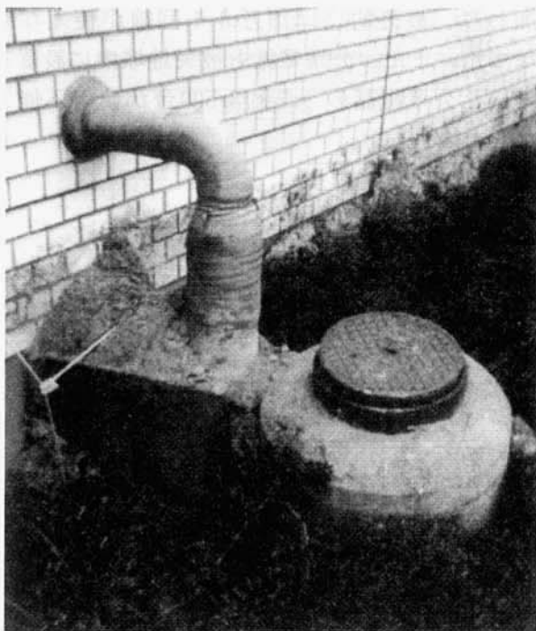
伸縮継手が地盤沈下を吸収した事例 (中央区、建物周囲が約70cm沈下)
