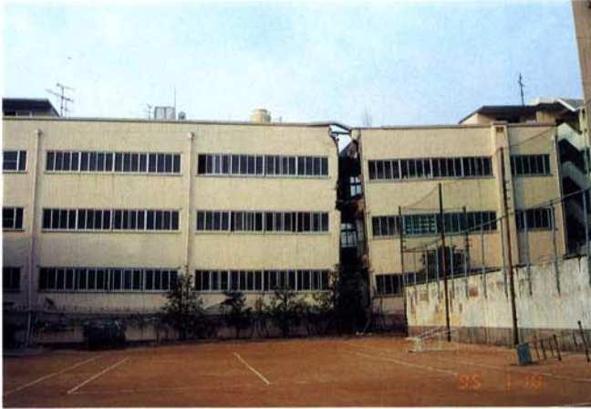
校舎の渡り廊下が崩壊した御影中学校
