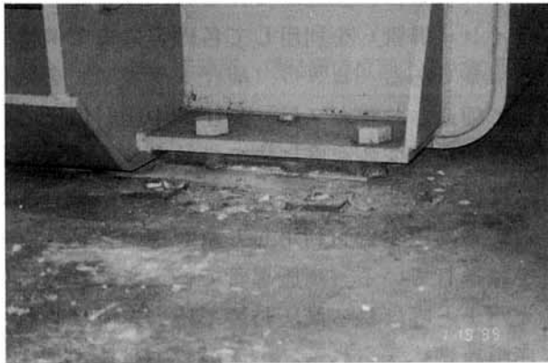
伊丹変電所 275kV変圧器 （変圧器のアンカーボルトが破断し、変圧器本体が移動）
