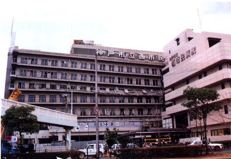
5階が押しつぶされた西市民病院（長田区）
