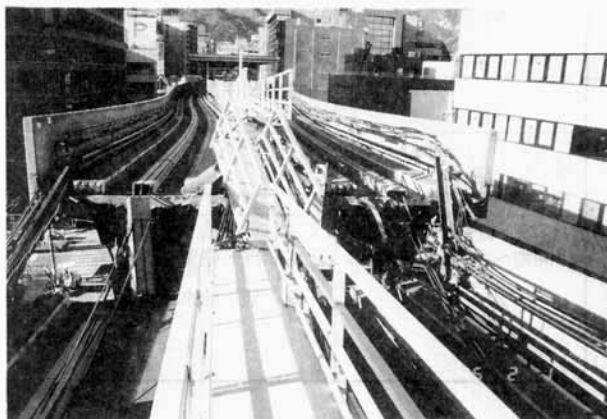
桁宙吊りによる橋面設備の被災状況 (ポートアイランド線)
