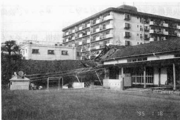
倒壊した御影幼稚園園舎
