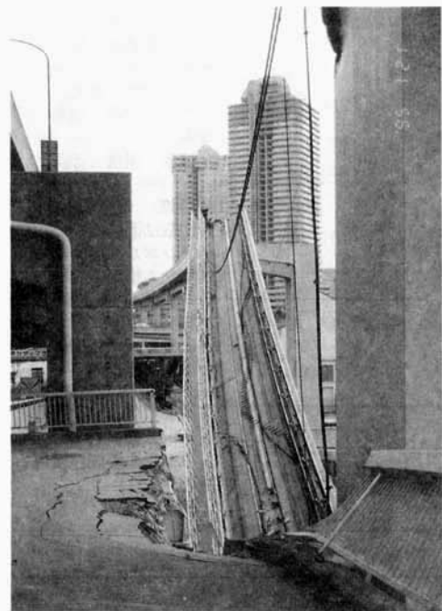
六甲大橋南取り付け部の落橋 (六甲アイランド線)
