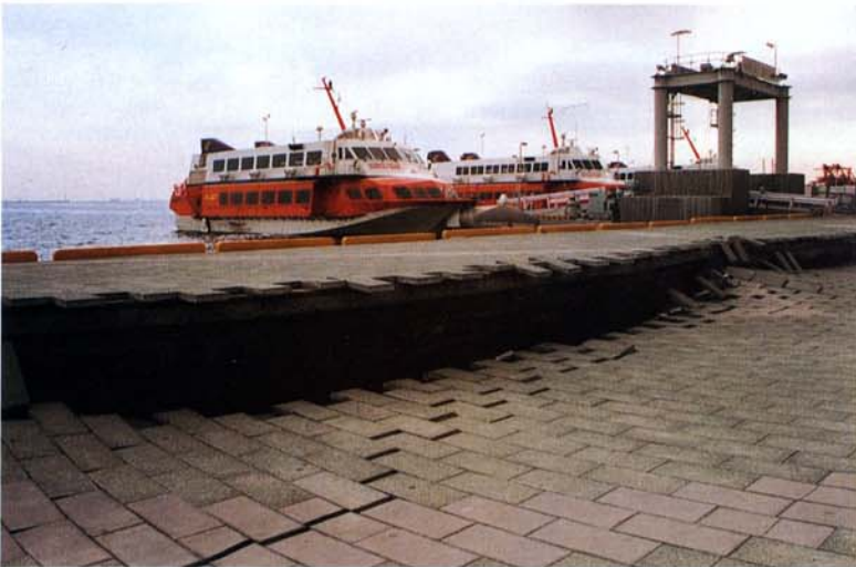
陥没したK-CATの岸壁
