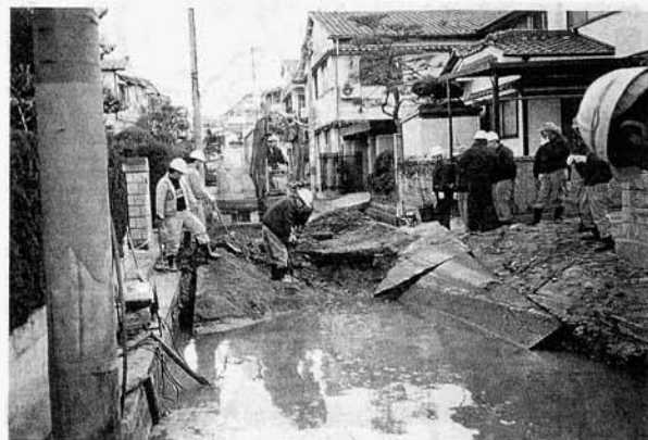
配水管の被害(管体の割れ)
