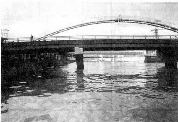
東魚崎大橋橋脚の傾斜
