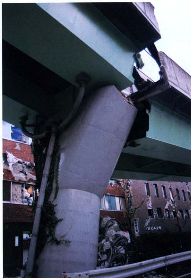
新交通ポートアイランド線の桁（けた）落下
