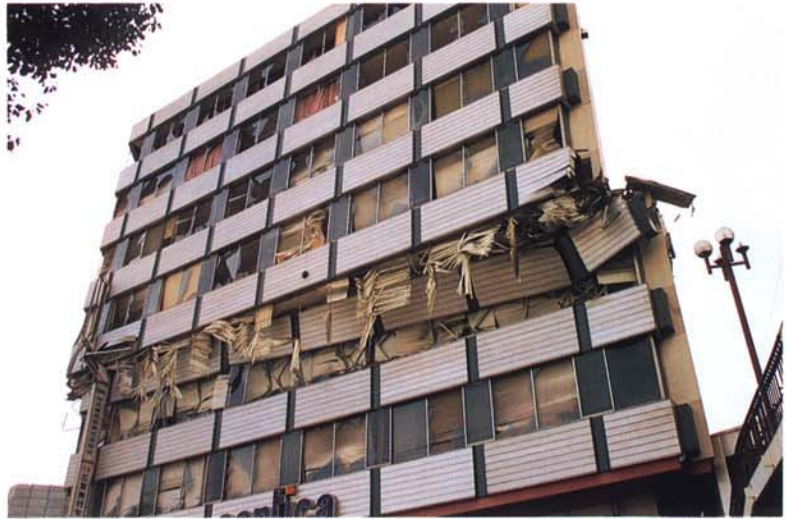
ビルが傾いた交通センタービル
