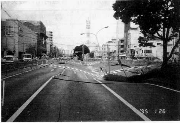
国道28号(大開通り)路面陥没現場
