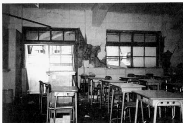
せん断破壊した飛松中学校校舎の教室内部
