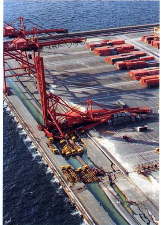
倒壊したガントリークレーン（東灘区）
