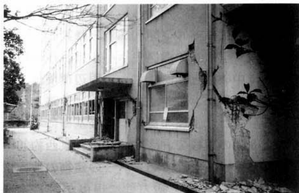
飛松中学校 (崩壊の危険性があるため内部に入らず)
