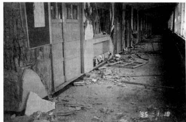
半壊・傾斜した丸山中学校校舎の廊下部分
