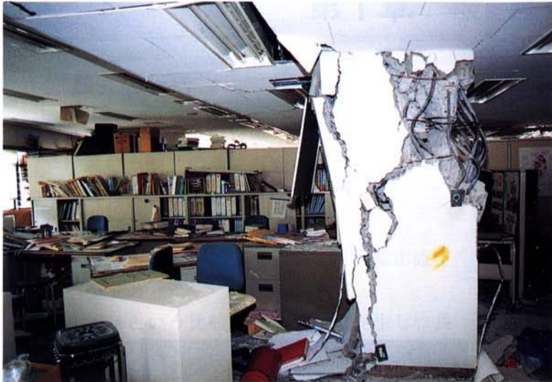
座屈した市役所内の柱
