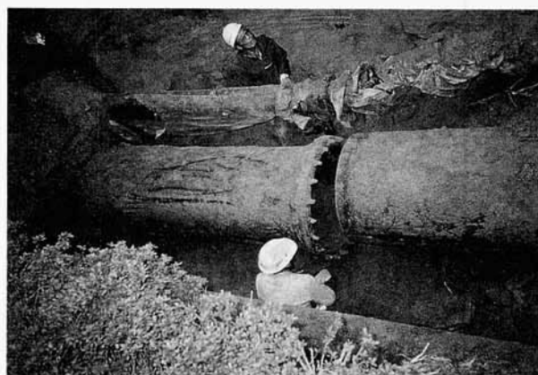
配水管の被害(継手抜け出し)
