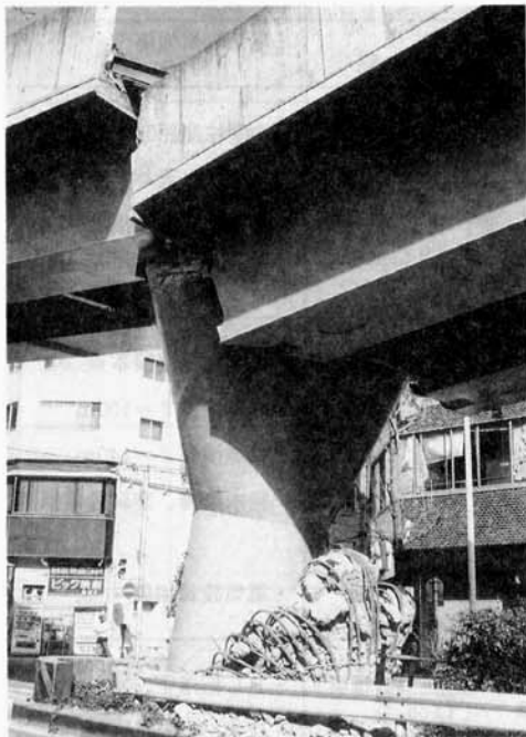
コンクリート橋脚のせん断破壊 (ポートアイランド線)
