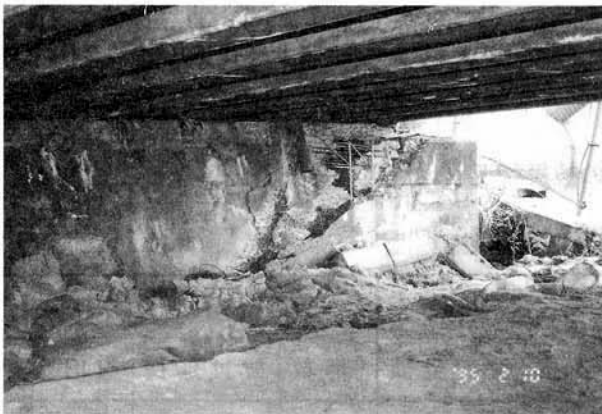
東魚崎大橋橋台損傷部分
