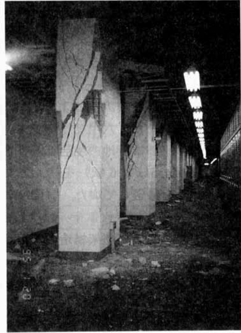
上沢駅中柱被災状況（東→西）
