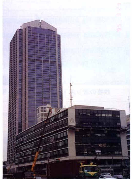
6階が押しつぶされた神戸市役所
