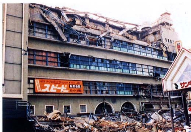
駅ビルも崩壊した阪急電車
