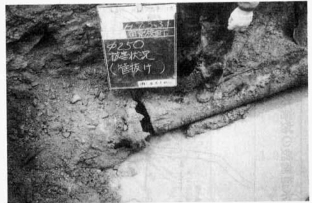
配水管の被害（抜け出し）
