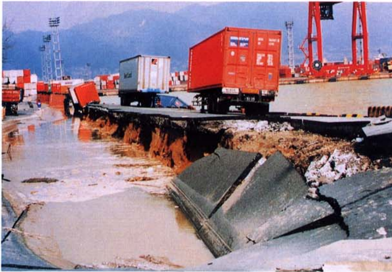
約2mもの段差のできた岸壁
