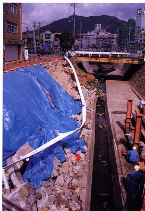
護岸が崩壊した妙法寺川（須磨区）
