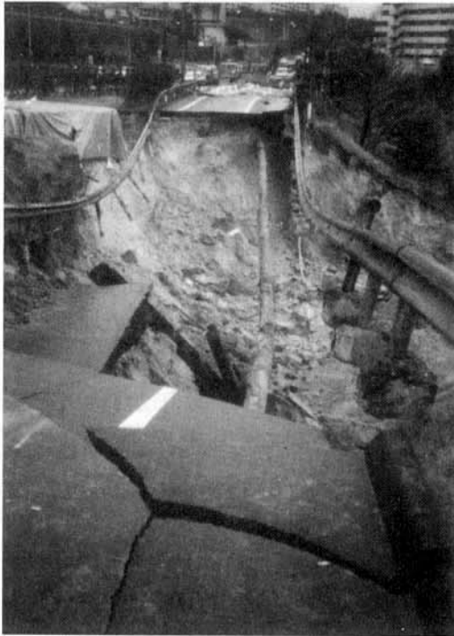
第二神明道路における中圧導管の露出事例
