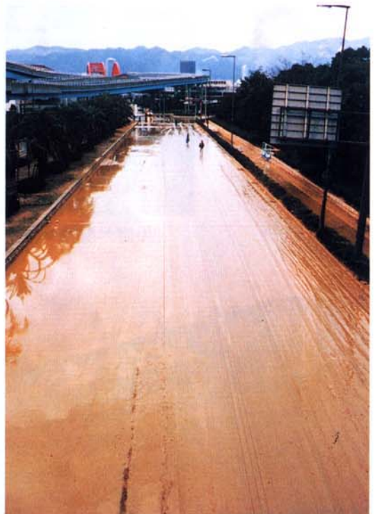
液状化のため泥の川となった道路(中央区)
