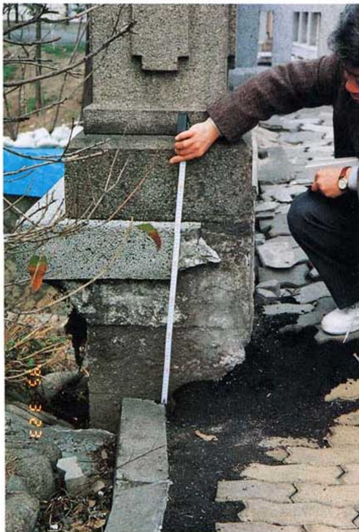
(c)橋台付近の沈下状況
