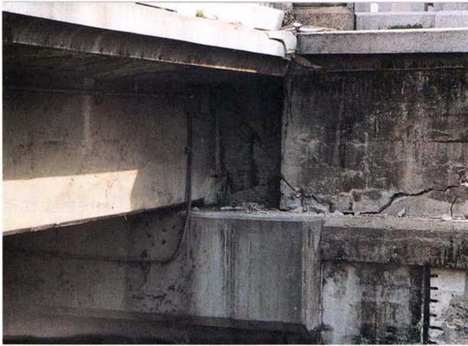
(b)橋台破損状況
