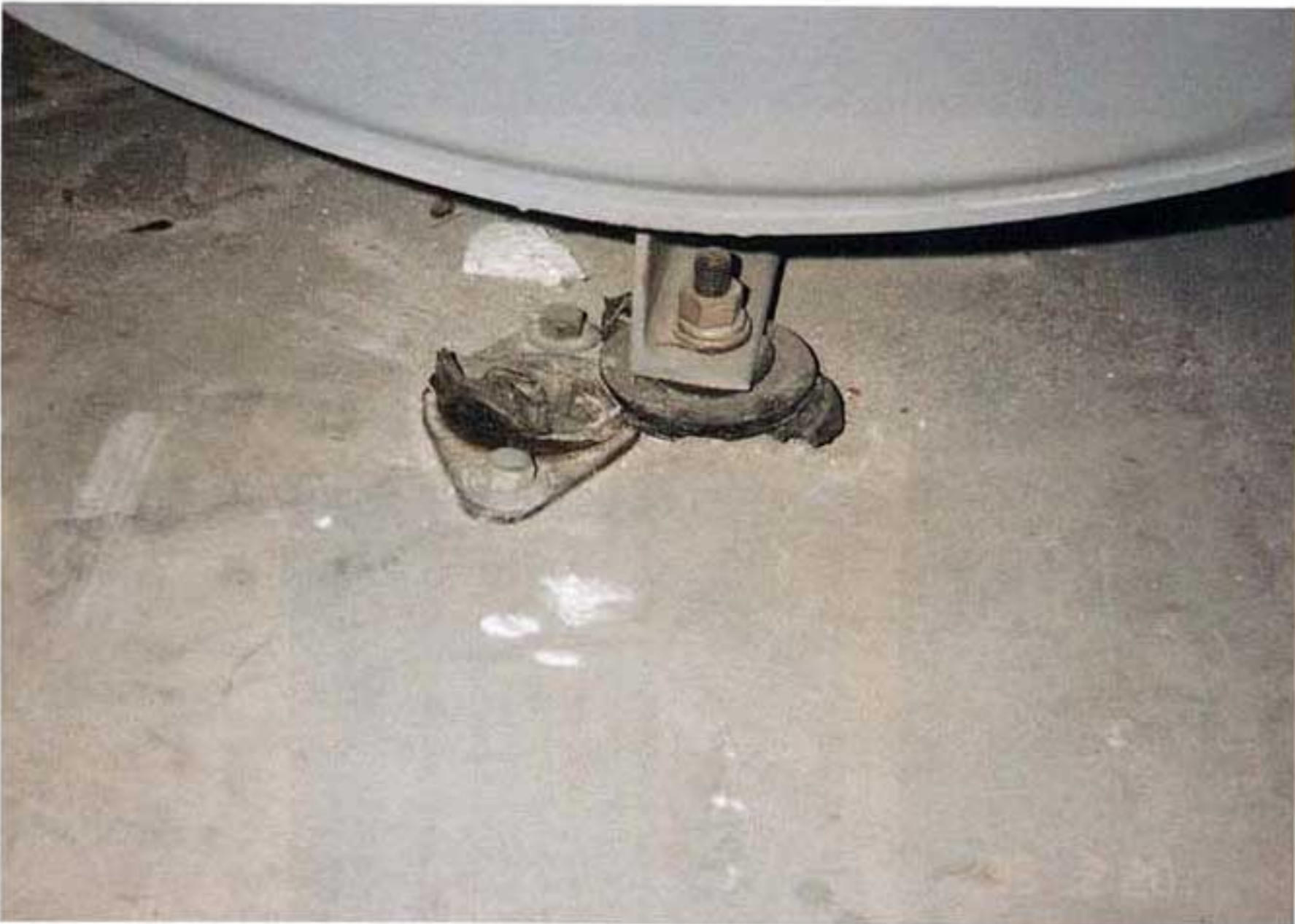
写真5.2-24 油入トランスの防振ゴム破断 による移動
