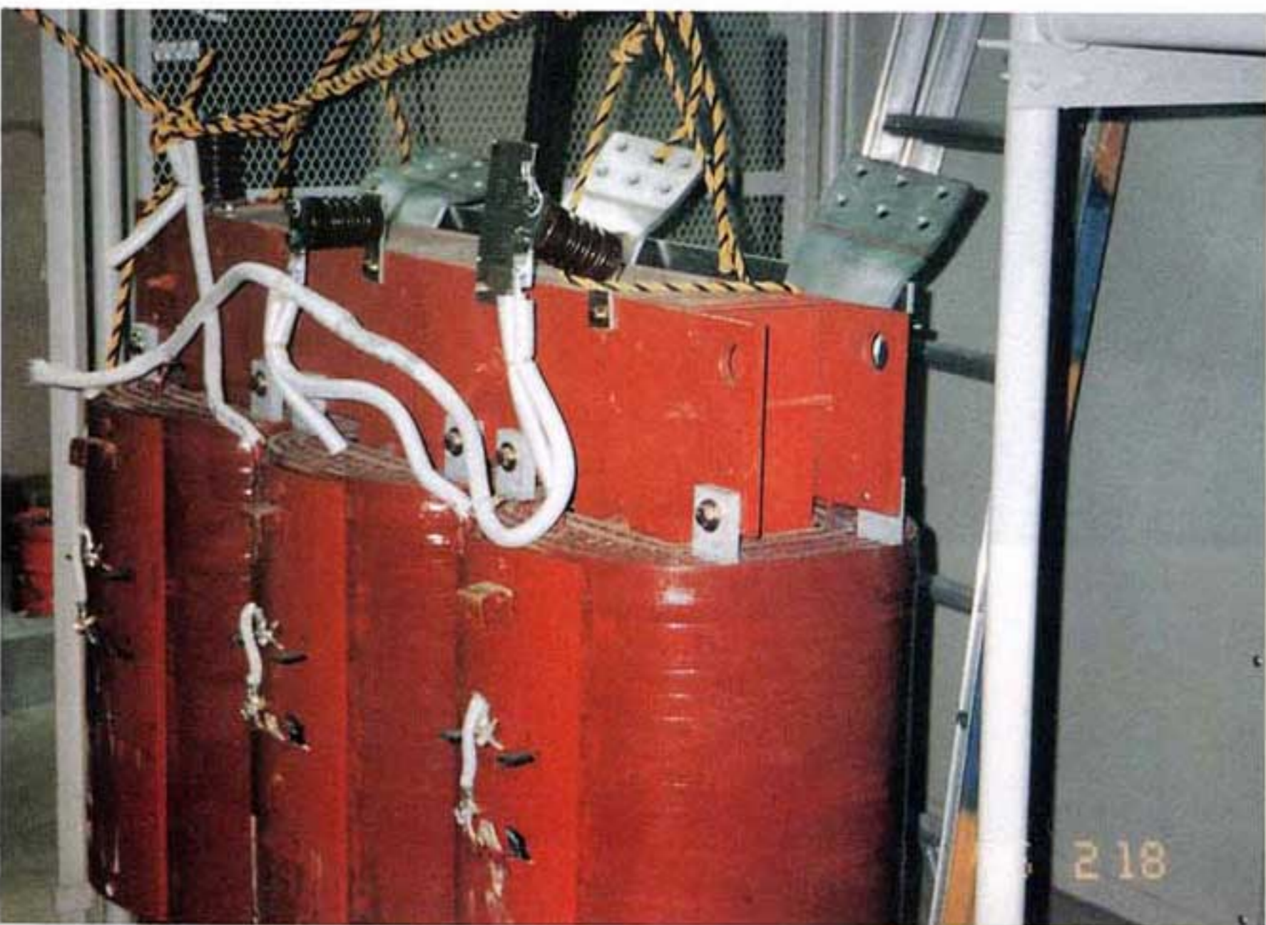
写真5.2-25 トランスの転倒による 上部高圧側の碍子および 低圧端子バー破損
