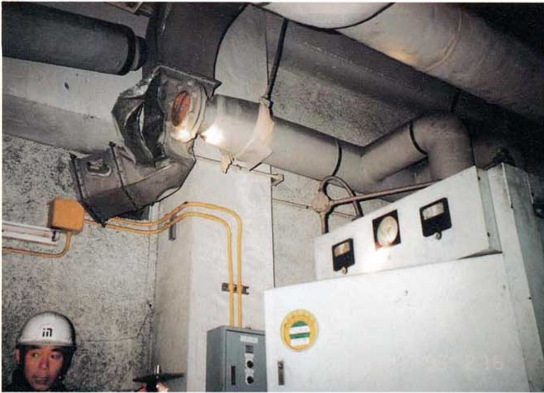
写真5.2-20 温水配管（SGP）の破断
