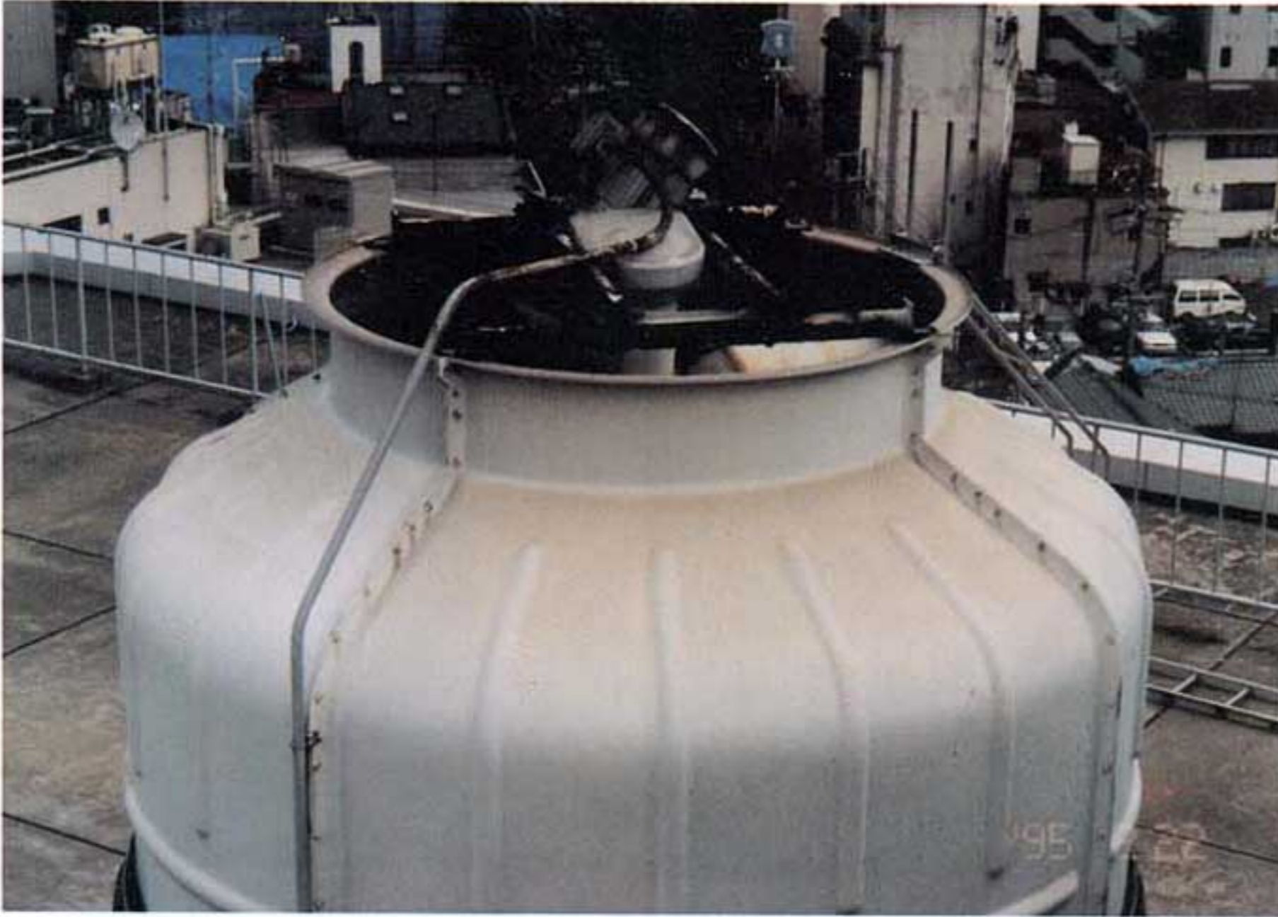
写真5.2-17 冷却塔モータ部脱落
