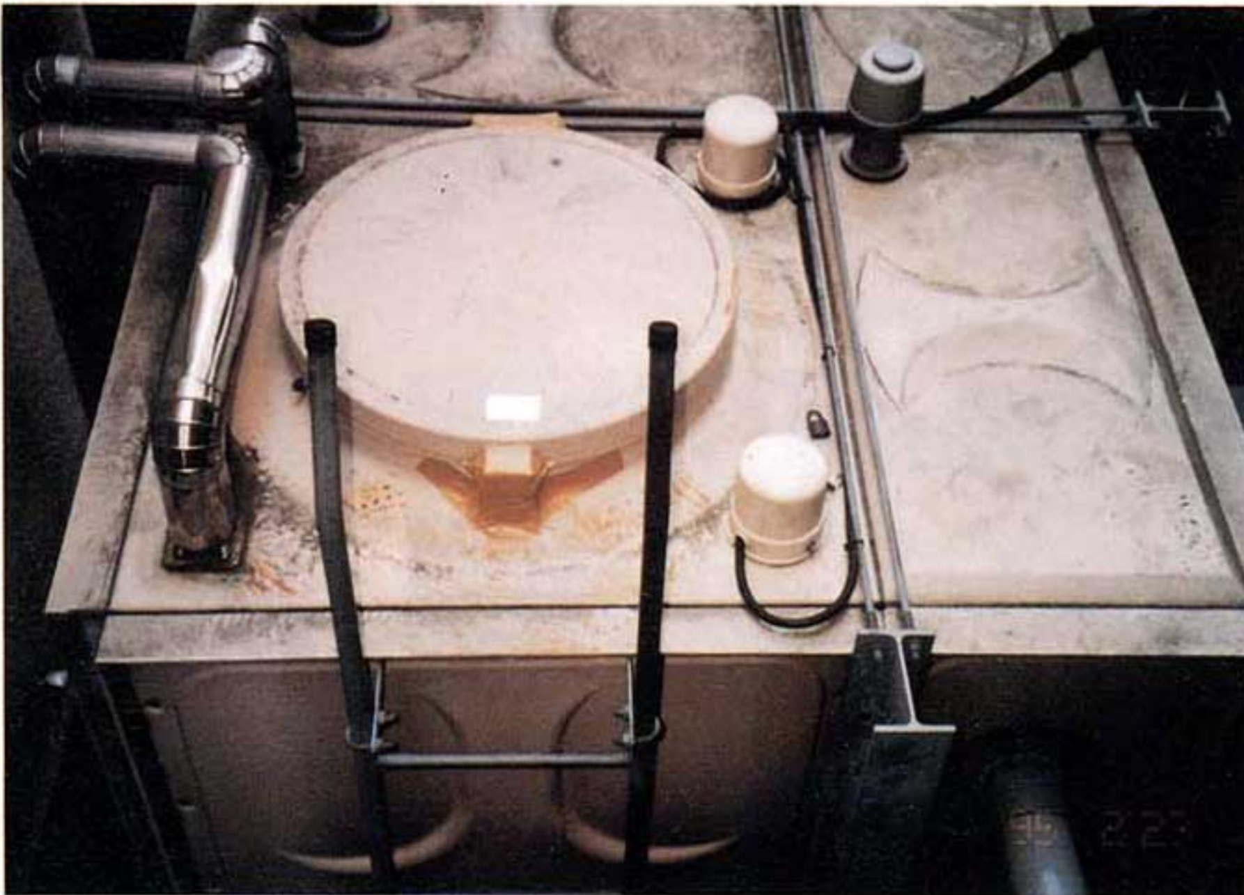
写真5.2-8 受水槽マンホールヒンジ破損
