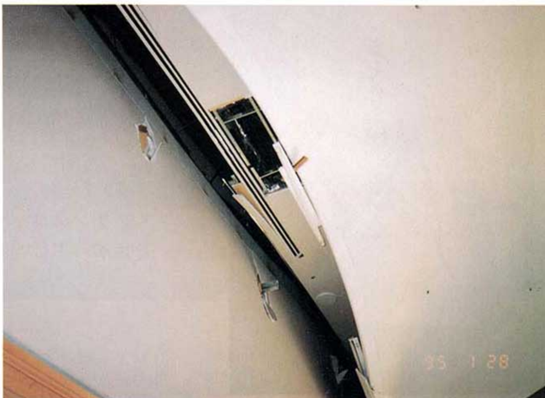
写真5.2-16 天井下がりによる制気口 の破損
