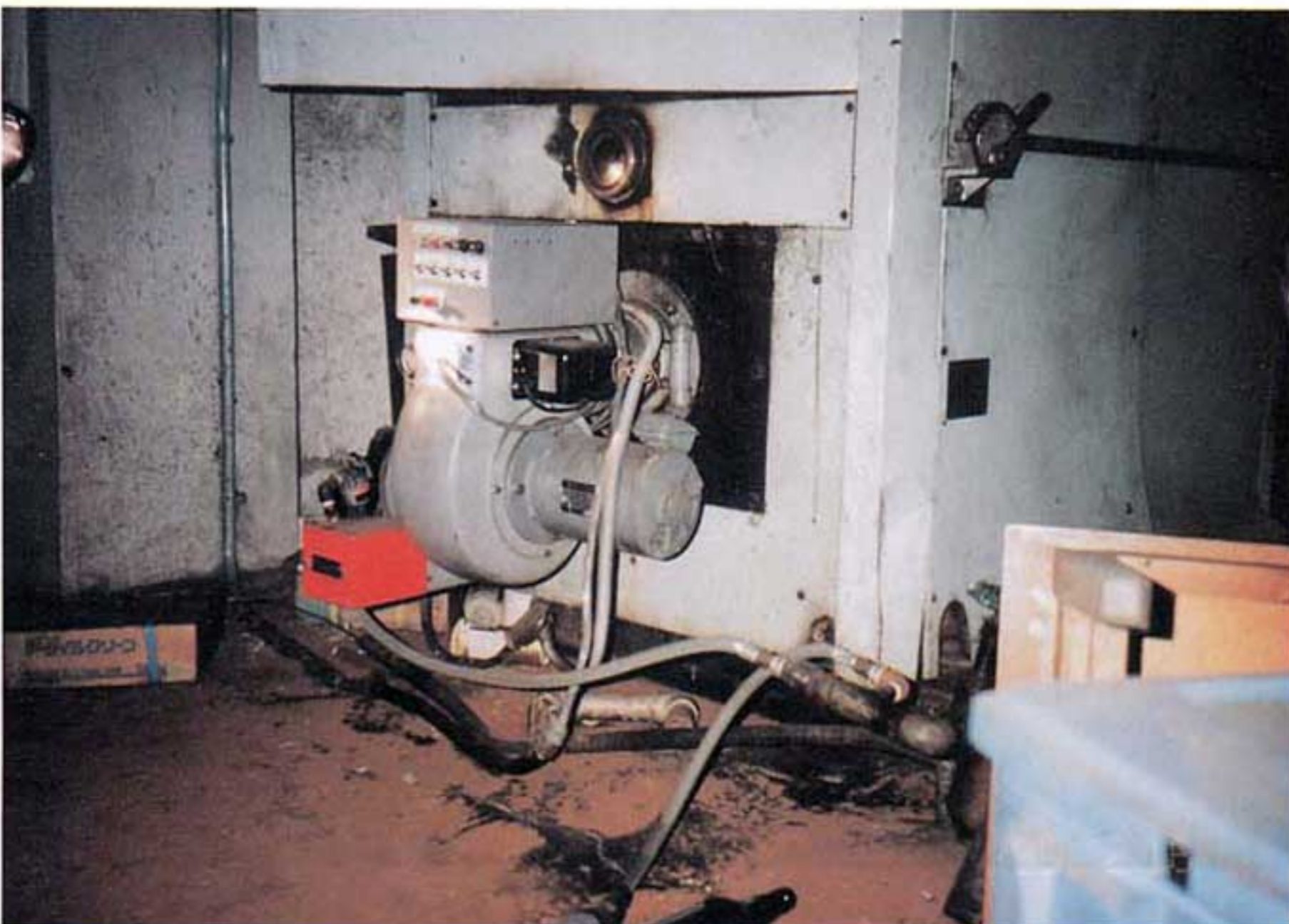
写真5.2-19 セクショナルボイラの移動 基礎モルタルの破損
