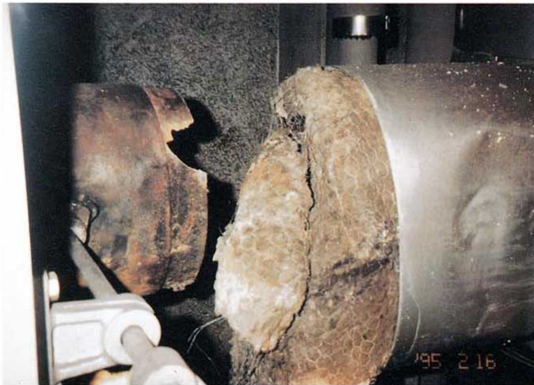
写真5.2-21 煙導継手部の破断
