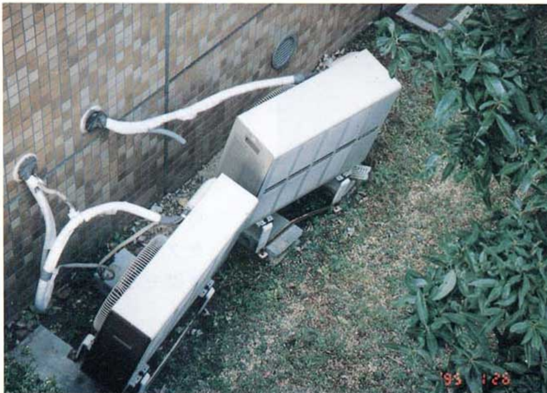
写真5.2-22 ヒートポンプ屋外機のずれ・傾き
