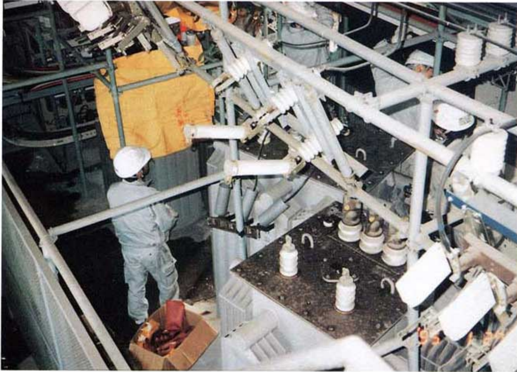
写真5.2-23 オープンの電気室でトランス移動 二次側ブスバー、碍子を破損
