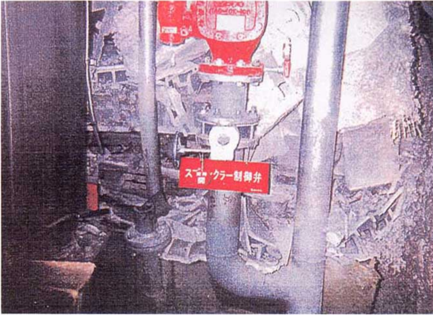
写真5.2-14 アラーム弁排水管（塩ビ管） 破損
