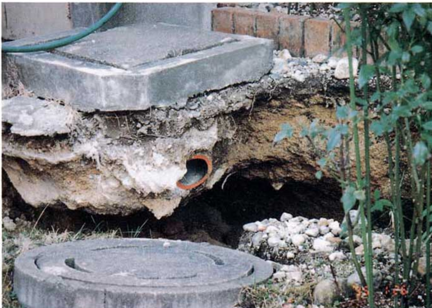
写真5.2-10 地盤沈下による排水管切断
