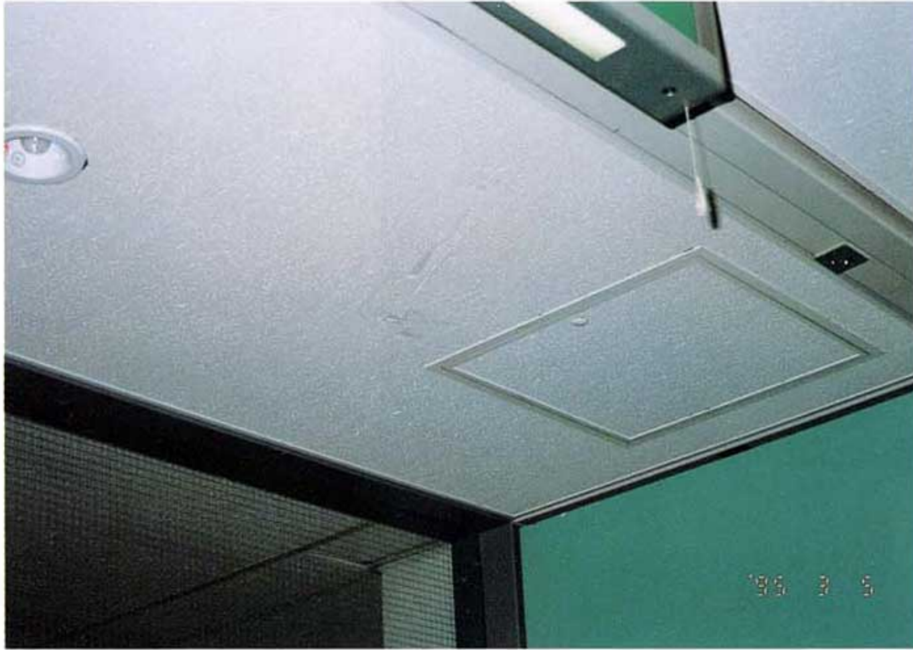
写真6.2-5 防火戸が天井にぶつ かった痕
