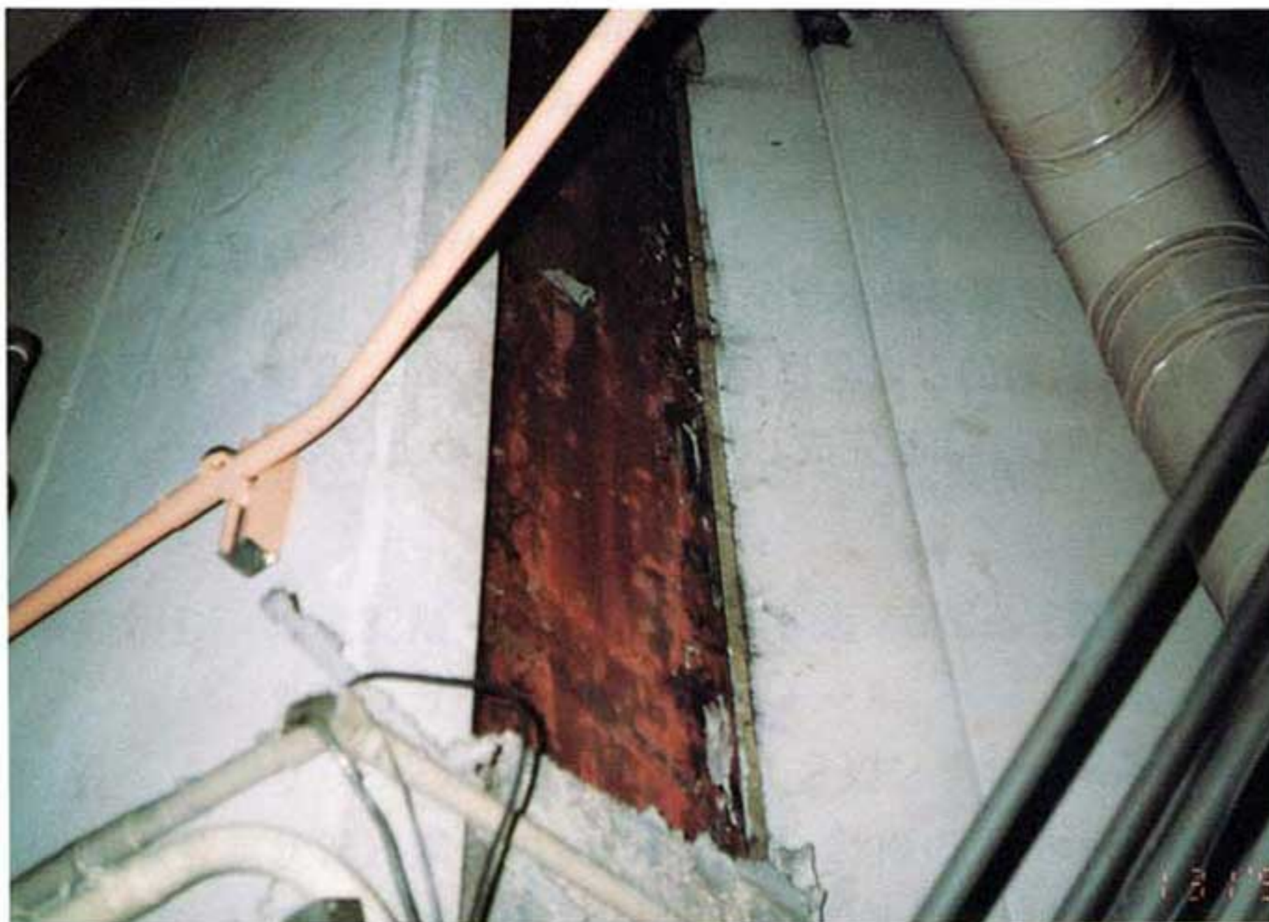
写真6.3-6 柱の成形板耐火被覆の 脱落
