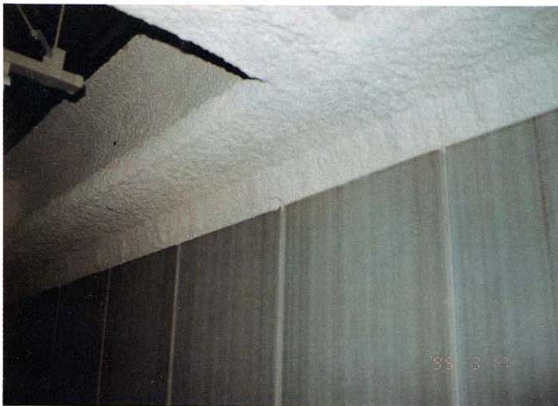
写真6.3-2 成形板との取合部の 耐火被覆材に発生し たわずかな亀裂 (西宮市, E立体駐車場)
