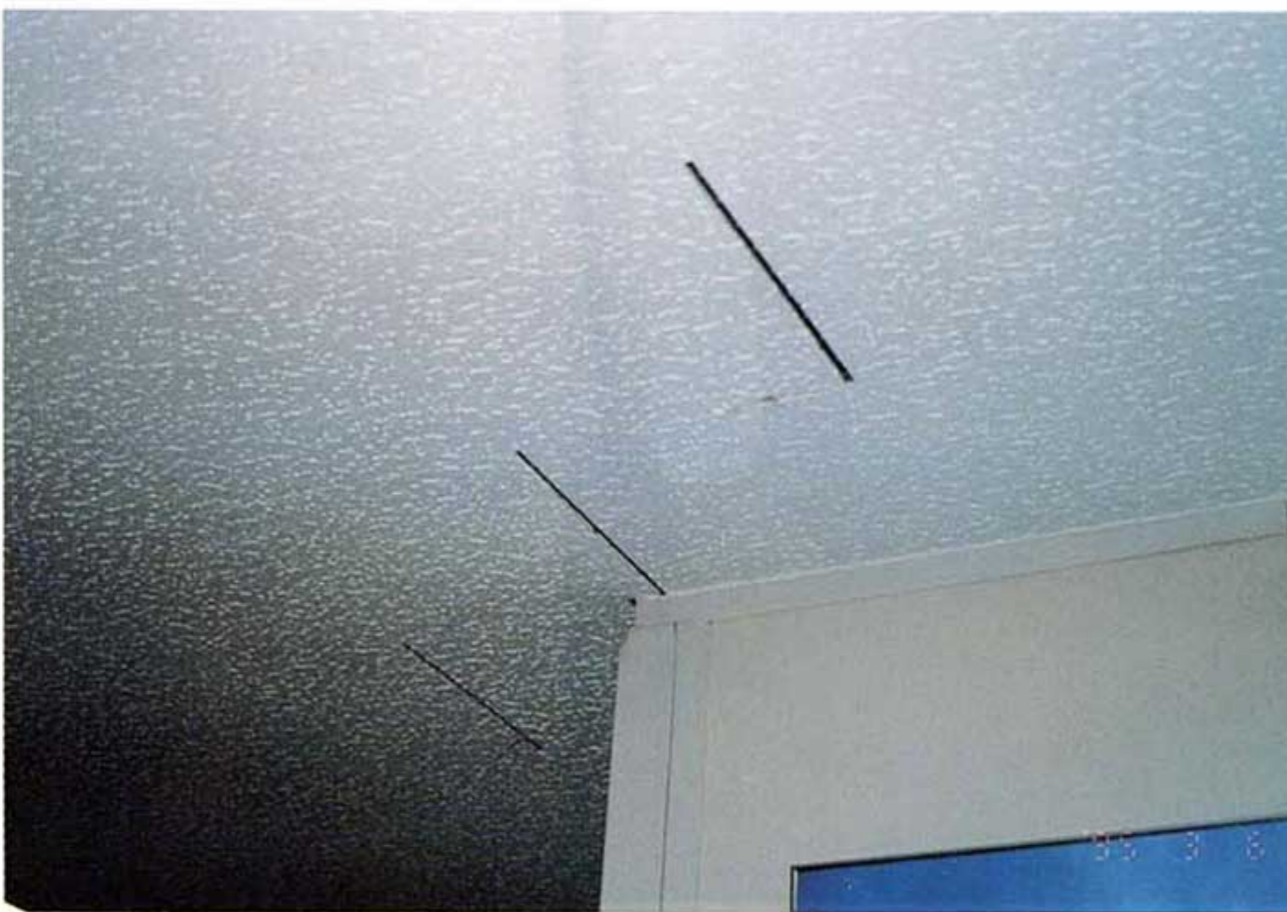
写真6.2-4 天井板の目地開き
