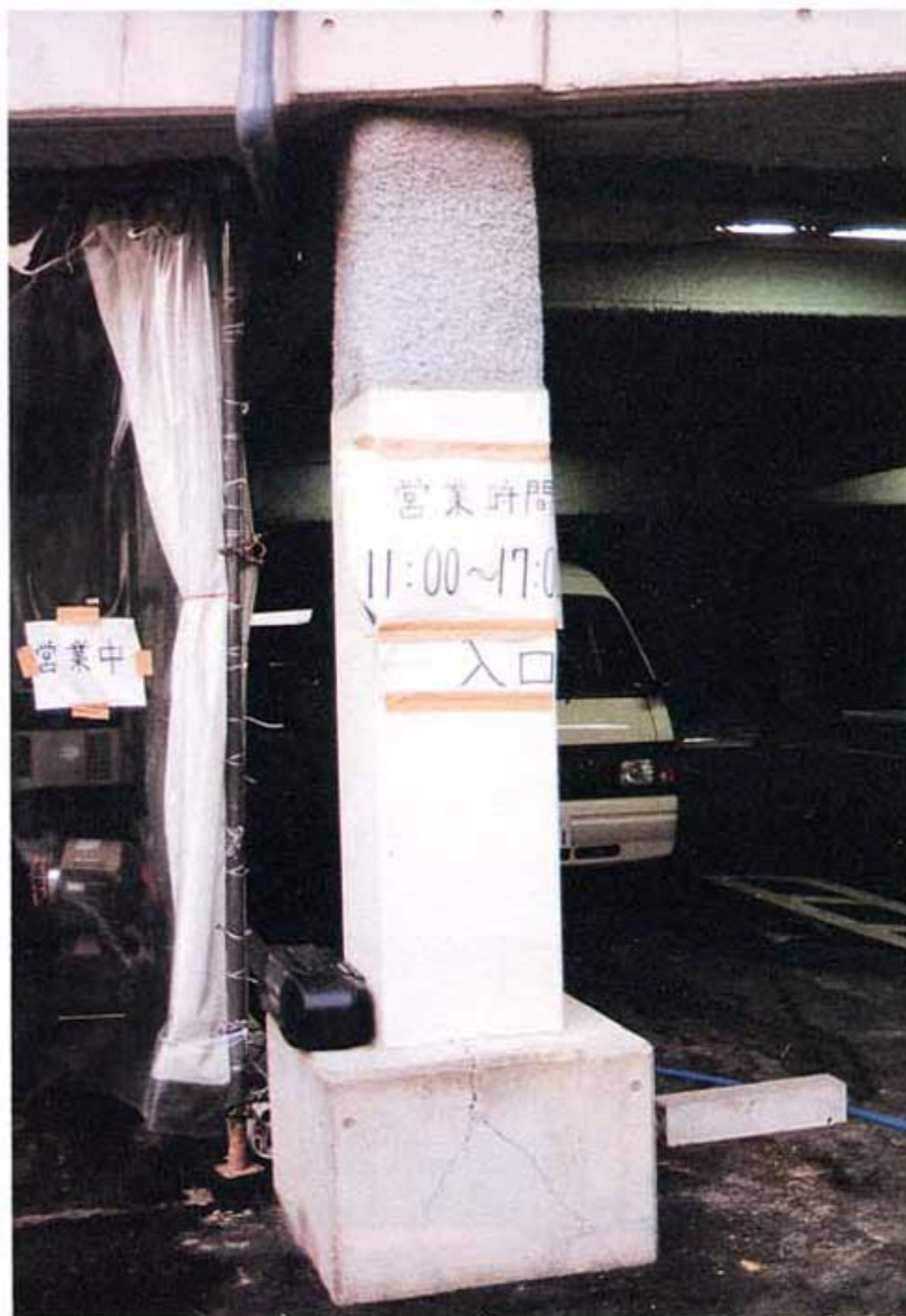
写真6.3-4 コンクリートの亀裂と 無被害の耐火被覆 (新長田, Iゴルフ練習場)
