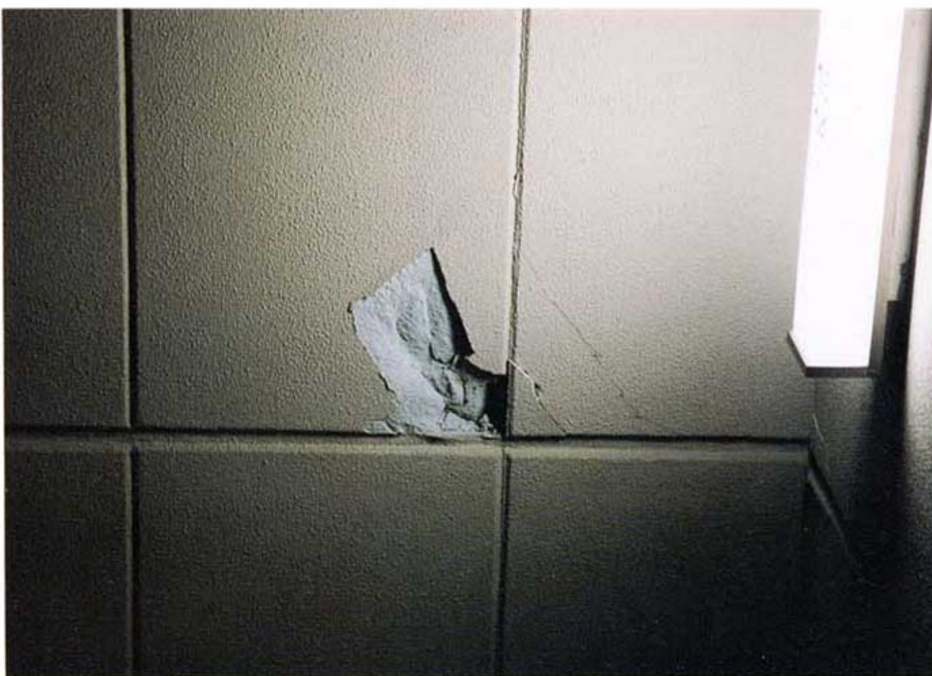
写真6.2-2 ALC板隅角部の脱落
