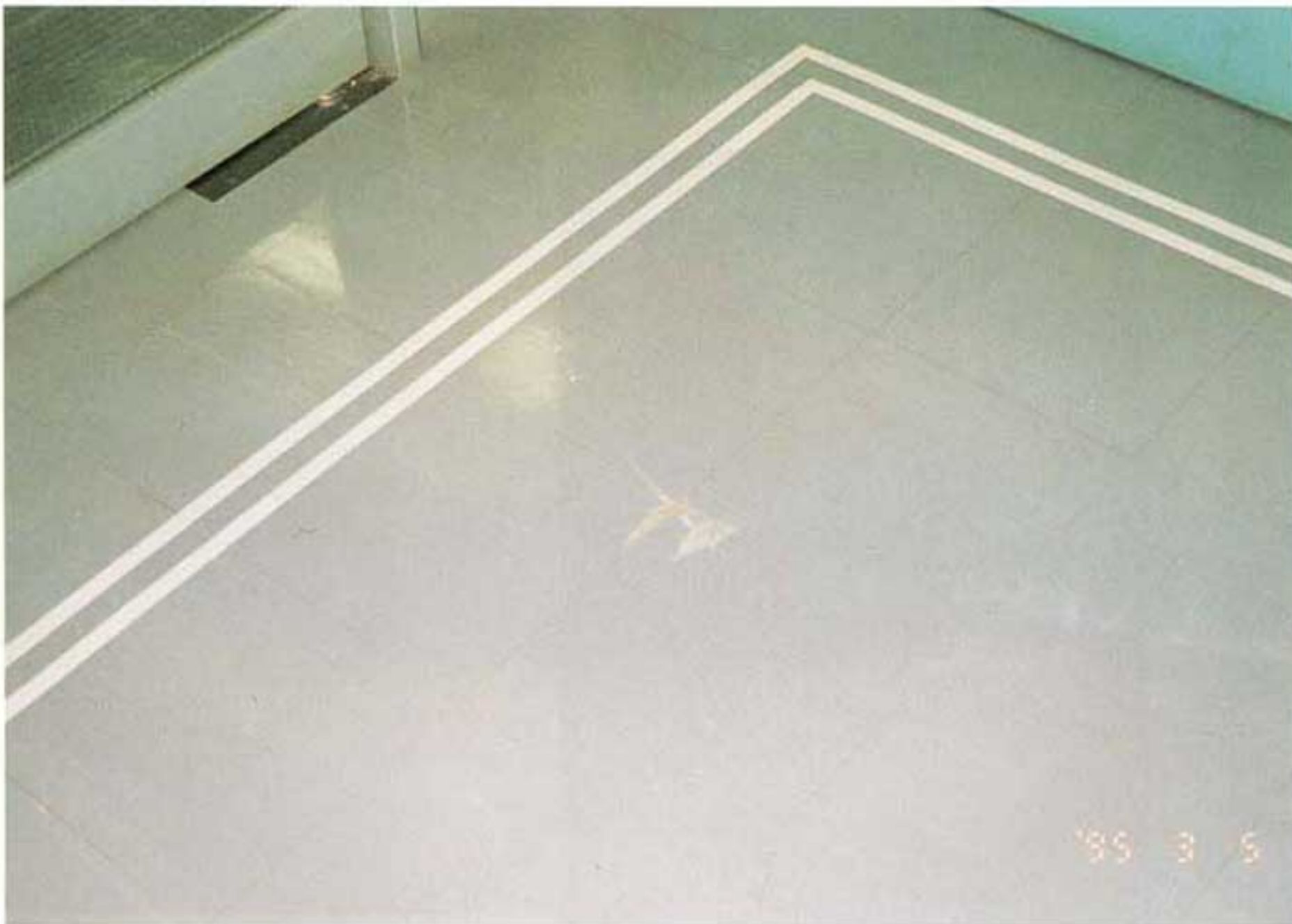
写真6.2-6 防火戸が床にぶつ かった痕
