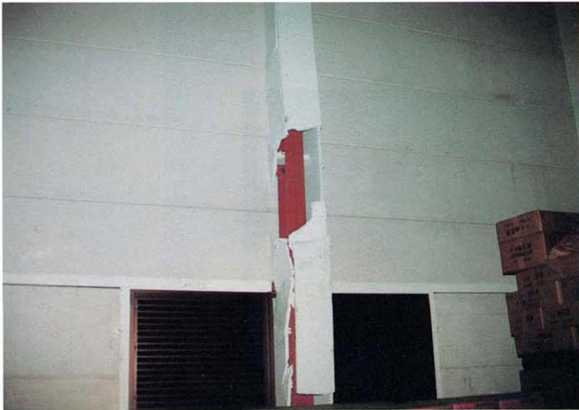
写真6.3-3 貯蔵品転倒により生じた耐火被覆材の破損 (魚崎, F酒造倉庫)
