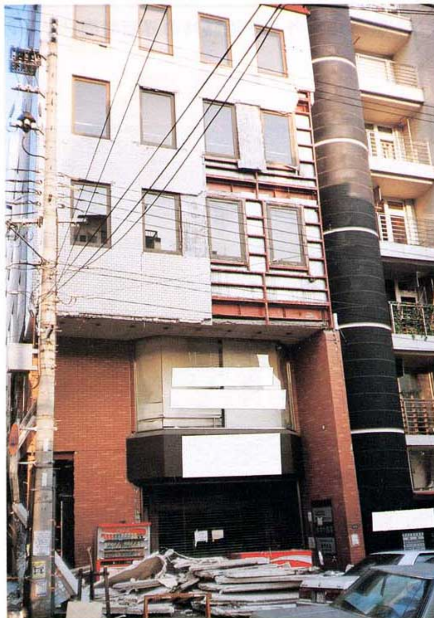
写真7.3-10 ラスシートモルタルタイル張り、ラスシートの脱落
