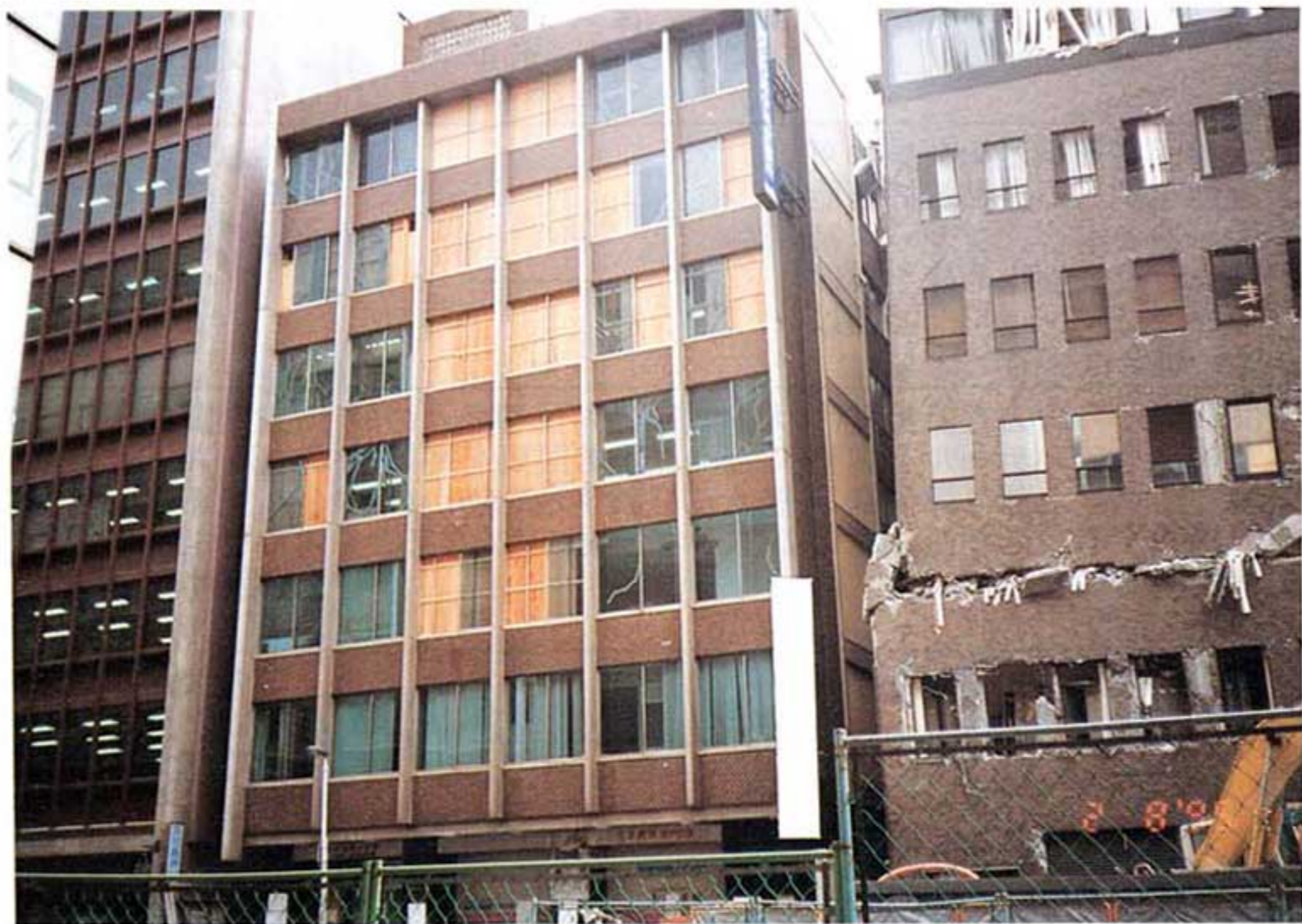
写真7.3-2 パテ止めの建物のガラスの破損（その2）
