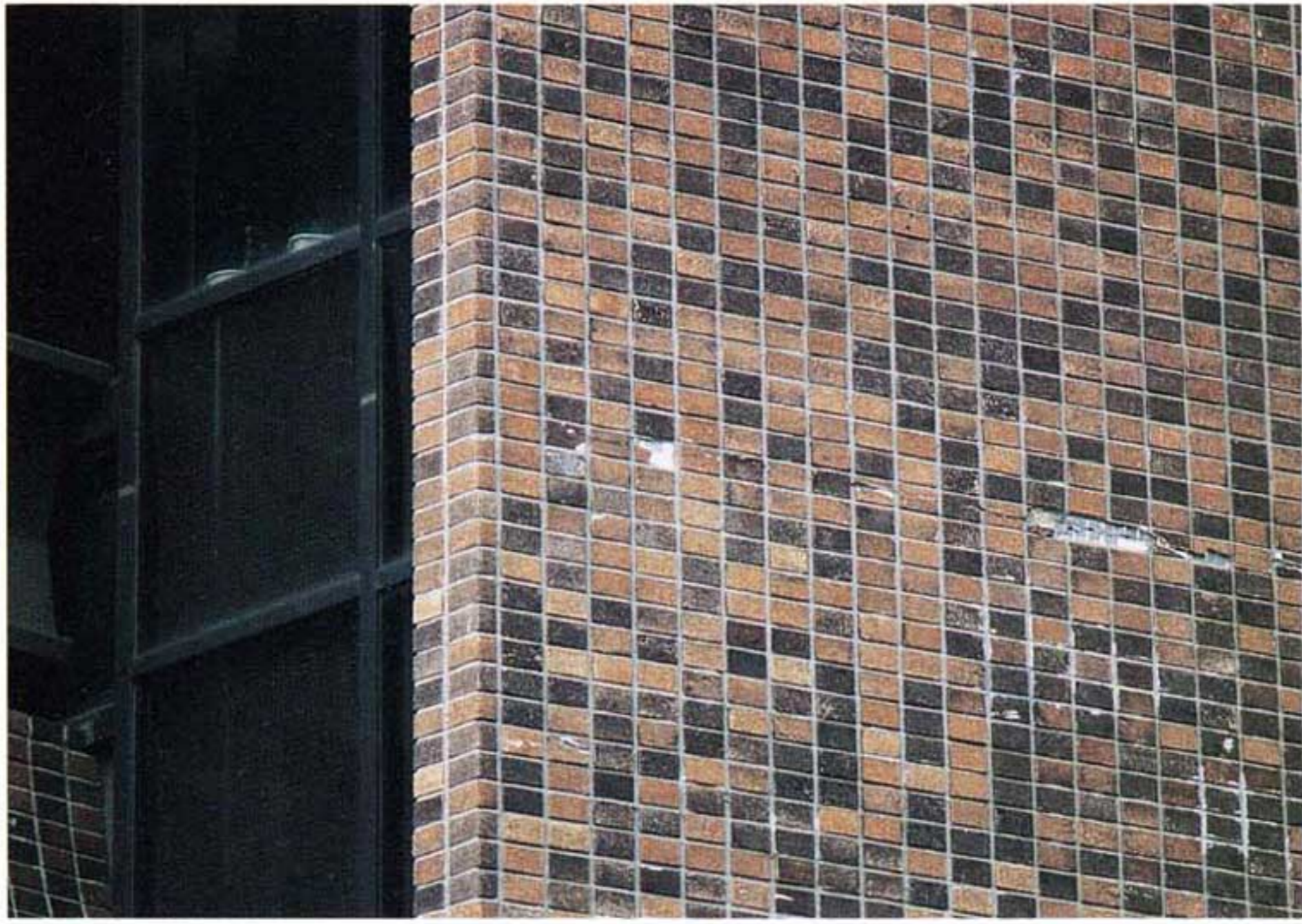
写真7.3-5 剪断ひび割れ周辺のタイルの剝離（その1）
