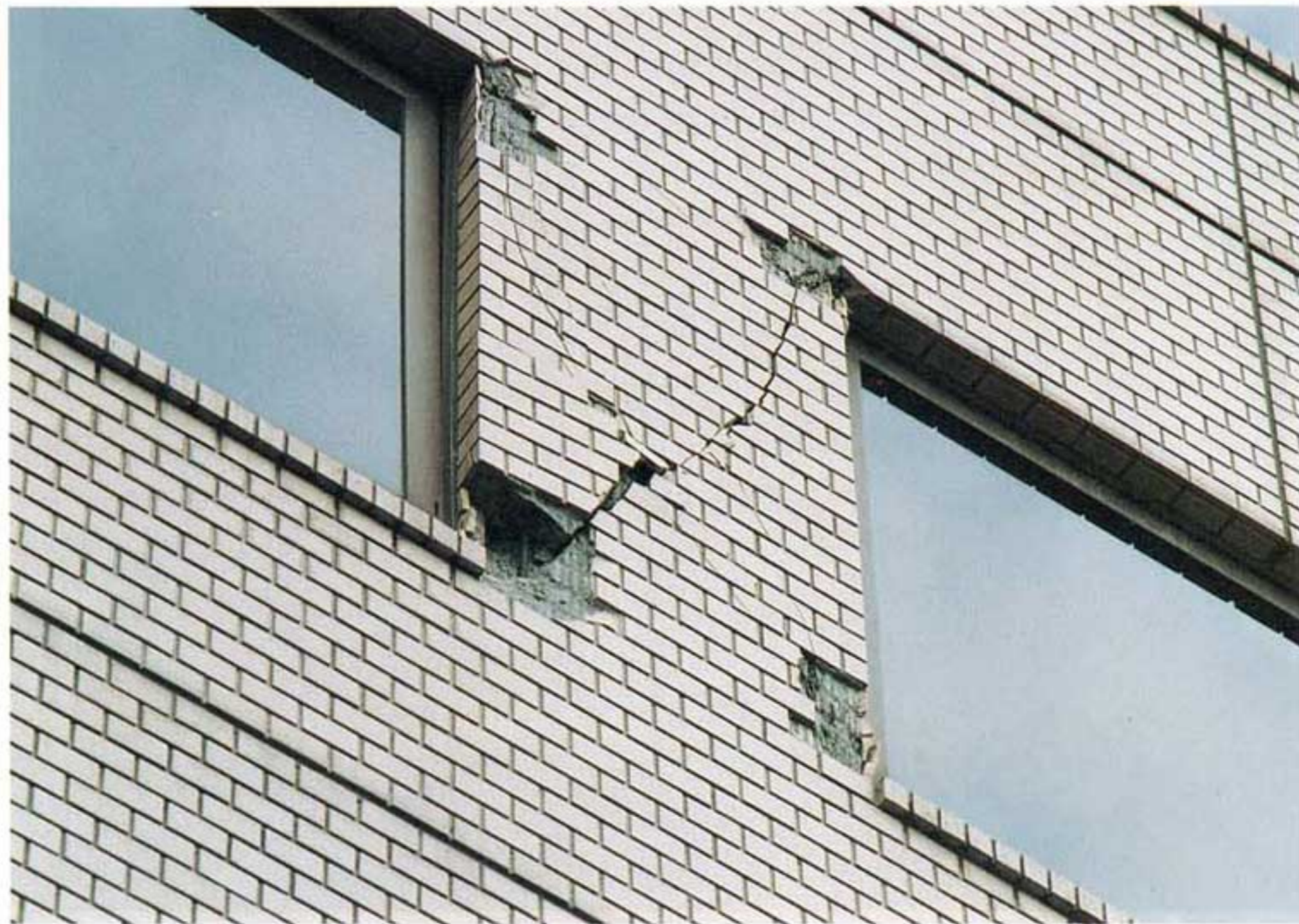
写真7.3-6 剪断ひび割れ周辺のタイルの剝離（その2）
