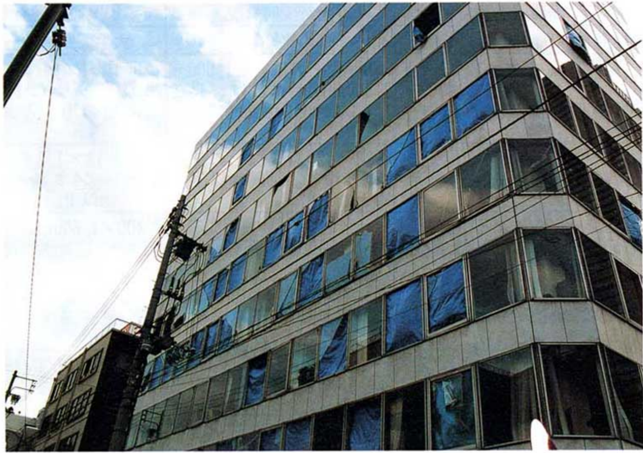
写真7.3-1 パテ止めの建物のガラスの破損（その1）
