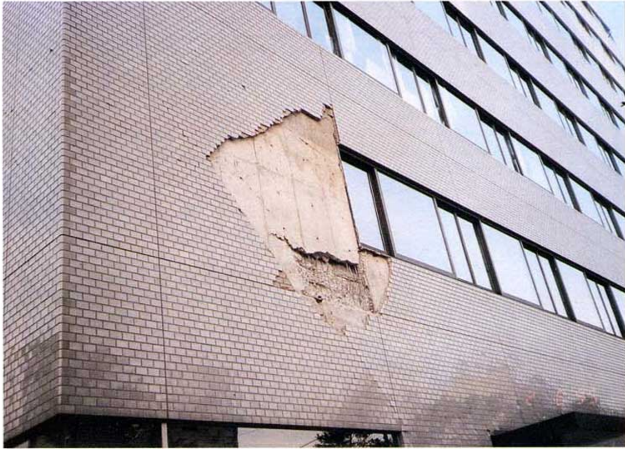
写真7.3-7 躯体コンクリート下地モルタルの界面でのタイルの剝離
