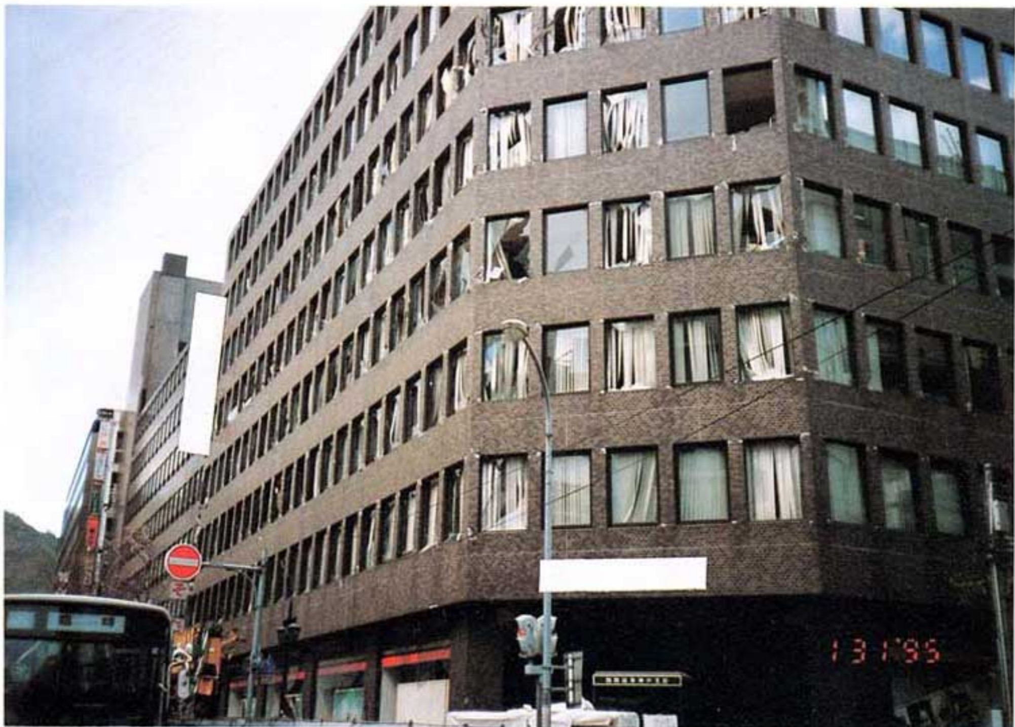
写真7.3-4 コーナー部付近のガラスの破損
