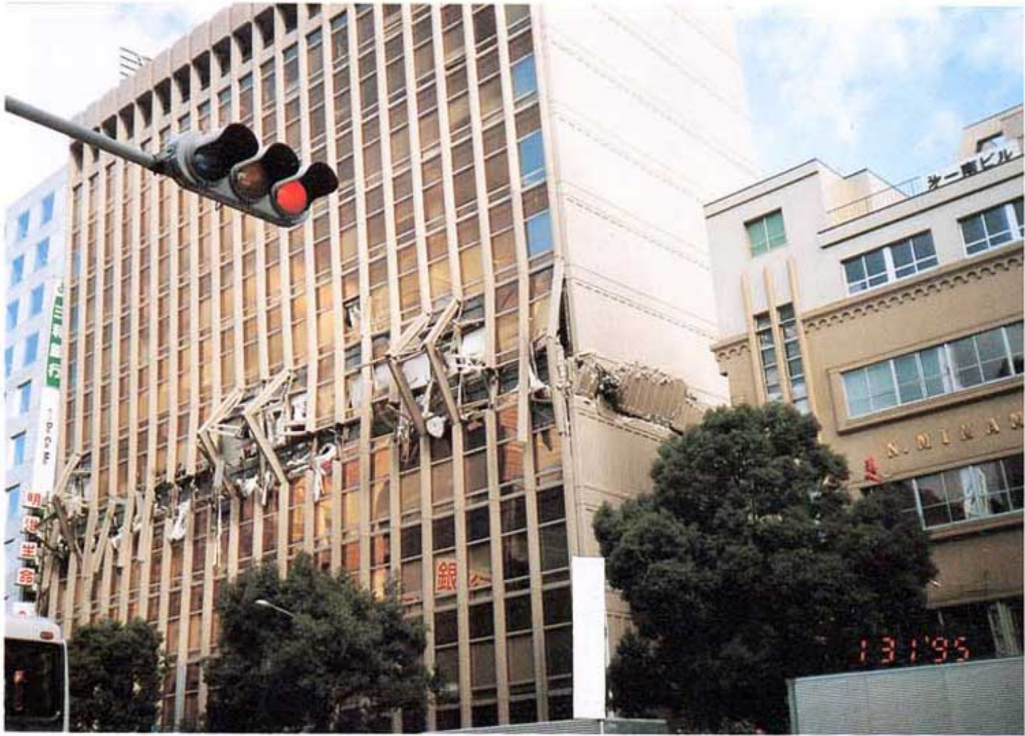
写真7.3-3 カーテンウォール方式の建物のガラスの破損 中間階は圧壊、その階以外のガラスは被害なし
