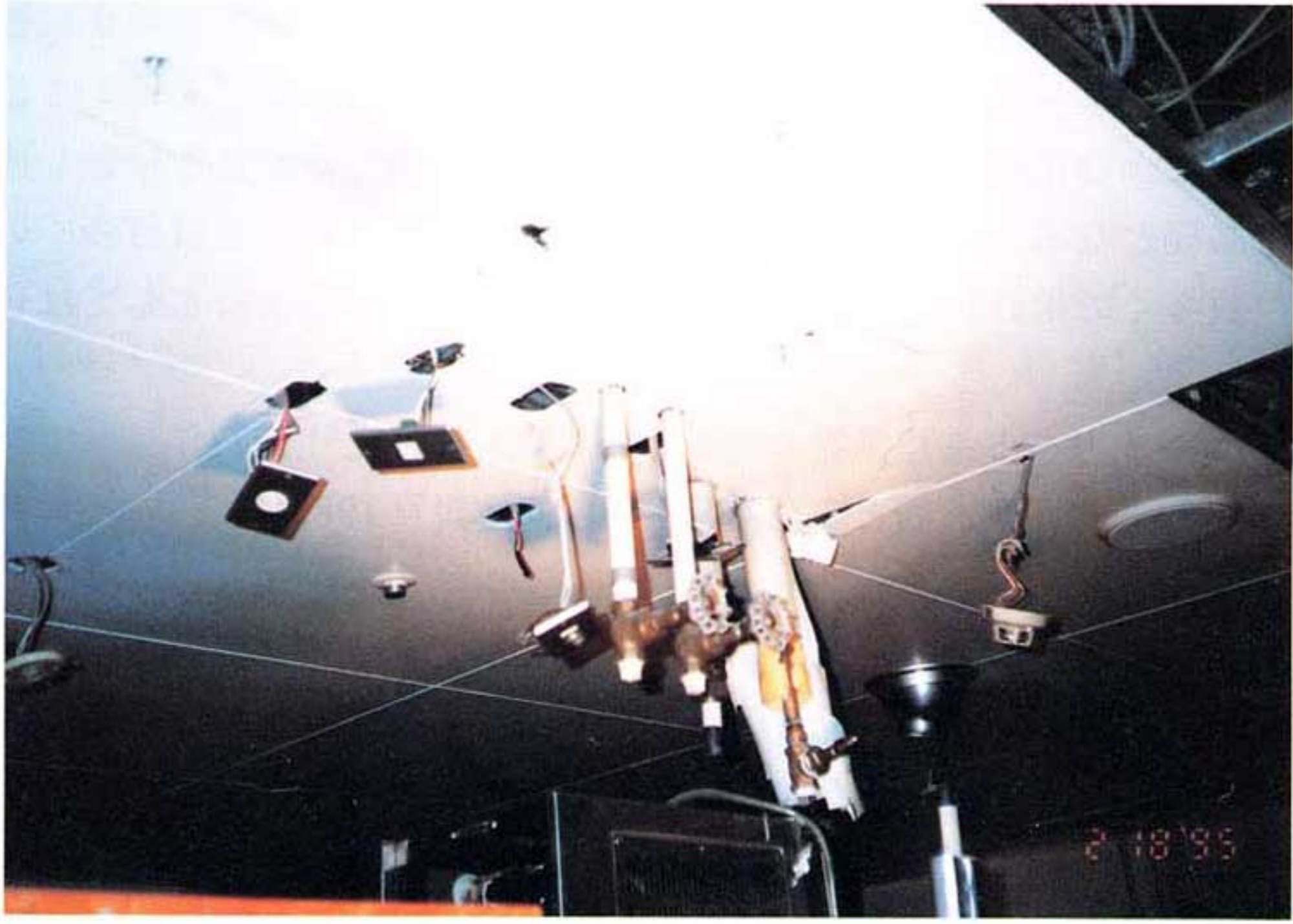
写真7.3-11 設備機器が突き抜いた天井材の破壊
