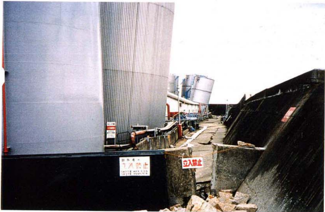
写真 2.2.1 コンテナのタンク傾斜 (神戸市長田区南駒栄町)
