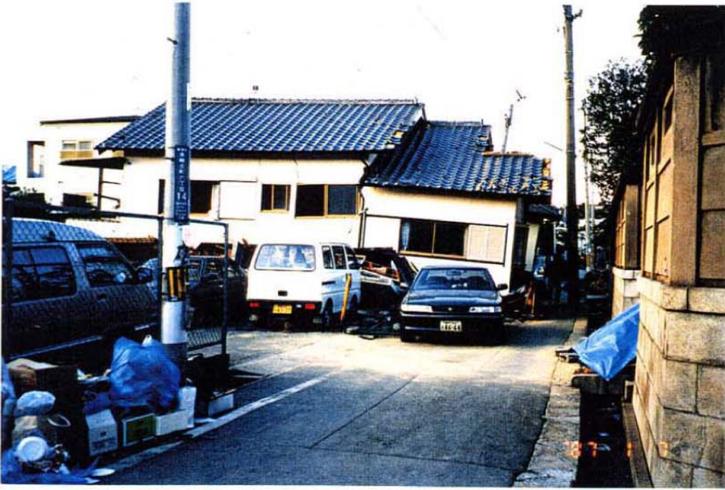
写真 2.3.69 一階部分の破損 東灘区魚崎北町
