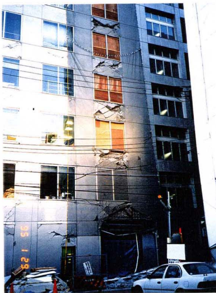
写真2.3.43 東面の損傷状況。 境界梁にせん断破壊を 生じている。
