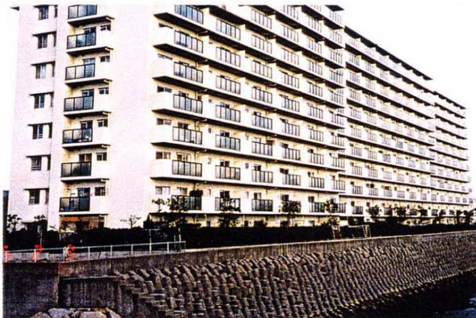
写真 2.2.8 盛土に近接した高層住宅の傾斜 (芦屋市大東町)
