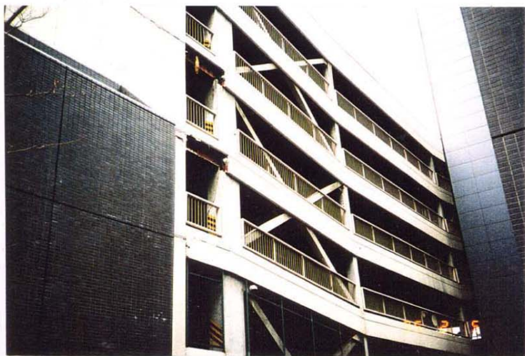
写真2.3.58 南面の損傷状況。 損傷状況は、西面に比べてあまり目立たない。
