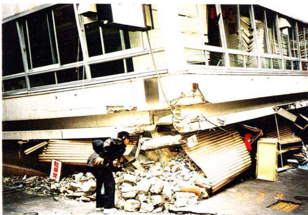
写真2.3.33 偏心により1階が層崩 壊している（東側）。
