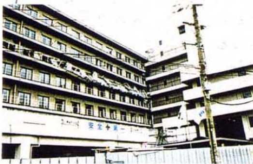
⑥ 中間階の層崩壊
