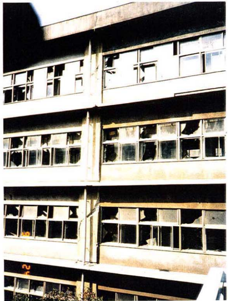
写真2.3.34 垂れ壁、腰壁の付いた 柱がせん断破壊をして いる。
