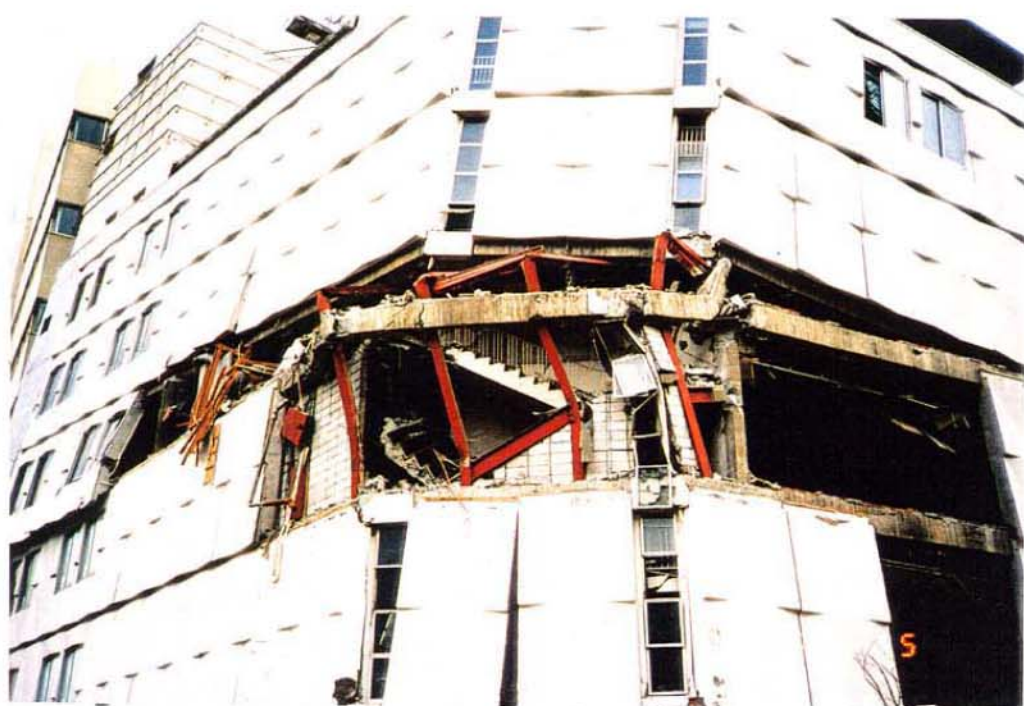
写真2.3.14 3階に比べ4階の柱が 小さい。 PCカーテンウォール が脱落している。
