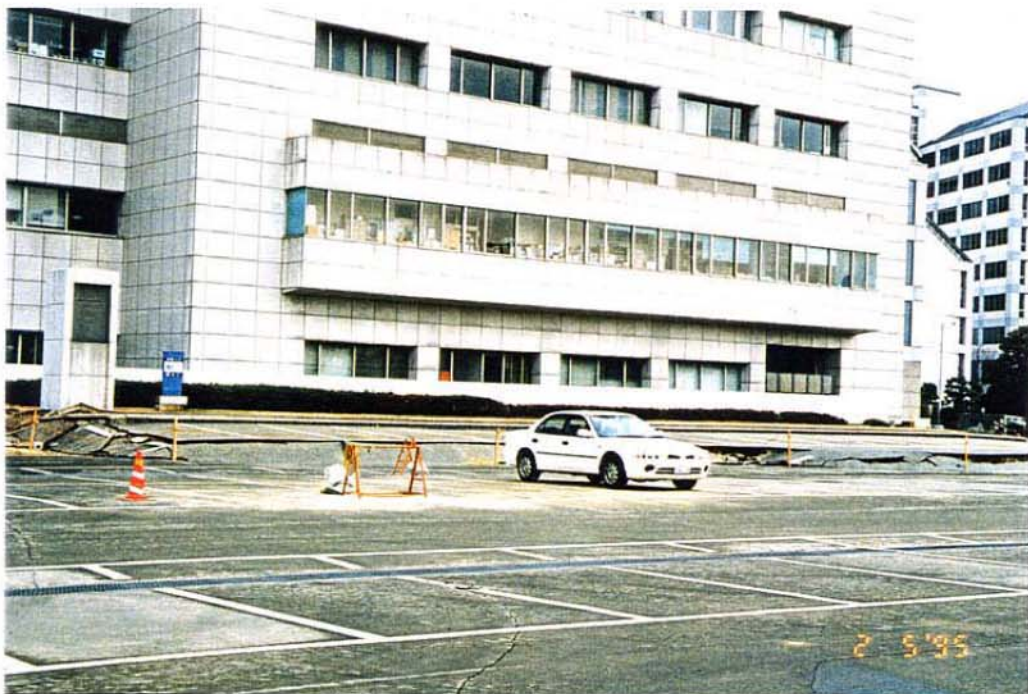
写真 2.2.4 支持杭建物の抜上がり (ポートアイランド)
