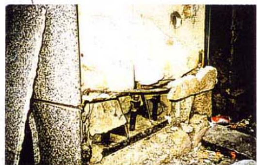
④ 鉄骨造の柱脚部の破損
