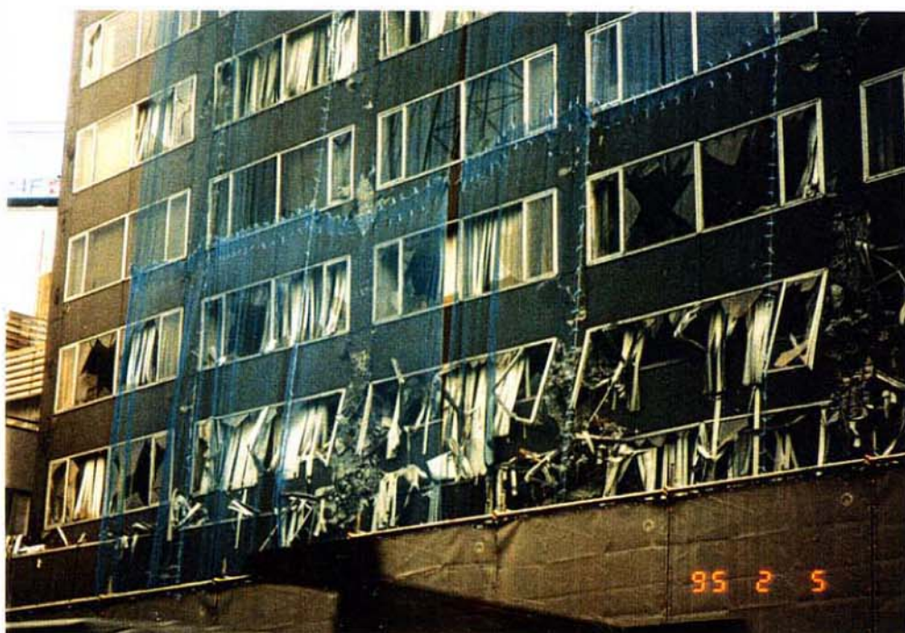
写真2.3.20 ガラスが破損、タイルの一部は剝落している。
