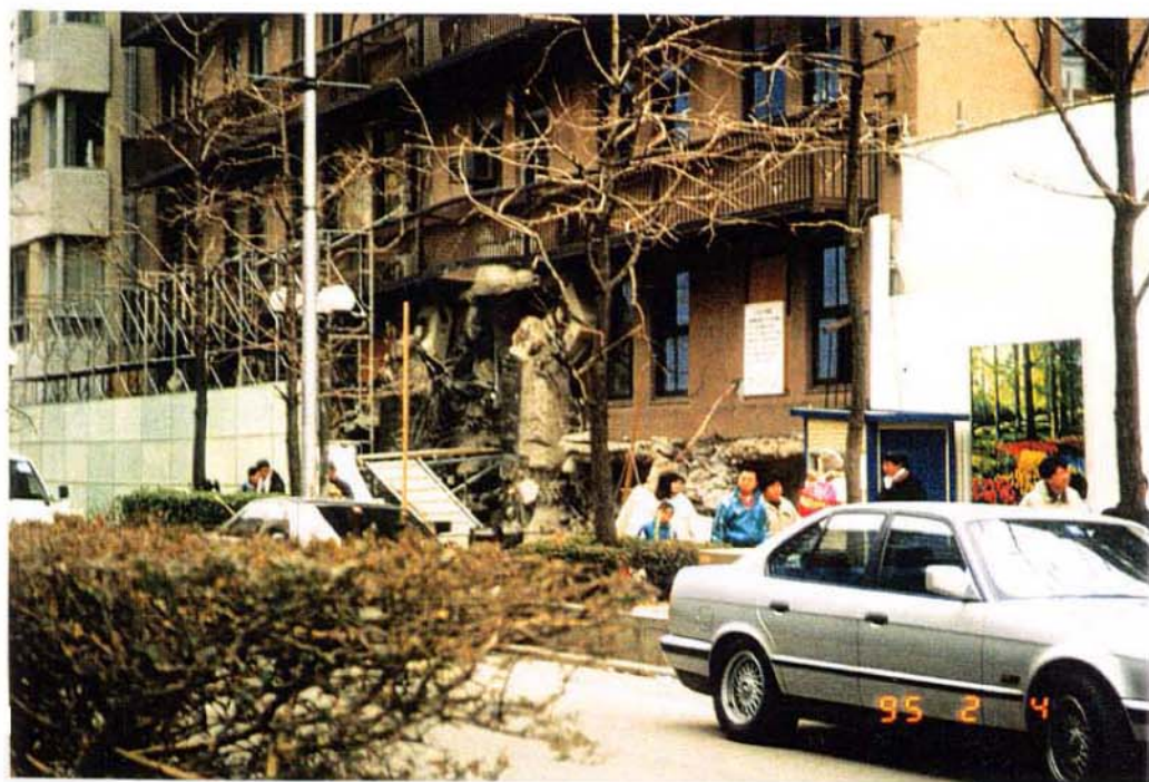
写真2.3.6 柱鉄筋（丸鋼）の付着の低下により、1階柱にせん断破壊が生じている。 せん断破壊に伴い、柱主筋も座屈し、層崩壊に至っている。
