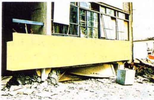
⑤ 1階部分の層崩壊
