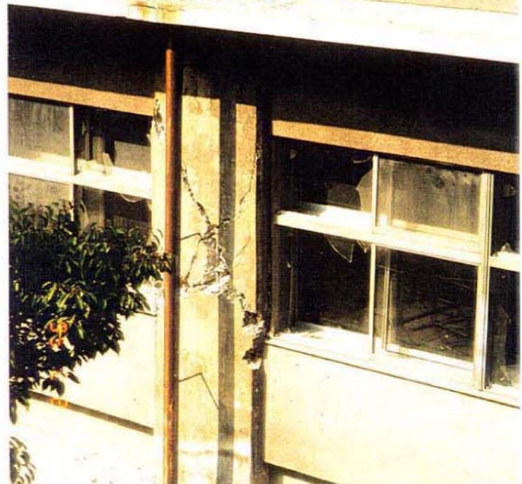
写真2.3.35 柱のせん断破壊の詳細。
