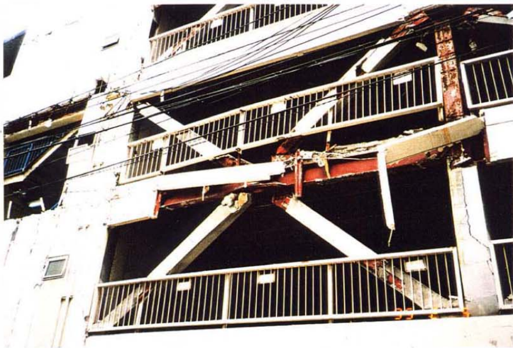
写真2.3.57 西面の損傷状況。 K形筋かいを用いており、梁の座屈およびブレース端部の破断が観察される。 梁の筋かいが取り付く位置には縦スチフナーがない。
