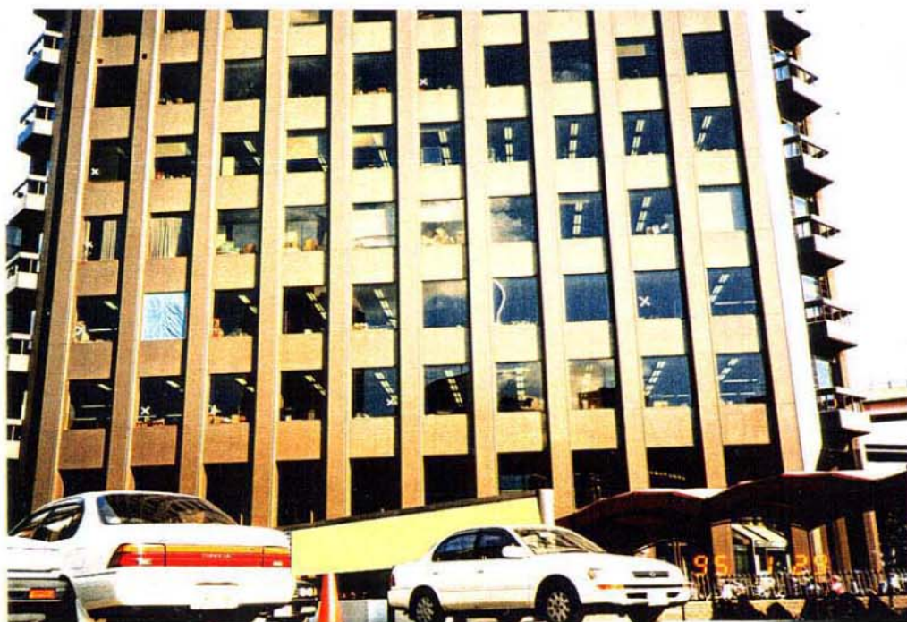
写真2.3.82 外壁のガラスが割れて おり、ブルーシートや テープで補修している。
