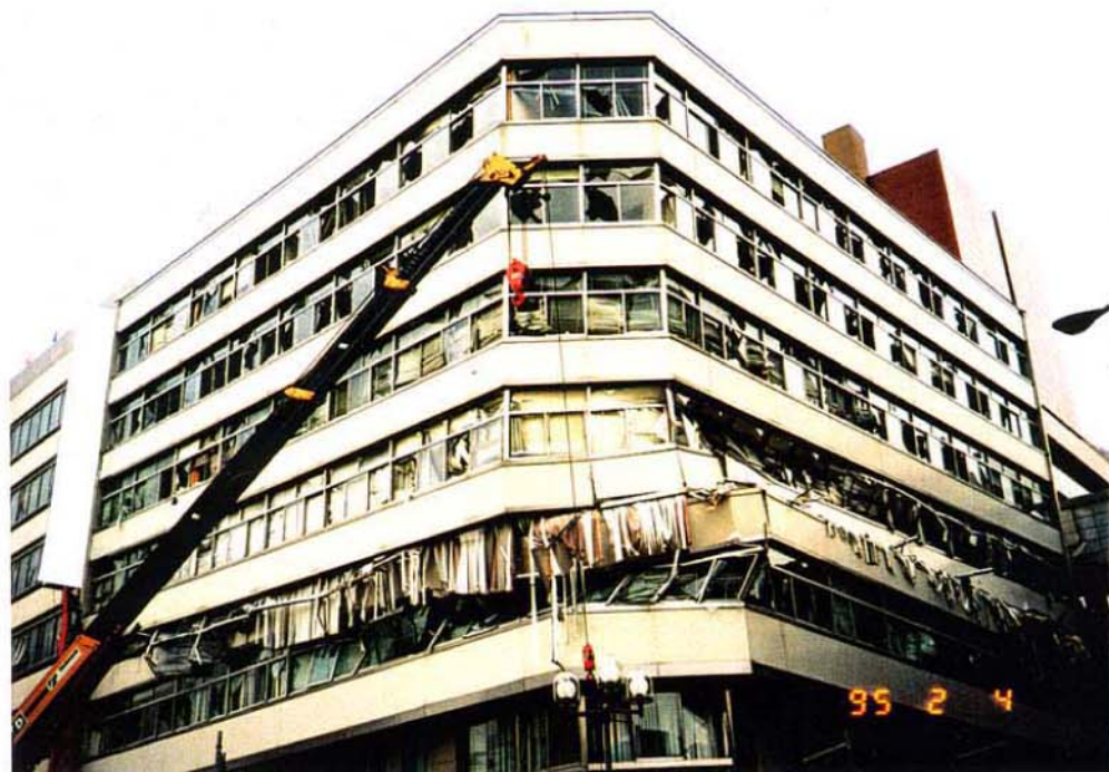
写真2.3.15 4階が層崩壊している。
