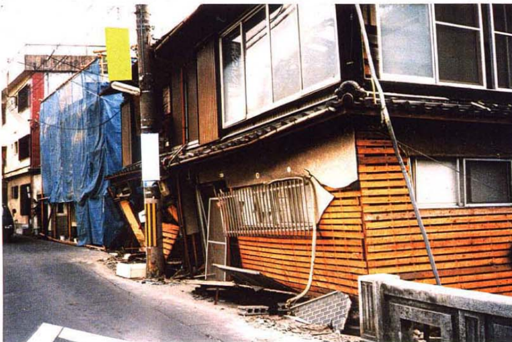
写真 2.3.65 一階部分の傾斜と 外壁モルタル落下 宝塚市武庫川沿いの 住宅
