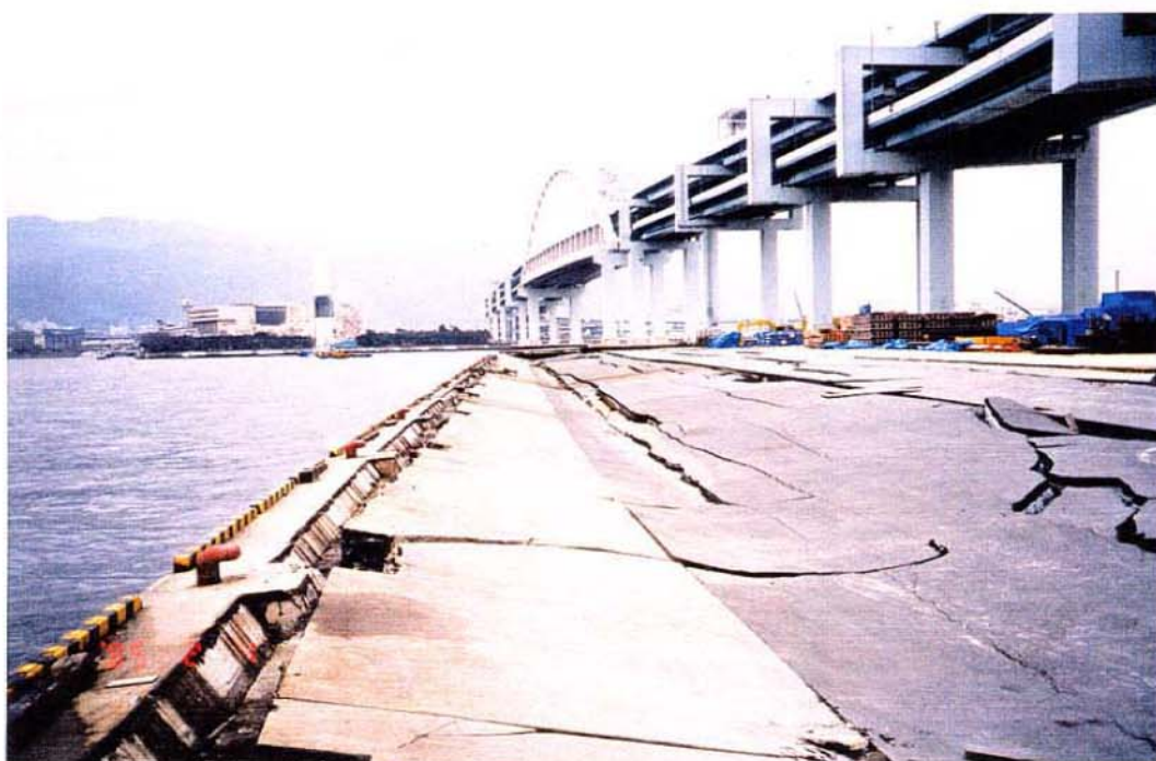
写真 2.2.6 側方流動による護岸のはらみ出し (六甲アイランド北)
