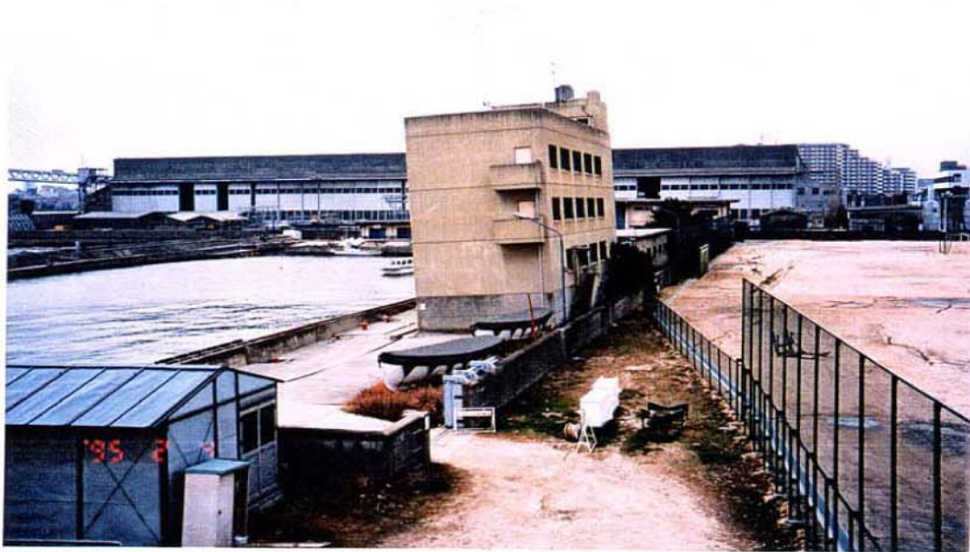
写真 2. 2. 9 護岸に近接した低層建物の傾斜 (神戸市東灘区深江南町)
