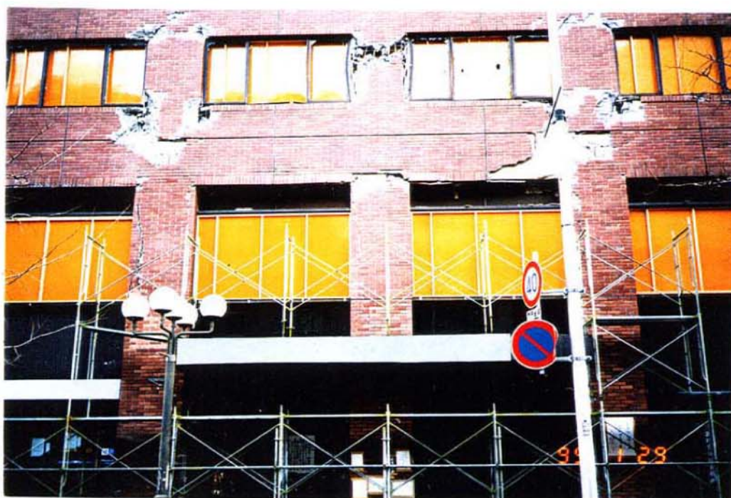
写真2.3.39 2、3階の柱梁接合部、 柱にはせん断ひび割れ、 非構造壁にはせん断破 壊が生じている。
