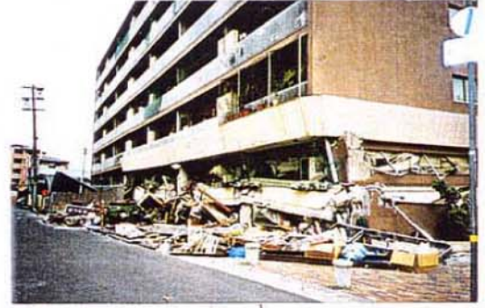
① ピロティの崩壊
