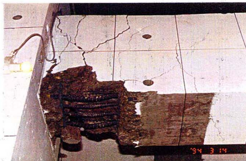
写真4.4.15 梁端部の破壊状況
