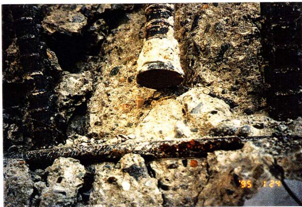
写真3. 2. 10 橋脚主鉄筋圧接部の破断
