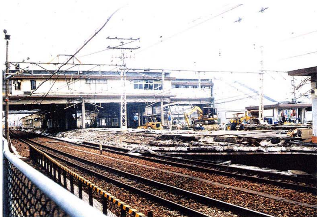
写真 3.3.29 JR 西日本 芦屋駅ホーム 崩壊状況
