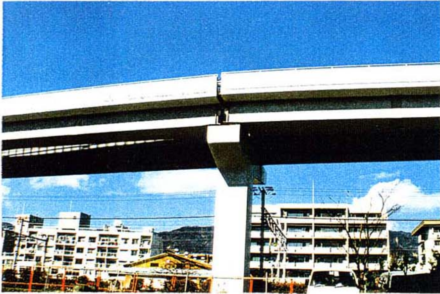
写真 3.3.46 神戸新交通 六甲ライナー 軌道桁移動・衝突・損傷 主桁落下防止装置有効に作用
