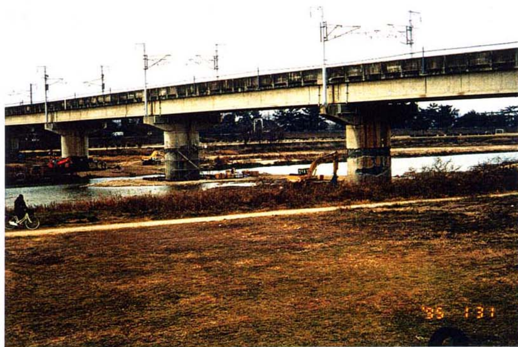
写真 3.3.15 山陽新幹線（武庫川橋梁） RC 橋脚破損状況
