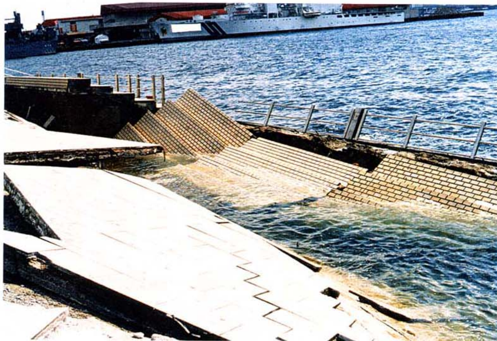
写真 3.4.4 崩れ落ちた階段式護岸 (メリケンパーク)
