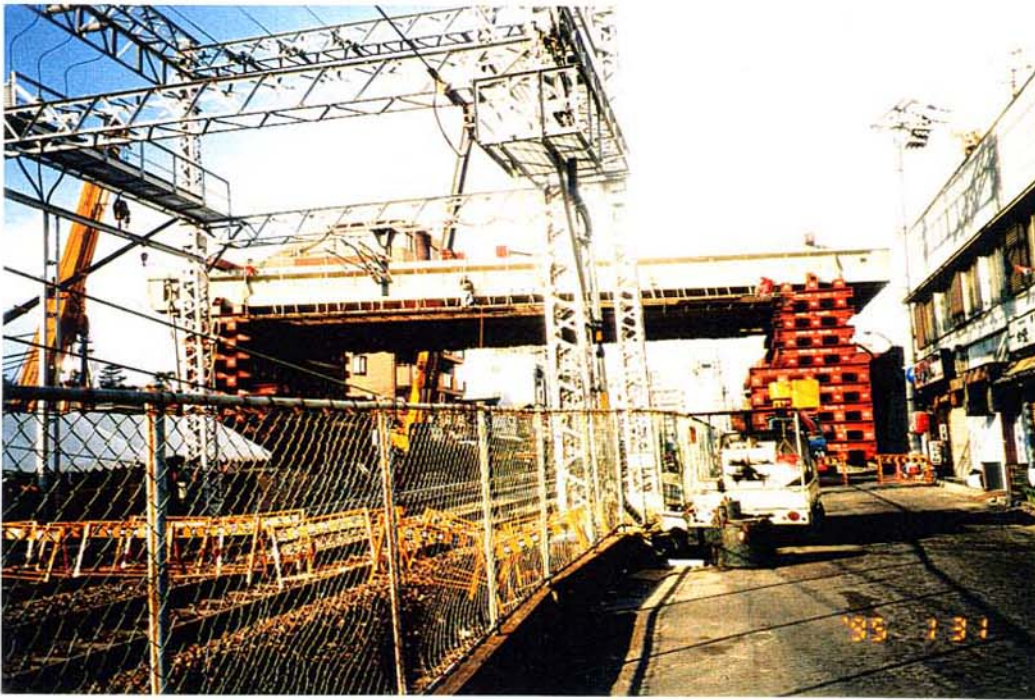
写真 3.3.11 山陽新幹線PC桁 阪急今津線上に落下 再使用のため仮置状況
