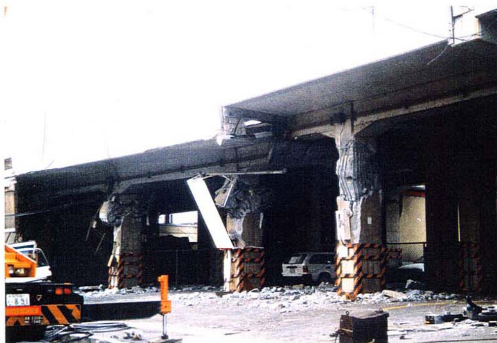
写真 3.3.18 阪神電鉄 RC ラーメン高架橋 崩壊状況
