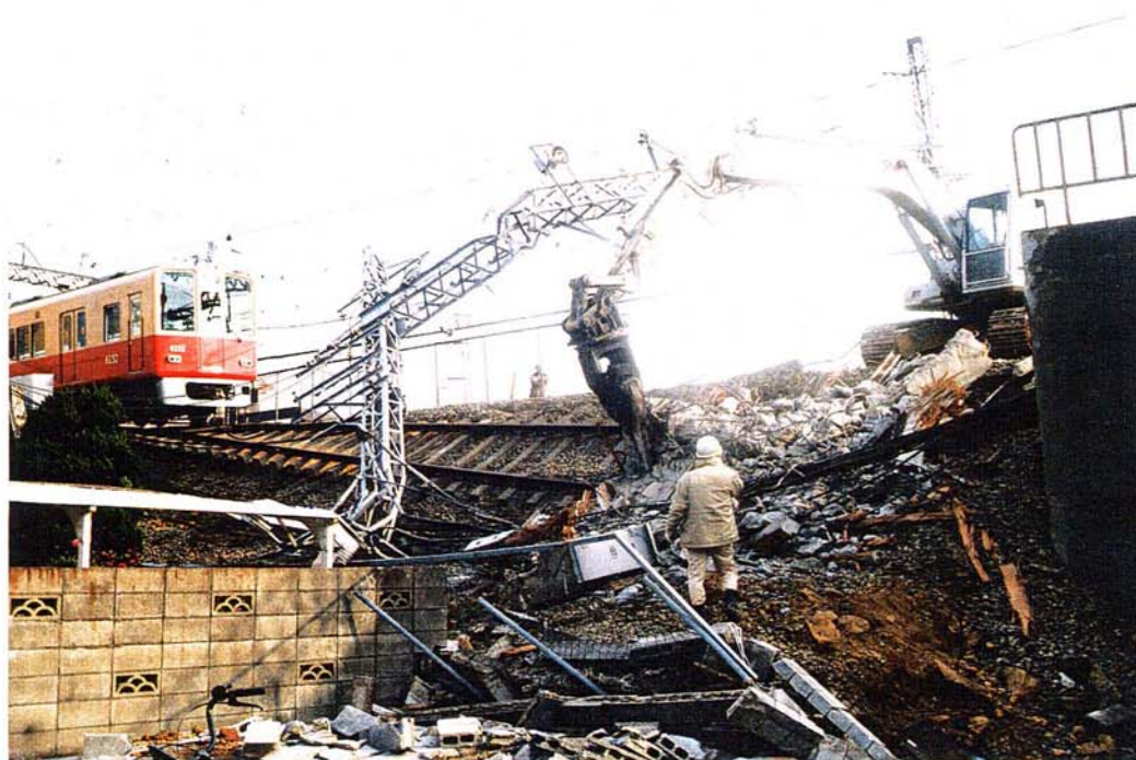
写真 3.3.24 阪神電鉄 土留め擁壁崩壊 (擁壁撤去中) (被災車両撤去済)
