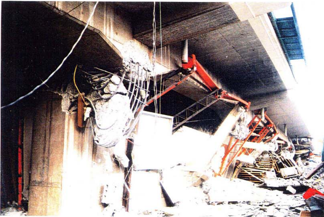
写真 3.3.20 同 上 高架橋崩壊状況
