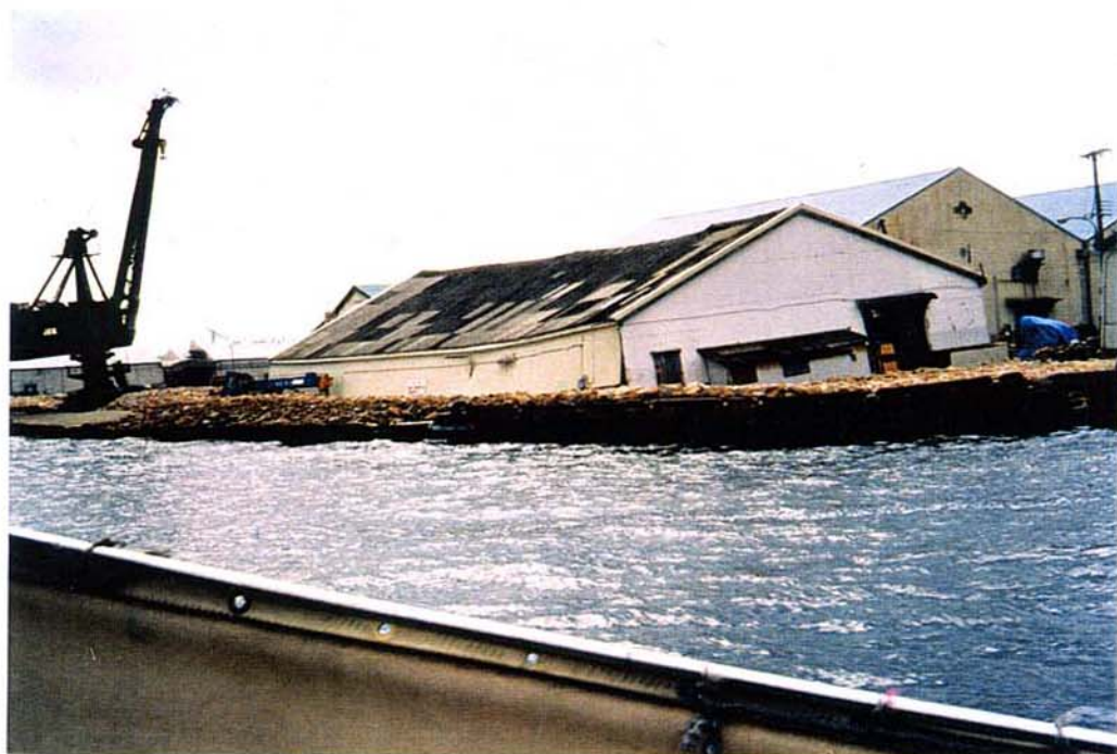
写真 3.4.10 兵庫第一突堤の先端部 エプロン部が水没
