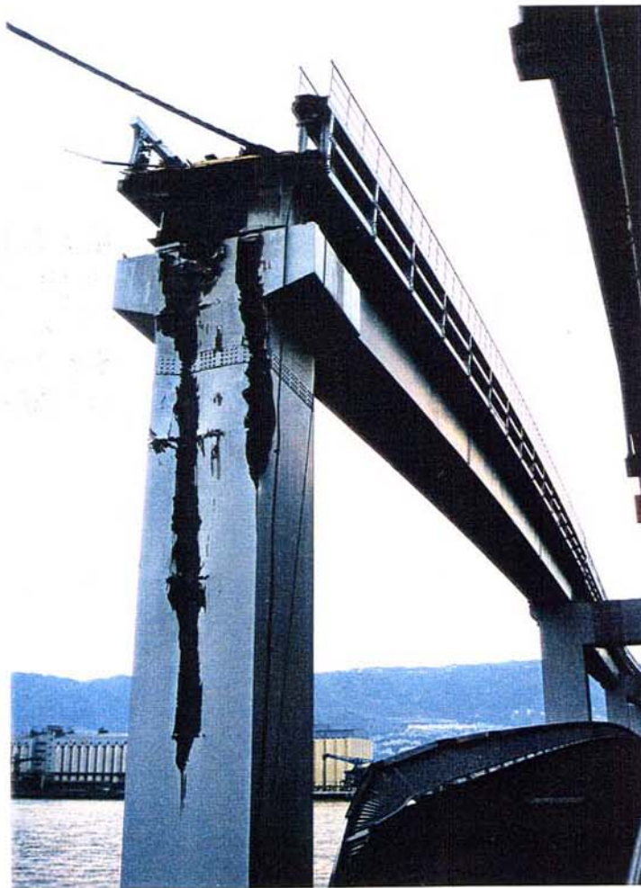
写真 3.3.48 神戸新交通 六甲ライナー 六甲大橋側径間 (六甲アイランド側) 鋼製橋脚変位により落橋
