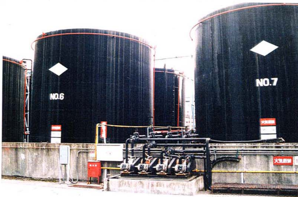
写真 3.7.2 動植物油タンクの傾斜
