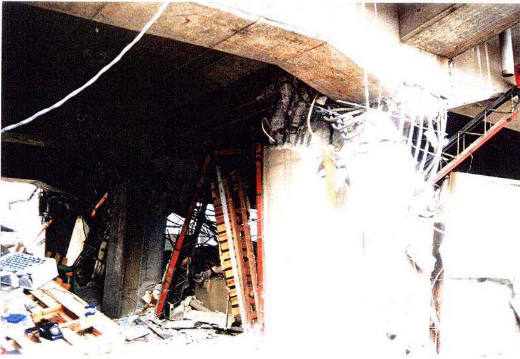
写真 3.3.21 阪神電鉄 RC 橋脚破壊状況
