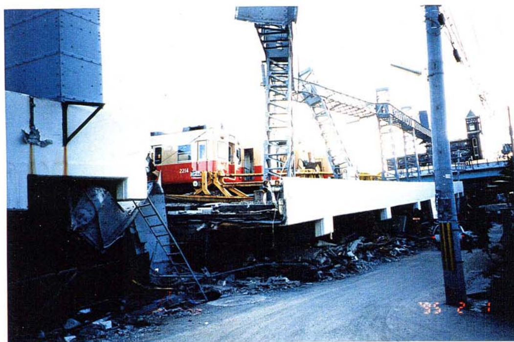
写真 3.3.28 阪神電鉄 石屋川車庫 高架崩壊状況
