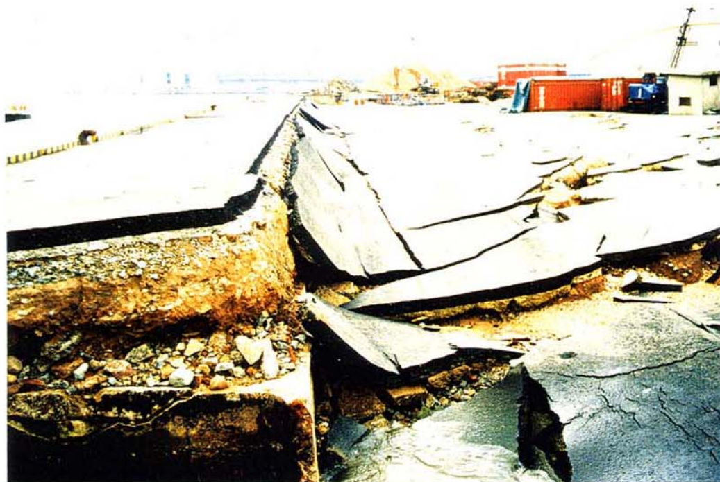
写真 3.4.6 陥落した岸壁背後のエプロン (摩耶埠頭第一突堤)
