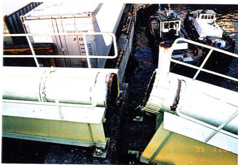
図 3.6.3 破損した送水管
