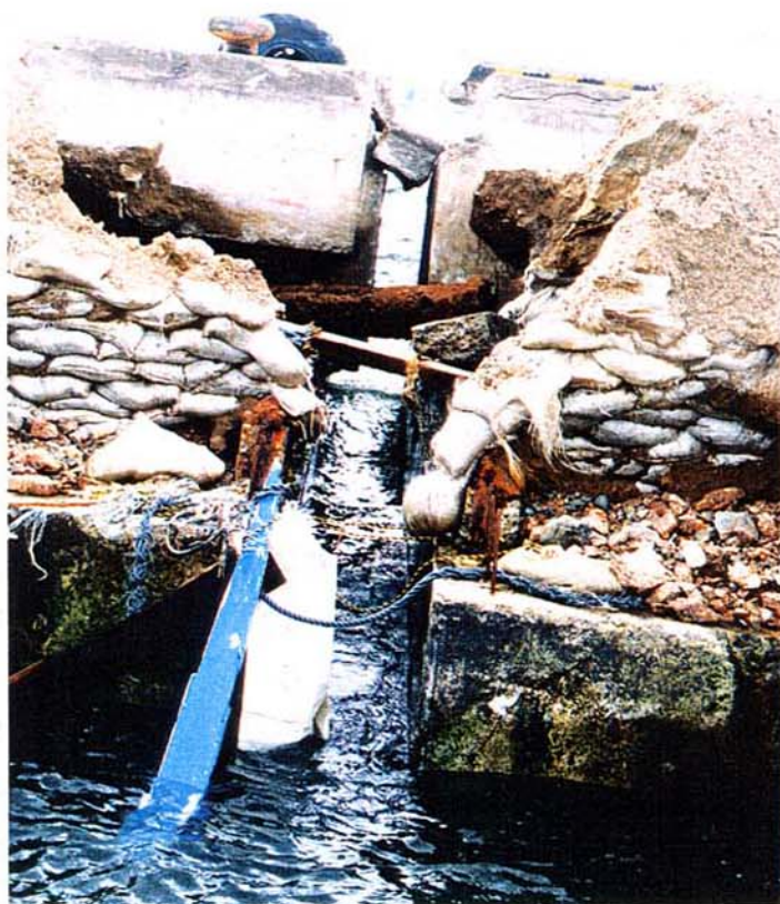
写真3.1.6 ケーソン式防波堤 の移動・破壊
