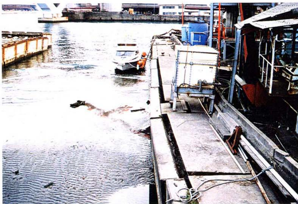
写真3.1.5 岸壁の移動・破壊
