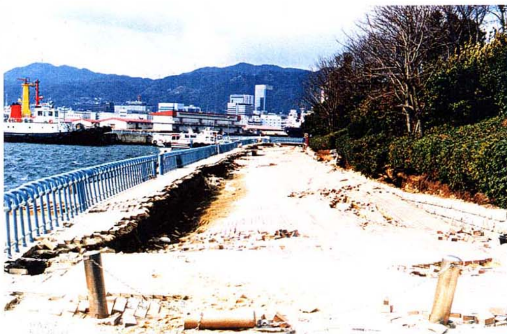
写真 3.4.8 ポートアイランド北公園 所々噴砂によるレンガの散乱 が確認できる
