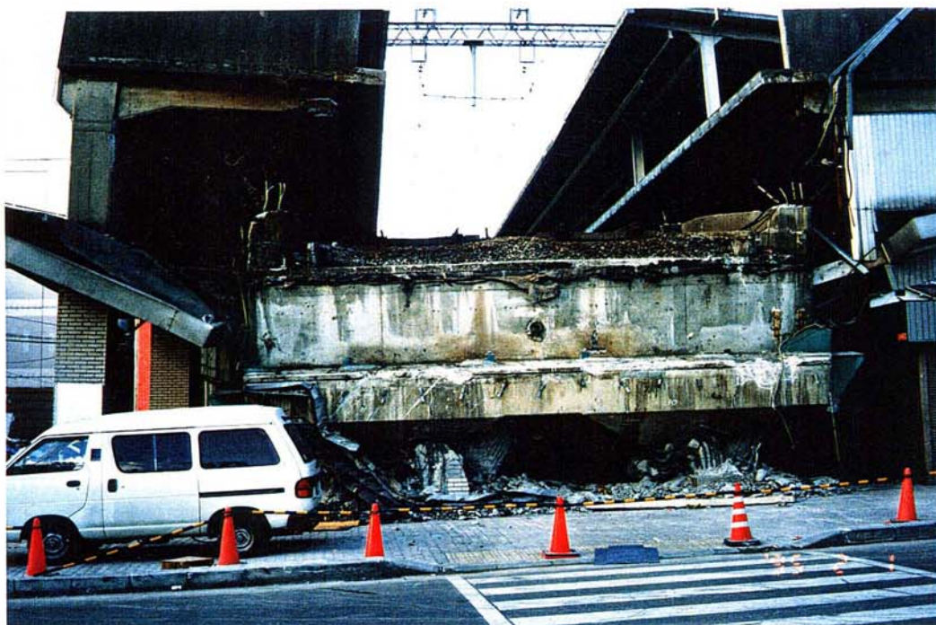
写真 3.3.23 阪神電鉄新在家駅 高架橋崩壊状況
