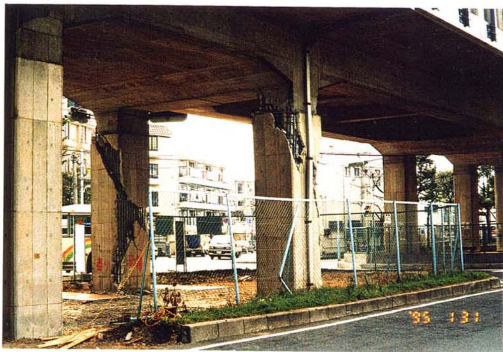
写真 3.3.5 山陽新幹線 RC 橋脚破損状況
