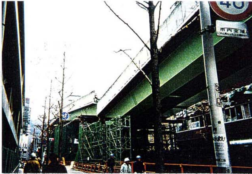
写真 3.3.40 神戸新交通 ポートアイランド線 RC 橋脚破壊・落橋状況 貿易センター付近
