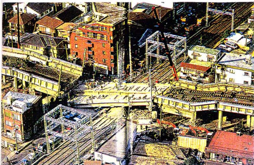
写真 3.3.9 山陽新幹線PC桁 ラーメン橋台崩壊により 阪急今津線上に落下 「日経コンストラクション」 (1995.2.24 撮影：三島 勲氏)
