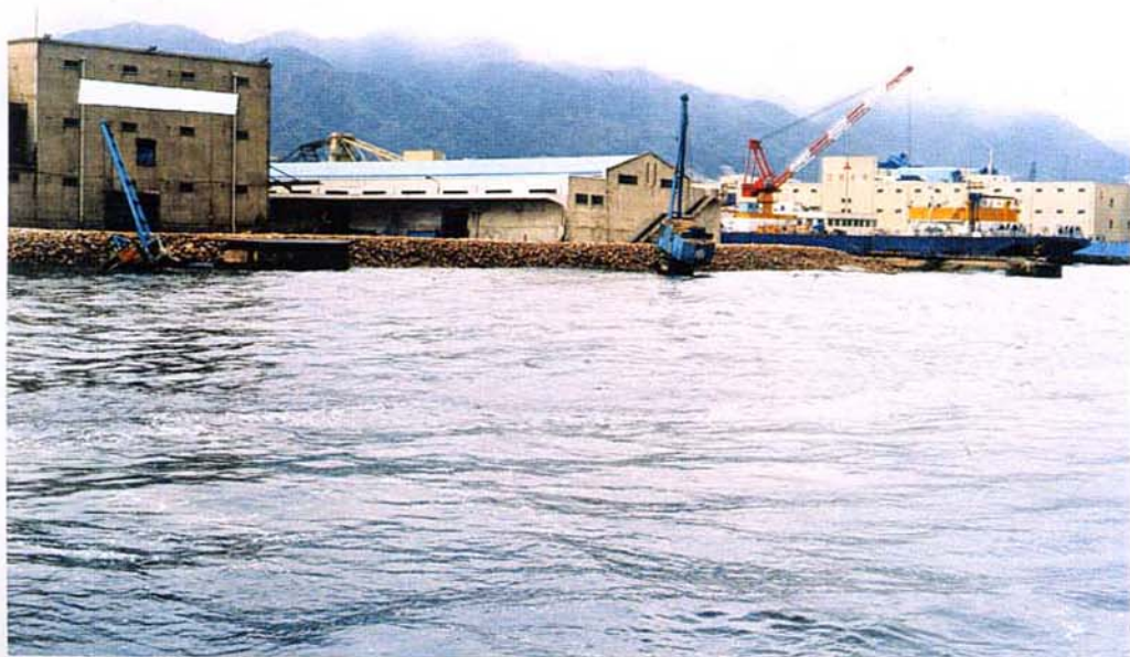
写真 3.4.11 新港第五突堤の先端部も 水没している
