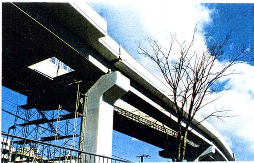
写真 3.3.44 神戸新交通 六甲ライナー 軌道桁移動・衝突・損傷
