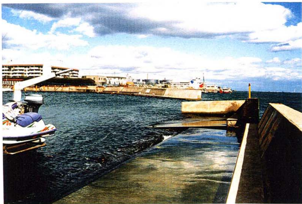
写真 3.4.15 垂水・須磨地区でも被害が みられる 防波堤が港内側に移動している
