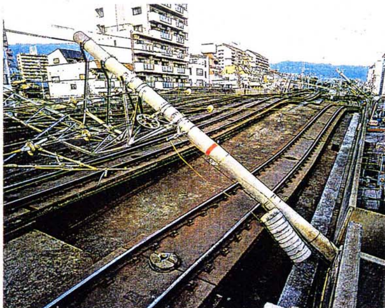
写真 3.3.31 JR 西日本 六甲道駅 高架橋崩壊状況 (架線柱撤去済) 「日経コンストラクション」 (1995.2.24 撮影：玉井強志氏)
