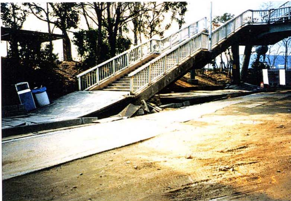
写真 3.4.17 砂が一面に吹き出し地盤の 沈下を確認できる。
