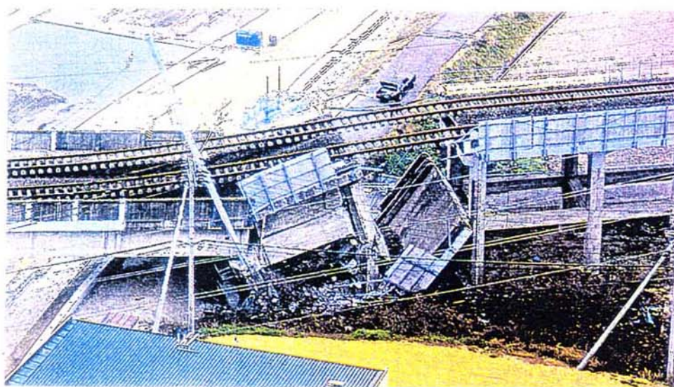
写真 3.3.14 山陽新幹線（武庫川橋梁） PC 桁・RC ラーメン・単版桁 崩壊（落下）状況 「日経コンストラクション」 （1995.2.24 撮影：三島 勲氏）
