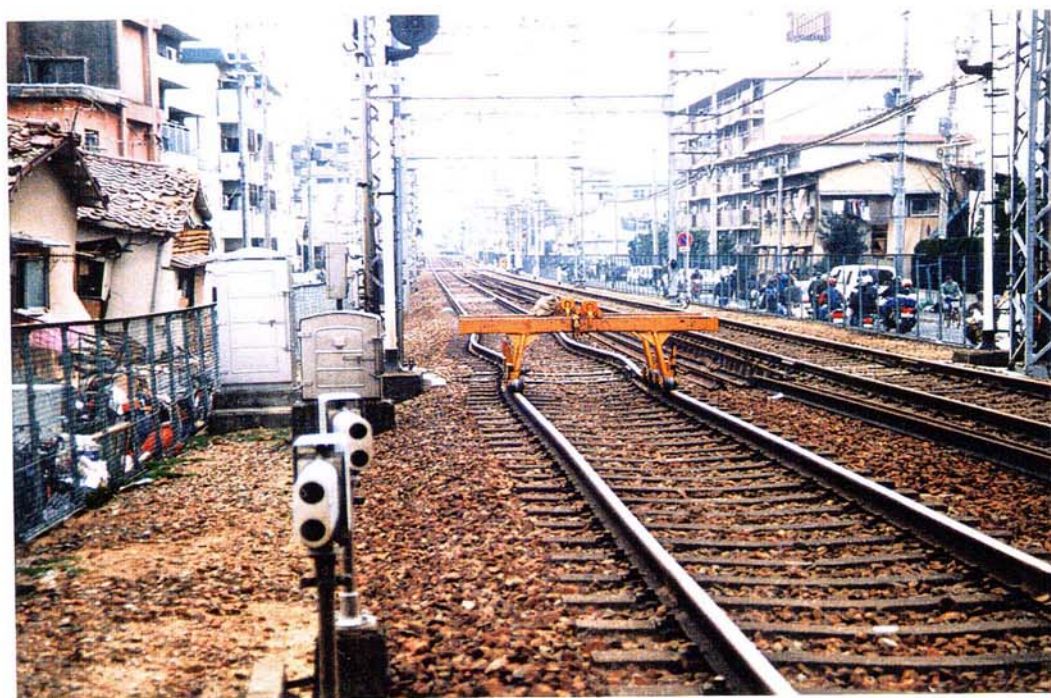
写真 3.3.27 阪神電鉄 軌道崩壊状況
