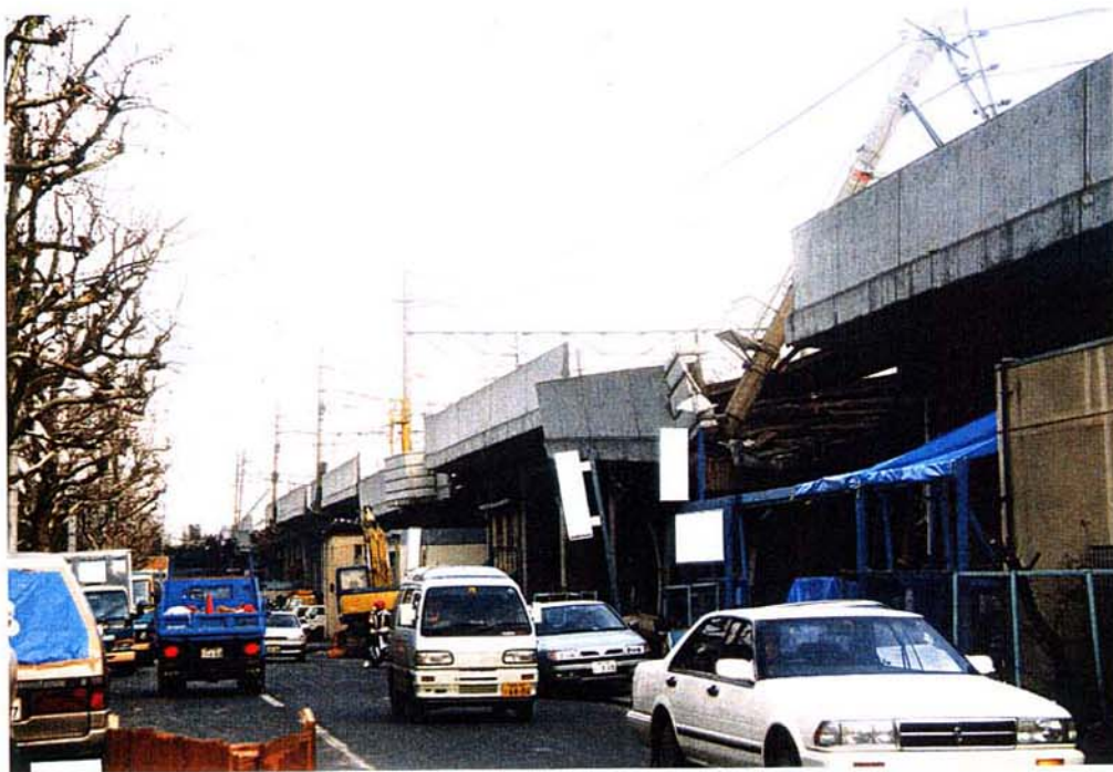
写真 3.3.17 阪神電鉄 高架被災状況
