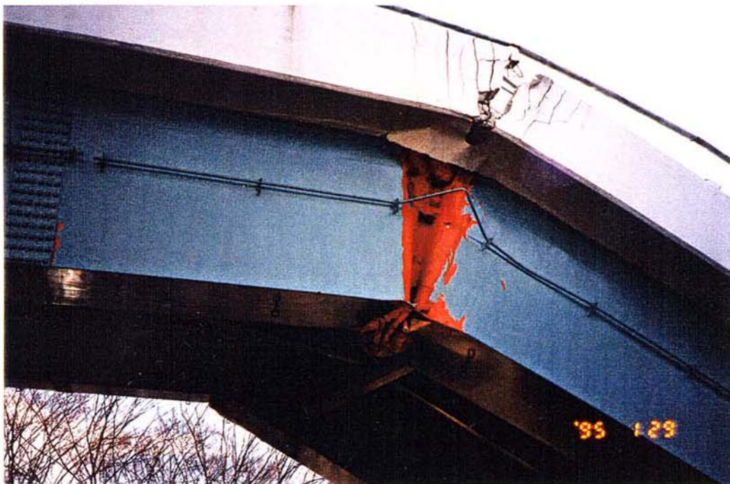
写真3.2.8 合成桁の破壊
