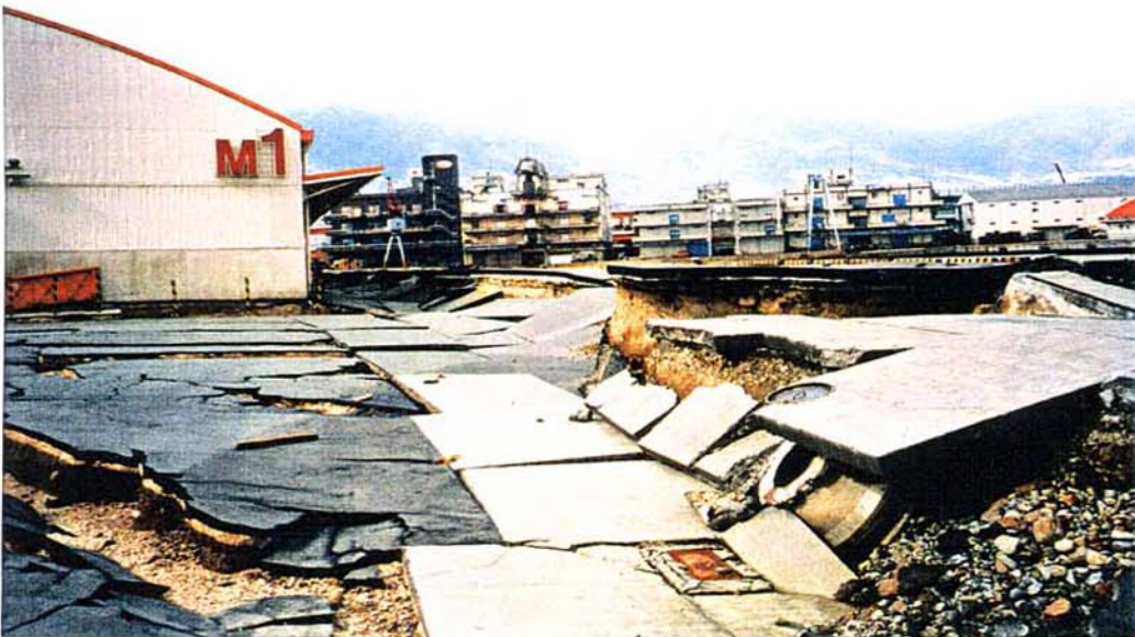
写真3.1.4 地盤沈下(周辺部)
