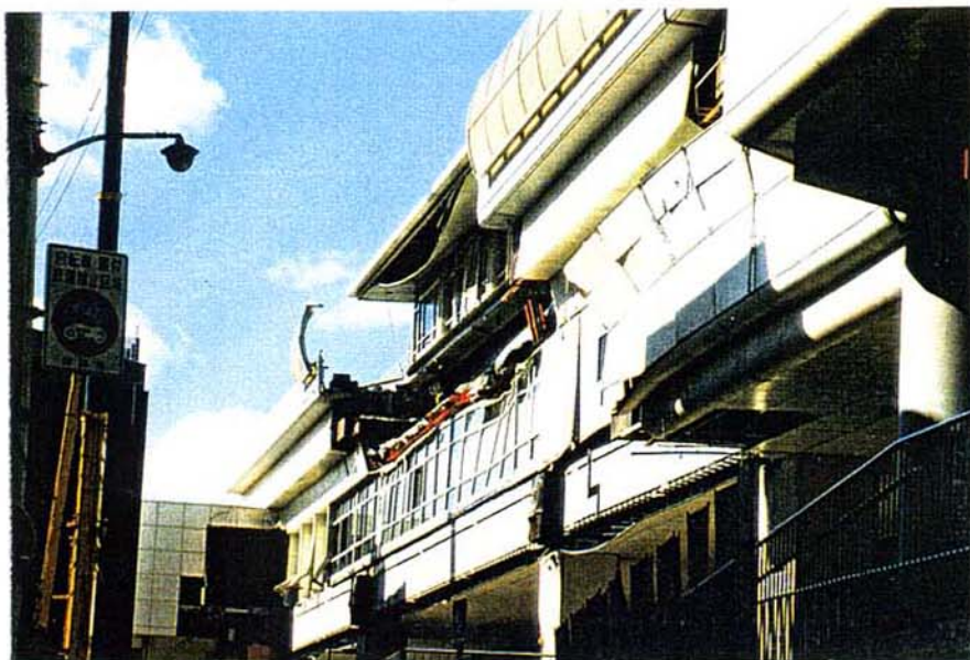
写真 3.3.42 神戸新交通 六甲ライナー 住吉駅 軌道桁・連絡通路落下 (落下桁撤去済)
