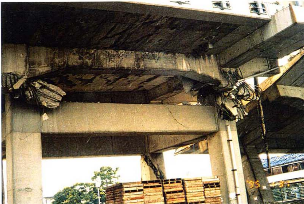
写真 3.3.8 同 上 (橋脚中間梁上にて破壊)
