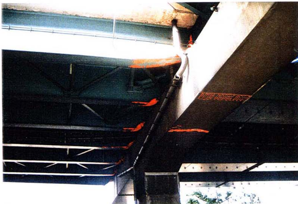
写真3. 2. 9 桁固定端の過大変形
