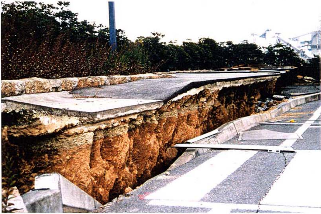
写真3.1.3 地盤沈下(内部)
