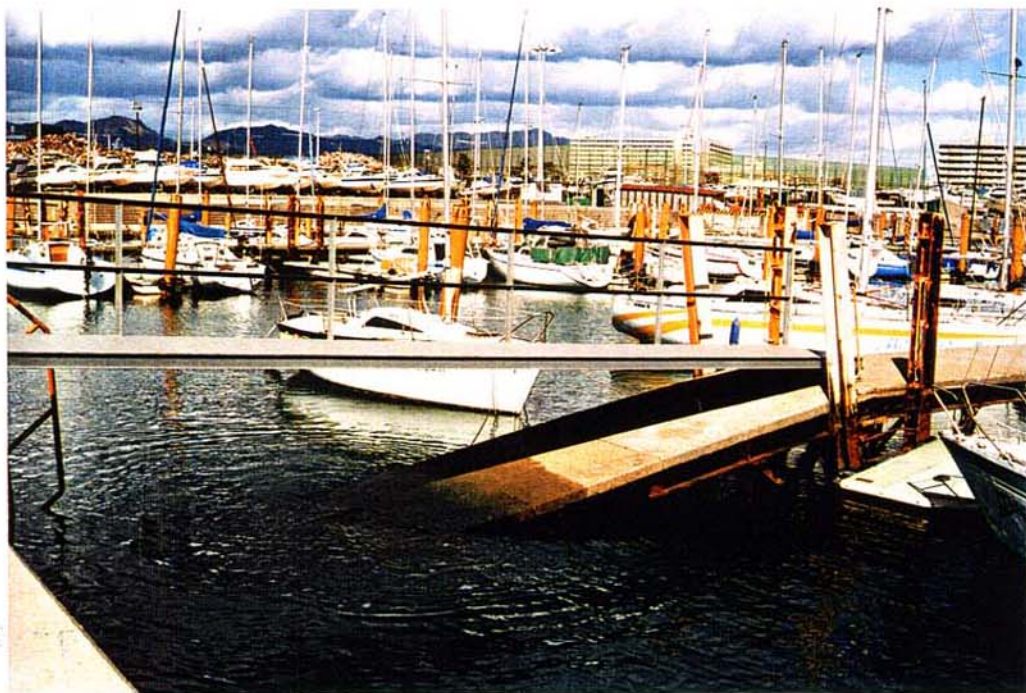
写真 3.4.14 渡り栈橋の落下 垂水フィッシャリーナ
