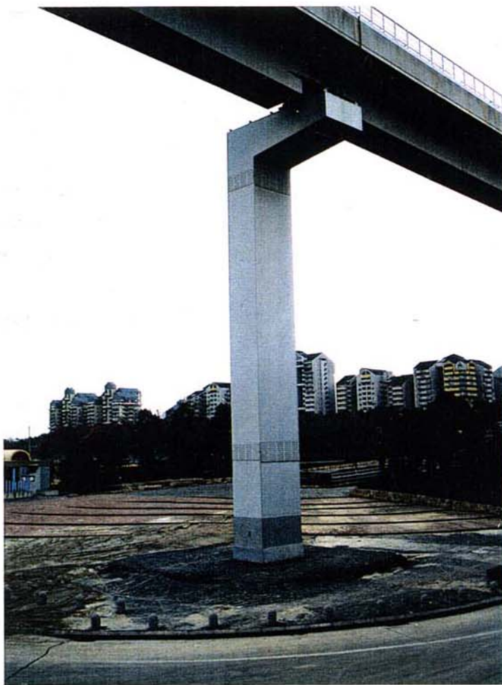
写真 3.3.50 神戸新交通 六甲ライナー 六甲アイランド内 地盤の液状化による沈下 に伴う橋脚基礎部突出状況
