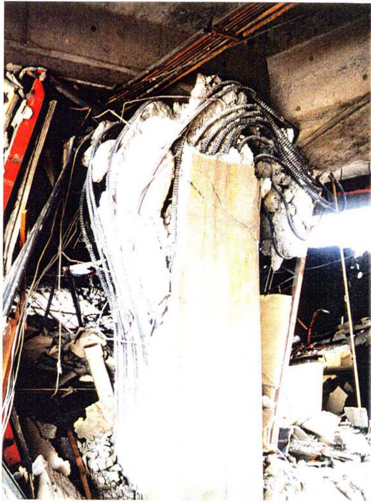
写真 3.3.19 阪神電鉄 RC 橋脚破壊状況
