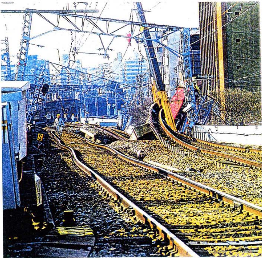
写真 3.3.37 神戸高速鉄道 軌道破壊およびPC桁落下状況 「日経コンストラクション」 (1995.2.24)
