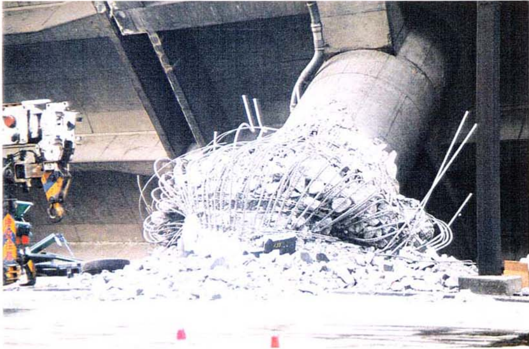
写真3.2.3 提灯座屈した橋脚
