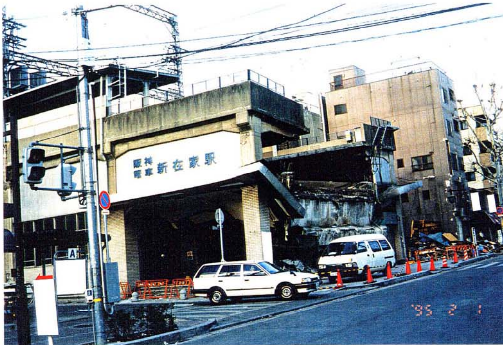
写真 3.3.22 阪神電鉄新在家駅 被災状況 (落下橋梁撤去済)
