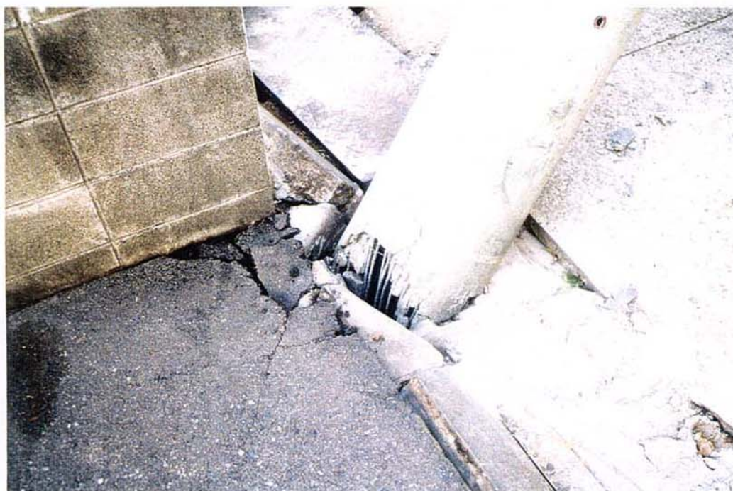
写真 3.6.2 折損した配電柱
