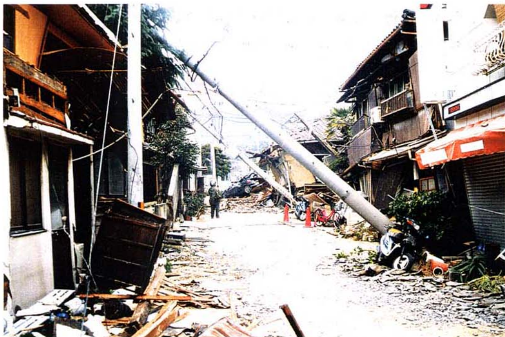
写真 3.6.1 軒並み倒れる配電柱
