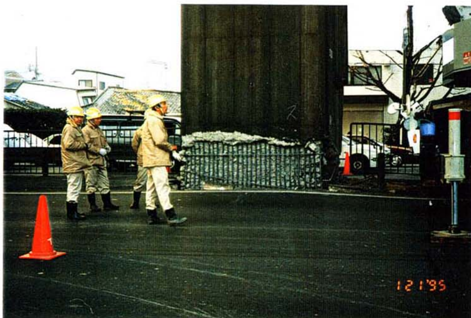
写真4.2.10 P203 ランク D (根元部一部破壊)
