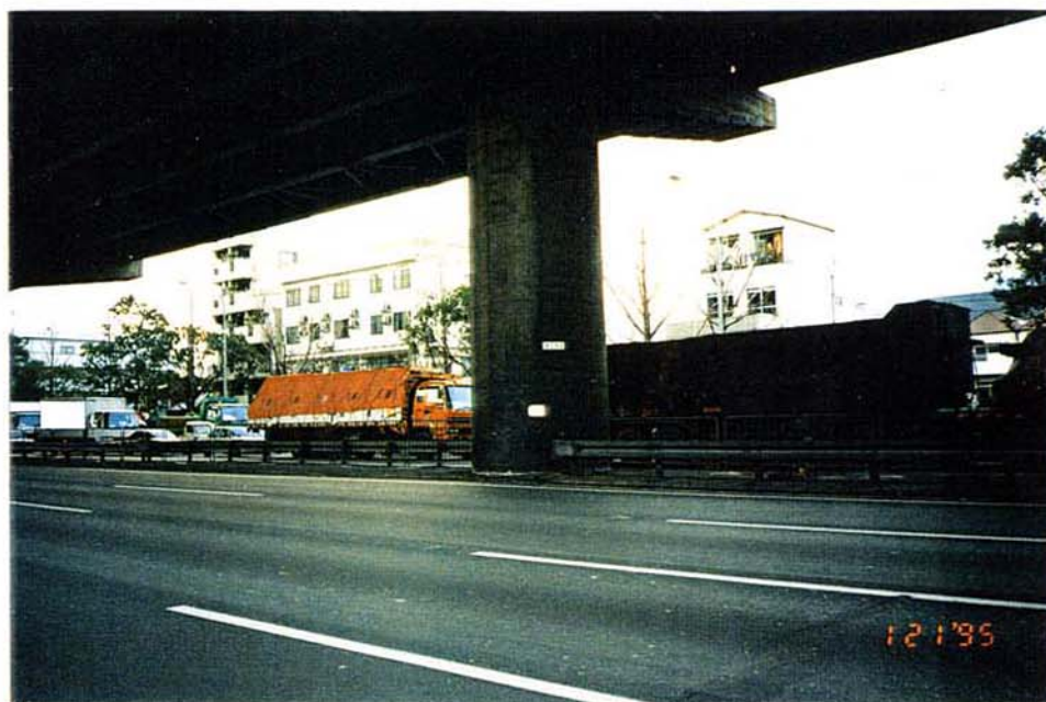
写真4.2.6 P199 ランク C (根元部クラック, 一部破壊)
