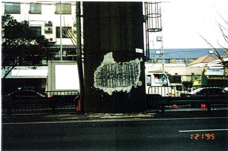
写真4.2.7 P200 ランク B (根元より1~1.5m鉄筋露出, 曲り)
