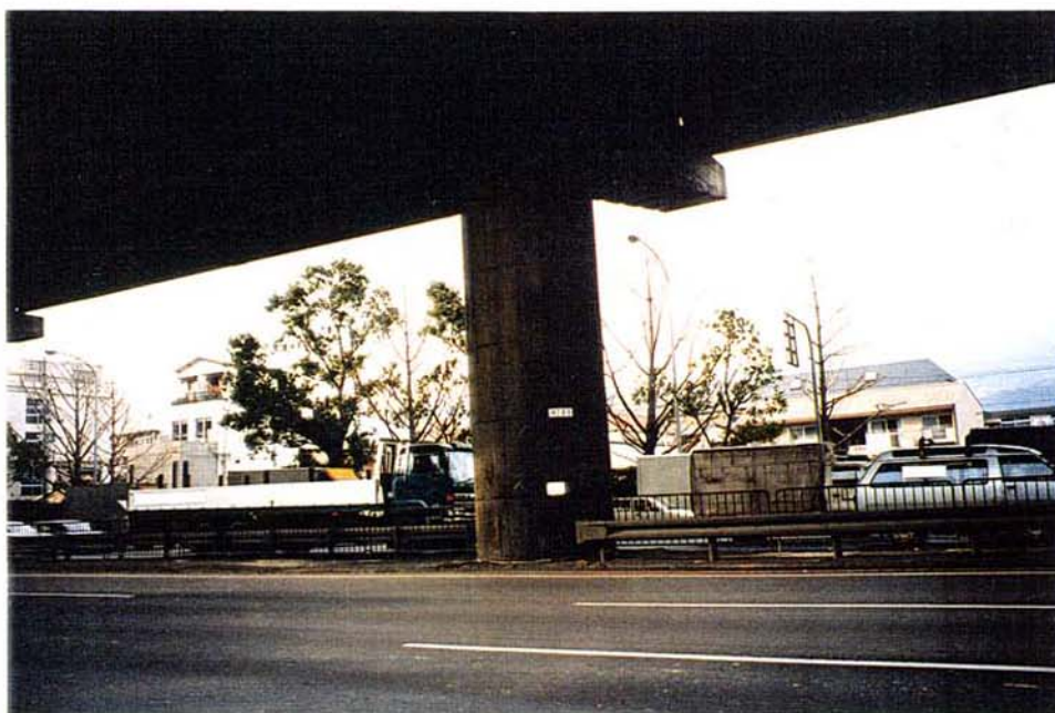
写真4.2.5 P198 ランク E (根元部クラック)
