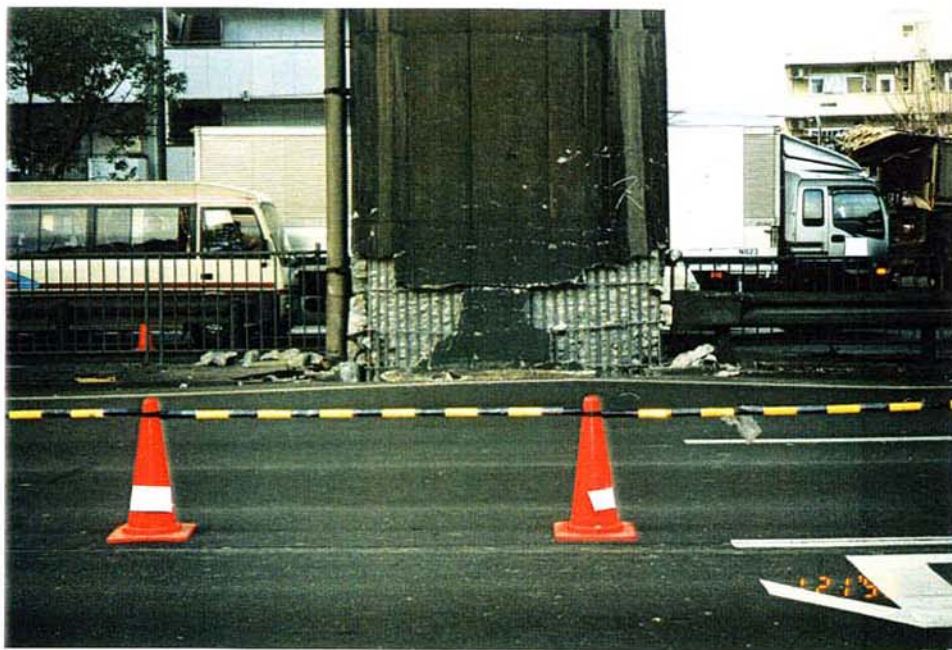
写真4.2.9 P202 ランク B (根元部破壊, 傾斜)
