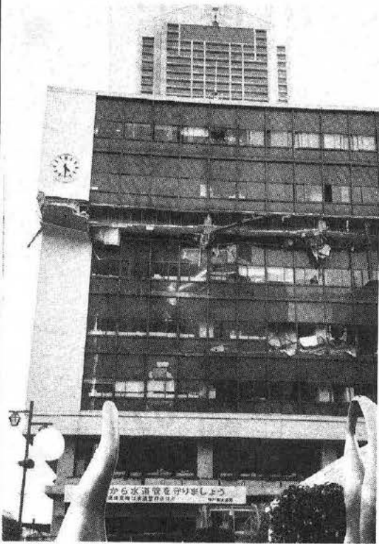
◀ワンフロアが押しつぶされた旧神戸市庁舎(神戸市中央区)
