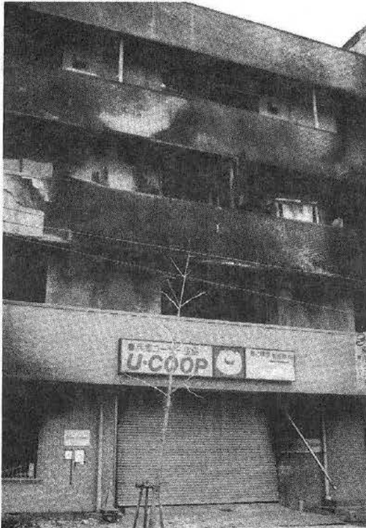
兵庫ユニバー生協が全壊しました(神戸市須磨区)
