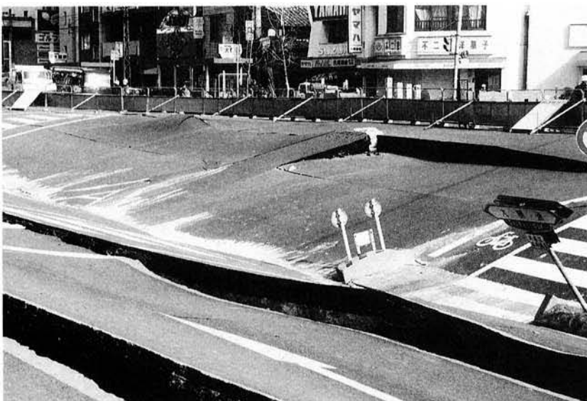
▼地割れをおこした道路
