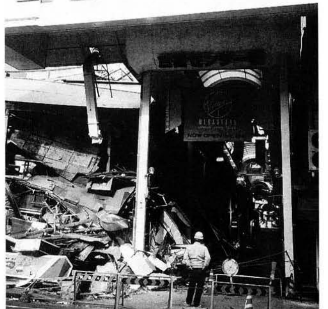
▲店舗が倒壊している三宮センター街
