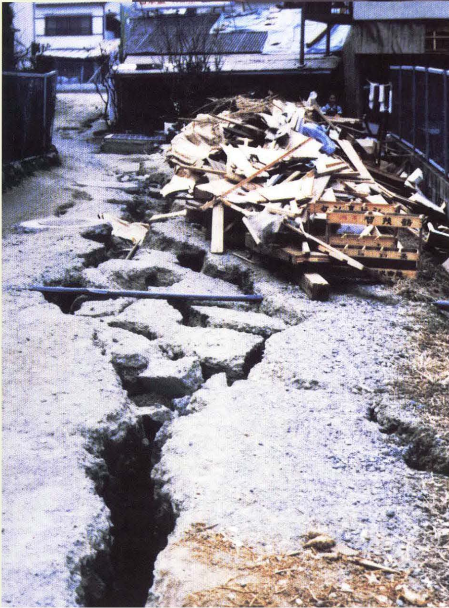
◀地割れを起こした道路
