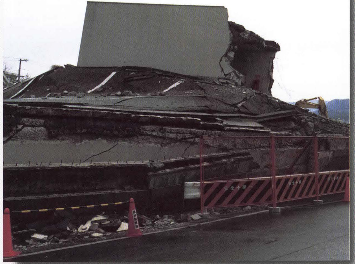
▲全壊した2階建駐車場
