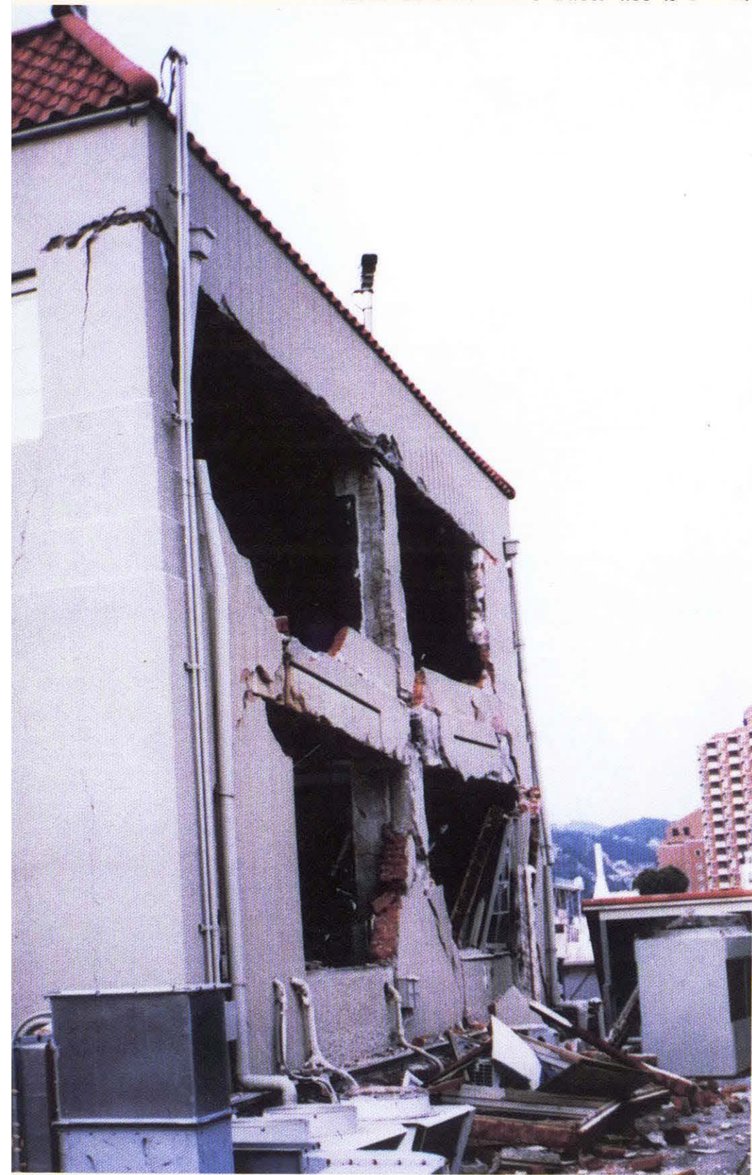
▼被害を受けた宝塚歌劇大劇場の一部
