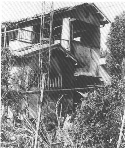
建物東側の焼損
