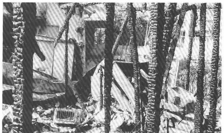
火点北側柱の焼損
