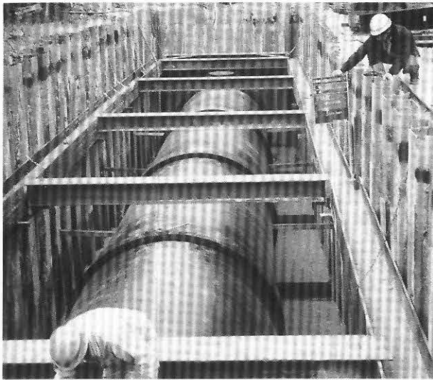
飲料水兼用耐震性防火水槽（100m 3 級）
