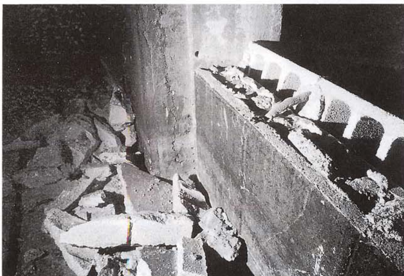
〈武庫川浄水場 配水池整流壁の倒壊〉
