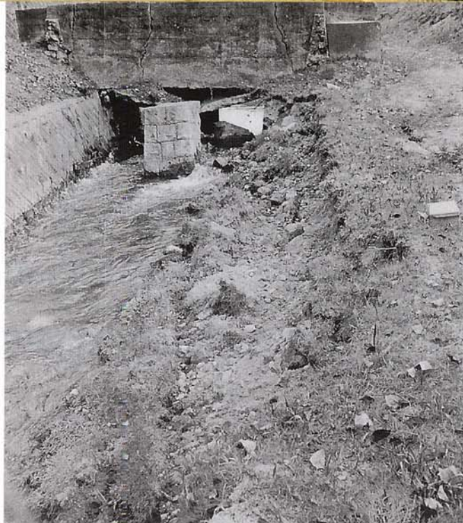
〈百間樋取水場 長持中樋門の破損及び水路護岸の崩壊〉
