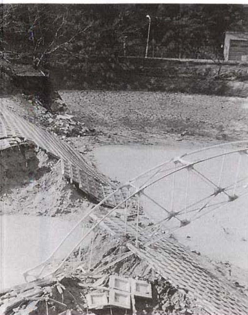
〈ニテコ池貯水池 中・下池間堤体の崩壊〉
