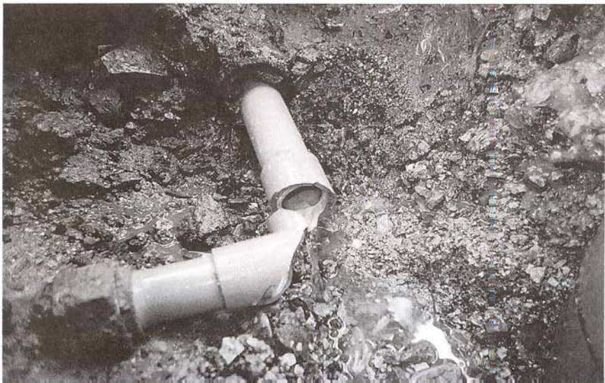
〈TSVPエルボ φ 30の破損〉
