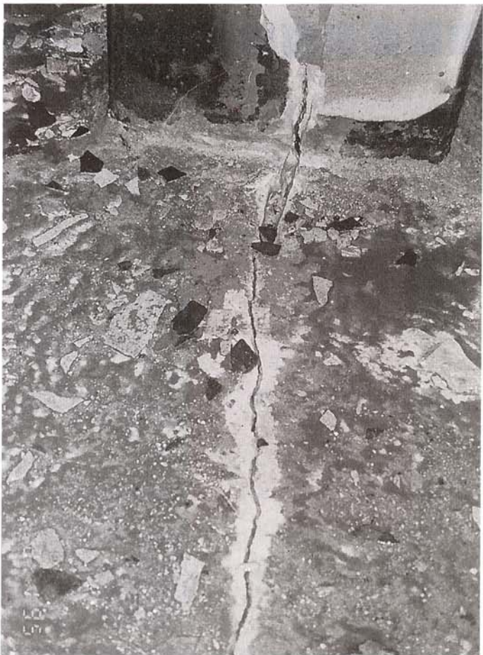
〈越水浄水場 第1配水池内底部にクラック発生〉
