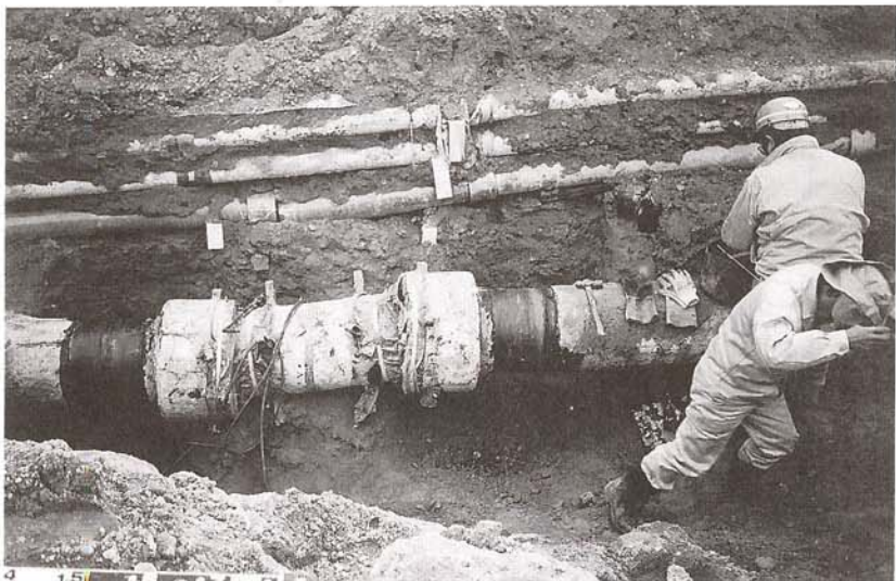
〈人口島への連絡橋接続部における可とう管の破損〉
