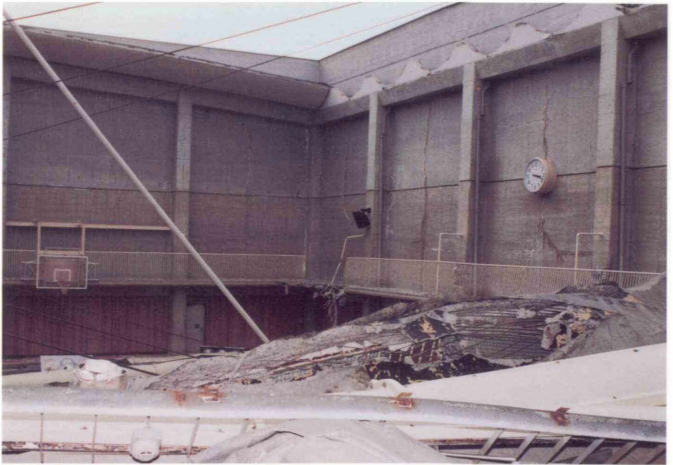
市立体育館の屋根が落下 (H7. 1. 27撮影)
