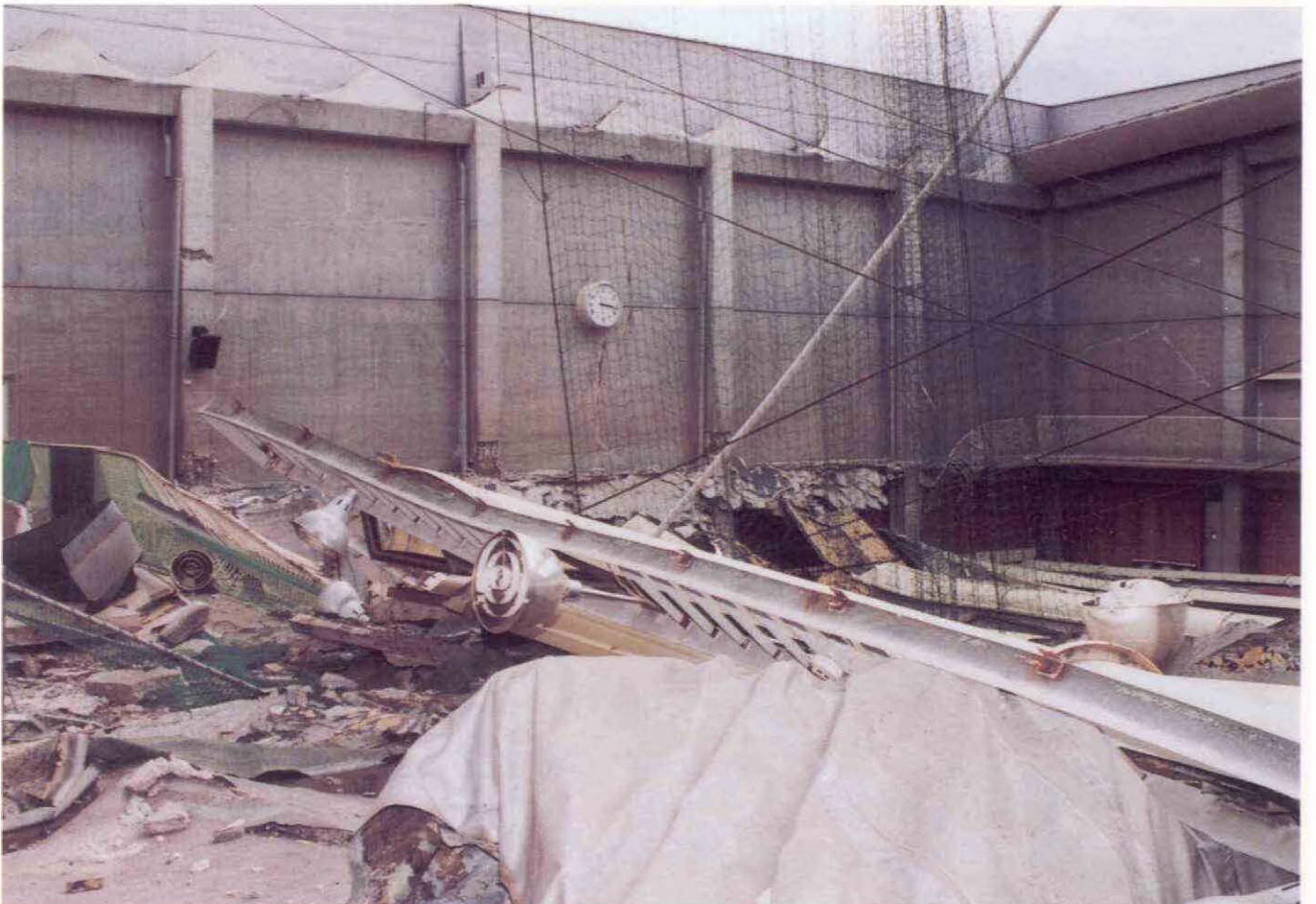
市立体育館の屋根が落下 (H7. 1. 27撮影)
