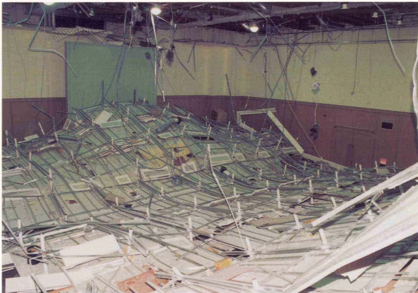
南館 3 階の市議会議場の天井が落下 (H7. 3. 14撮影)
