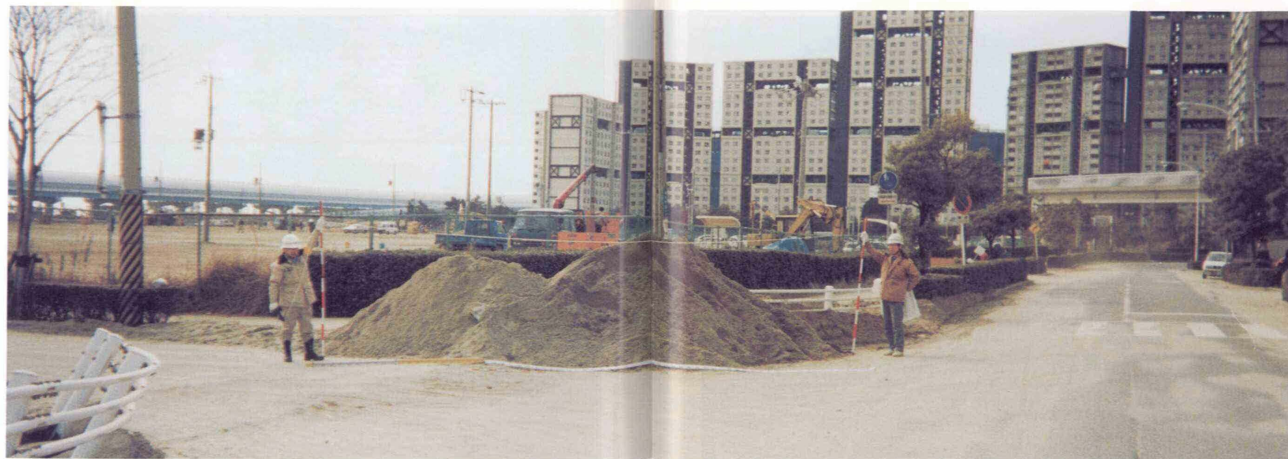
芦屋浜地区液状化
