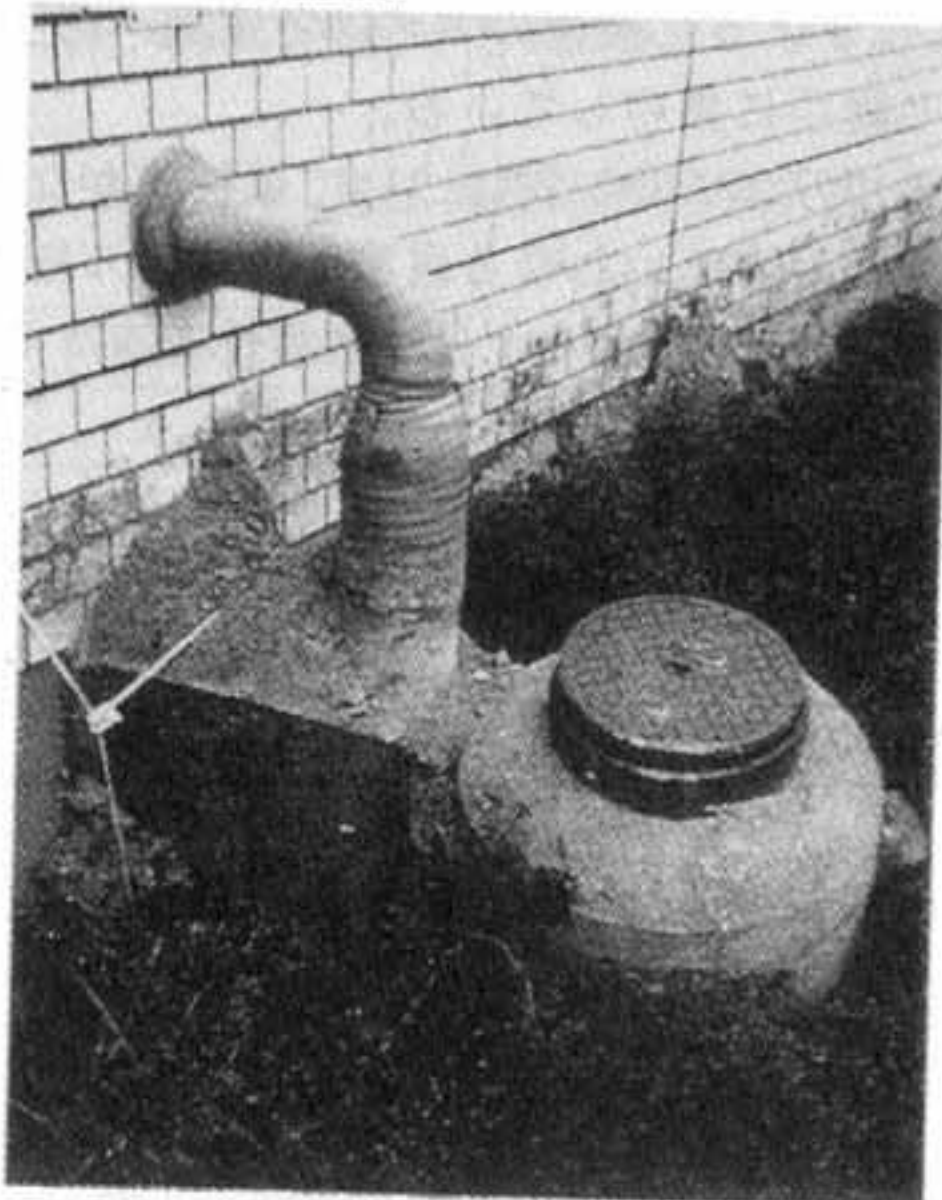
図 8-6-5 地盤沈下を吸収したSGM伸縮継手 (グラビア参照)
