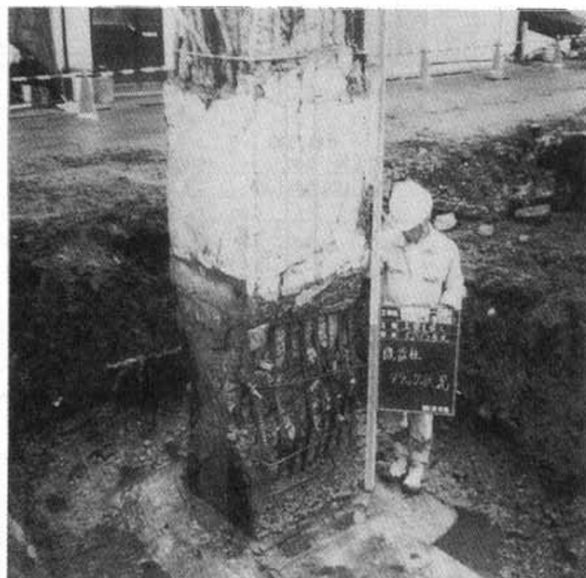
写真 10-1-3. 柱下端部におけるせん断破壊
