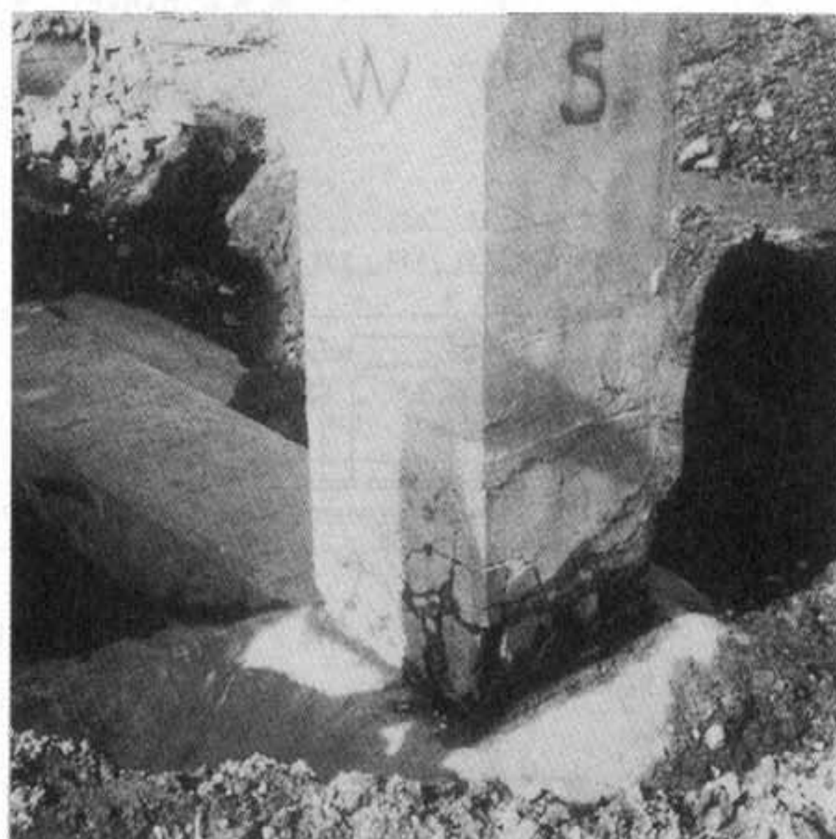
写真 10-1-2. 柱下端部の網目状クラック
