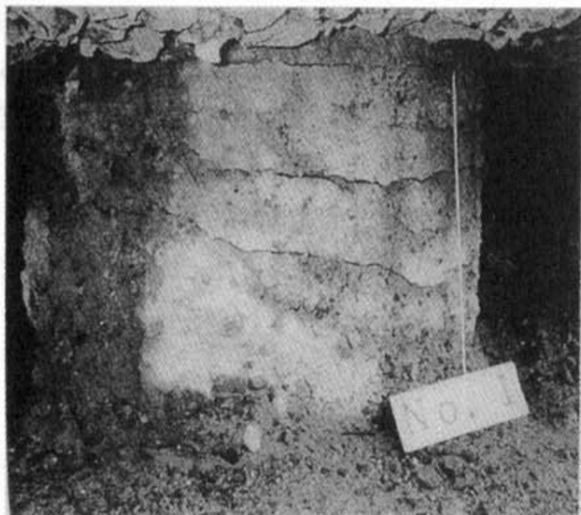
写真 10-2-9 載荷試験終了後の試験杭の損傷状況
