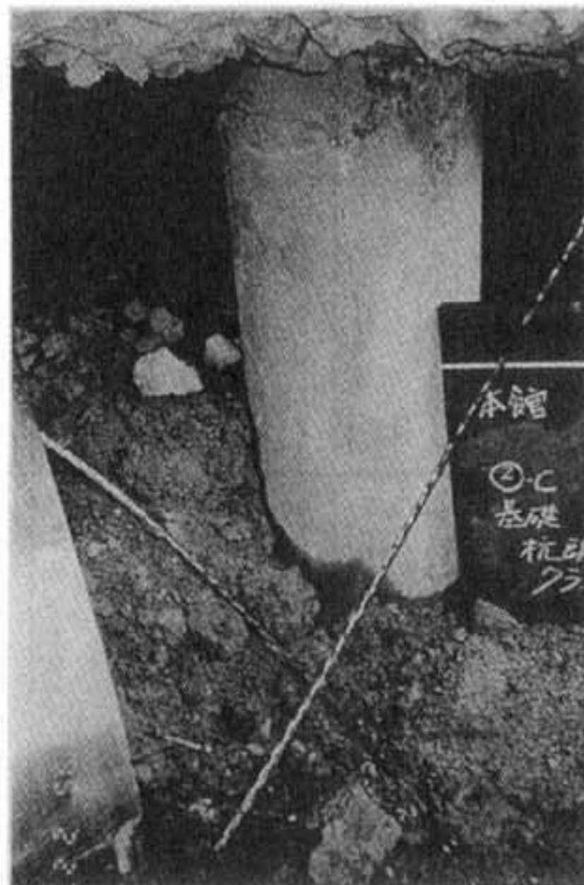
写真4 杭の縦ひび割れ
