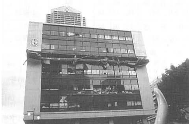
中間層の層崩壊が生じるパターンが目立った
