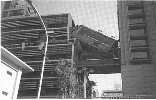
市役所2号館6階部分が圧壊、渡り廊下は崩壊
