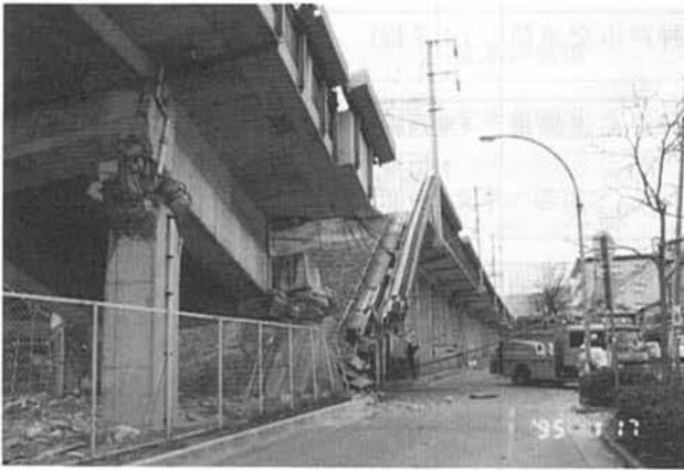
破壊された新幹線高架橋
