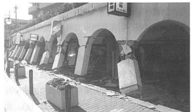
木造、鉄筋コンクリート造等問わず被害は大きかった
