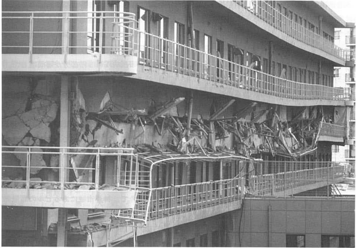
5階部分が層崩壊した西市民病院
