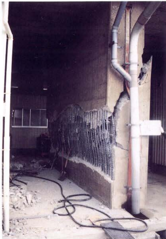
写真 - 3.29 固定橋脚のせん断破壊
