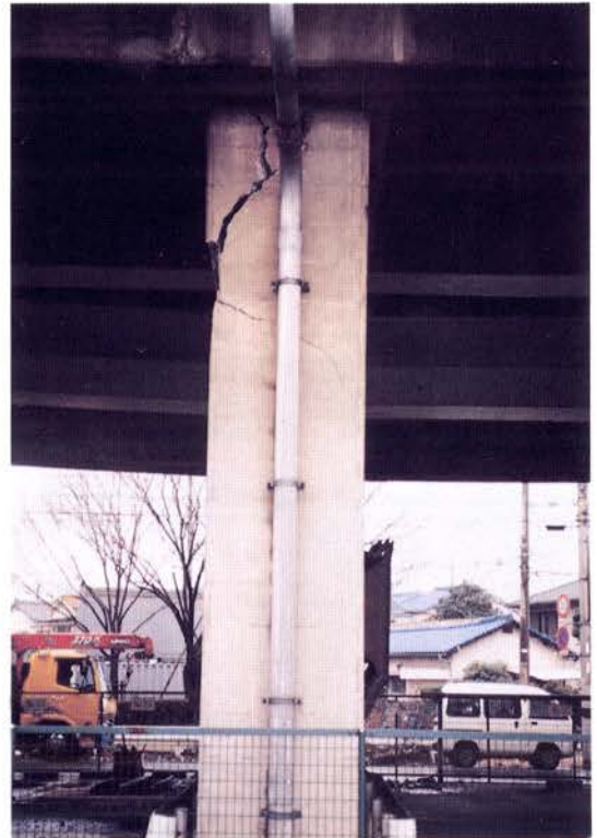
写真 - 3.30 固定橋脚の頭部せん断破壊
