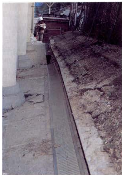
体育館西側の傾斜面の盛り上がり変形により、体育館（避難所）の柱基礎が破壊している。 写真 - 9.47
