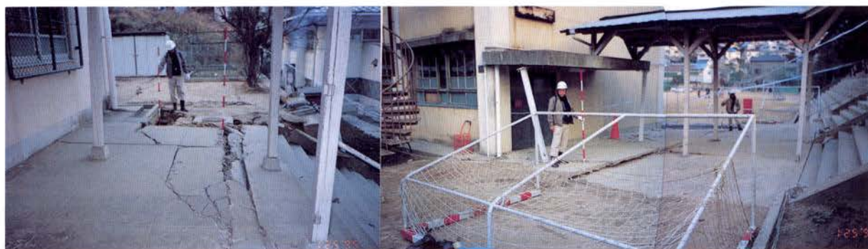
体育館と教室の渡り廊下に入った亀裂は、階段を経由して校庭に向かっている。校庭では、液状化現象が見られる。
