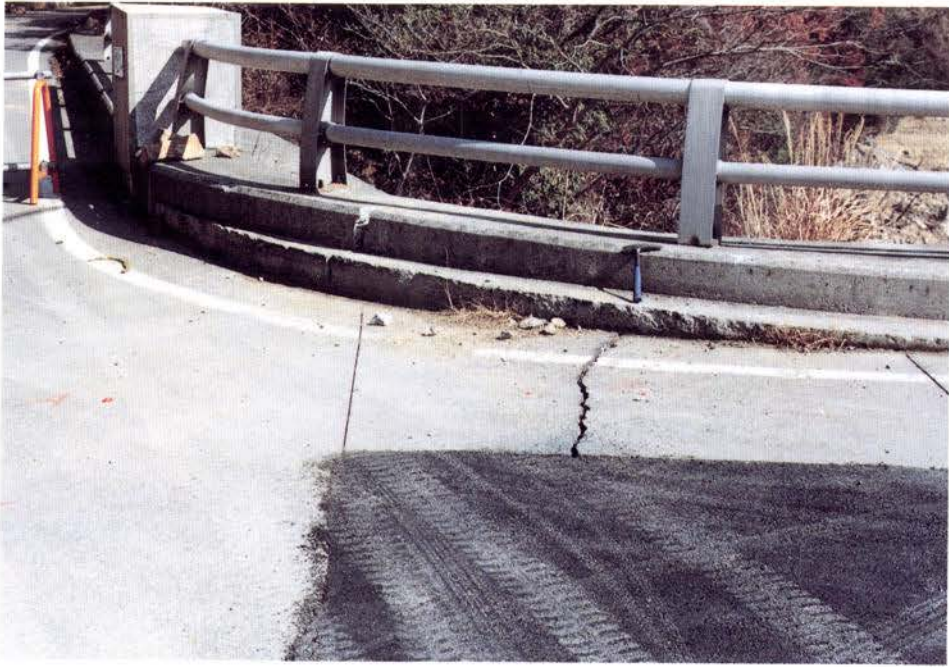
写真-8.1 Tダム天端のクラック
