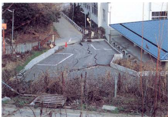
亀裂は十数本、すべて長田断層に平行し、連続性が見られる。亀裂に囲まれている体育館（避難所） 写真 - 9.45
