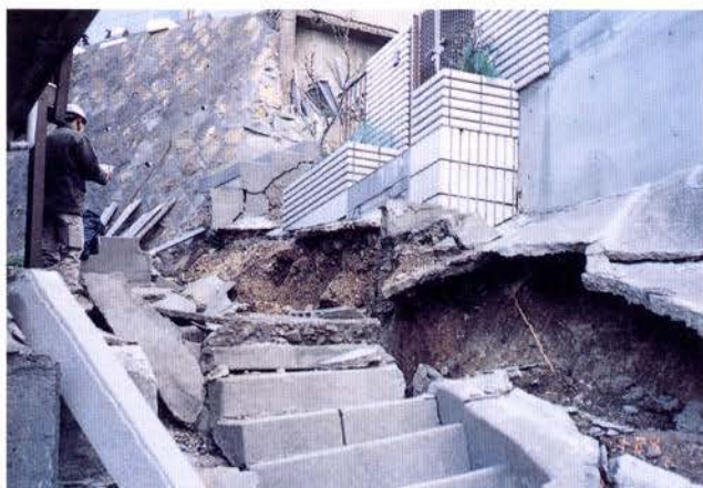
写真-9.42 基礎地盤が、1.2 m程度沈下、家屋は5°程度傾斜している。生活道路の階段が破壊し、通行不能。
