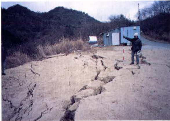
写真-9.7 上写真の法枠工上部に発生したクラック
