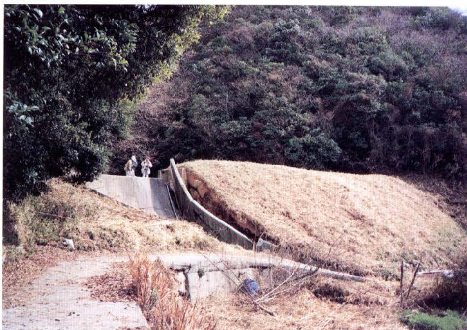
写真-8.6 断層上に余水吐のあったダムの被害
