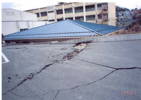
体育館西側に存在する卓越した亀裂。 写真 - 9.46
