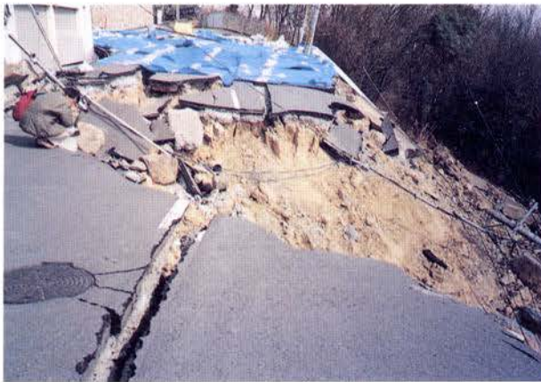
写真-9.19 台地面先端部での崩壊。 道路が崩落している。
