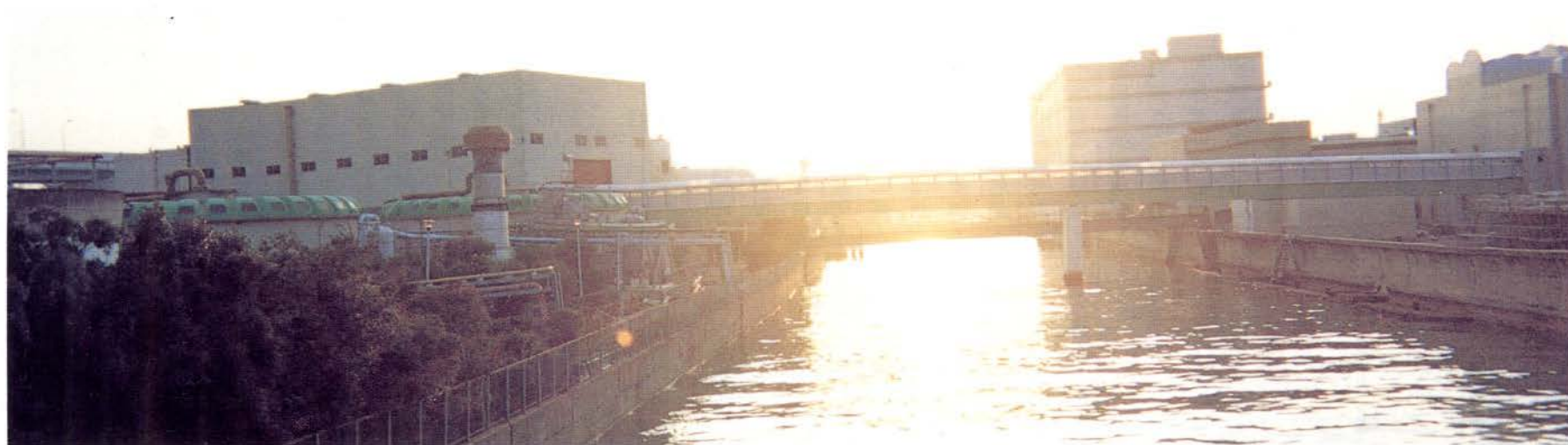
写真-12.4 左岸の護岸が運河側に大きく移動した。 右岸の護岸は数10cmの移動があった。
