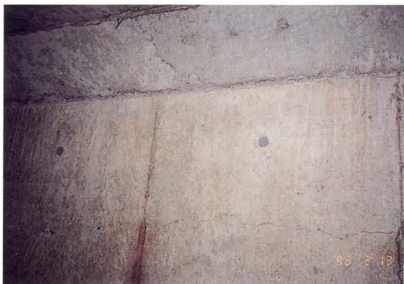
写真-6.11 神戸市海岸通り 七丁目付近
