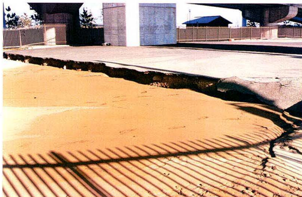
写真2 埋立地における液状化 による噴砂 高速道路の橋脚が見え ている
