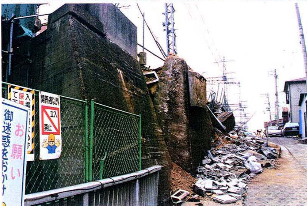
写真3 重力式擁壁の 移動
