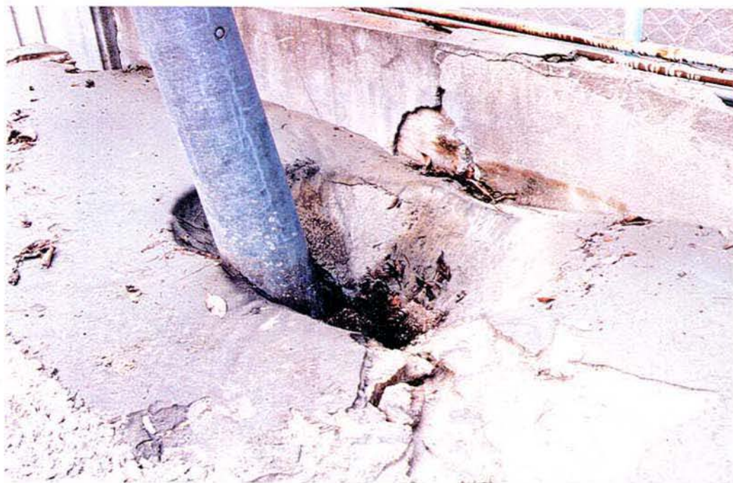
写真1 液状化による噴砂と 電柱の傾斜
