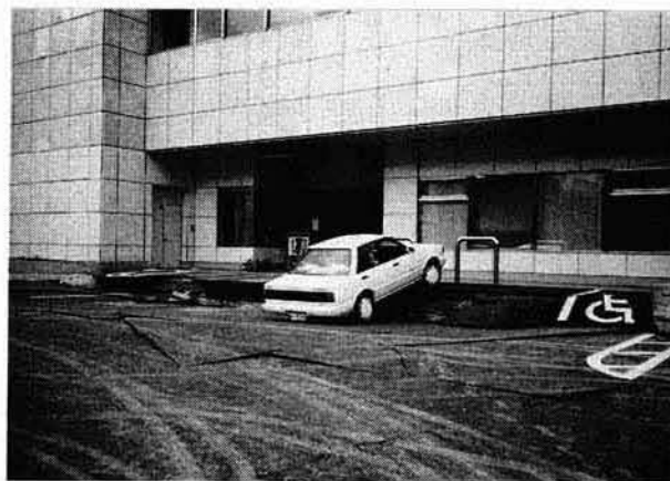
写真① 救急入口前の地盤沈下
