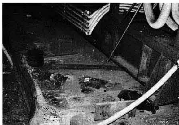
写真② スクリュー冷凍機の横ずれ
