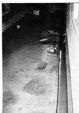
廊下の液状化の泥水
