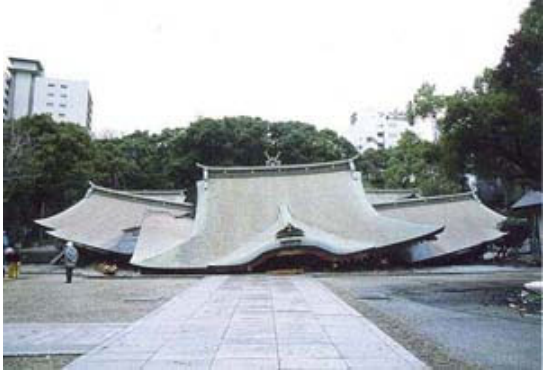
拝殿の屋根が落ちた生田神社
