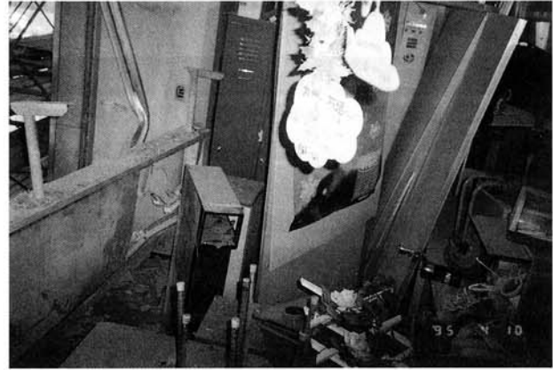
97年4月1日午前には什器備品等整理のため立ち入り。窓はゆがみ、壁も崩れて埃が舞い散り、瓦礫を踏んでの復旧作業となった。
