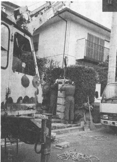
全日空団地付近の塀の損壊
