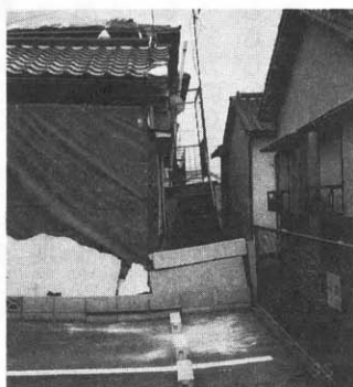
弁木さん方、駐車場と塀の損壊
