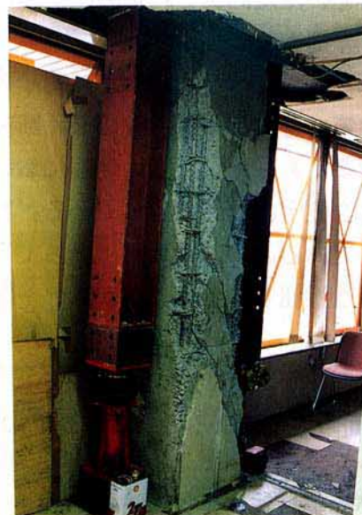
写真 3.2.1.62 SRC柱の付着割裂破壊
