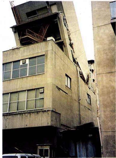
写真 3.2.1.23 ペントハウスの転倒
