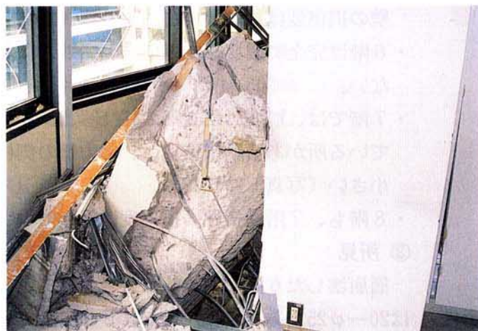
写真 3.2.1.47 7階床スラブ（D構面、8通り）上に突出した6階柱（写真3.2.1.46の5階柱に比べ柱主筋が極めて少ない）
