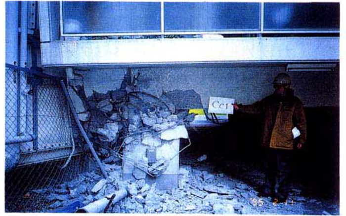
写真 3.2.1.52 1階柱のせん断破壊（C 61 ）
