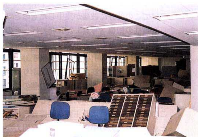
写真 3.2.1.48 7階柱の被害状況（全景）（5階、7階の柱の損傷は小さい）
