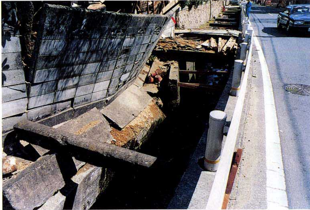
写真3. 2. 3. 12 造成地の移動による被害
