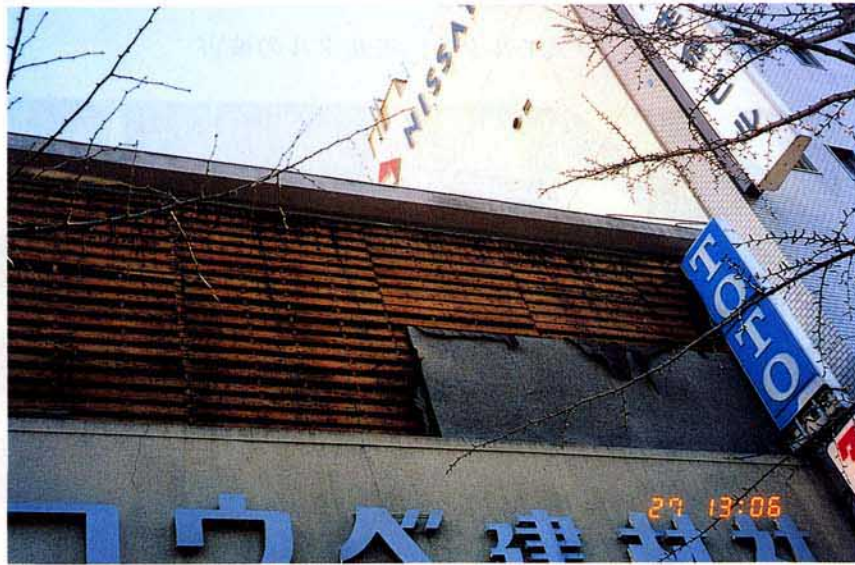
写真 3.2.4.12 ラスモルタル木ずり下地の脱落
