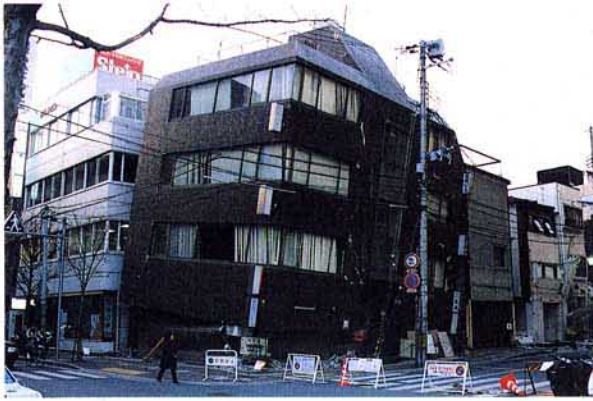
写真 3.2.1.1 4Fビル ・1階隅柱のせん断破壊による崩壊
