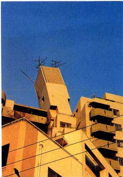
写真 3.2.1.22 ペントハウスの転倒
