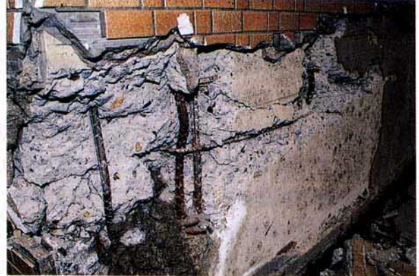
写真 3.2.1.64 鉄骨継手の破断
