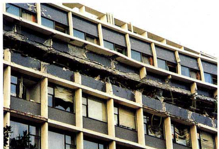
写真 3.2.1.25 セットバックの影響による層崩壊
