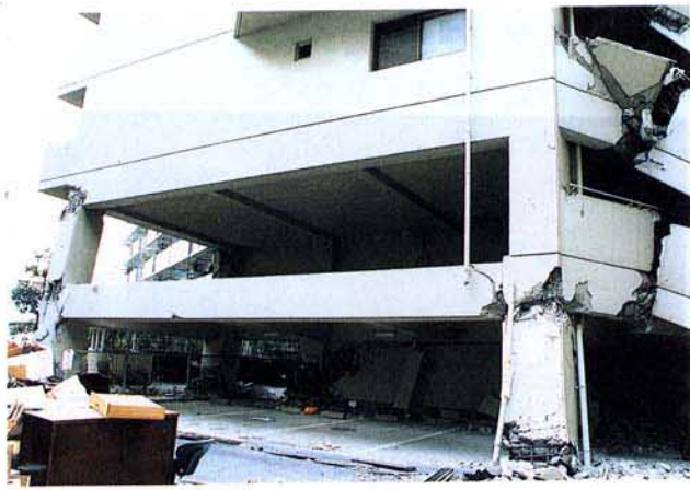
写真 3.2.1.33 柱頭・柱脚部の破壊
