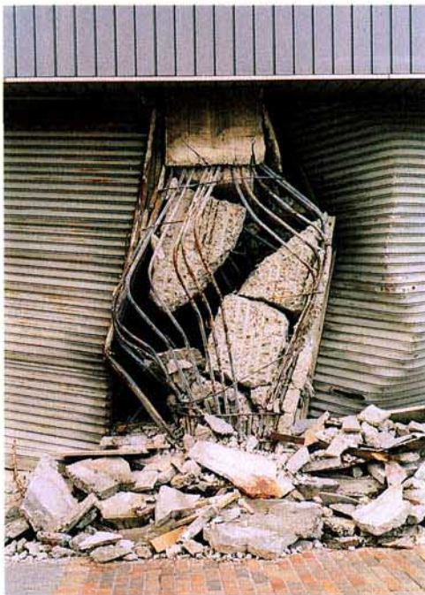
写真 3.2.1.29 柱のせん断破壊
