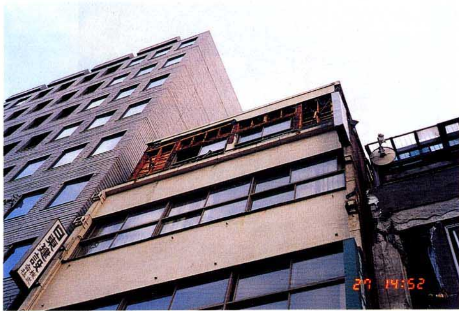
写真 3.2.4.11 ラスシートモルタルの全面脱落
