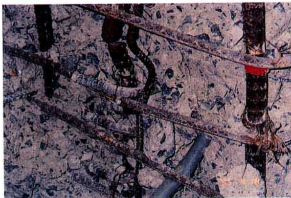
写真3.2.1.75 破断した圧接と破断していない圧接
