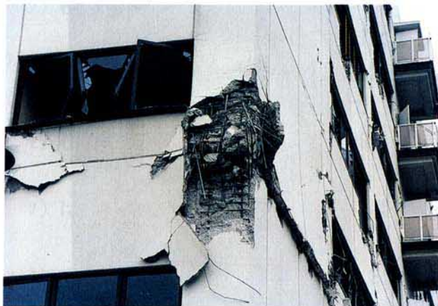
写真 3.2.1.9 7階建て（PH1階）のRC造社屋 ・注脚部のせん断破壊及び耐震壁脚部の破壊
