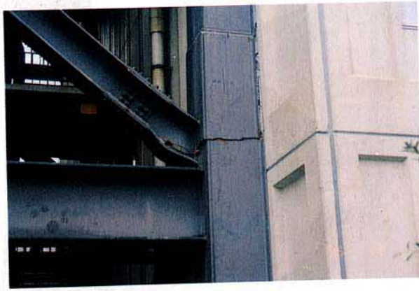
写真3.2.2.16 M建物 箱形断面の鉛直材と筋かいの破断
