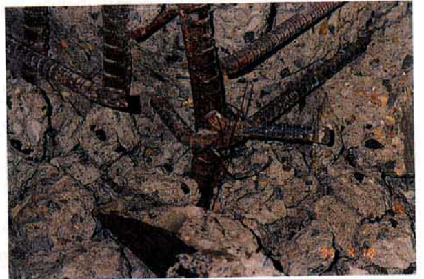
写真3.2.1.71 鉄筋末端部において折り曲げ部が破断している例
