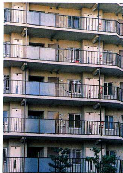
写真 3.2.1.66 非構造壁の被害
