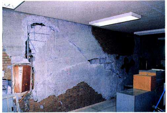
写真 3.2.1.4 3階建てSRC造庁舎 ・7階の耐震壁のせん断破壊
