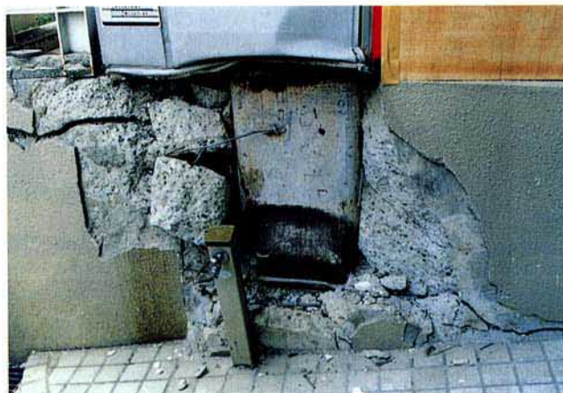
写真 3.2.2.6 E 建物 上階の筋かいを受ける柱に局部座屈発生後、引張力の作用による破断が生じている。周辺コンクリートが落下。
