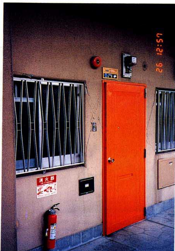
写真 3.2.4.6 1F 雑壁斜めひび割れのために鋼製玄関ドアが開閉不能となった
