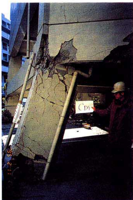
写真 3.2.1.53 1階柱の曲げ破壊（C 64 ）
