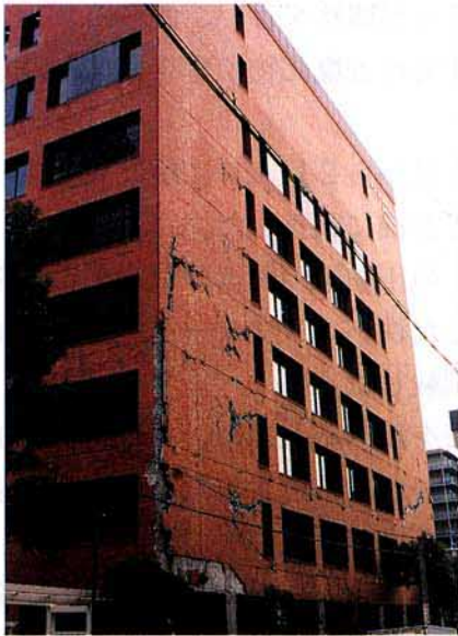
写真 3.2.1.65 壁筋の定着破壊
