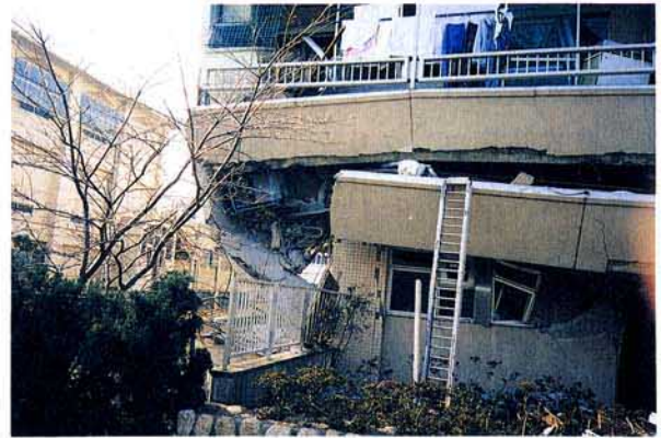
写真 3.2.1.5 RC造7階建て共同住宅 ・2階の層崩壊 1階部分は壁が上階に比べて多い 1階柱、壁にはせん断破壊が見られた
