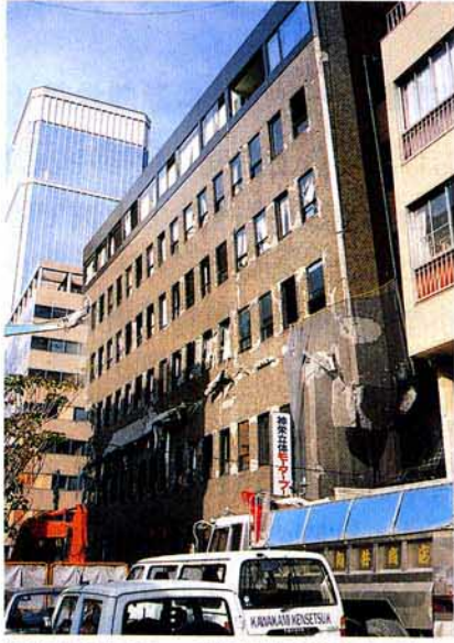
写真 3.2.1.58 7階建事務所ビルの被害
