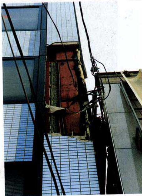
写真3.2.2.17 O建物 衝突により仕上げ材の脱落
