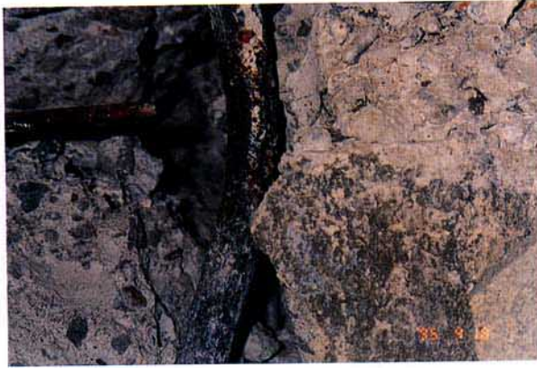
写真3.2.1.67 せん断補強筋が腐食して切断された例
