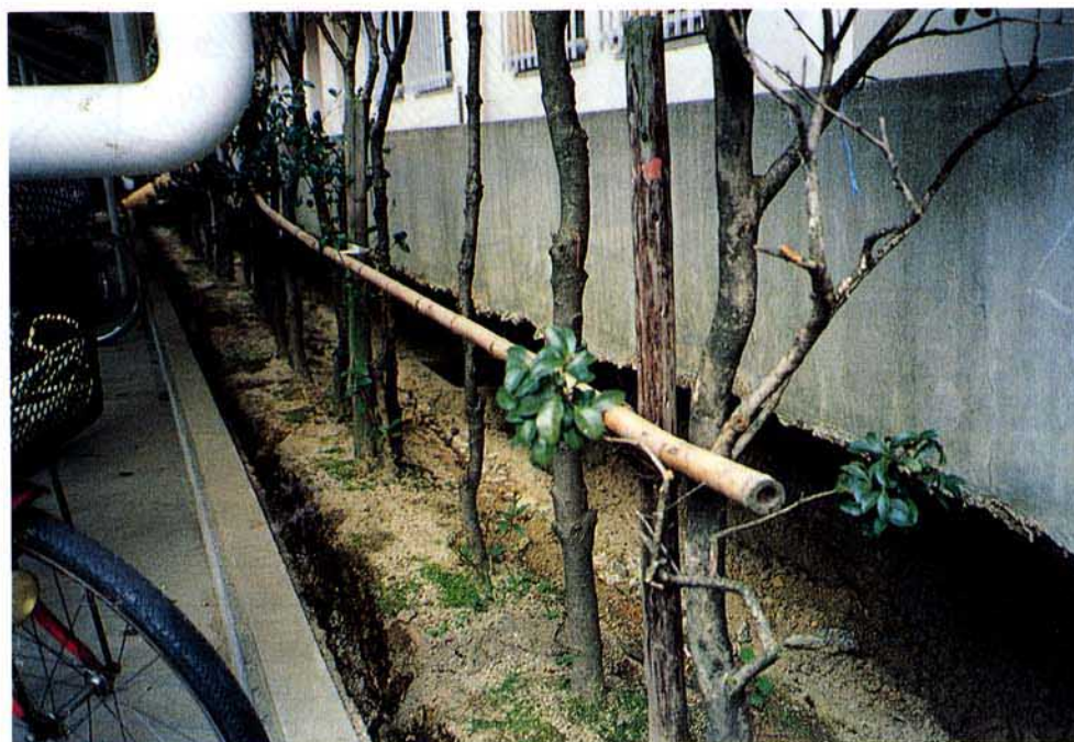
写真3. 2. 3. 1 杭基礎建物 (SRC11F) の被害
