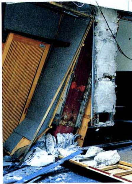
写真 3.2.2.4 C 建物 中柱は大きな層間変形を受け傾斜している。基礎の根巻き部分は大破。
