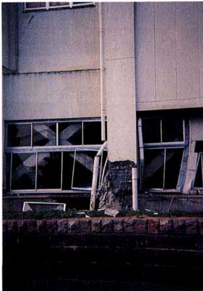
写真 3.2.1.8 4階建てのSRC造事務所建物 ・柱脚部のアンカープレート下端で、北側に 柱成の半分ほどがずれている
