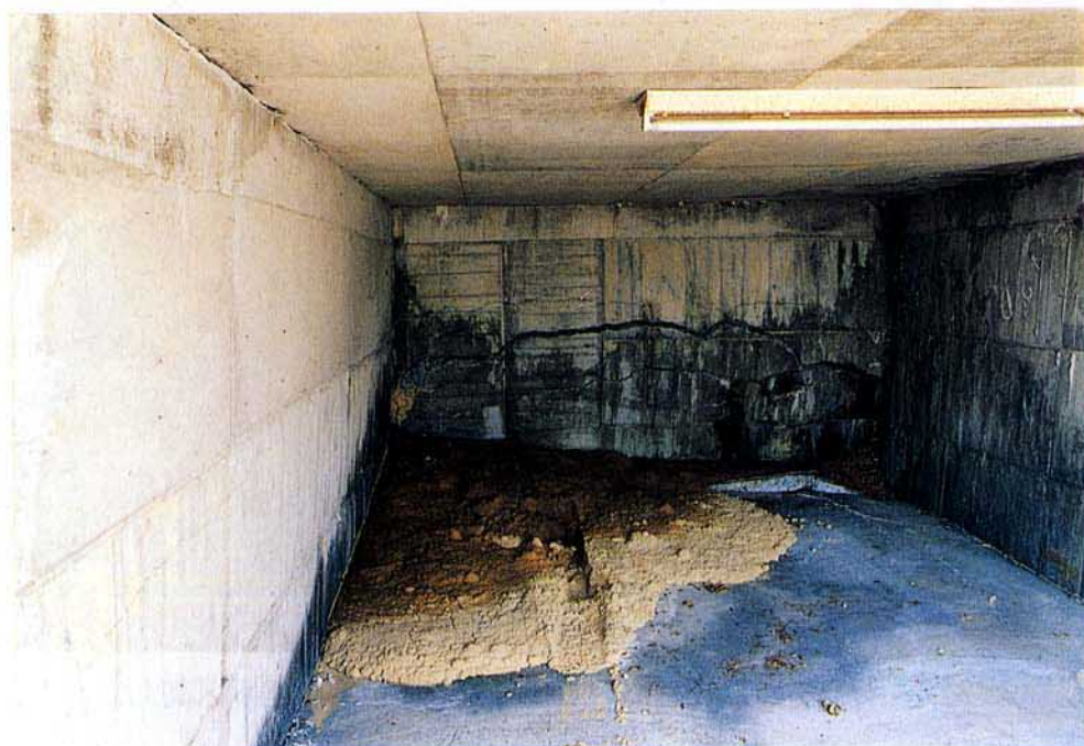
写真3. 2. 3. 15 埋設車庫内の流出土砂（芦屋市剣谷）
