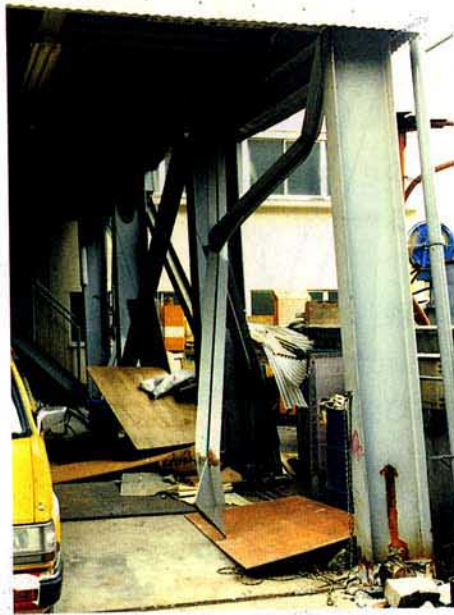
写真3.2.2.14 K建物 1階筋かいを受けるガセットプレートが柱のウェブから引きちぎられ破断した
