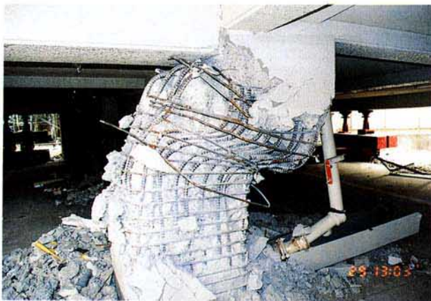
写真 3.2.1.31 柱のせん断破壊
