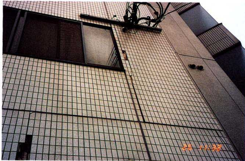
写真 3.2.4.18 ALC帳壁縦壁挿入筋工法を下地としたタイルのひび割れ・剥落（ALCの目地部）
