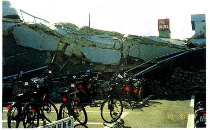
写真 3.2.1.28 パンケーキ状の崩壊
