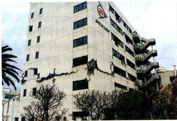
写真 3.2.1.60 比較的新しい事務所ビルの被害
