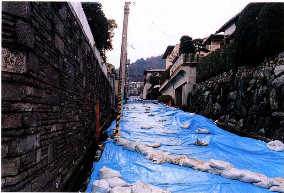
写真3. 2. 3. 11 西岡本道路の亀裂（シート保護）
