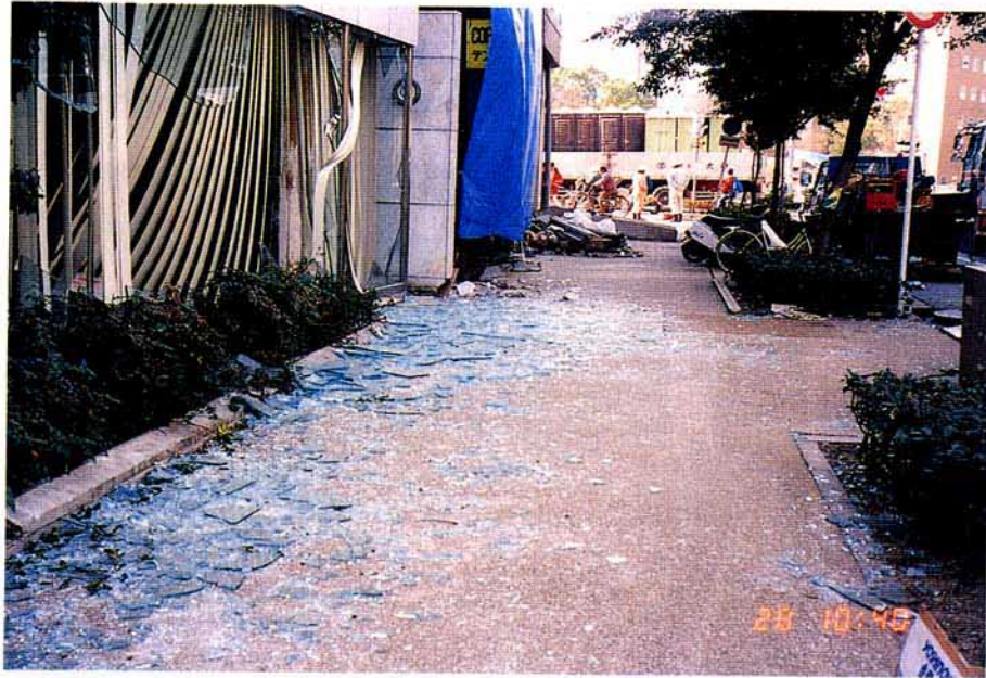
写真 3.2.4.3 破損したガラスの散乱状況
