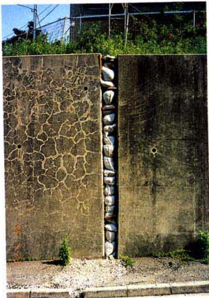
写真 3.2.1.11 擁壁の移動 (約15cm)
