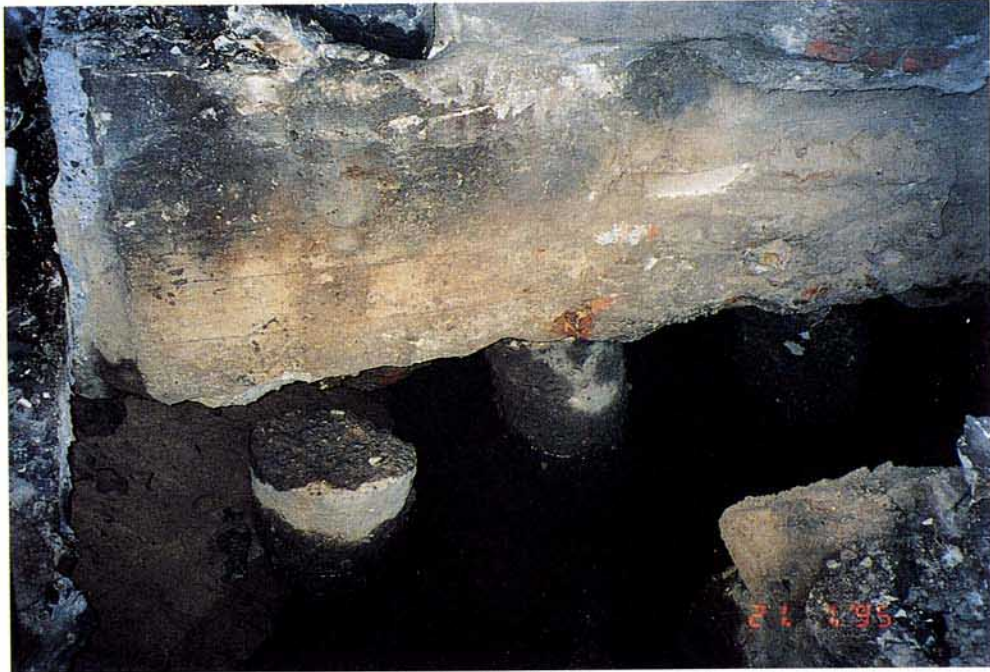
写真3. 2. 3. 6 杭基礎（無筋現場造成杭、 \phi 300 ）の被害状況
