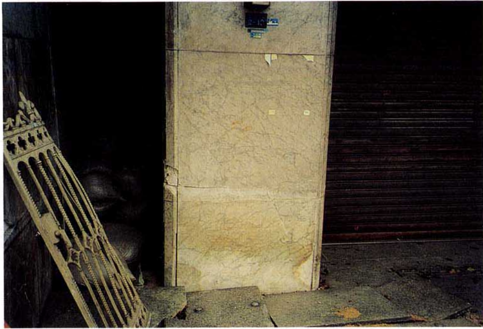
写真3. 2. 3. 8 直接基礎（RC9F）の被害状況
