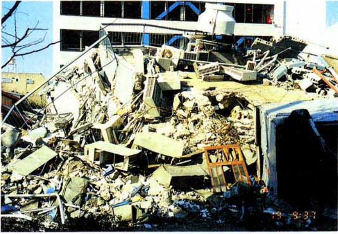
写真 3.2.1.27 パンケーキ状の崩壊
