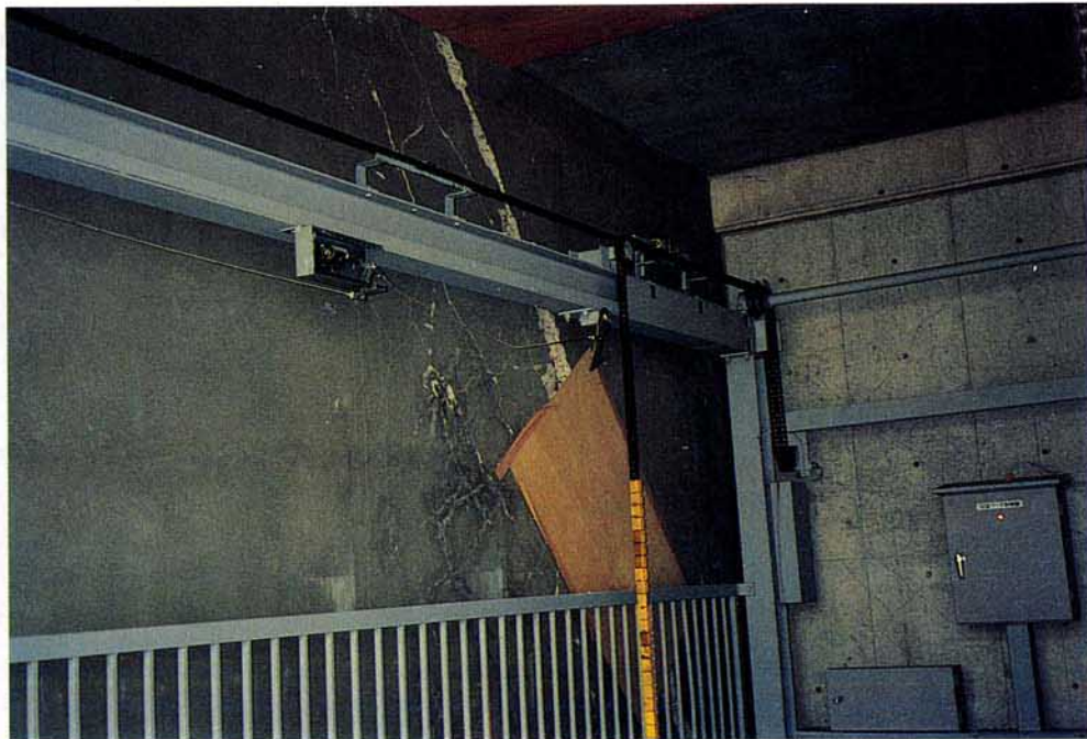
写真3. 2. 3. 7 直接基礎（RC10F）の被害状況
