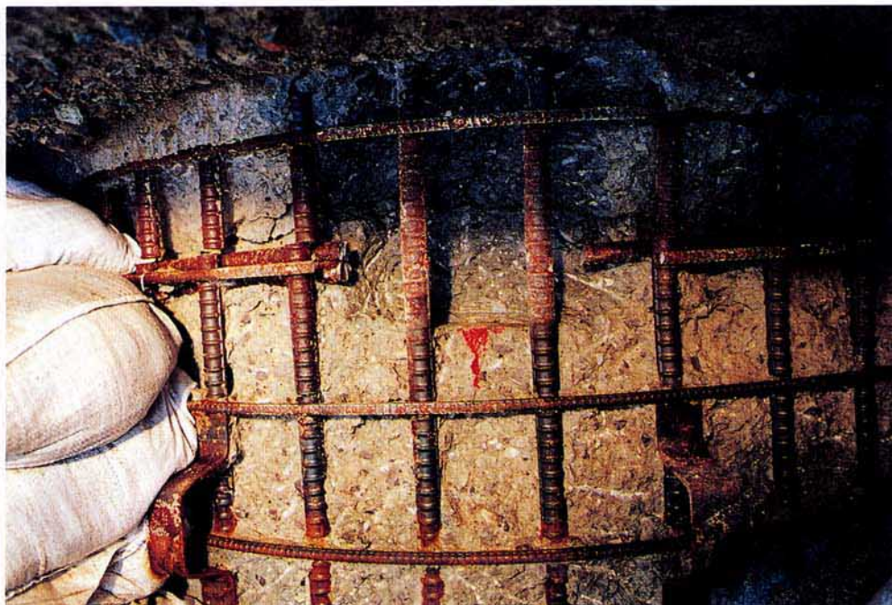
写真3.2.3.5 杭基礎（場所打ち杭、 \phi 1800）の被害状況
