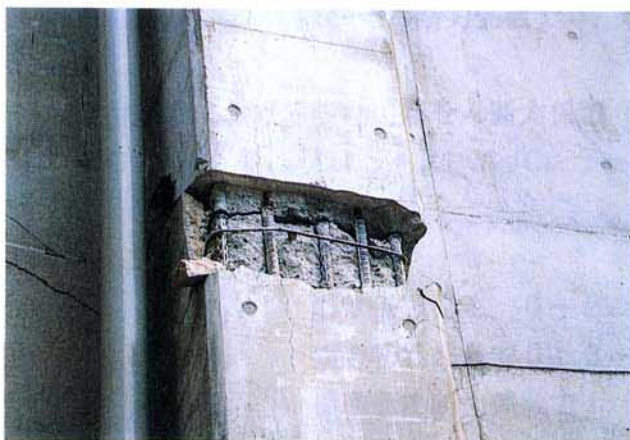
写真 3.2.1.37 鉄筋のガス圧接部の破断
