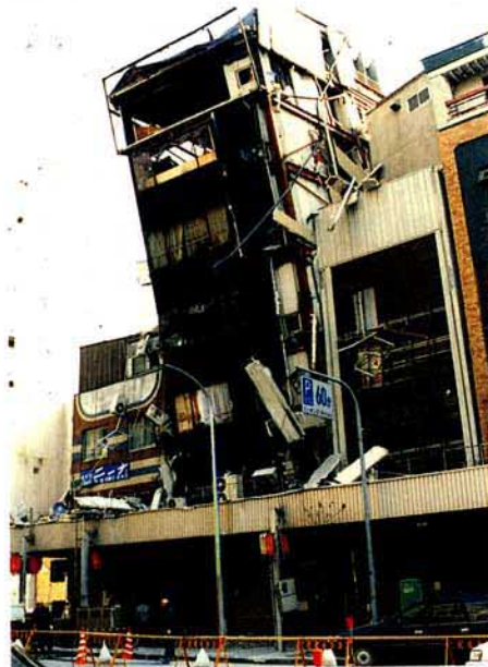
写真3.2.2.15 L建物 上階部分に大きな水平変形と外装材の脱落、引張形式の筋かいの破断が見られる
