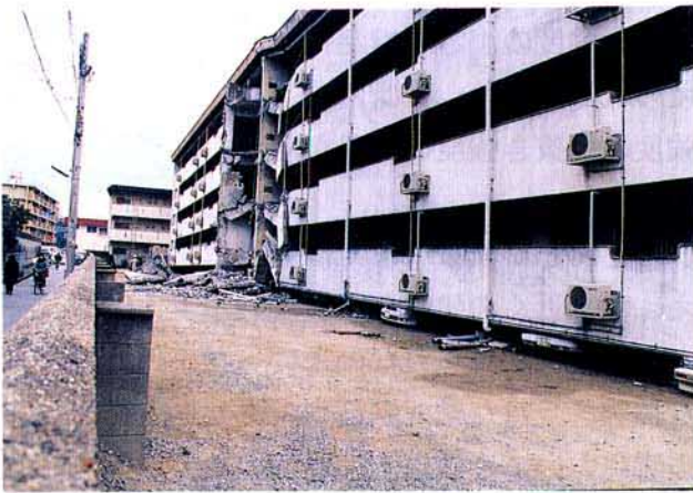
写真 3.2.1.2 5F集合住宅 ・1階ピロティーの層崩壊
