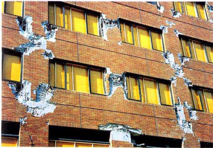
写真 3.2.1.35 柱はり接合部（SRC）のせん断破壊
