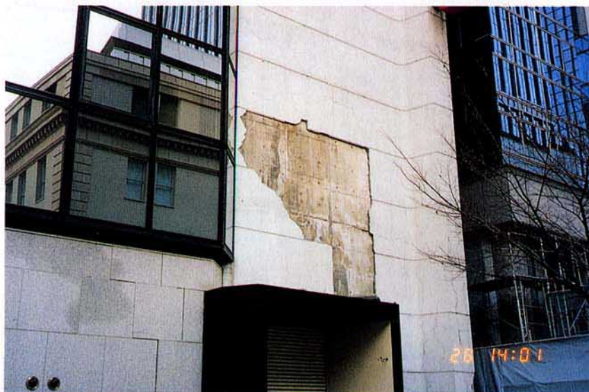
写真 3.2.4.19 RC下地石張りの脱落
