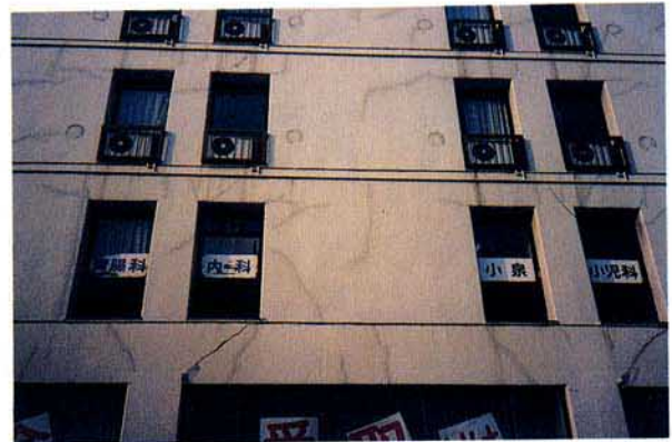
写真 3.2.1.42 方立壁によるはりの被害
