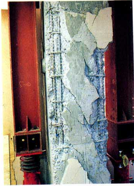
写真 3.2.1.39 柱の付着割裂破壊
