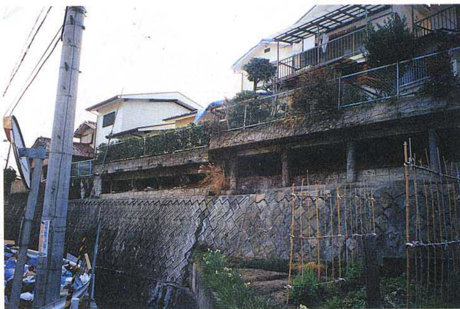
写真3.2.3.18 個々の宅地被害（練積みブロック）
