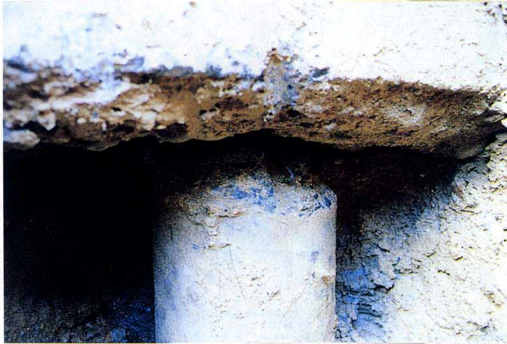
写真3.2.3.4 杭基礎（RC杭、 \phi 300）の被害状況
