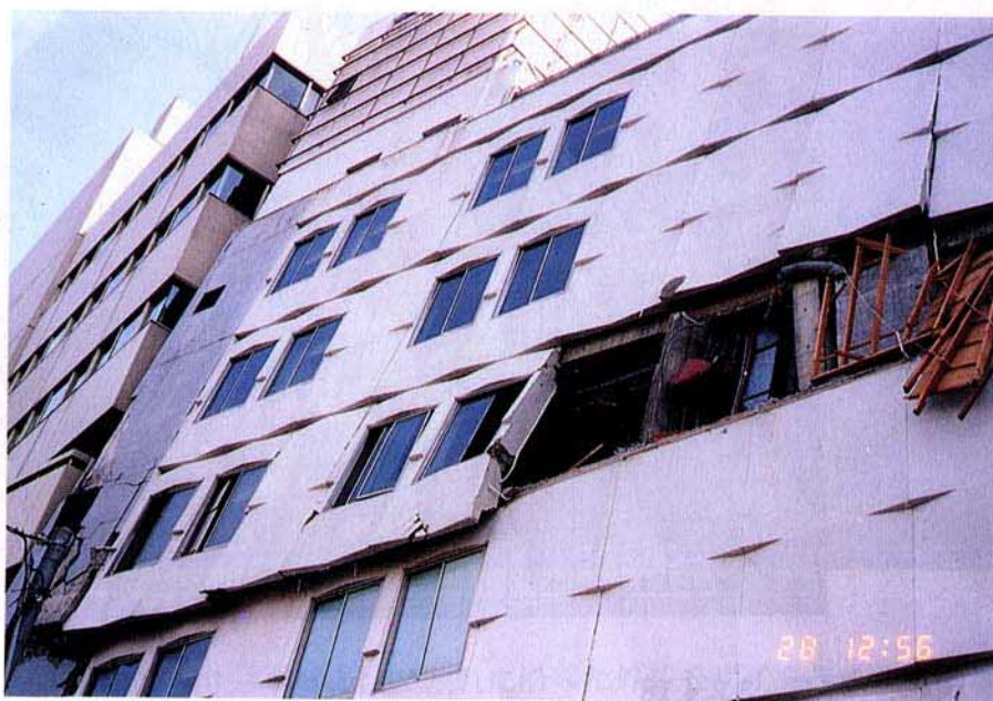
写真 3.2.4.20 PCカーテンウォールの脱落, 建物は層崩壊している
