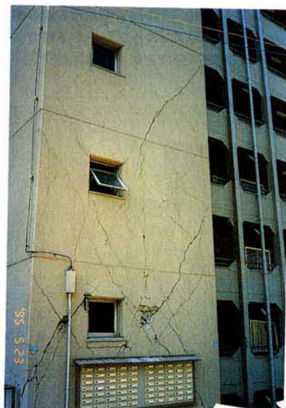
写真 3.2.1.15 付近の建物の被災状況 (7階建て、ラーメン構造：写真3.2.1.14とは別建物)
