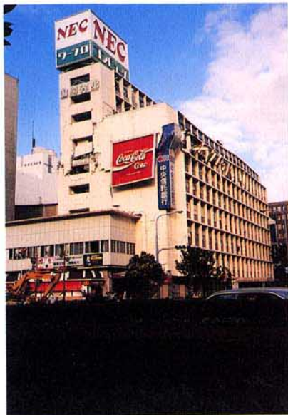
写真 3.2.1.24 セットバックの影響による層崩壊
