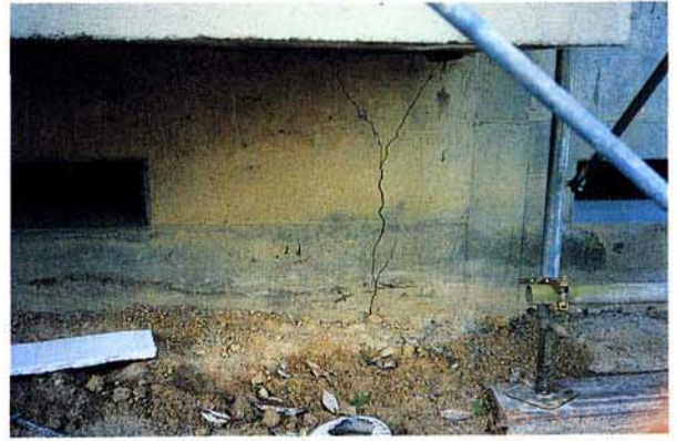
写真 3.2.1.13 基礎部のひびわれ
