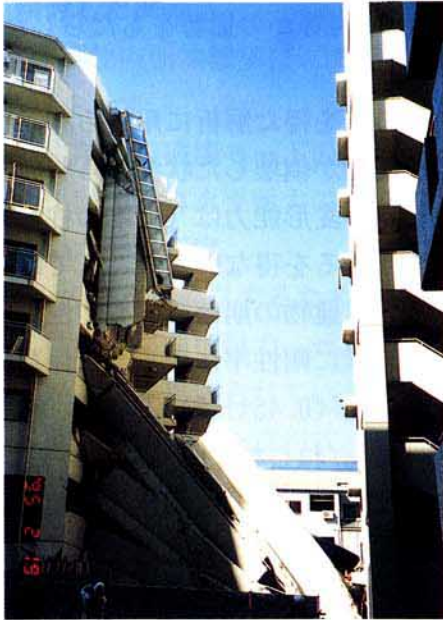
写真 3.2.1.51 渡り廊下の落下（北東部）
