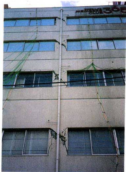
写真 3.2.1.30 短柱のせん断破壊
