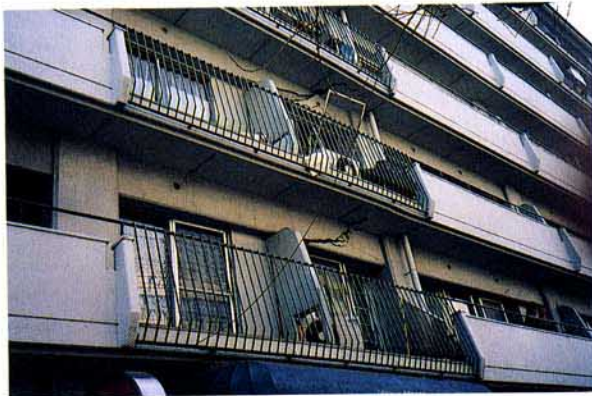
写真 3.2.1.41 方立壁によるはりの被害
