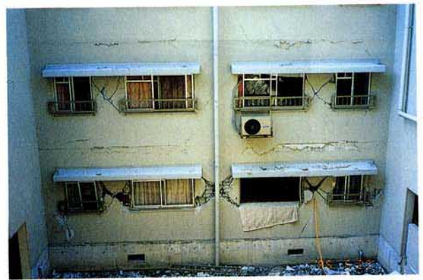
写真 3.2.1.14 付近の建物の被災状況 (7階建て、ラーメン構造)
