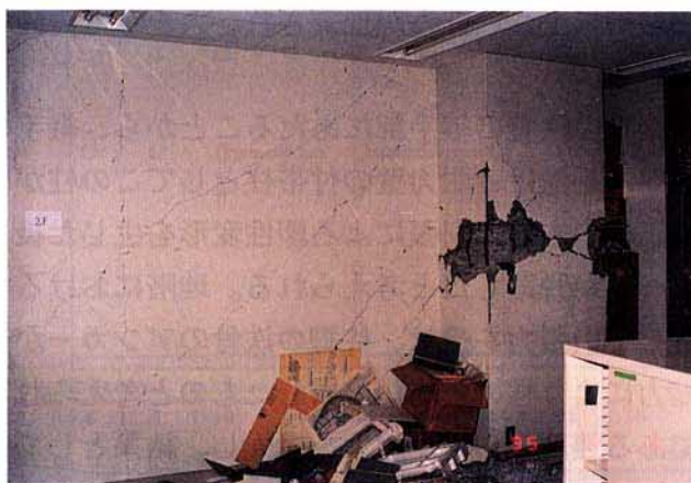
写真 3.2.1.45 2階耐力壁と側柱（D構面、15～16通り）壁せん断亀裂、柱主筋の座屈（柱内蔵鉄骨の接合部引張破壊によるものと想定される）
