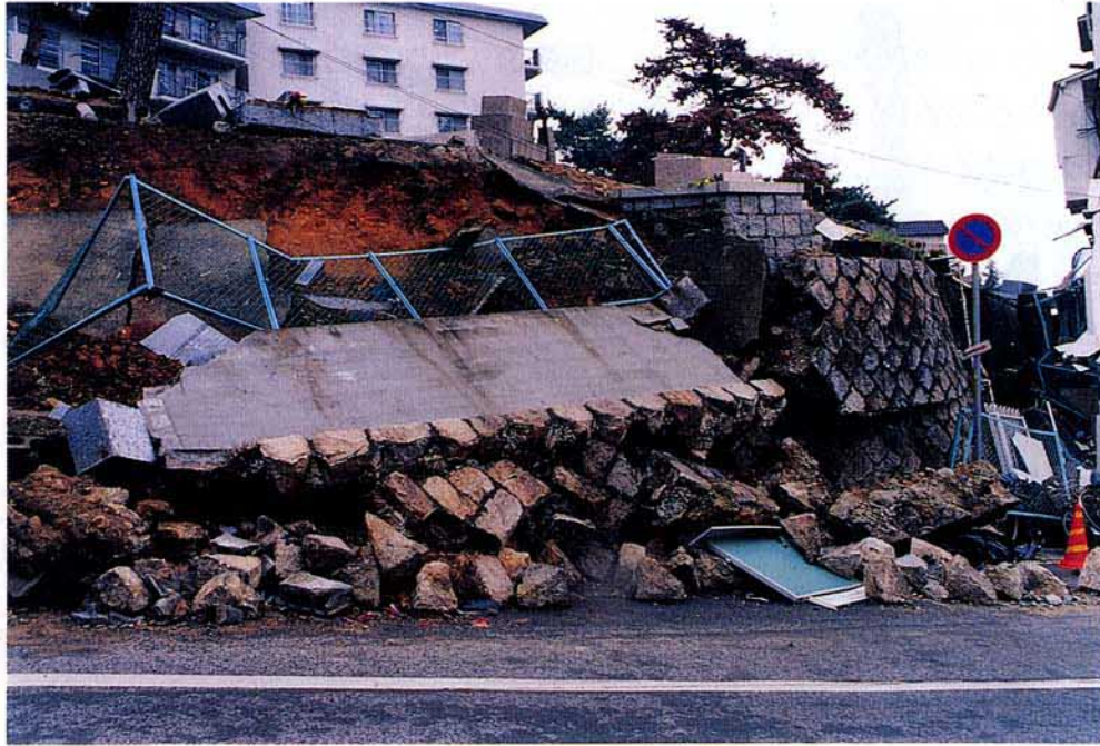
写真3. 2. 3. 17 個々の宅地被害（石積み擁壁）
