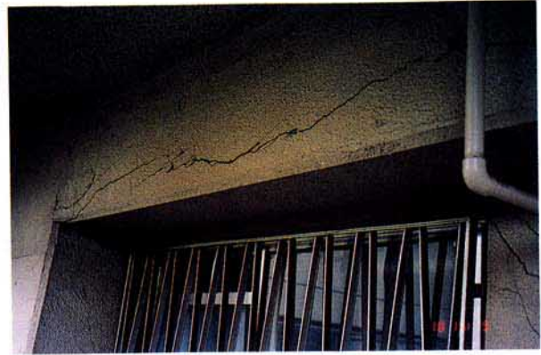
写真 3.2.1.40 はりの付着割裂破壊
