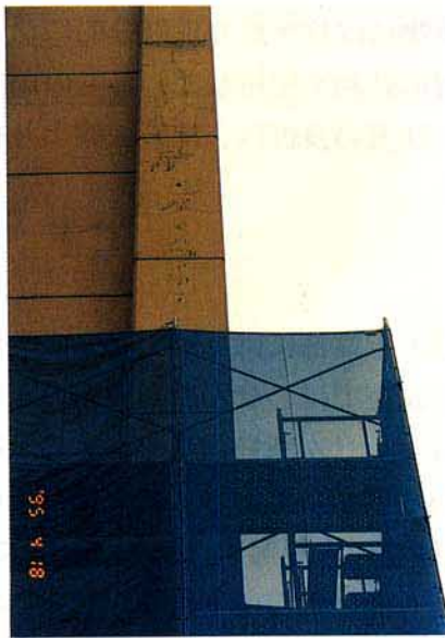
写真3.2.1.68 アルカリ骨材反応による柱の材軸方向に沿ったひび割れ
