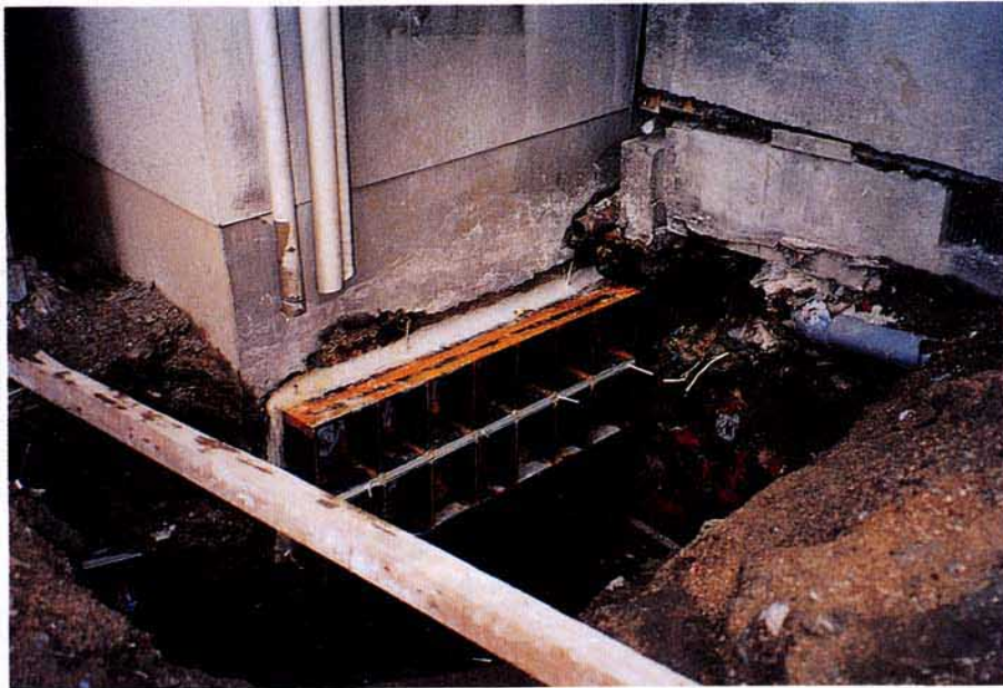
写真3. 2. 3. 3 直接基礎建物（S4F）の被害状況
