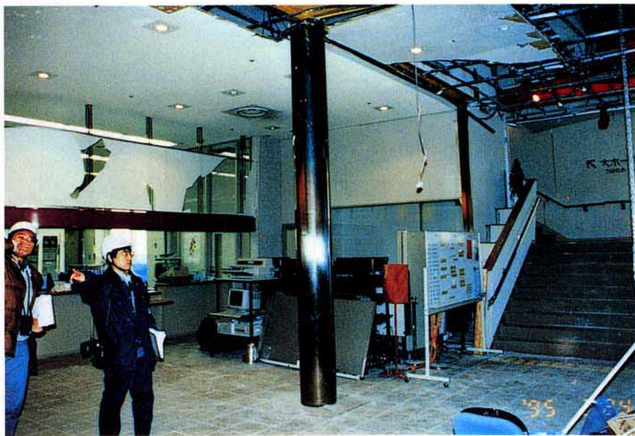
写真3.2.2.19 立体駐車場との衝突により損傷した建築物内部（Bビル）
