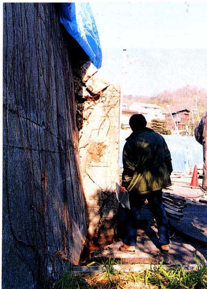
写真3. 2. 3. 14 擁壁の滑動（芦屋市三条）
