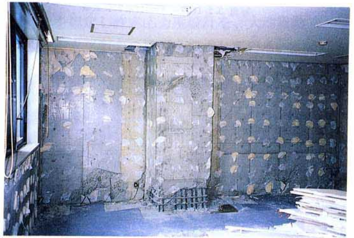
写真 3.2.1.36 柱の曲げ圧壊
