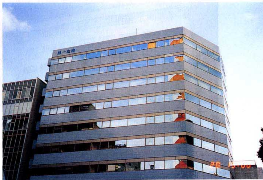
写真 3.2.4.2 全層でコーナー部のガラスが破損
