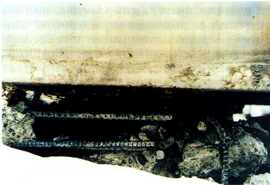
写真3.2.2.22 露出柱脚の損傷（Hビル）
