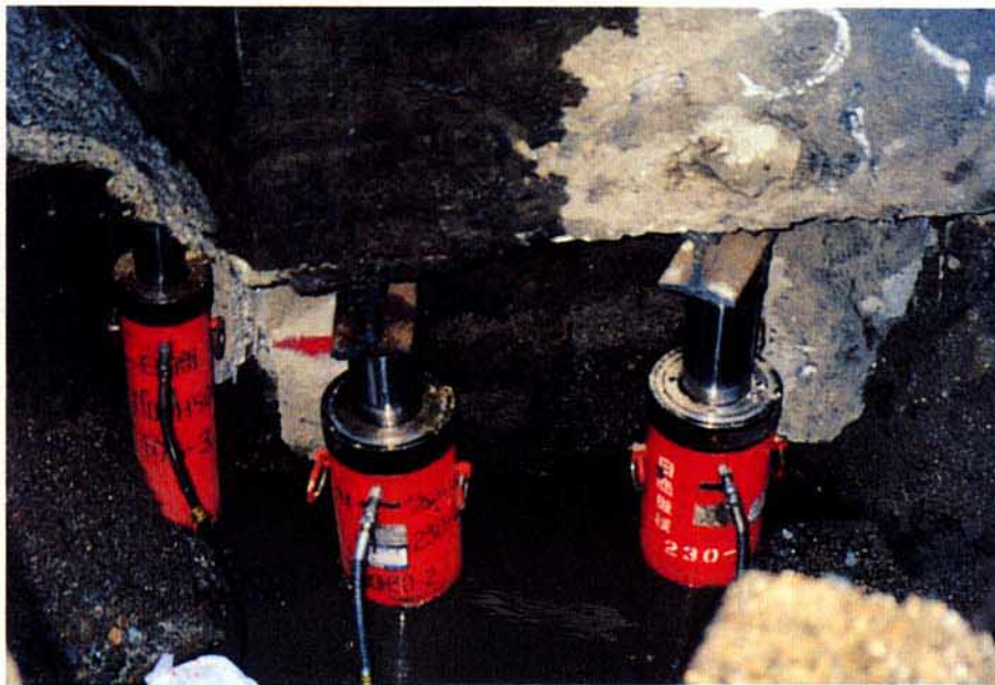
写真3. 2. 3. 2 杭基礎建物（RC3F）の被害状況
