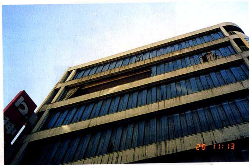
写真 3.2.4.5 溝型ガラスの破損
