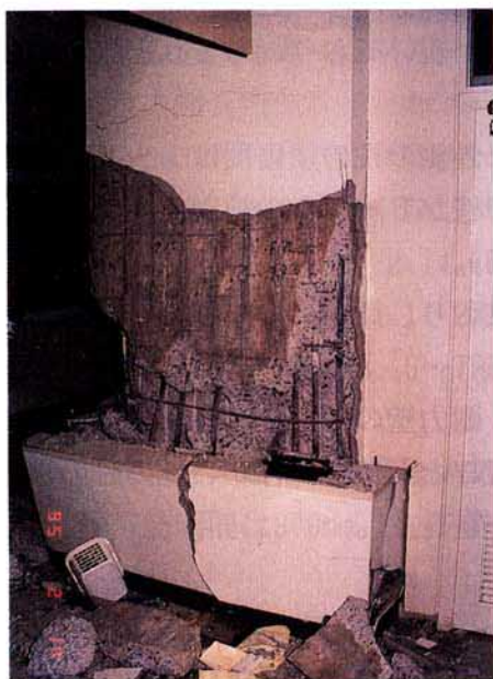
写真 3.2.1.44 地階 耐力壁側柱（D構面、15通り）柱主筋の座屈
