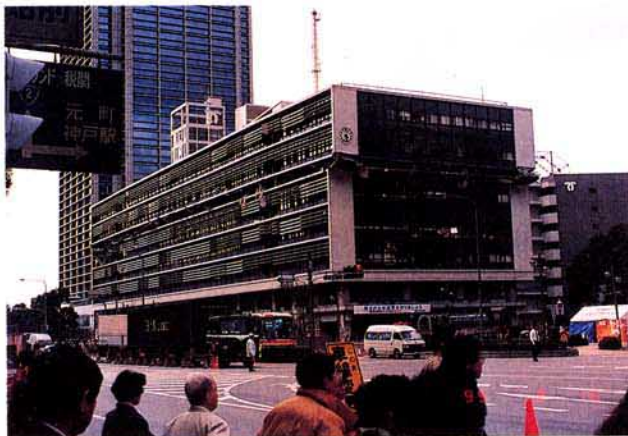
写真 3.2.1.43 全景（6階部分の層破壊が見られる）
