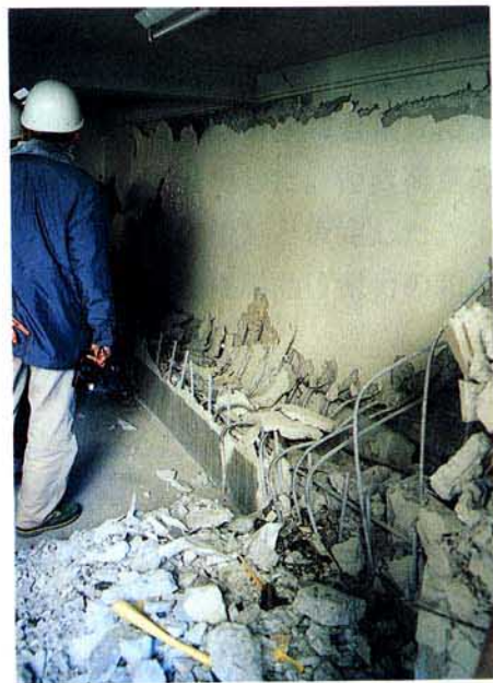
写真 3.2.1.54 1階耐震壁の破壊（2通りC～E間）
