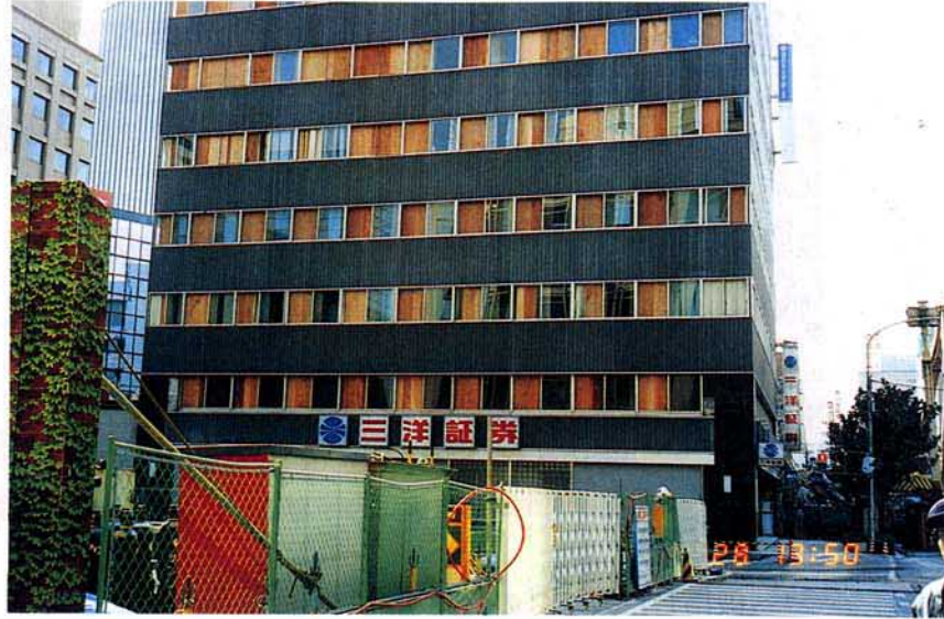
写真 3.2.4.1 全層で窓ガラスの破損
