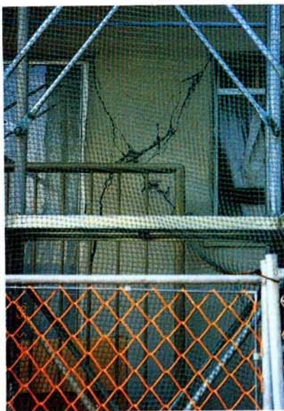
写真 3.2.1.12 開口隅角部を結ぶせん断ひびわれ
