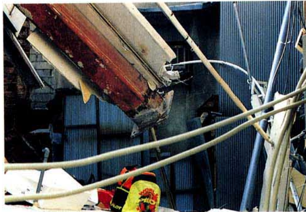
写真 3.2.2.5 D 建物 1階柱脚の大破、4本のアンカーボルトが破断し建物倒壊にいたっている。
