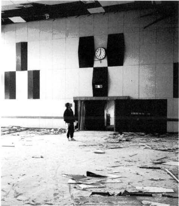
天井が落下した講堂（本多間小・垂水区）
