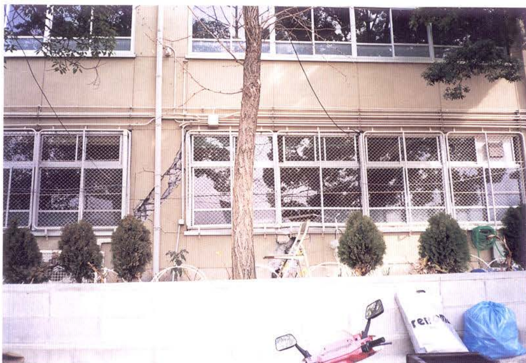
校舎外部柱せん断
