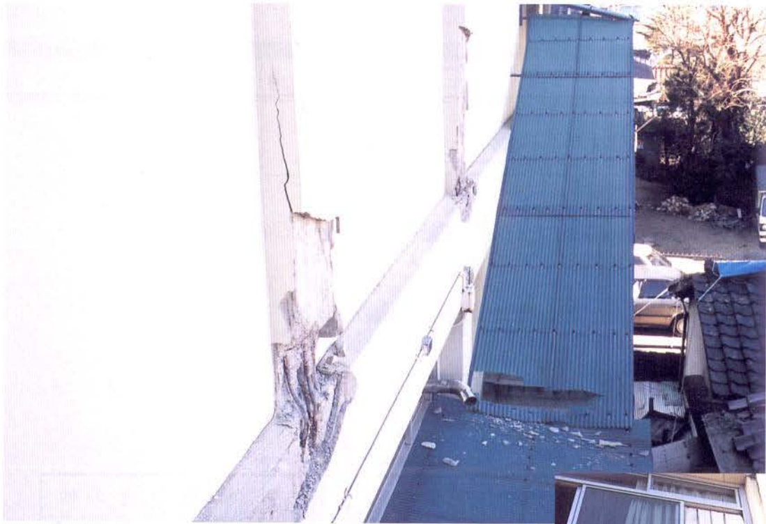
校舎外部柱せん断
