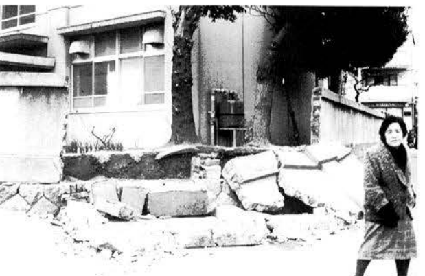
大きく崩れた塀（魚崎小・東灘区）
