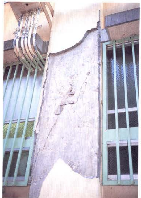
校舎柱せん断
