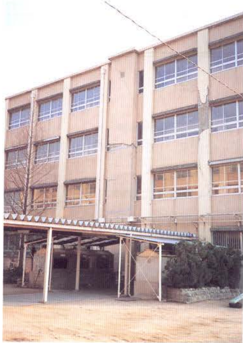
校舎柱せん断
