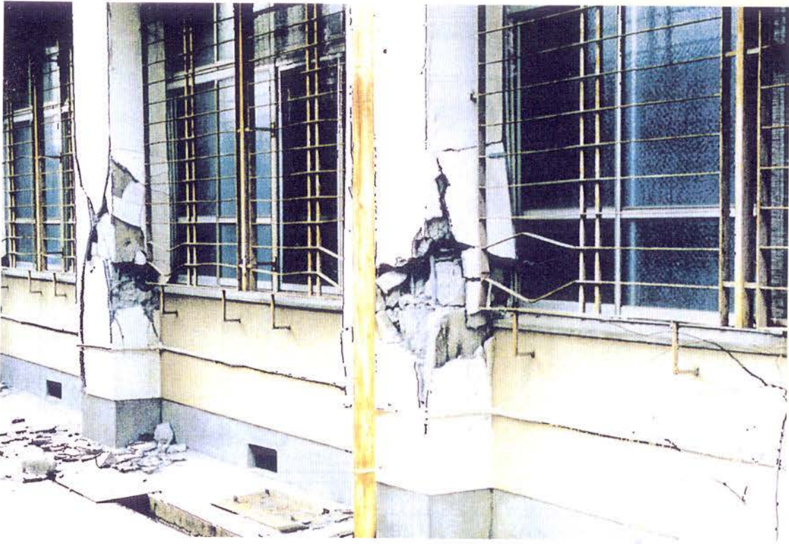
校舎外部柱せん断
