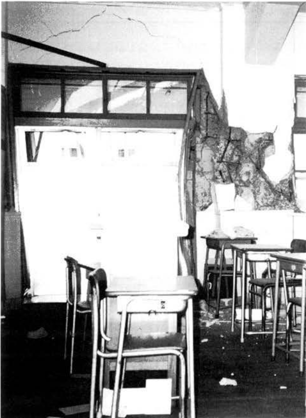
壁が落ち、出入口が破損した教室（飛松中・須磨区）
