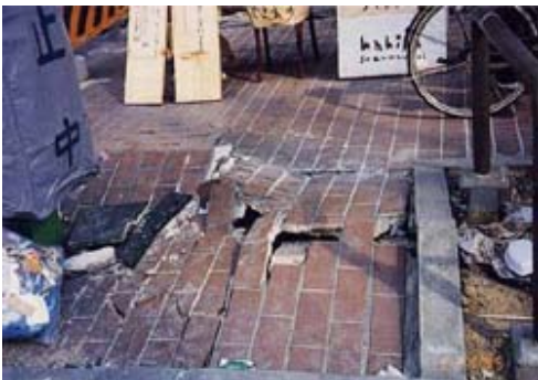
●地割れした歩道
