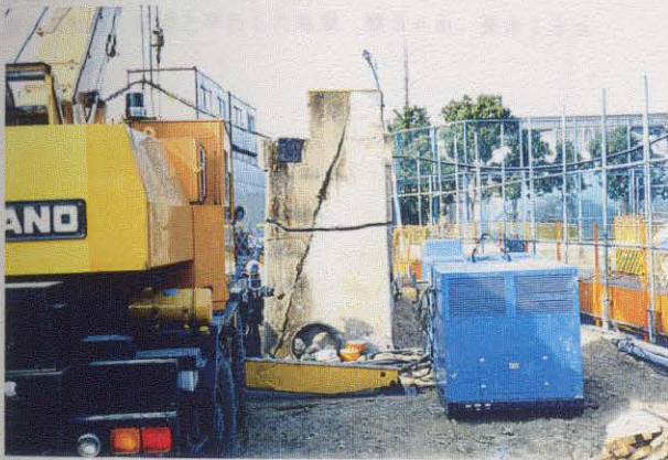
写真3.3.33 (図-3.1.4の 31) 修復・撤去前の橋台 躯体中央にセン断破壊面が見られる。
