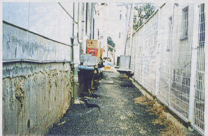
写真-3.2.19(図-3.1.2の⑲) 西宮浜 埋立て地 液状化により周辺が70cm程度沈下する。
