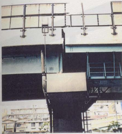
写真3.3.13 (図-3.1.4の 11) 橋桁の開口
