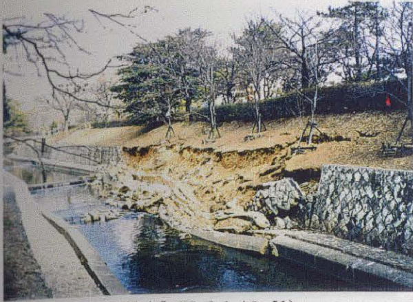
写真3.4.7(図-3.1.4の 51) 夙川護岸及び法線の崩壊
