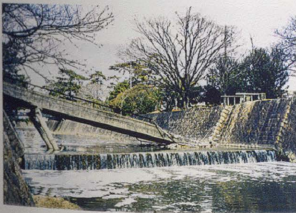
写真3.4.11(図-3.1.4の 55) 夙川横断橋の落橋(片鉾橋歩道橋)
