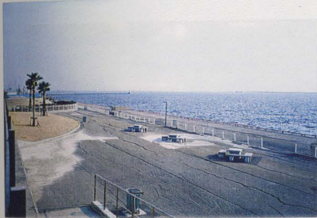
写真3.3.49(図-3.1.3の5) 西宮市海づり広場の変状 海づり岸壁より内側のアスファルト路面に生じた開口 亀裂。液状化による噴砂が見られる。
