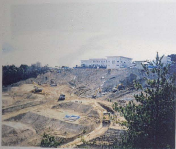
写真3.4.15 (図-3.1.4の 59) 仁川百合野町付近 地すべり
