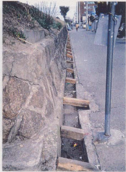
写真3.3.42 (図-3.1.4の 40) 石積擁壁の滑動 地震力によって土圧が壁体に作用し、これ によって滑動・前傾した。そのため側溝部に変状 が現れた。再滑動を防止するために角材で補強 している。
