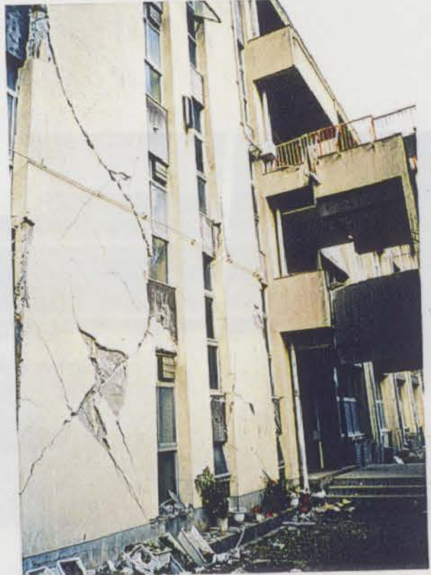
写真-3.2.12(図-3.1.1の㉒) 上ヶ原九番町2丁目 上ヶ原中学校 鉄筋コンクリート建築物 主柱の主筋が完全に 露出し座屈する。構造物の周辺は開口性亀裂が 認められ、10~15cm程度沈下している。
