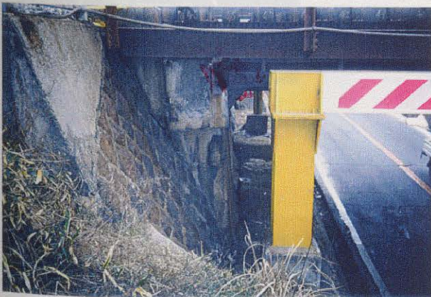
写真3.3.35 (図-3.1.4の 33) 道路側全体と橋台部に開口が8cm発生し、橋台が傾斜する。
