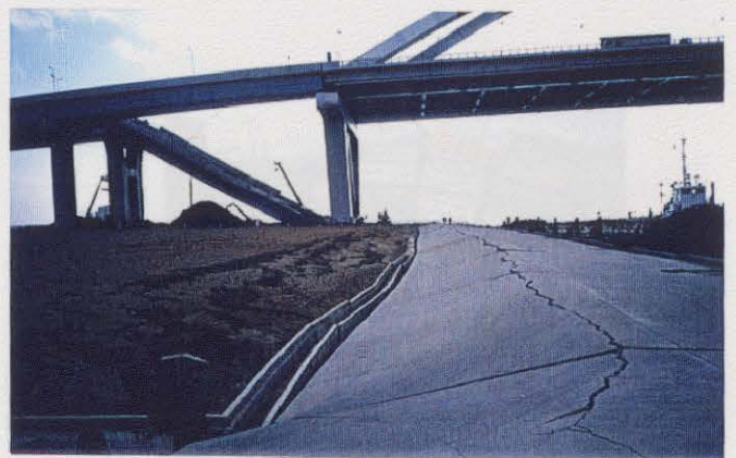
写真3.3.52(図-3.1.3の8) 甲子園浜西側護岸の変状 西宮大橋の落橋付近コンクリート舗装が水平圧縮あるいは 鉛直力によって凸形に変形背面土の沈下と地割れが著しい 盛土あるいは基礎地盤が液状化を起こしたものと考えられる。
