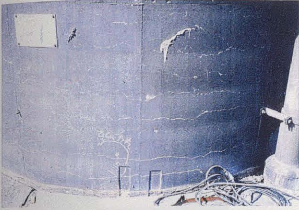
写真3.3.7 (図-3.1.4の5) 大阪側に見られる水平ひび割れ、脚の浮き上がり、地盤との隙間 第11橋脚
