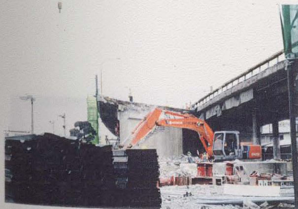
写真3.3.23 (図-3.1.4の 21) 橋脚の損傷状況 西宮球場南側の落橋部下部左側よりパラペットへ向かい セン断されている。
