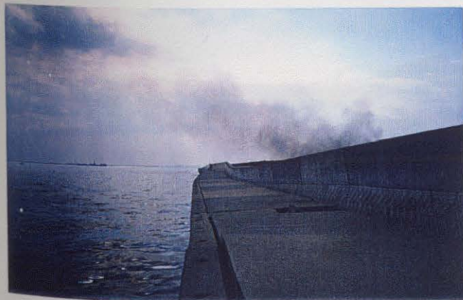
写真3.3.51(図-3.1.3の7) 甲子園浜東護岸の変状 岸壁のせりだし、前傾及びエプロンの変状。 内側の護岸も前傾し、法線方向に対して波打つ。
