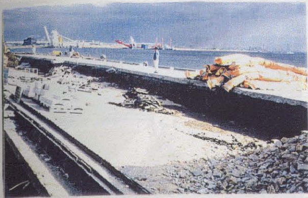
写真3.3.53 (図-3.1.3の 9) 西宮浜 南側岸壁の背面陥没(幅500cm, 落差150cm)
