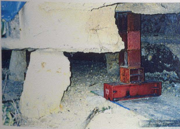
写真3.4.23(図-3.1.4の 67) 高塚町付近 マンション基礎部
