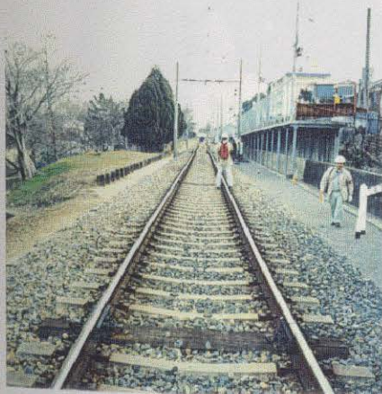
写真3.3.39 (図-3.1.4の 37) 阪急甲陽線 軌道が蛇行
