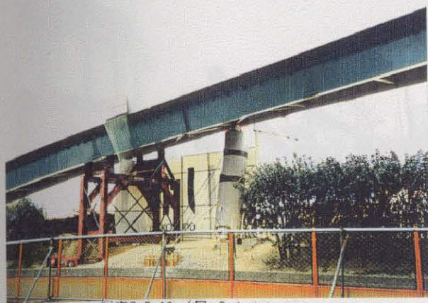
写真3.3.19 (図-3.1.4の 17) 芦屋入り口付近の橋脚転倒、破損
