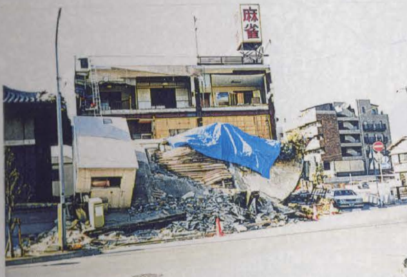
写真-3.2.16(図-3.1.1の⑯) 本町2丁目付近 鉄骨製建築物 東側部分完全倒壊
