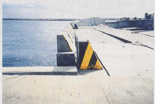
写真3.3.64(図-3.1.3の 20) 西宮浜 南側岸壁 東側に90cm移動
