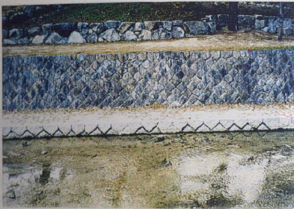
写真3.4.9(図-3.1.4の 53) 夙側低水路石積護岸の沈下
