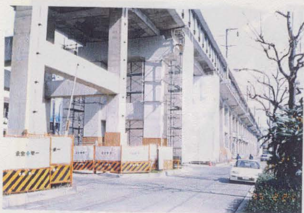
写真3.3.28 (図-3.1.4の 26) 橋梁との接合部に見られる微小亀裂の補修跡
