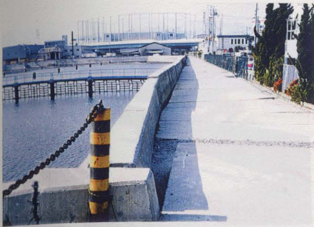
写真3.3.47(図-3.1.3の3) 鳴尾浜北東隅の埋立護岸の変状 護岸のせりだしと内側エプロンの沈下。 手前の護岸本体には損傷時の亀裂が認められる 亀裂幅、相対沈下量は最大で5cm×10cm 20cm～30cm内側の道路面に噴砂が見られた が護岸背面では認められなかった。
