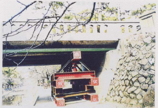
写真3.4.10(図-3.1.4の 54) 夙川横断橋橋台のひび割れ(大井手橋)
