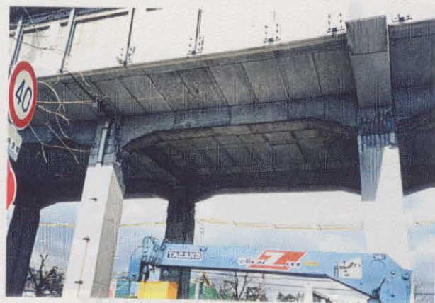
写真3.3.26 (図-3.1.4の 24) 新幹線 松籟荘付近 門型橋脚座屈
