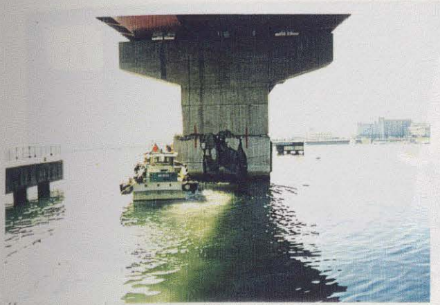
写真3.3.1 (図-3.1.3の1) 西宮大橋 3番目橋脚 座屈
