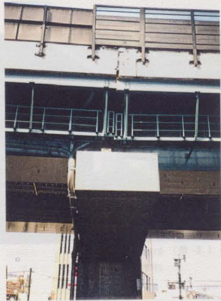
写真3.3.14 (図-3.1.4の 12) 橋桁の圧縮による破損
