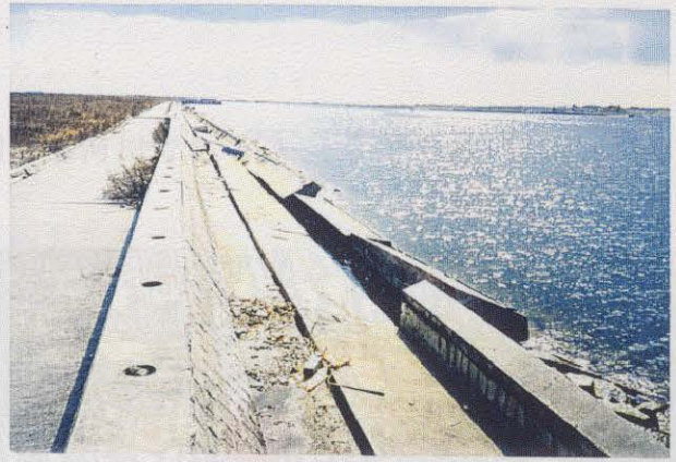
写真3.3.60(図-3.1.3の 16) 西宮浜 西側岸壁 重力式擁壁転倒
