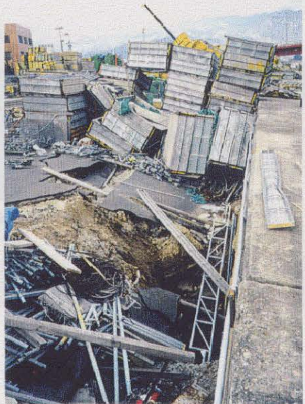
写真3.3.58 (図-3.1.3の 14) 西宮浜 北側岸壁の背面陥没 (幅500cm, 落差90~200cm)
