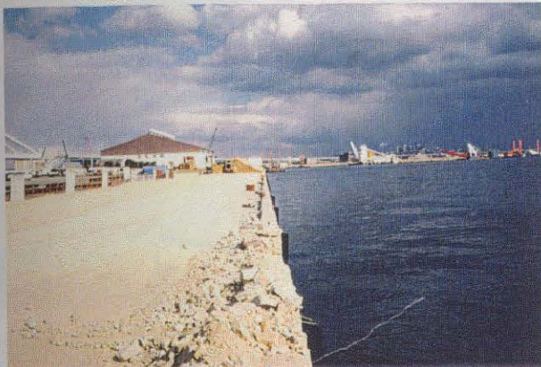
写真3.3.55 (図-3.1.3の 11) 西宮浜 南側岸壁傾斜4度と法線直線状
