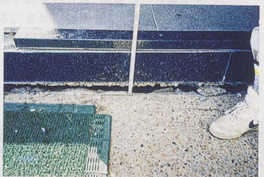
写真-3.2.18(図-3.1.2の⑱) 中葭原町2丁目付近 甲陽学院中学校 鉄筋コンクリート建築物 液状化により周辺が8cm程度沈下する。
