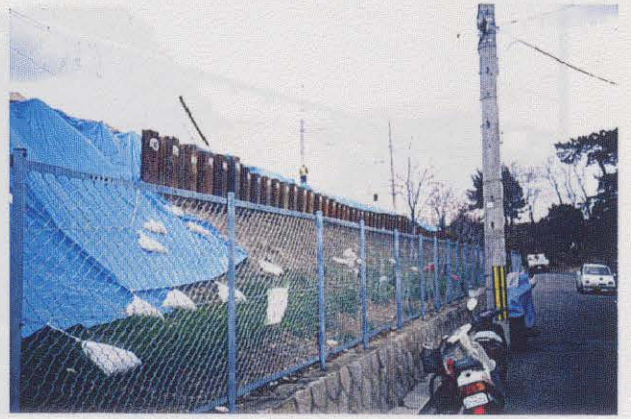
写真3.3.32 (図-3.1.4の 30) 高盛土区間での損傷状況 盛土補修のための鋼矢板がすでに設置されている。 法面、堤頂部の変状はシート等により確認できない。 また石積擁壁にも変状は見られない。
