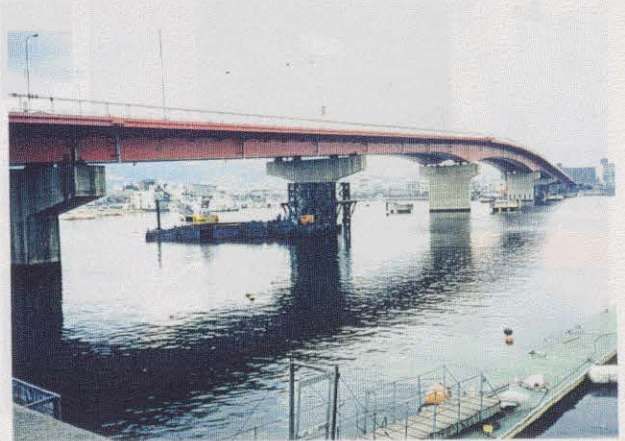
写真3.3.2 (図-3.1.3の2) 西宮大橋 6番目橋脚 座屈
