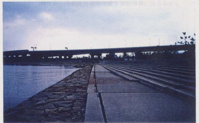
写真3.3.50(図-3.1.3の6) 北側護岸の人工干潟の変状 人工干潟の噴砂跡 構造物の変状は軽微である。
