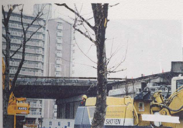
写真3.3.21 (図-3.1.4の 19) 橋脚の修復状況 鉄板によって橋脚を補強している。
