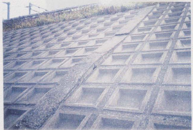
写真3.3.40 (図-3.1.4の 38) コンクリートブロックに法面保護工 地震力により土圧がブロックに作用し、 はらみだが見られる。 梁が座屈し、盛り上がる。
