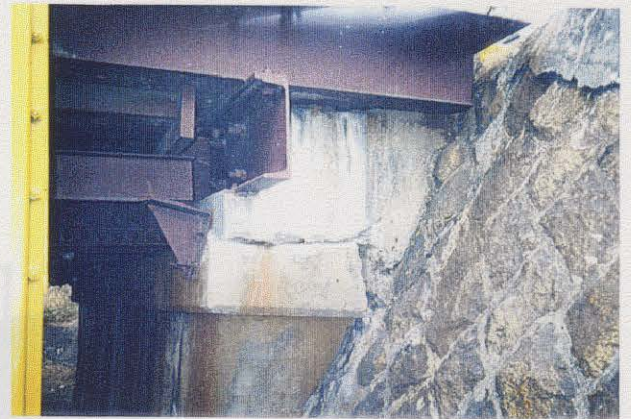
写真3.3.34 (図-3.1.4の 32) 武庫川右岸の橋台部 橋台がセン断破壊されてH鋼も一部セン断されている。
