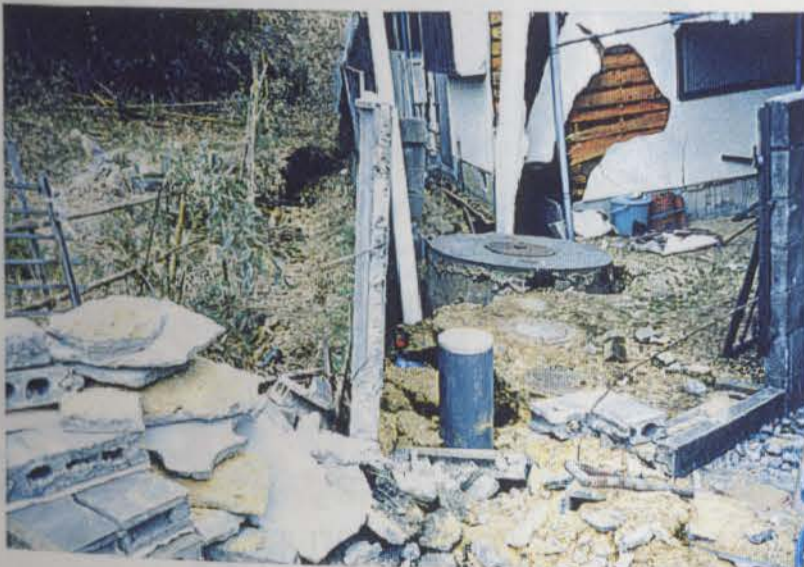
写真-3.2.11(図-3.1.1の㉕) 豊楽町11丁目 木造家屋 木造家屋の壁がはがれ、基礎が沈下し傾斜する。 盛土地盤の地すべりで滑落崖を認める。
