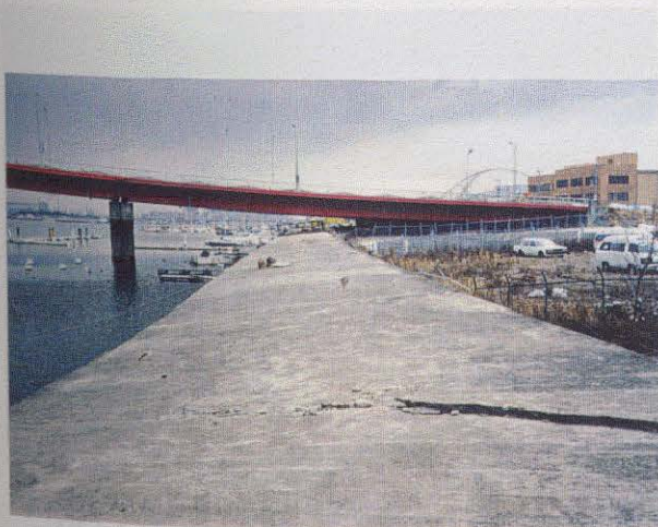
写真3.3.57 (図-3.1.3の 13) 西宮浜 北側岸壁 海側に3度~8度傾斜
