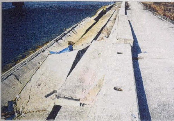
写真3.3.61(図-3.1.3の 17) 西宮浜 西側岸壁 管理道路隆起
