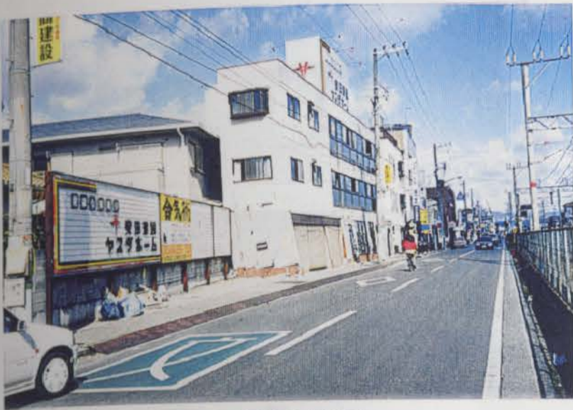
写真-3.2.9 (図-3.1.1の㉑) 門戸町4丁目 鉄筋コンクリート建築物 1階部分が座屈し傾斜する。
