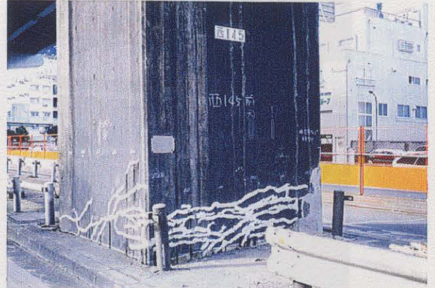
写真3.3.8 (図-3.1.4の6) 大阪側にみられる水平ひび割れ密集部(補修跡) 海側には斜めセン断ひび割れが見られる。
