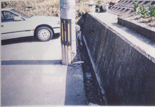
写真3.3.41 (図-3.1.4の 39) 電柱下端部コンクリートの剥離状況 南側でコンクリートが剥離し、鉄筋が露頭 している。
