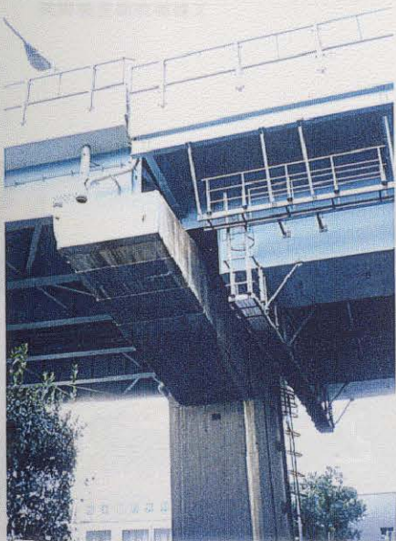
写真3.3.11 (図-3.1.4の9) 第16橋脚を山側より望む 神戸側(写真右側)の桁が取付部より脱落している。 大阪側の桁も神戸側にずれているのが雨水配水管のズレ によりわかる。
