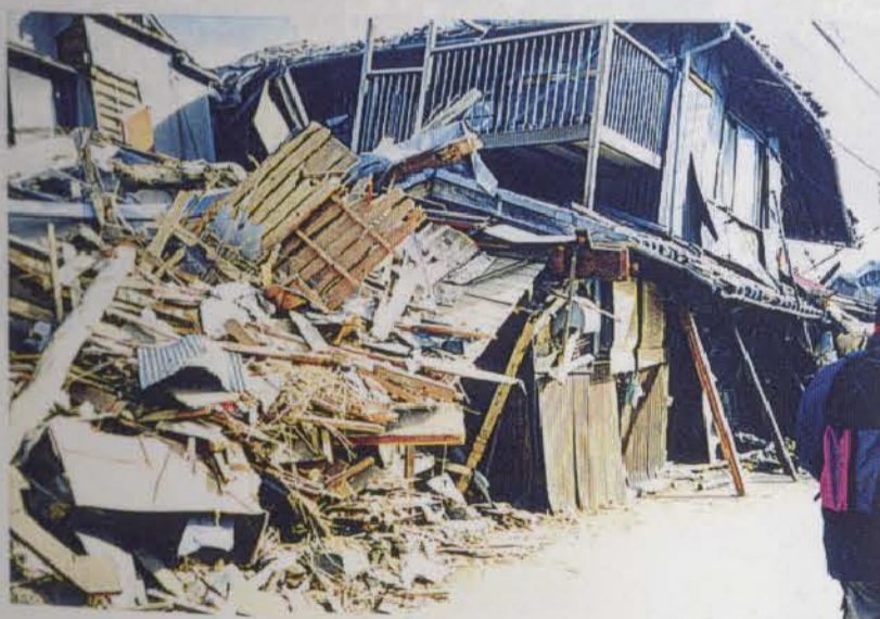
写真-3.2.17(図-3.1.1の⑰) 屋敷町8丁目付近 木造家屋 付近一帯は被害の集中した地域で全壊する。
