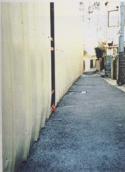
写真3.3.45 (図-3.1.4の 43) 盛土部土留め工のはらみだし
