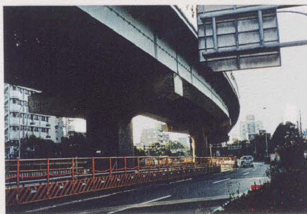
写真3.3.20 (図-3.1.4の 18) 橋桁のずれ
