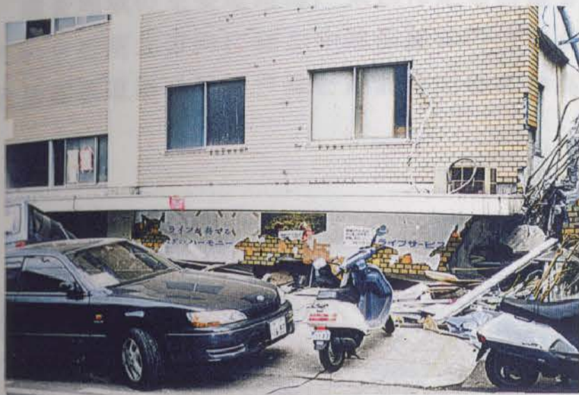
写真-3.2.15(図-3.1.1の⑮) 城ヶ堀町1丁目付近 鉄筋コンクリート建築物 1階部が完全に座屈し圧壊する。
