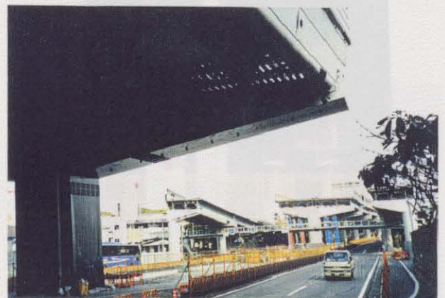
写真3.3.18 (図-3.1.4の 16) 西宮市市庭町の落橋部
