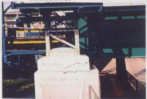
写真3.3.46 (図-3.1.4の 44) 宮川横断橋梁部のひび割れ
