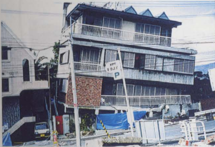
写真-3.2.10(図-3.1.1の㉓) 相生町12丁目 鉄筋コンクリート建築物 1階部分が駐車場で座屈し傾斜する。
