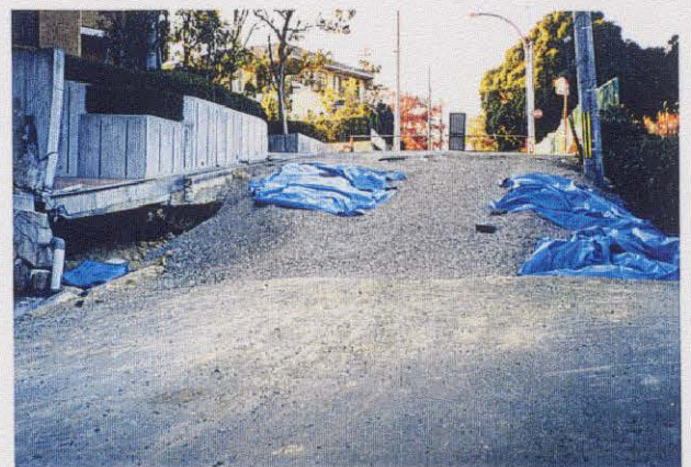
写真3.4.24(図-3.1.4の 68) 高塚町付近 道路亀裂
