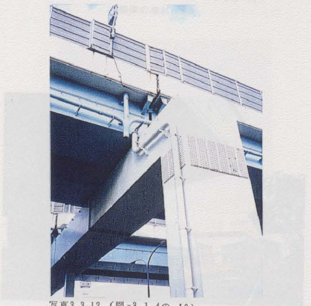
写真3.3.12 (図-3.1.4の10) 第147橋脚を海側より望む。 橋脚自体には目立った被害はみられないが 桁は神戸方向(写真右方向)にずれているのが わかる。
