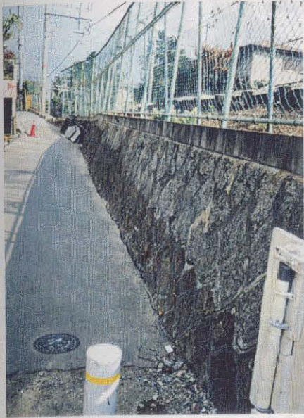
写真3.3.37 (図-3.1.4の 35) 殿山町付近 鉄道と平行した亀裂 幅3cm、長さ15m
