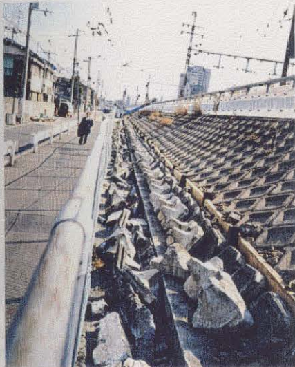
写真3.3.43 (図-3.1.4の 41) 六湛寺町付近 コンクリートブロックの法面法尻 付近崩壊
