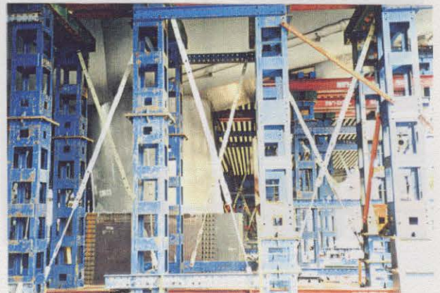
写真3.3.16 (図-3.1.4の 14) 橋脚の傾斜
