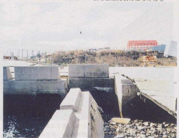
写真3.3.56 (図-3.1.3の 12) 西宮浜 南側岸壁 海側に230cm移動
