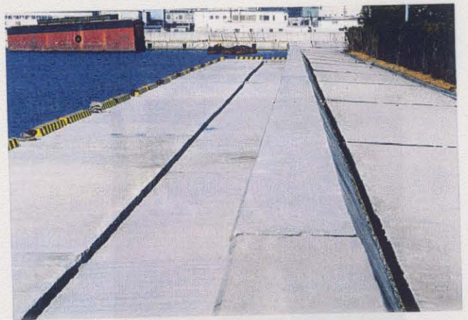
写真3.3.48(図-3.1.3の4) 甲子園フェリーターミナル周辺の護岸の変状 岸壁の前傾とエプロンの沈下及び亀裂。 背面の護岸及び舗装コンクリートにも変状が 生じている。岸壁より内側には噴砂は認められなかった。
