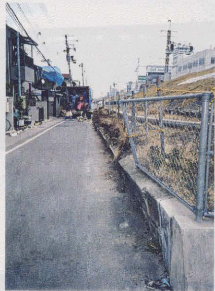
写真3.3.44 (図-3.1.4の 42) 神楽町付近 コンクリート擁壁傾斜(20度) およびはらみだし。
