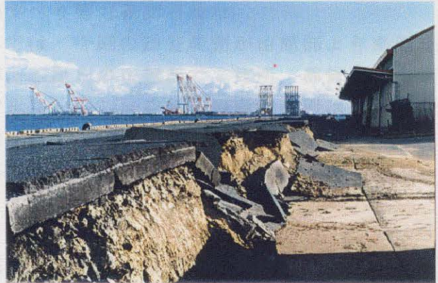
写真-6.3.35 摩耶埠頭 第一埠頭東側岸壁(図-6.3.8の⑪) エプロン部と倉庫の間に見られる段差。 1m程度。
