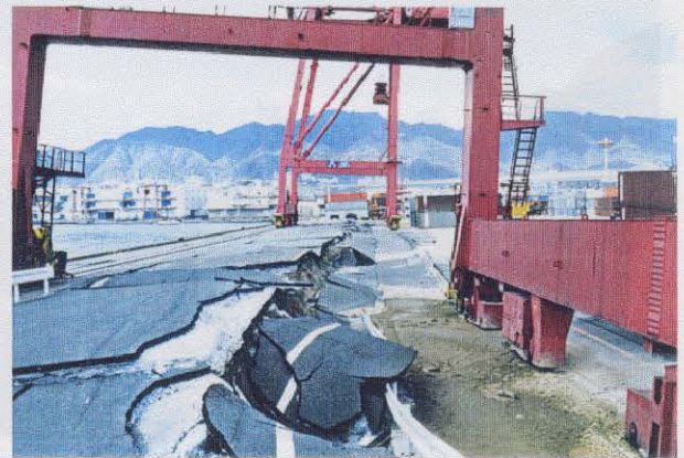
写真-6.3.29 コンテナターミナル西側岸壁(図-6.3.8の⑤) ガントリークレーンの内側の不等沈下の状況
