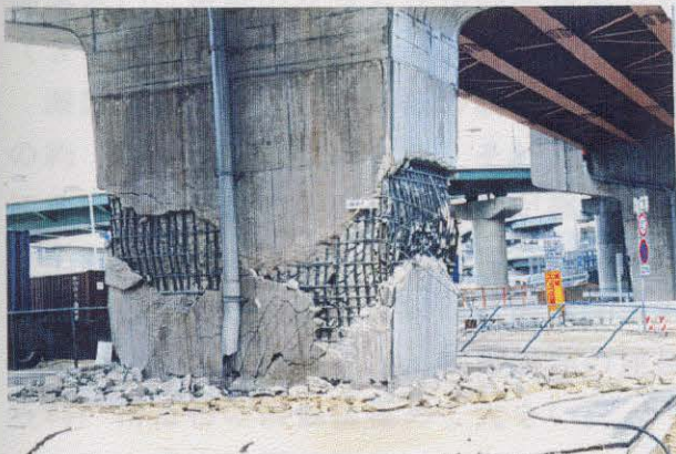
写真-6.3.9 ハーバーウェイの橋脚の被害〔摩耶埠頭〕(図-6.3.3の⑨) 被害は上下2車路で一脚型の橋脚に見られる。 表面のコンクリートが剥離し、せん断破壊している。
