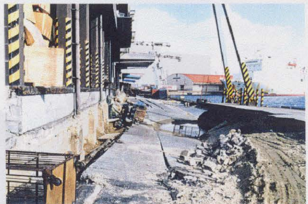
写真-6.3.30 埠頭間の倉庫専用荷揚げ岸壁の被害状況(図-6.3.8の⑥) 岸壁には大きな沈下と側方変位が生じており、荷揚げ機能は停止している。倉庫の基礎部分も剥き出しとなり、基礎杭頭部の破損が確認される箇所もある。
