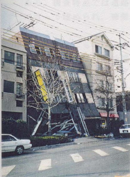
写真-6.2.17 千旦通り3丁目(図-6.2.4の㉓) S構造4Fのビル。 倒壊している。
