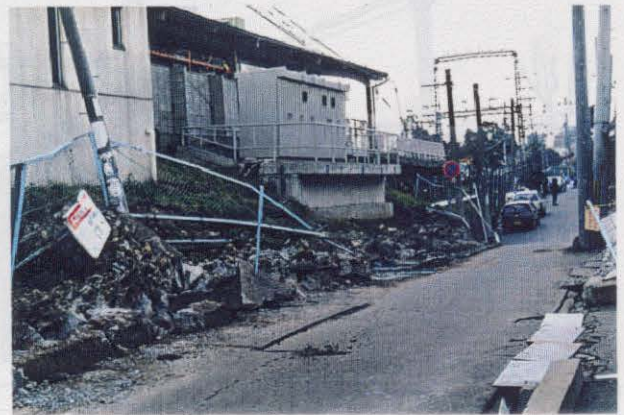
写真-6.3.18 阪神灘駅北側盛土の小崩壊（図-6.3.6の⑥）
