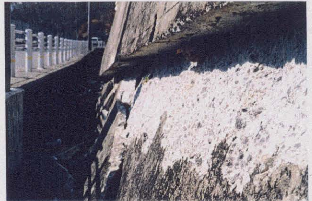
写真-6.4.21 灘丸山公園南側法面(図-6.4.9の⑬) 擁壁下部のジョイントから上が前に約40cm出ている。
