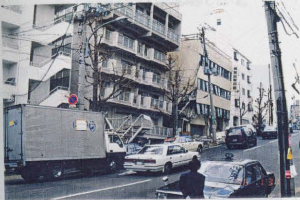
写真-6.2.2 城内通1丁目のビルの損害状況(図-6.2.4の②) 中央の2つのビルは1階部分が倒壊している。 両ビルともに1階部分が駐車場となり、建築時期も 昭和56年以前である。左右のビルは新しいため健全。
