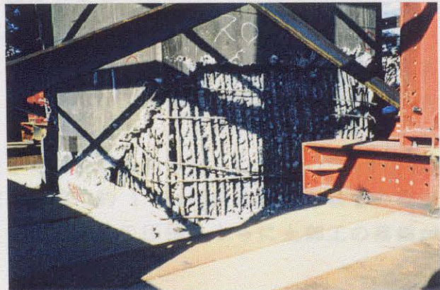
写真-6.3.12 阪神高速3号神戸線 新在家南町5-12(図-6.3.3の⑫) 神289橋脚の破損状況。
