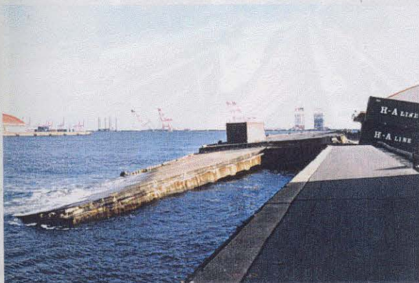
写真-6.3.27 第一突堤東側の岸壁被害状況(図-6.3.8の③) 栈橋の棚部分が海中に没している。 コンテナ奥の倉庫と岸壁の間には1m程度の段差が生じている。
