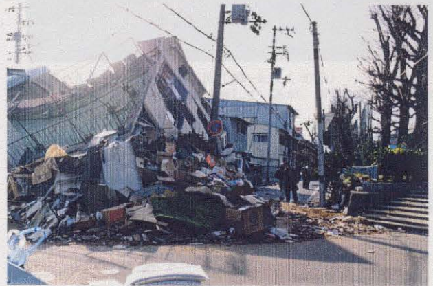
写真-6.2.13 大石東町1丁目 北東角 (図-6.2.4 の㉙) 家屋は全壊状態である。
