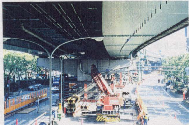
写真-6.3.11 阪神高速3号神戸線 新在家南町1-2(図-6.3.3の⑪) 歩道橋上より見た神269橋脚の踏座。 右側の踏座は隙間が開いている。排水管がぐい違っているのがわかり、桁は北側へ30cm程度ずれている。
