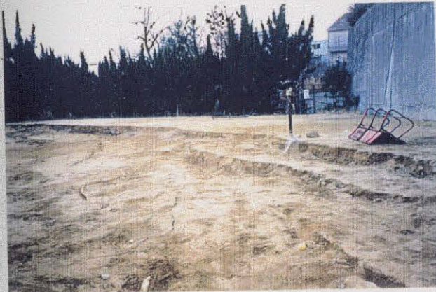
写真-6.4.17 土山町のテニスコートの変状(図-6.4.9の⑨) 谷側が1m沈下している。
