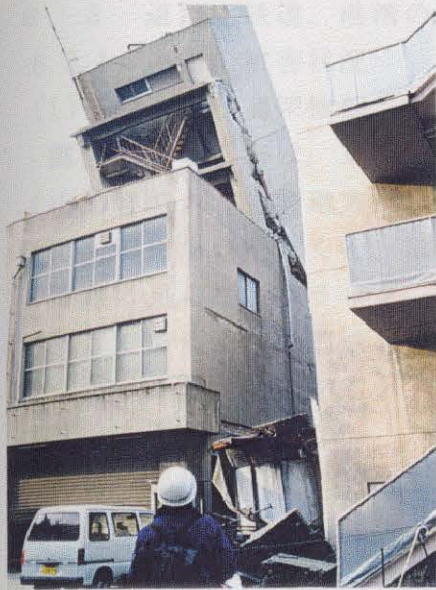
写真-6.2.15 大石東町3丁目(図-6.2.4の⑮) 大丸澆配送センター。 背後のビルが倒壊している。
