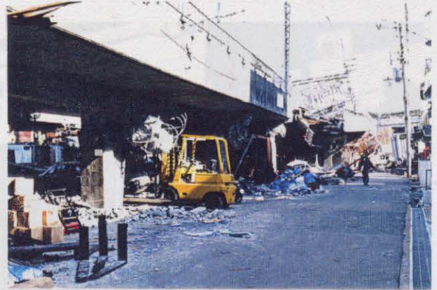
写真-6.3.17 阪神電鉄高架橋被害状況（図-6.3.6の⑤） 浜田町二丁目 橋脚頭部の座屈に伴う圧壊。 さらに、上部工にも大きな損傷が起こっている。
