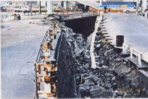
写真-6.4.6 観音寺川・国道43号南側(図-6.4.3の⑥) 左岸側40m, 右岸側が20mに渡って護岸が倒壊しており、橋は落橋する。なお、右岸側護岸倒壊部下流20m間にはらみ出している。 また、護岸周辺部は全体に沈下(20cm程度?)している。
