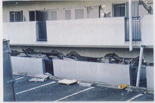
写真-6.2.11 桜ヶ丘町南部の集合住宅 (図-6.2.4 の㉕) 北棟1F部分が圧壊し、大きく傾斜している。
