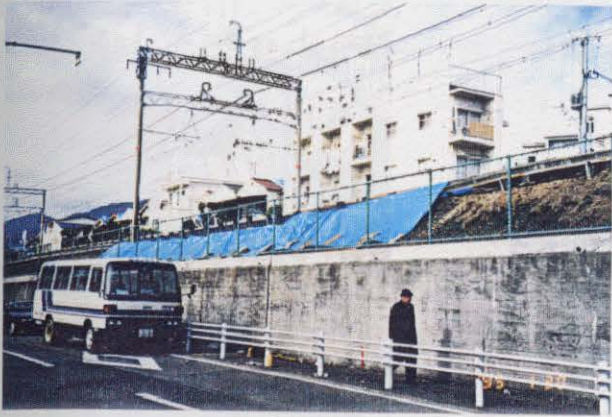
写真-6.3.13 阪急電鉄盛土法面の小崩壊（図-6.3.6の①） 楠丘町一丁目付近 線路脇の盛土法面部が約20mに渡って小崩壊をしている。
