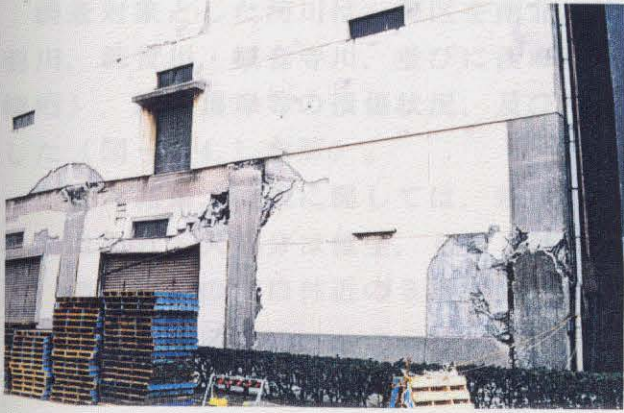
写真-6.3.31 倉庫の柱の損傷状況〔明糖倉庫〕(図-6.3.8の⑦) 倉庫裏の岸壁は写真-6.6.6に示すように 大きな被害を受けている。
