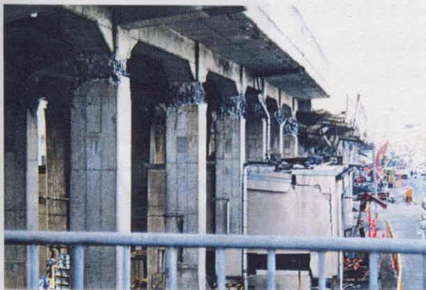
写真-6.3.15 JR高架橋の被害状況（図-6.3.6の③） 石屋川右岸 橋脚の頭部（上部工桁下のハンチ下部）が座屈し、主鉄筋が露出している。
