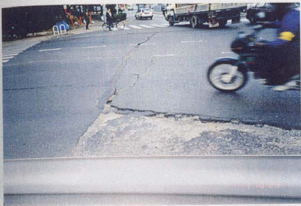
写真-6.3.1 石屋川堤防上の道路の段差(図-6.3.3の①) 石屋川堤防上の道路はクラック、段差が多数発生している。
