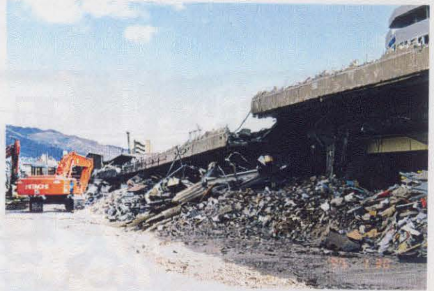
写真-6.3.16 JR六甲道駅全景（図-6.3.6の④） 下部工が圧壊している。 さらに、上部工にも損傷が現れている。
