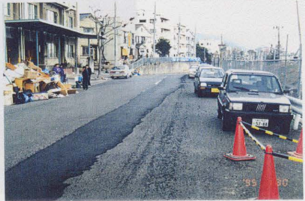
写真-6.3.4 灘北通7丁目のJ R沿いの道路補修跡(図-6.3.3の④) 道路センターに幅1.0~1.5m程度の補修跡が約100mの区間に渡って認められ、J R側の擁壁が変位し、道路センターに段差が発生したものと推定される。
