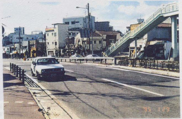
写真-6.3.5 国道2号線西灘交差点付近の道路補修跡(図-6.3.3の⑤) 中央分離帯が沈下しており、道路が液状化により沈下したものと推定される。
