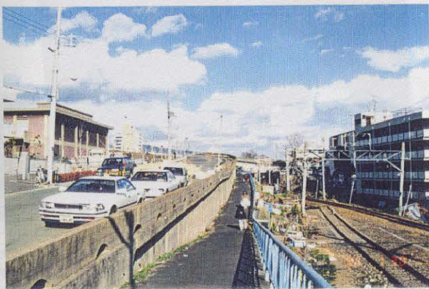
写真-6.3.3 J R横断橋(灘橋)の南口進入路(図-6.3.3の③) 擁壁が傾斜し、クラック、継ぎ目のズレが多数発生している。道路面は波打っている。(調査時点は完全に通行止め)
