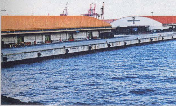
写真-6.3.26 第一突堤西側の耐震岸壁(図-6.3.8の②) 目地部のズレがみられる程度で、機能には問題がない。 背後のかまぼこ型の倉庫は0.7m程度沈下しており、B棟との間はアプローチ盛土が成されている。
