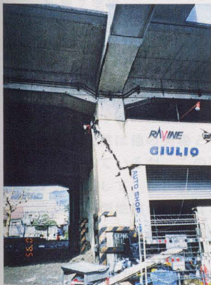
写真-6.3.21 徳井神社付近のJR高架橋(図-6.3.6の⑨) 橋脚に斜め方向のせん断クラックが発生し、 主鉄筋が露出している。
