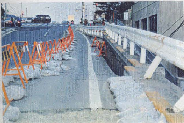
写真-6.3.2 山手幹線と石屋川との交差点部の擁壁の傾斜(図-6.3.3の②) 路肩部が沈下し、擁壁天端との隙間は30cmに達している。道路にも補修跡が認められる。
