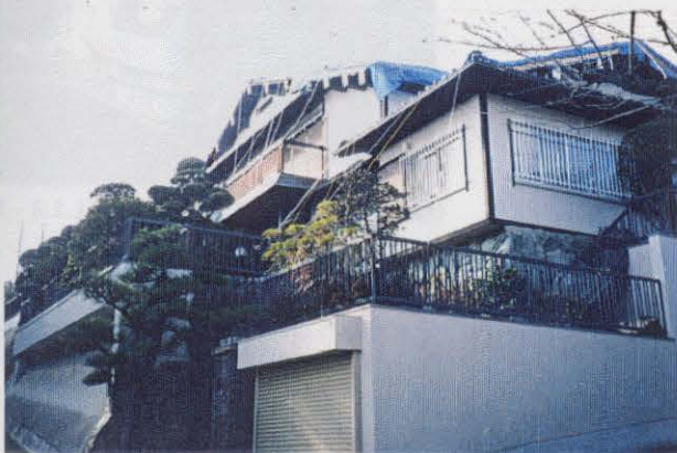
写真-6.2.4 長峰台1丁目の家屋の被害状況(図-6.2.4の④) 壁と瓦の破損が大きく、周辺の道路にも多くの クラック、段差が発生している。
