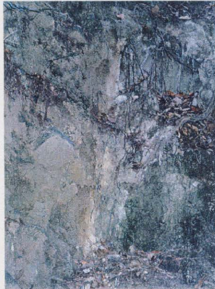
写真-6.4.14 大月台西側の沢浴い(図-6.4.9の⑥) 大月断層の露頭。右側白色部の花崗岩と左側の 黄褐色部の高位段丘礫層の境界となっている。 変状は見られない。
