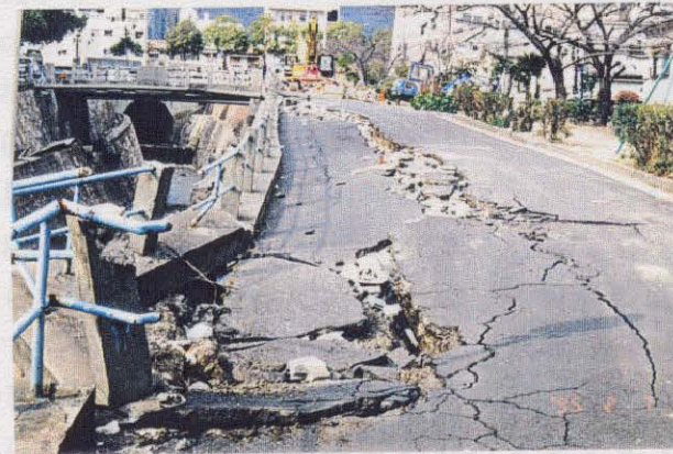
写真-6.4.7 西郷川・岸地通5丁目付近(図-6.4.3の⑦) 左岸側の石積み護岸の一部が倒壊するとともに、兩岸部の道路中央部にまで崩壊(すべり)が及び、最大30cm程度で路面が陥没する。陥没は約50m区間で生じており、護岸は全般的にはらみ出している。
