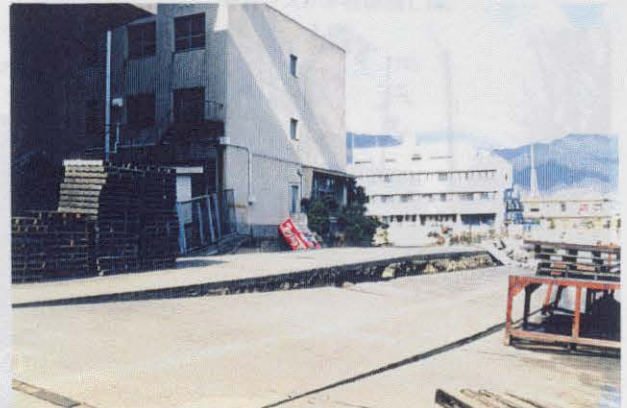
写真-6.2.7 摩耶埠頭内の道路および建物(図-6.2.4の⑦) 道路は非常に大きな段差が発生しているが、建物の 被害はそれに比べると軽微である。
