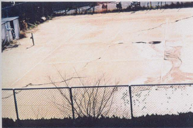
写真-6.4.18 神戸大教養部グラウンドの変状状況(図-6.4.9の⑩) 山側が沈下したクラックが広く分布し、水道管 破裂による水と砂の噴出跡が見られる。
