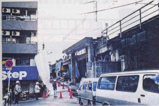
写真-6.3.14 阪急電鉄高架橋の被害（図-6.3.6の②） 阪急王子公園駅 橋脚が座屈しているため、すでに解体工事作業が行われている。
