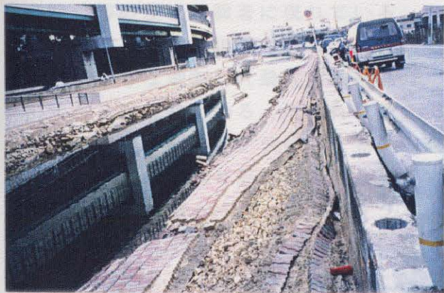
写真-6.3.33 運河の親水性護岸の崩壊状況(図-6.3.8の⑨) ブロック部は遊歩道となっていた。 左の高架道路はハーバーライン。
