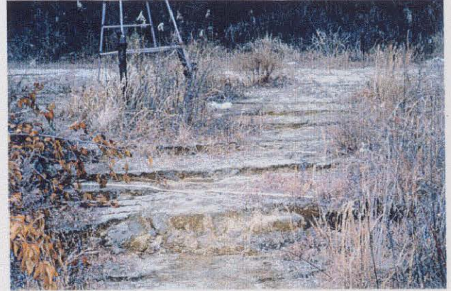
写真-6.4.19 土山町 旧神戸市外国語大学(図-6.4.9の⑪) 旧運動場に盛土のすべりに起因するクラックが多く発生している。
