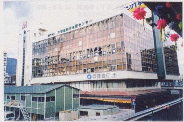
写真-6.2.12 J R六甲道駅前 (図-6.2.4 の㉗) 勤労市民センタービル。 窓ガラスが多数破損した。
