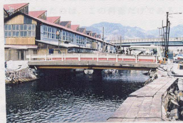
写真-6.4.8 西郷川・河口付近(図-6.4.3の⑧) 護岸は全体にはらみ出し、一部倒壊している。 橋梁(川口橋)に関しても破損しており、特に右岸側橋台、中央部橋脚が右岸側に傾斜している。
