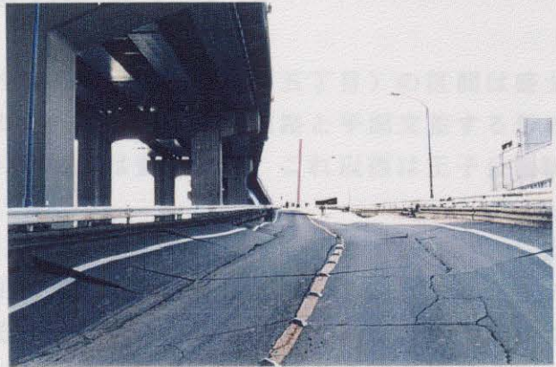
写真-6.3.10 摩耶大橋アプローチ部の被害状況(図-6.3.3の⑩) 大きな陥没や不陸が生じている。正面の主塔は北側へ傾いている。
