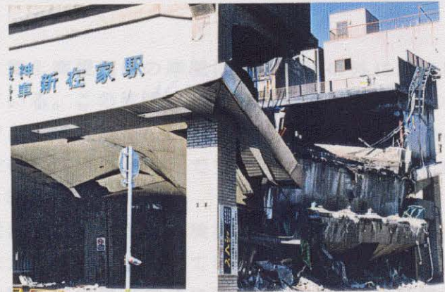
写真-6.3.23 阪神新在家駅東側(図-6.3.6の⑪) 橋台は圧壊し、上部工にも損傷が見られる。
