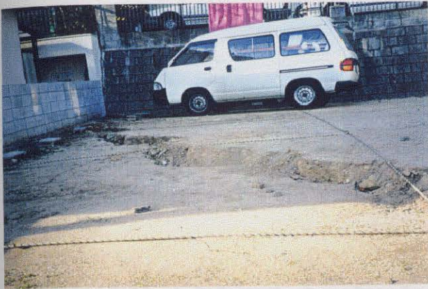
写真-6.4.16 長峰台1丁目宅地の変状(図-6.4.9の⑧) 谷側が数10cm沈下している。
