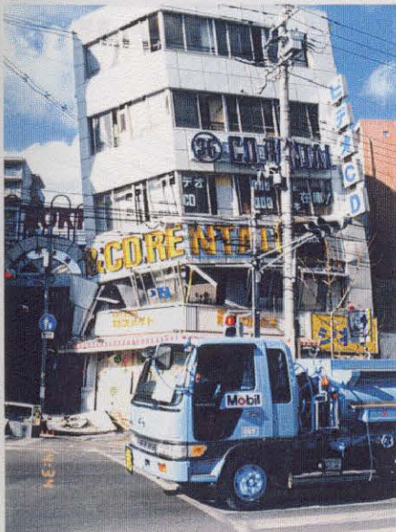
写真-6.2.10 森後町2丁目 (図-6.2.4 の㉘) 5階建てのビル。 2階部分が圧壊している。
