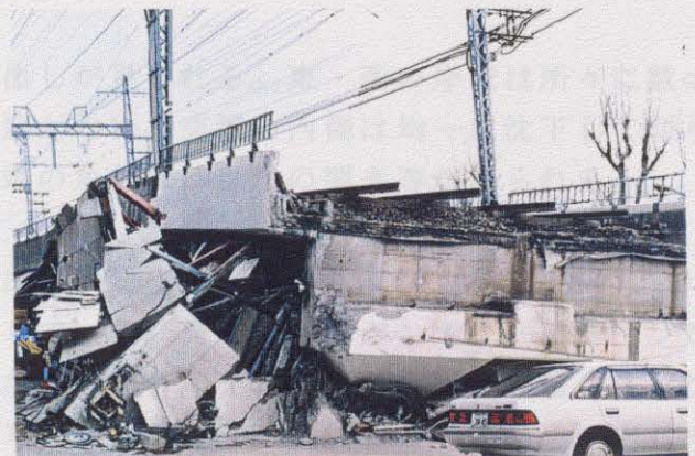
写真-6.3.24 船寺町3丁目 阪神道路横断橋梁(図-6.3.6の⑫) 橋台の座屈に伴う圧壊と上部工の落橋。
