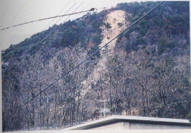
写真-6.4.9 六甲ケーブル下駅上部斜面の崩壊状況(図-6.4.9の①) 硬質の岩盤が幅20~30mにわたり崩壊している。
