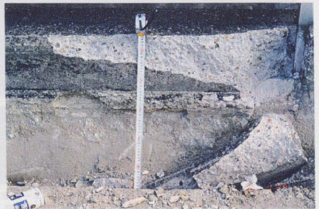
写真-6.3.6 国道2号線西灘交差点付近の歩道の沈下(図-6.3.3の⑥) 歩道部が最大55cm沈下している。
