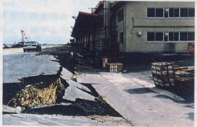
写真-6.3.34 摩耶埠頭 第二埠頭東側岸壁(図-6.3.8の⑩) 倉庫との際の所で内側地盤が沈下しているので、 大きな段差が生じている。
