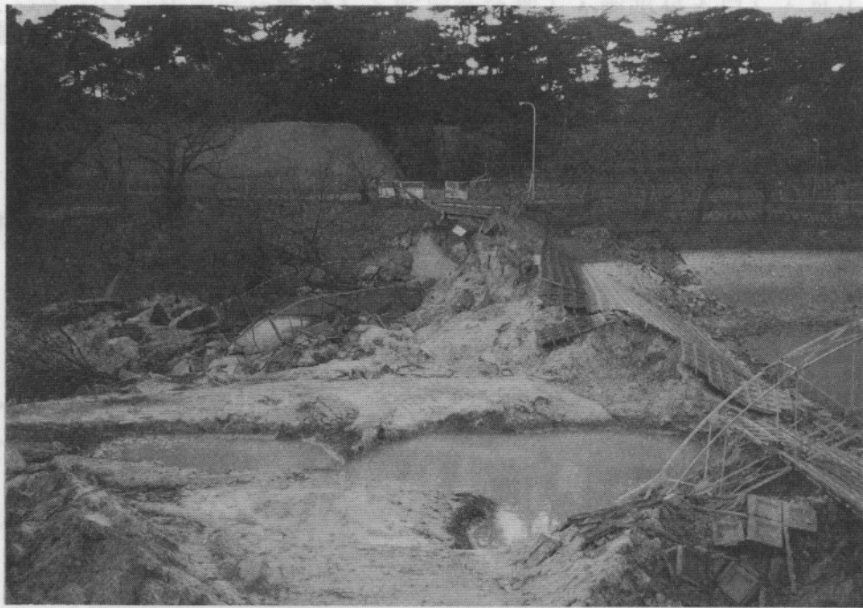
写真5.5.3-2 土堰堤 Photo5.5.3-2 Damaged weir
