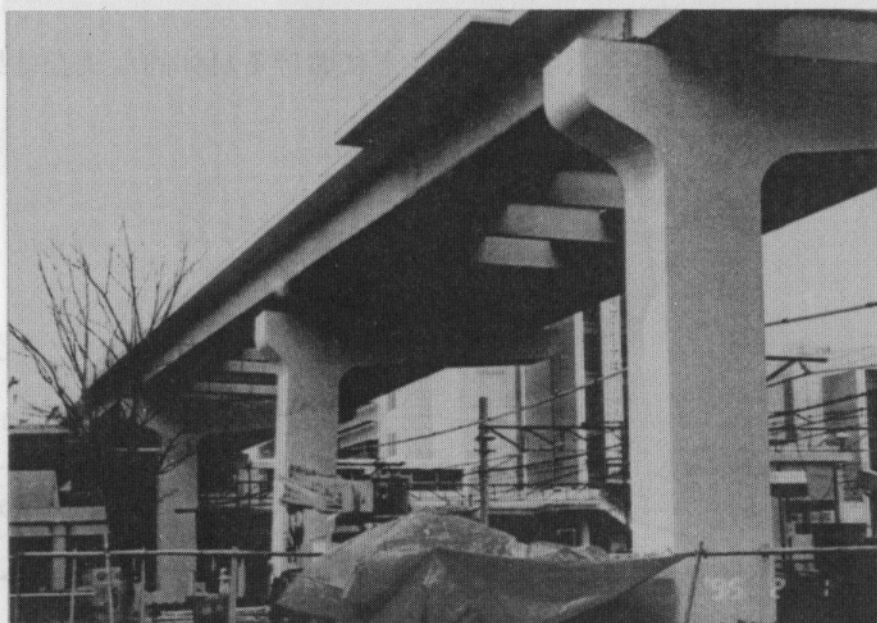
写真 5.6.4-3 非対称橋脚の傾斜
