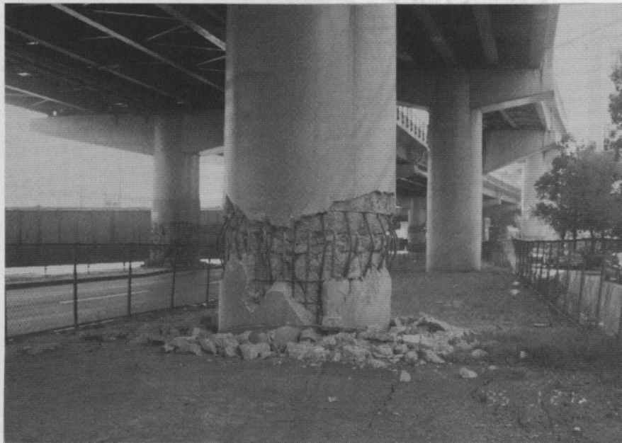
写真 5.6.2-1 段落し部曲げ破壊
