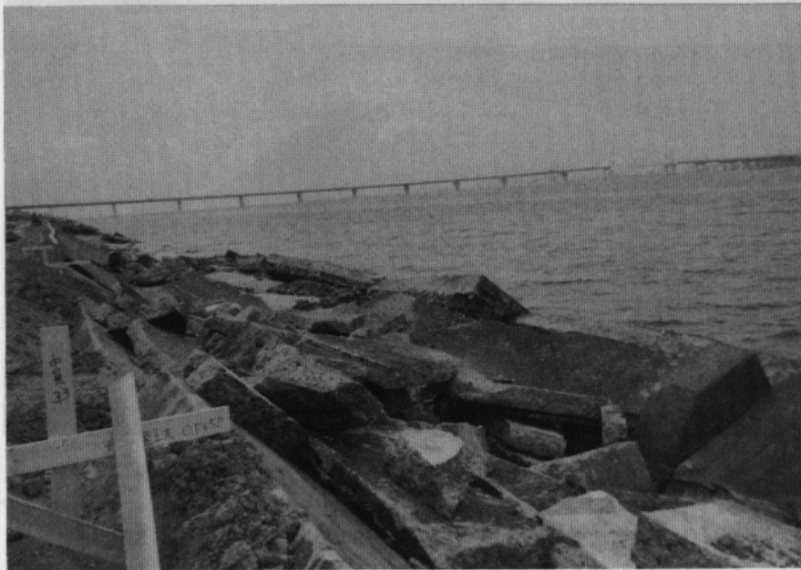
写真-5.8-1 表のり工、波返工の崩壊
