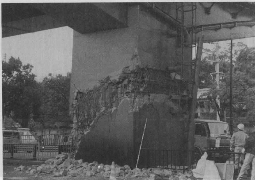
写真 5.6.2-4 短橋脚の断落し部からのせん断破壊
