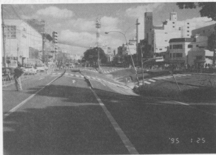
写真5.5.1-1 神戸高速鉄道大開駅上の地表面の沈下 Photo5.5.1-1 Ground Settlement onto Underground Station
