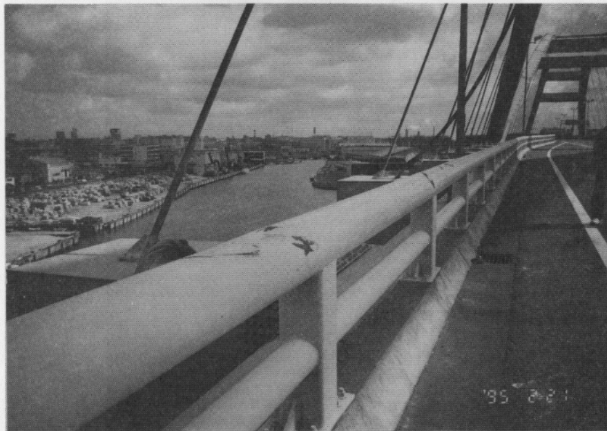
写真5.6.3-5 ニールセンアーチ橋のケーブルアンカー破断 Photo 5.6.3-5 Stress Release due to Failure of Cable Anchorage
