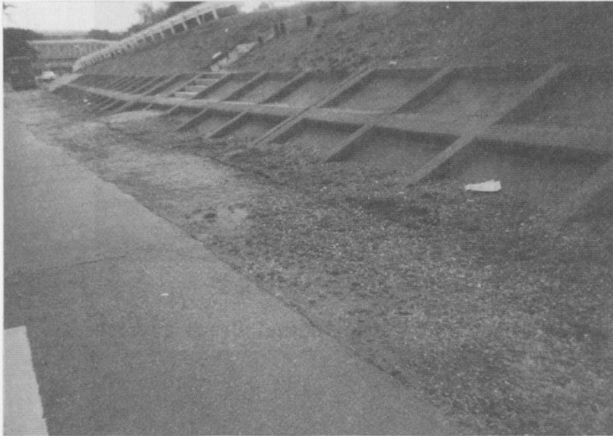
写真-5.8-4 表のり尻の縦亀裂
