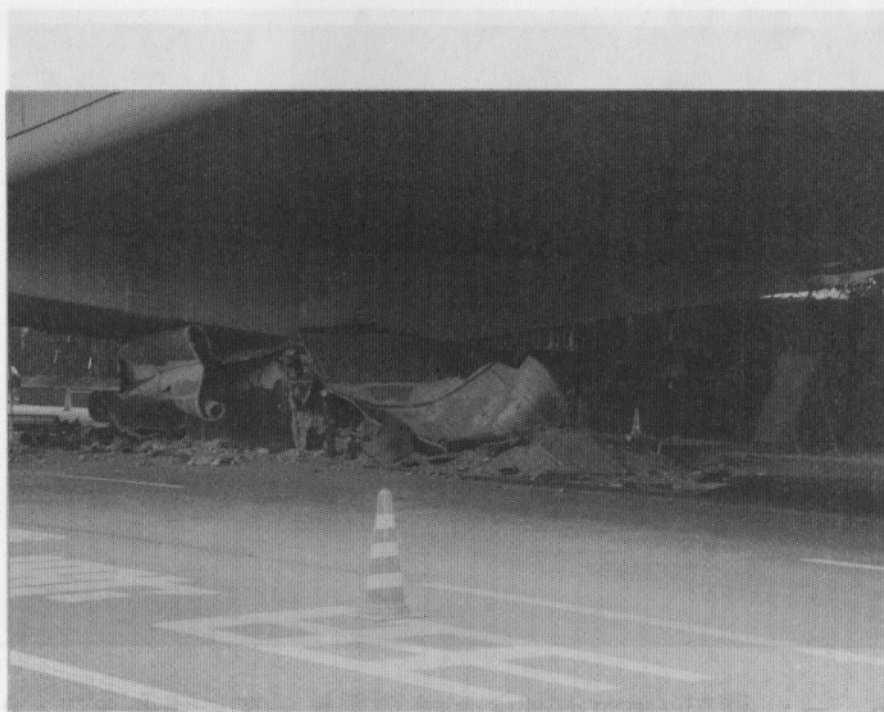
写真5.6.3-1 座屈破壊した鋼製橋脚
