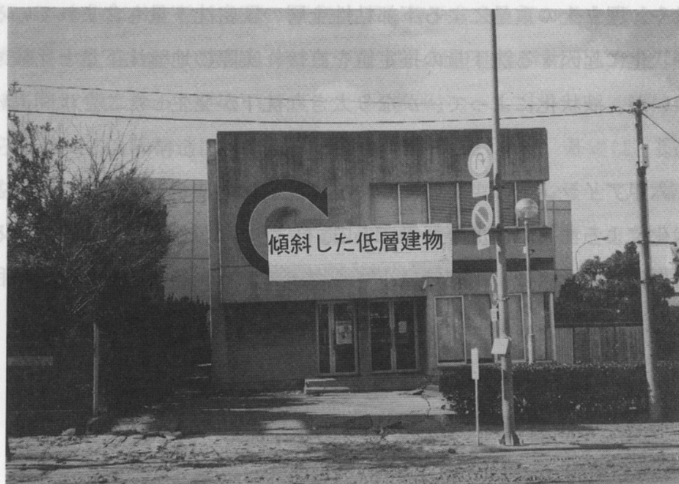
写真5.2.5-7 地盤の液状化によって傾斜した低層建物
