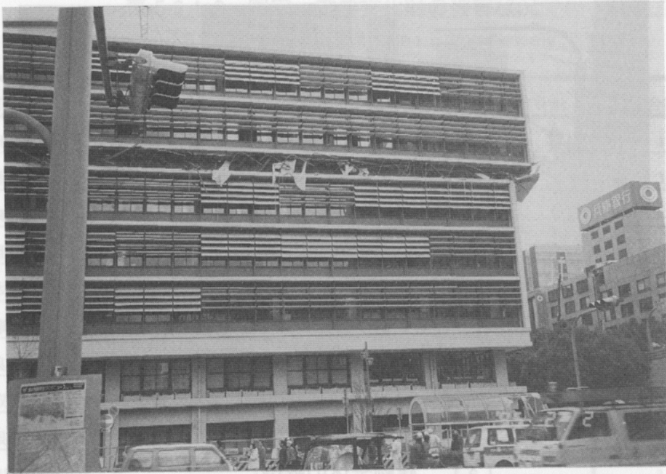
(a) 中間層の崩壊（8階建てSRC造，6階が崩壊）
