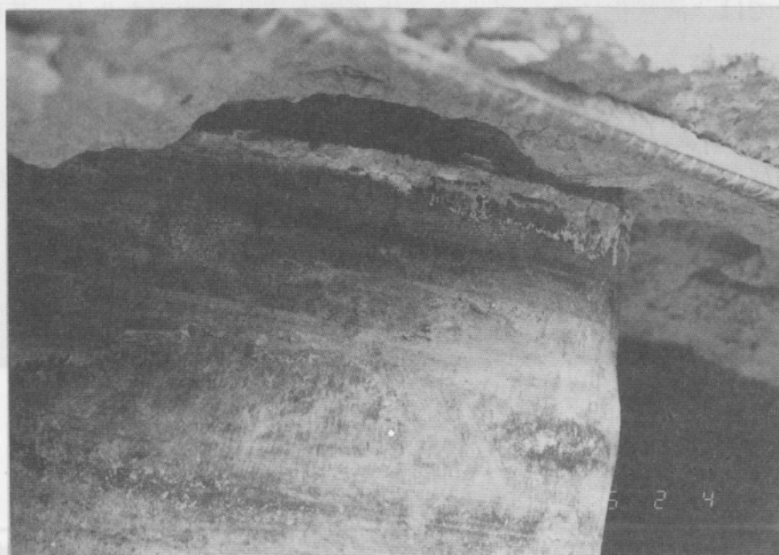
写真5.2.5-5 液状化に起因する地盤の側方流動によって基礎スラブから杭頭が離れた鋼管杭
