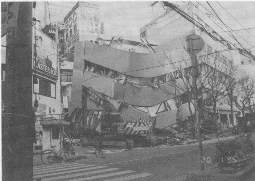
(b) 建物全体の崩壊
