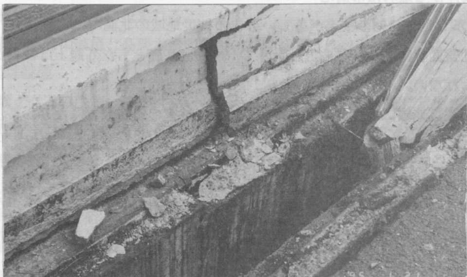
写真5.2.5-2 基礎梁にクラックが発生した建物
