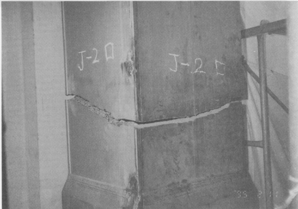
写真 5.2.1-13 角形鋼管柱の破壊状況
