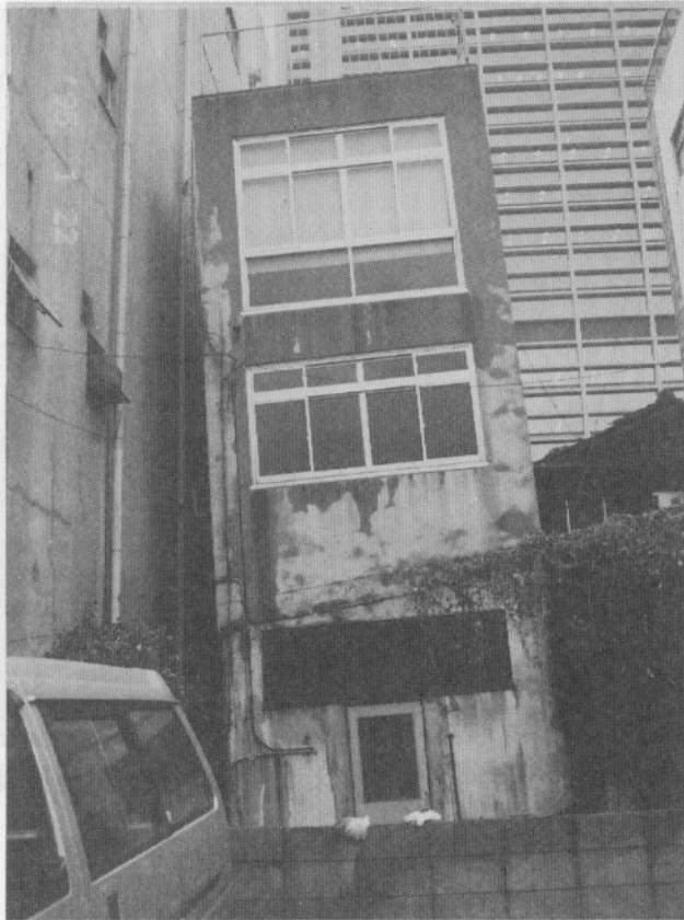
写真5.2.5-3 液状化によって傾斜した建物
