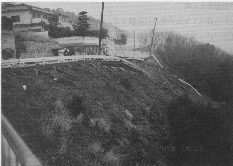
写真5.1.2-3 道路部分の斜面崩壊
