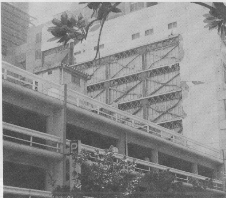
(b) ブレースの曲がり
