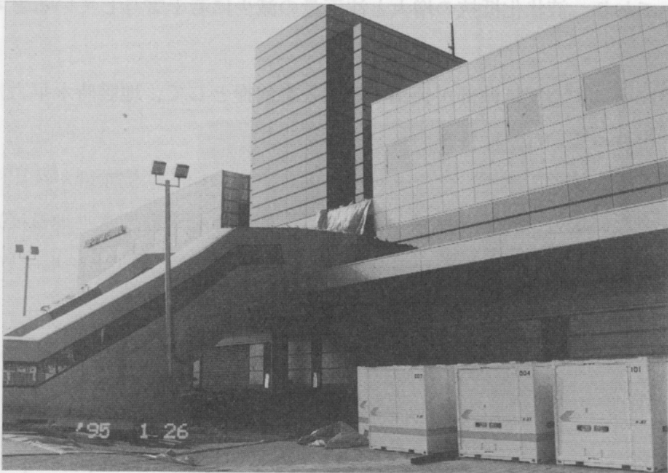
写真5.2.5-8 液状化に起因する地盤の側方流動によって損傷を受けた基礎梁 (その1)
