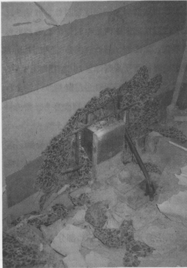
写真5.2.2-2 取付け金物周辺のコンクリート破損例
