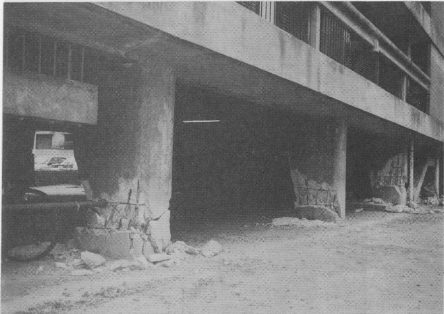
写真 5.2.1-3 ピロティ形式の柱の被害
