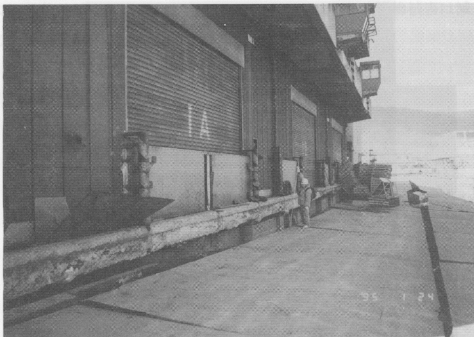
写真5.2.5-4 液状化に起因する地盤の側方流動によって基礎梁が露出した建物
