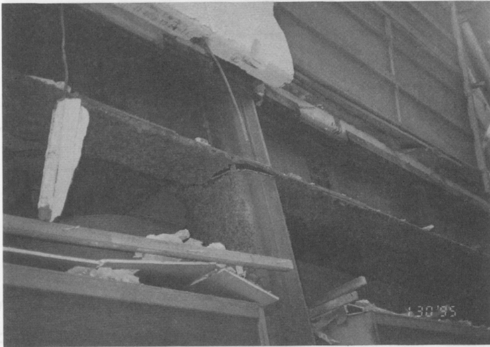
(a) 角形鋼管柱とH形鋼梁との溶接部の破断
