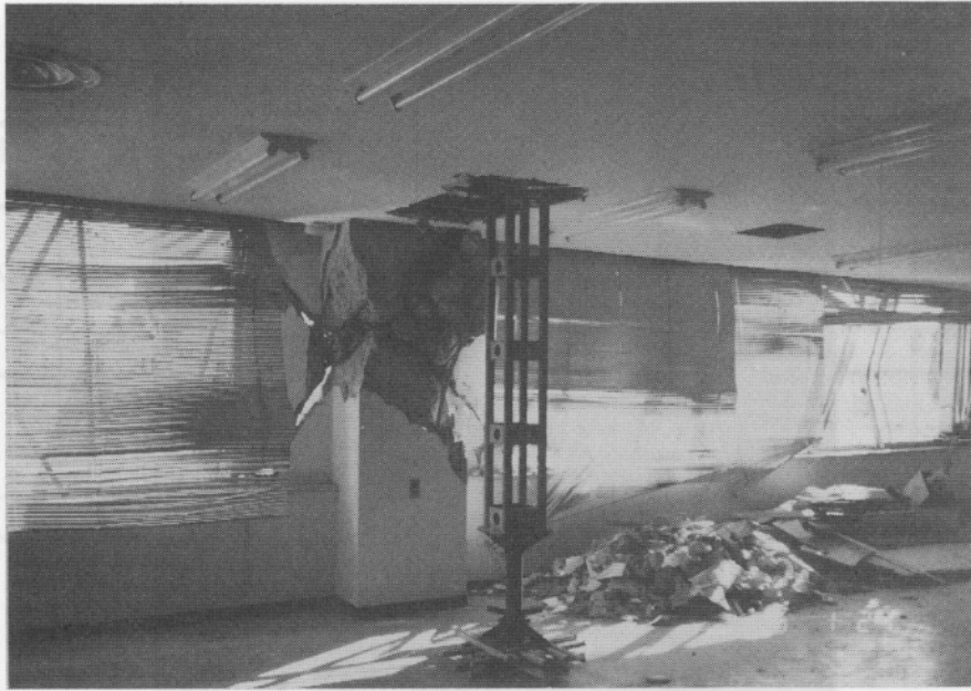
(a) 雑壁・腰壁付きの柱のせん断破壊 (5階建てRC造で1, 5階の柱がせん断破壊 破壊した柱の直上には機械室が載っている)
