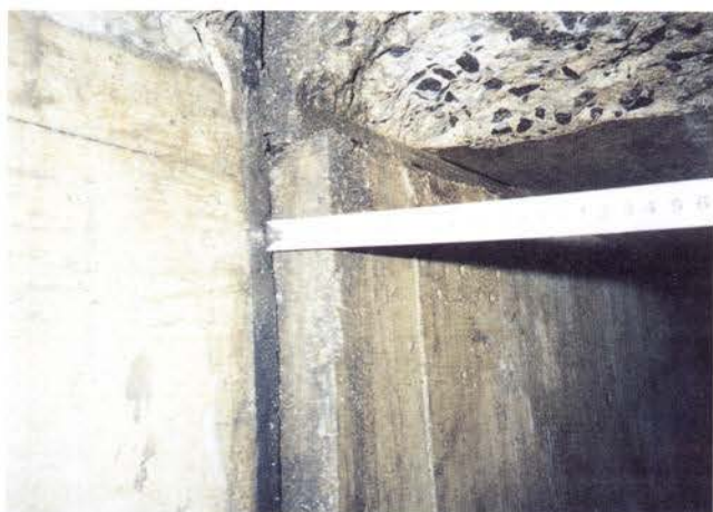
被災状況（暗渠河川の継目分離等：西谷川）
