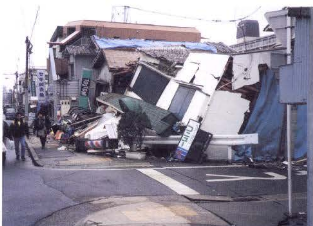
被災状況（民家倒壊他、護岸崩壊等による河道閉塞：高橋川）
