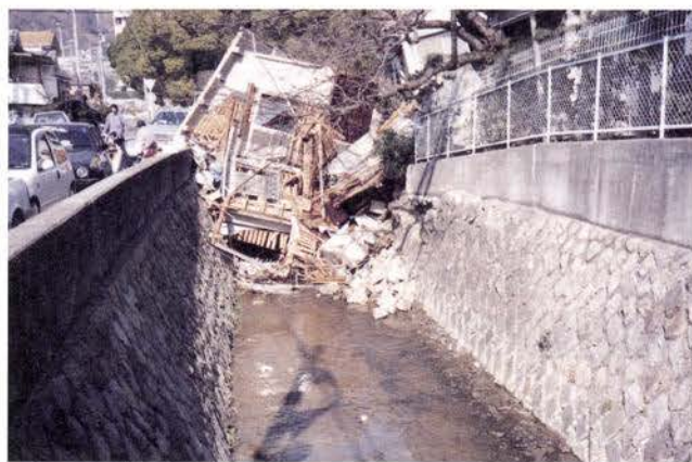
天神川では倒壊家屋が河川を閉塞
