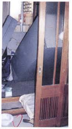
災害待機室ではロッカーが倒れた
