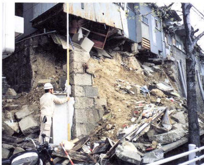
大丸町3丁目の民間宅地擁壁の崩壊 (神戸市長田区)
