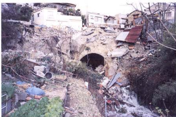
新湊川では会下山トンネル吐口部を崩土が閉塞
