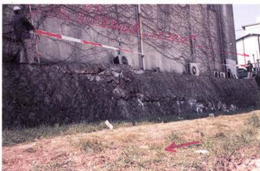
写真1 被災状況 (右岸)
