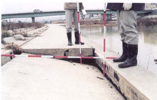
写真3 被災状況 (甲第215号)
