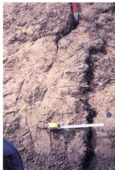
写真3 被災状況 (Bブロック: 亀裂の近景)
