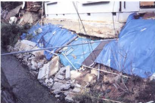
写真1 被災状況 (宅地の基礎が河川側に動く)
