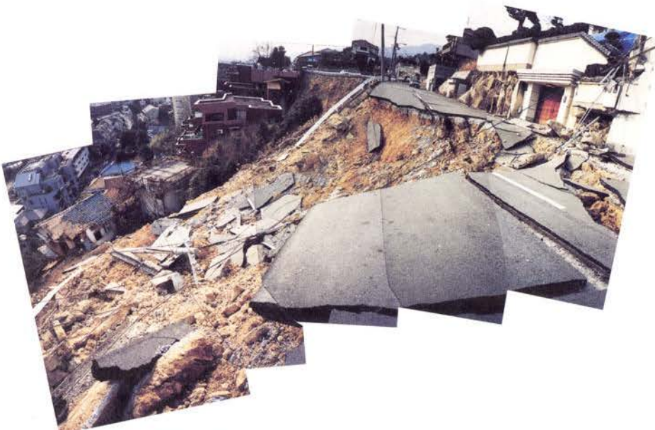
写真3 被災状況（道路の変状：Bブロック）
