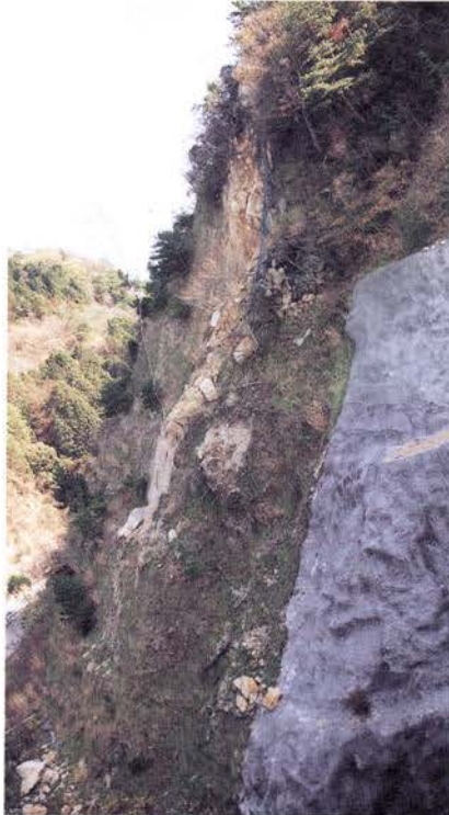
写真3 被災状況（ダム右岸）
