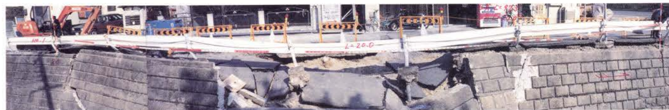
写真3 被災状況（下流部）
