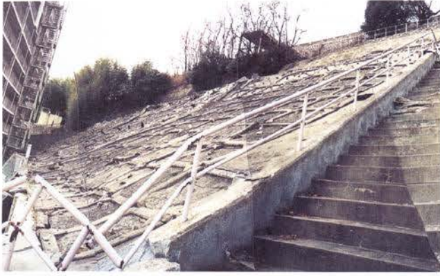
写真2 被災状況（プレキャスト法枠の押し出し：Aブロック）
