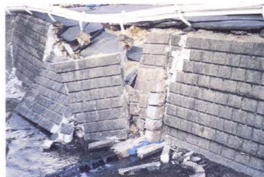
写真1 被災状況（下流部）
