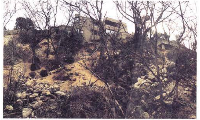
写真4 被災状況（斜面崩壊状況：Cブロック）
