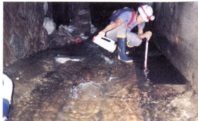
写真3 被災状況（陥没箇所）
