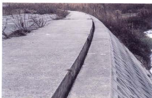
写真1 被災状況 (甲第212号)
