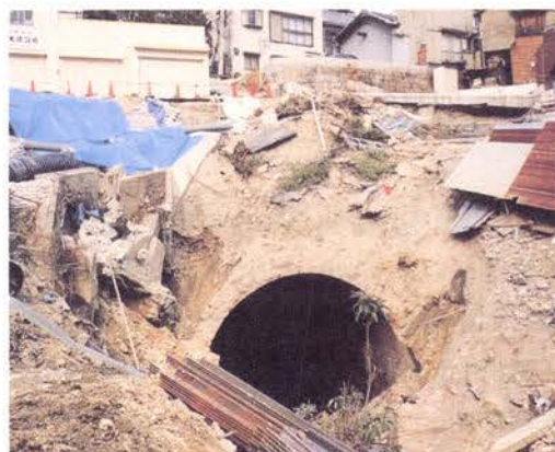
写真3 被災状況（会下山トンネル吐口部）
