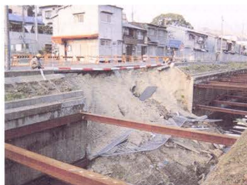
写真4 被災状況（兵庫区湊川町地内の右岸側護岸）
