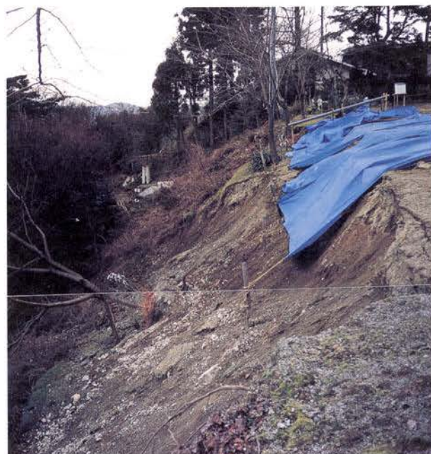
写真1 被災状況 (Aブロック：頭部の崩壊)
