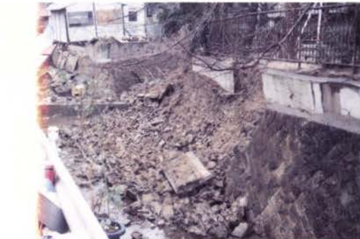
写真3 被災状況 (下流部)
