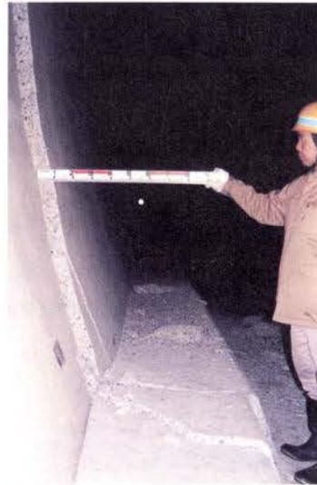
写真2 被災状況 (横尾山断層西側側壁：80mmの段差)
