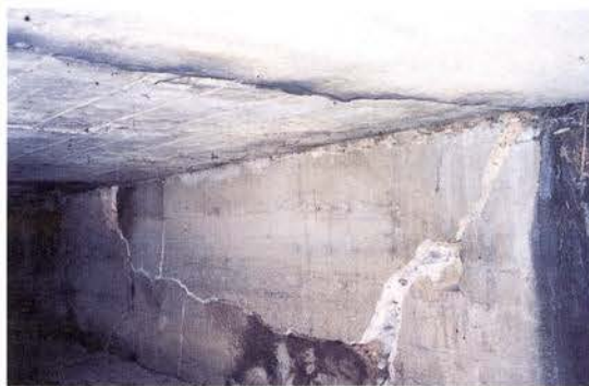
写真2 被災状況（下流部護岸）
