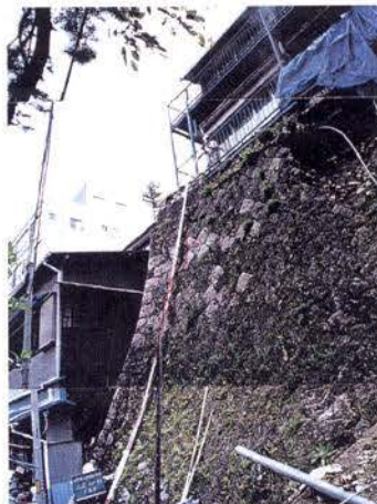
写真2 被災状況 (石垣崩壊)
