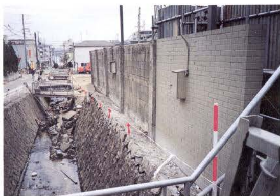
写真1 被災状況 (護岸の崩壊)
