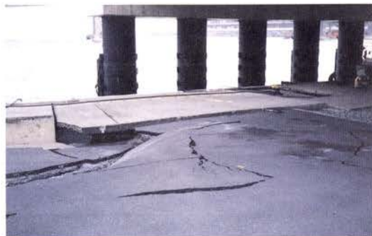
写真3 西谷川 (甲第276号、中央区脇浜海岸通) 地表に見られる陥没状況から被災の大きさが分かる
