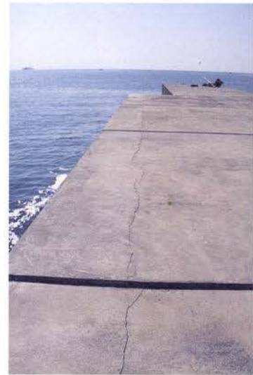
写真3 被災状況 (左岸側導流堤天端のクラック)
