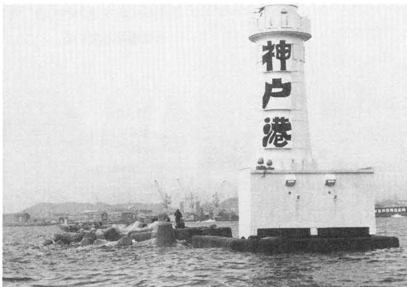
⑯第1防波堤。港湾便覧図に よると+4.0 mあったはず が、数m沈下している。
