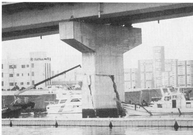
⑨ヒビが入った橋脚。
