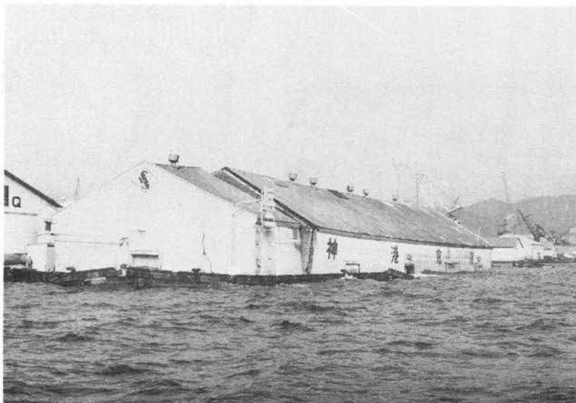
②⑨完全に水没している倉庫。 屋根のズレ。(兵庫突堤部)
