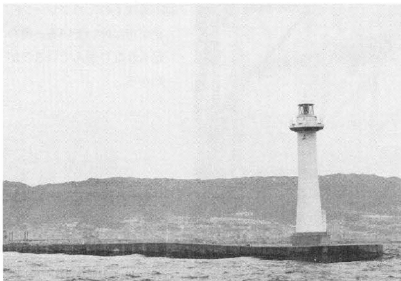
⑬第 6 南防波堤。完成時 + 5.0 m であるからかなり沈 下していることになる。
