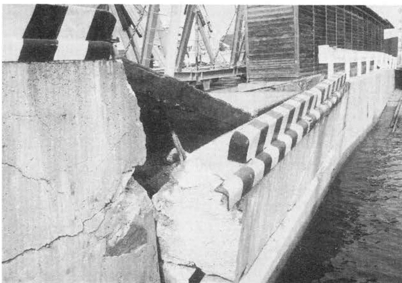
②⑥スロープわきの崩壊部。 (同前、右端部拡大写真)
