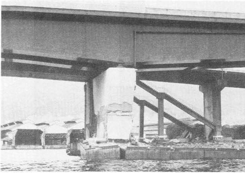
⑤⑤摩耶大橋。橋脚の被害がひどい。
