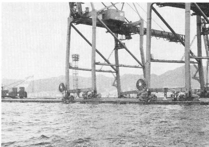
⑩不等沈下のためクレーンの足が宙に浮いている。奥の足もかなり歪んでいるのがわかる。
