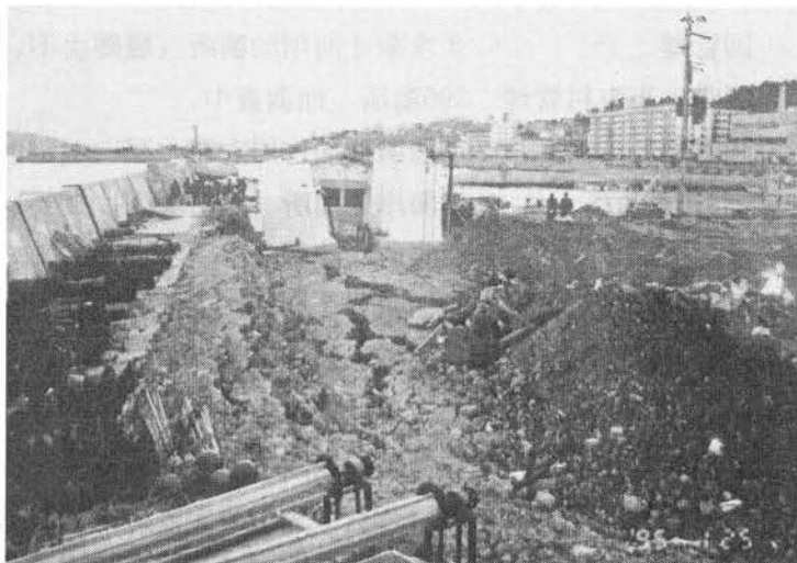
塩屋漁港（神戸市）～のり加工の海水揚水施設が沈下、傾斜
