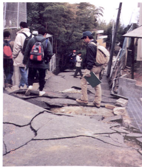
芦屋市三条町の宅地の変状を調査する大阪市立大学の調査グループ 一九九五・二・一六
