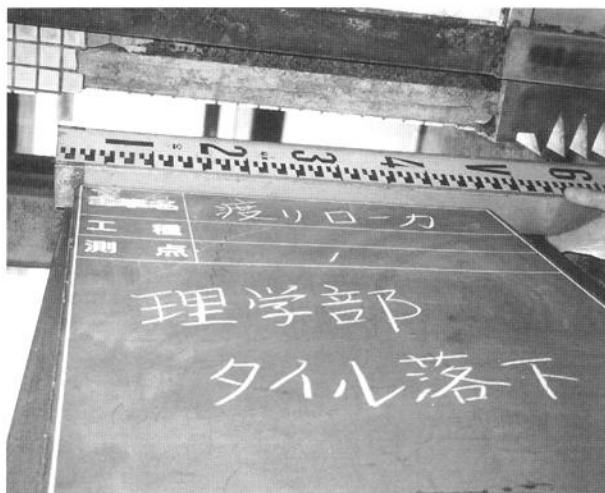
理学部渡廊下タイル落下
