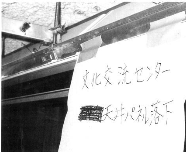
文化交流センター、天井パネル落下
