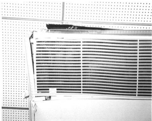
工学部GHP破損
