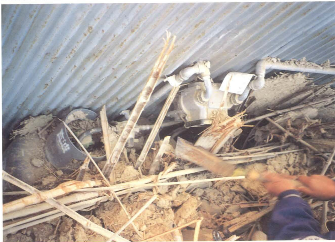
⑤ 崩れ落ちた土壁に埋もれた消費設備。
