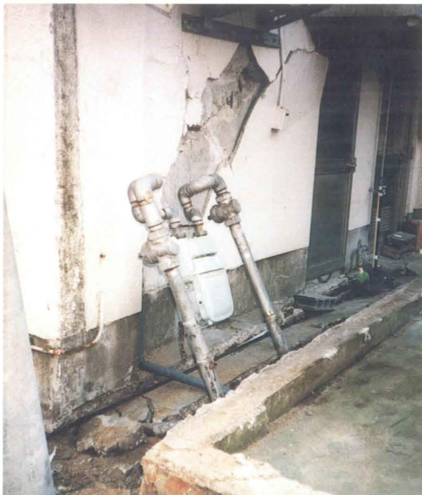
④ 倒壊した家屋と共に折れ曲がった都市ガスメーター。都市ガス被害は甚大で、都心部ではこうした光景が各所で見受けられた。
