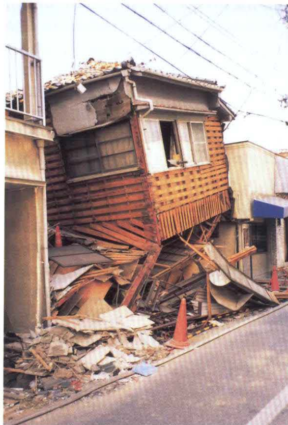
木造建物の 倒壊 （神戸市内）
