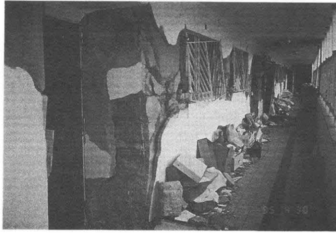
(写真-7) 外壁剪断破壊(芦屋市内マンション)
