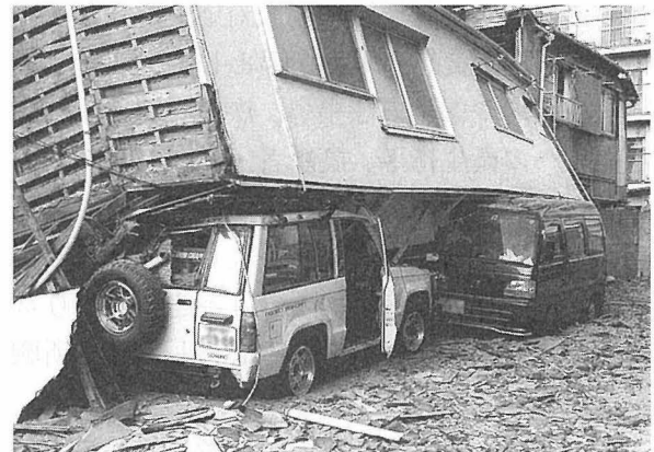
写真5-1-4 1階が潰れた住宅：若宮町（須磨区）
