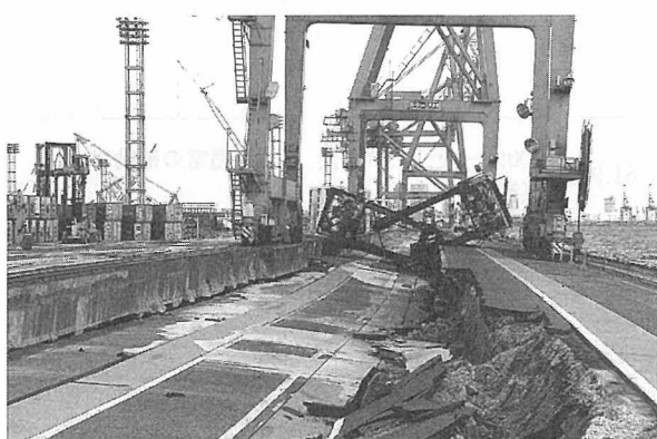
写真18-1-1 大きな被害を受けたコンテナターミナル
